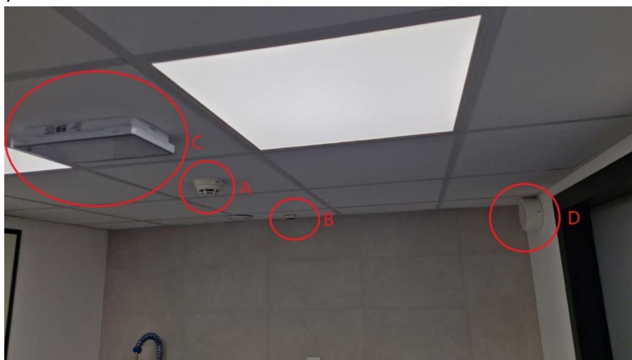
Rys 4. Wnętrze zaplecza kuchni ze wskazanymi przykładowymi elementami systemu p-poż.
