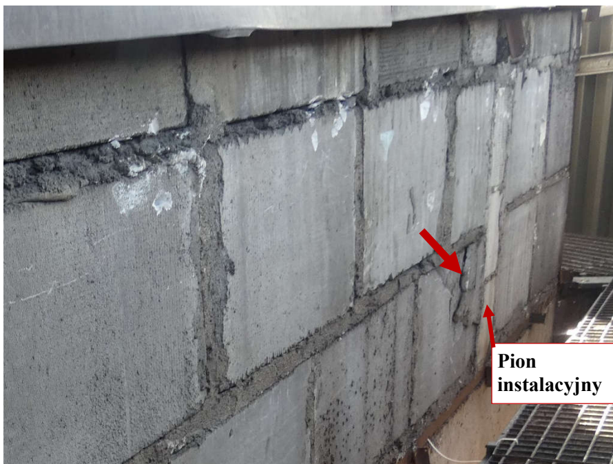
Fot. 48 Kondygnacja 7 (Poziom +28.50) Elewacja Zachodnia – widok ściany murowanej w osiach 10/E-F. Zbyt duże wymiary spoin. Ściana z uszkodzonych elementów murowych. Wypełnienie ubytków między elementami i uszkodzonych miejsc zaprawą i gruzem. Zamknięcie pionu instalacyjnego.
