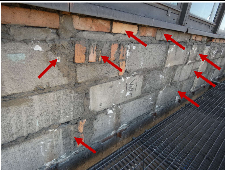
Fot. 27 Kondygnacja 7 (Poziom +28.50) Elewacja Północna – widok ściany murowanej w osiach 12-13/I. Zbyt duże wymiary spoin. Wykonanie i zwieńczenie ściany z uszkodzonych elementów murowych o zróżnicowanych materiałach i kształtach. Wypełnienie ubytków między elementami zaprawą i gruzem.
