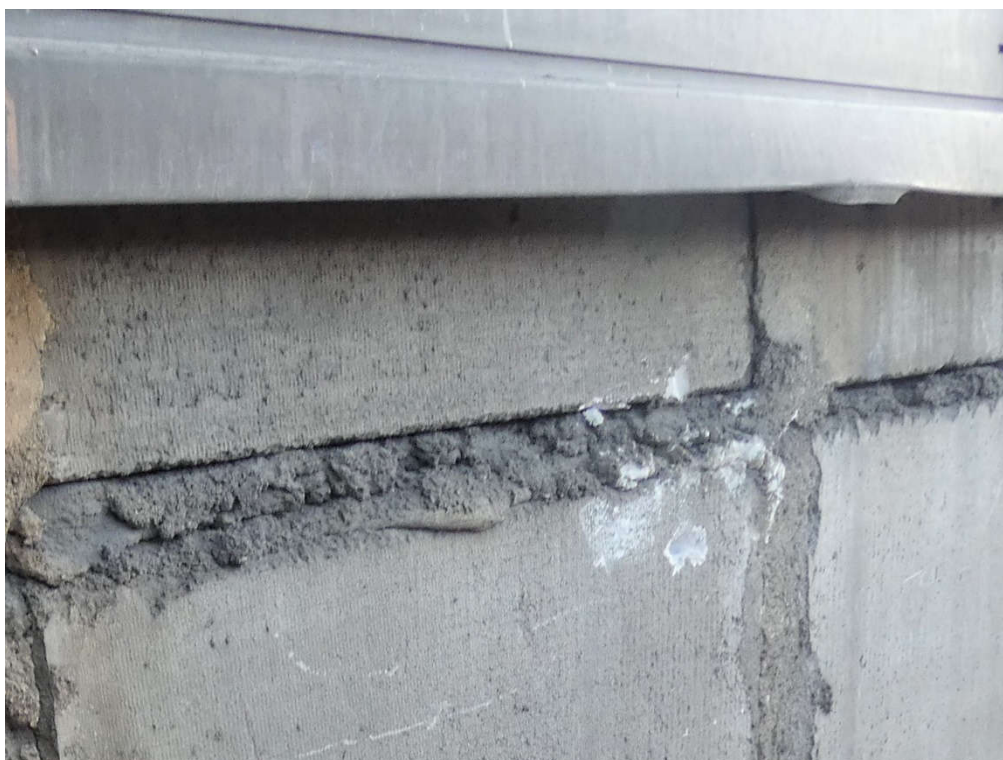
Fot. 9 Widok zwieńczenia ściany z elementów o wymiarach 12x60 cm z betonu komórkowego bez podlewki pod profilem stalowym.
