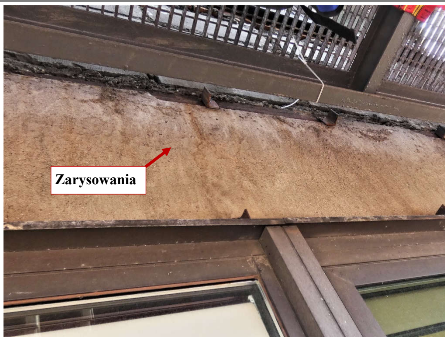
Fot. 105 Kondygnacja 7 (Poziom +28.50) Elewacja Zachodnia – belka w osiach 10/E-F. Zarysowanie belki w przęśle na wysokości miejsca oparcia.
