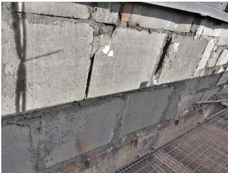
Fot. 2 Przykładowe ubytki zaprawy w spoinach pionowych
