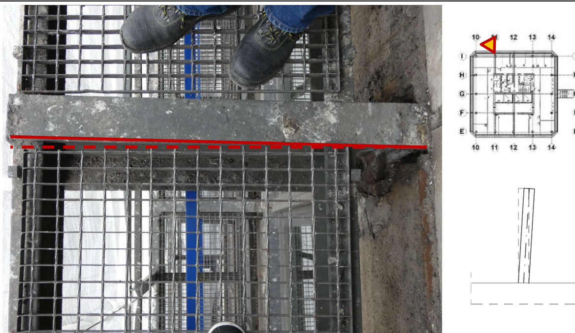
Fot. 148 Kondygnacja 7 (Poziom +28.50) Elewacja Północna – wspornik w osiach 11/I (widok z góry) Przemieszczenie wspornika w kierunku osi 12. Brak widocznych uszkodzeń wspornika.
