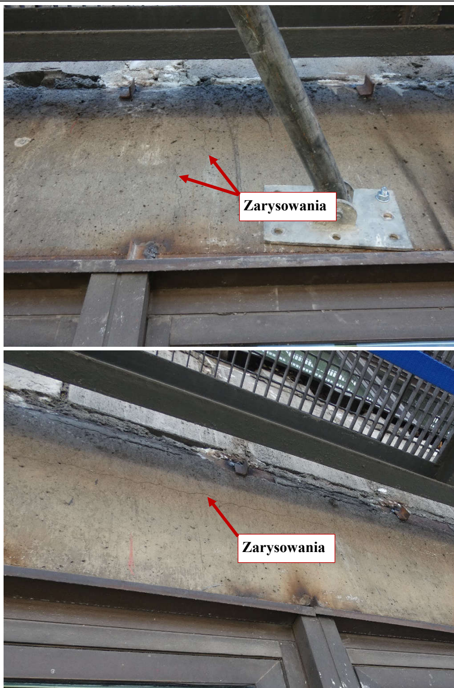
Fot. 75, 76 Kondygnacja 7 (Poziom +28.50) Elewacja Północna – belka w osiach 12-13/I. Zarysowania pionowe i poziome na wysokości miejsca oparcia.
