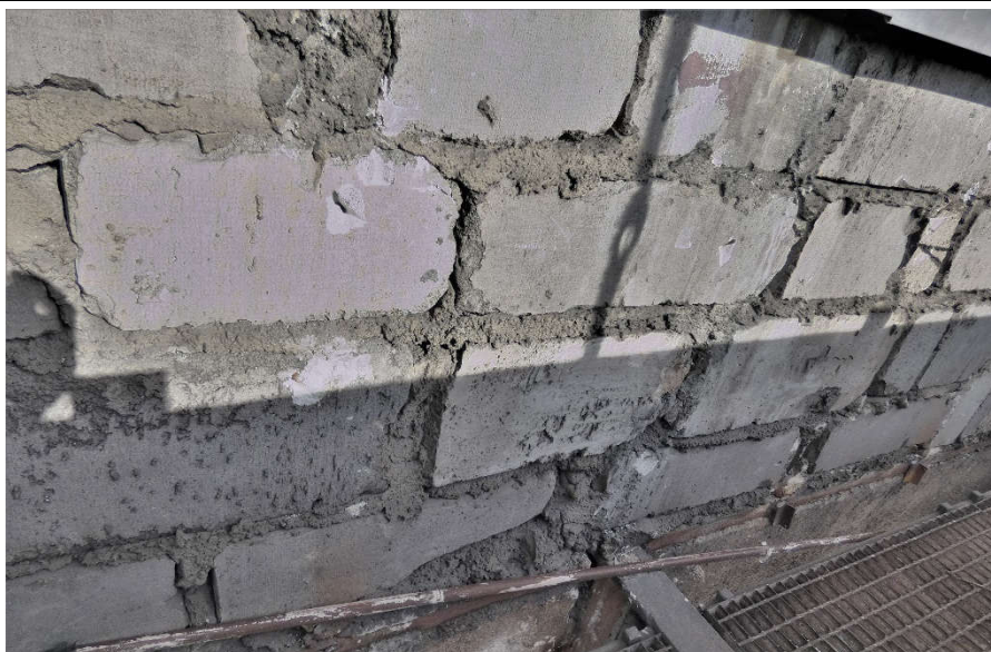
Fot. 55 Kondygnacja 7 (Poziom +28.50) Elewacja Południowa – widok ściany murowanej w osiach 11-12/E.
