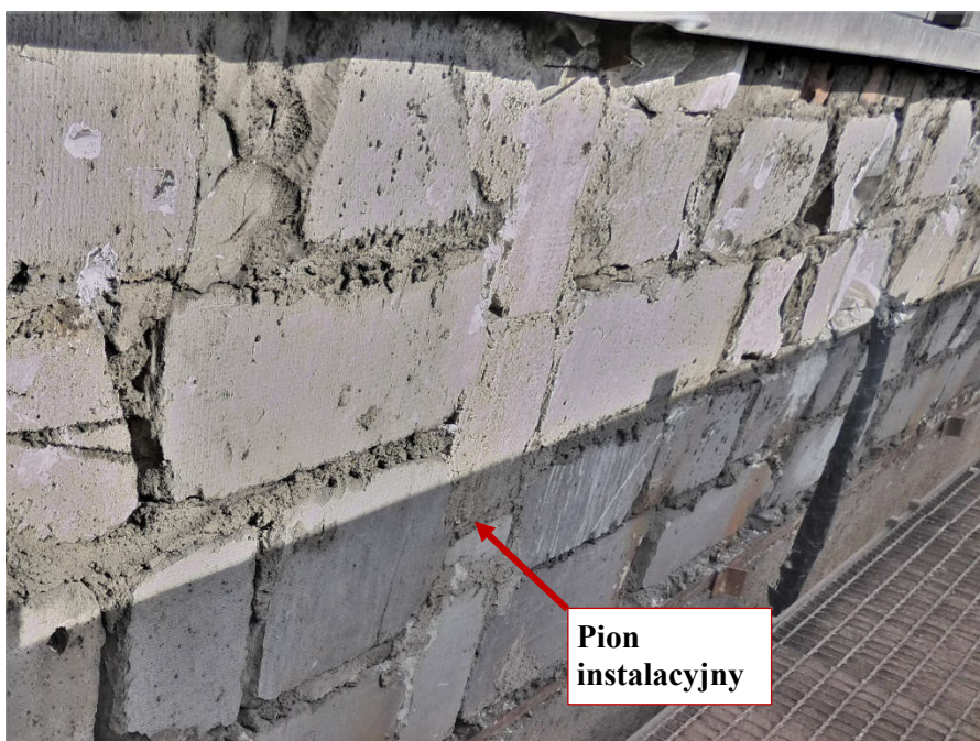
Fot. 56 Kondygnacja 7 (Poziom +28.50) Elewacja Południowa – widok ściany murowanej w osiach 12-13/E.
