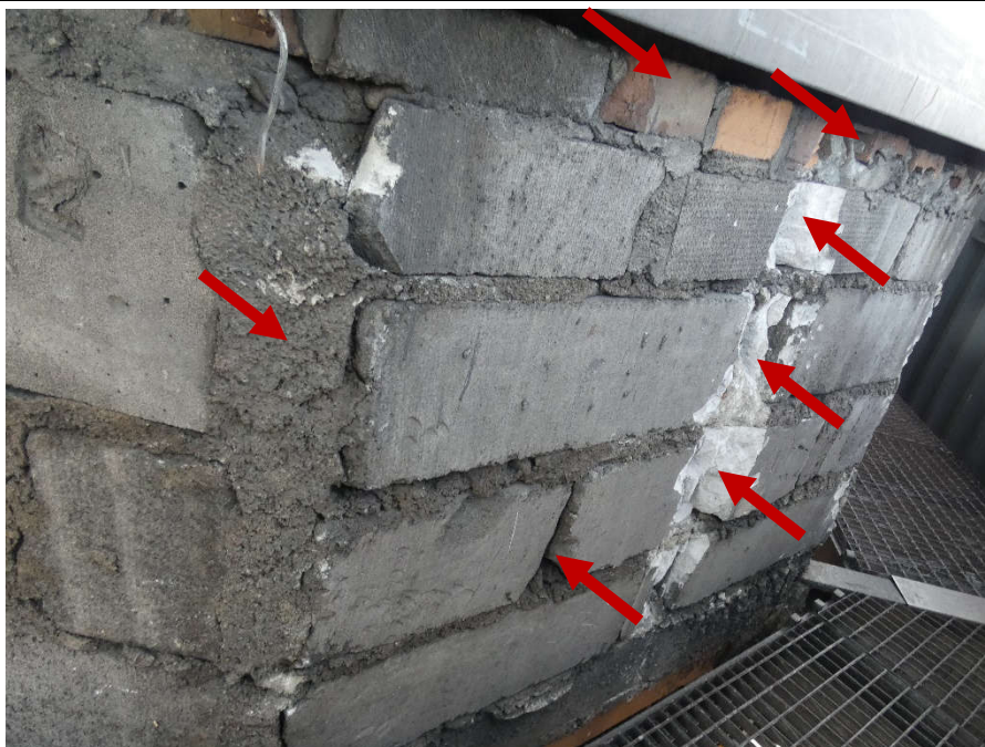
Fot. 35 Kondygnacja 7 (Poziom +28.50) Elewacja Północna – widok ściany murowanej w osiach 10/I. Zbyt duże wymiary spoin. Ubytki spoin pionowych. Niewłaściwe przewiązanie elementów. Wykonanie ściany z uszkodzonych elementów murowych 18x60 cm. Wypełnienie ubytków między elementami zaprawą i gruzem. Zwieńczenie ściany elementami murowymi o zróżnicowanych materiałach i kształtach oraz gruzem.
