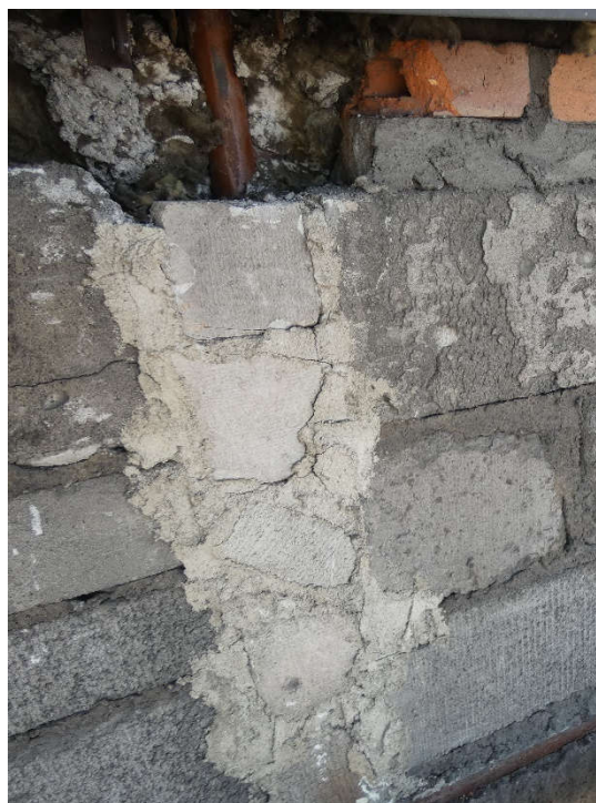
Fot. 12 Widok otwartego pionu instalacyjnego (częściowe zamknięcie zaprawą i gruzem)
