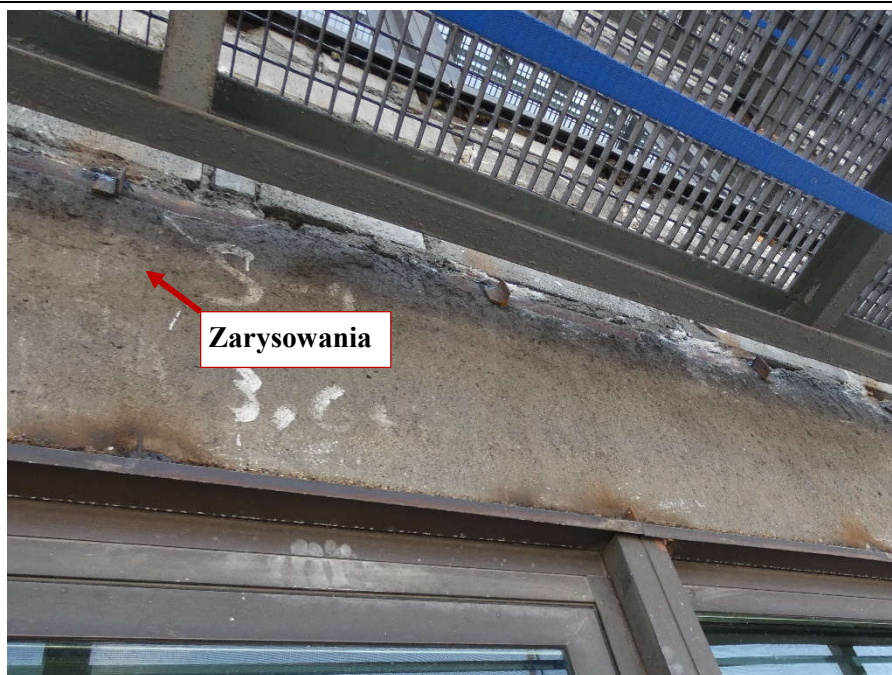
Fot. 81 Kondygnacja 7 (Poziom +28.50) Elewacja Północna – belka w osiach 11-12/I. Zarysowanie belki w przęśle na wysokości miejsca oparcia.
