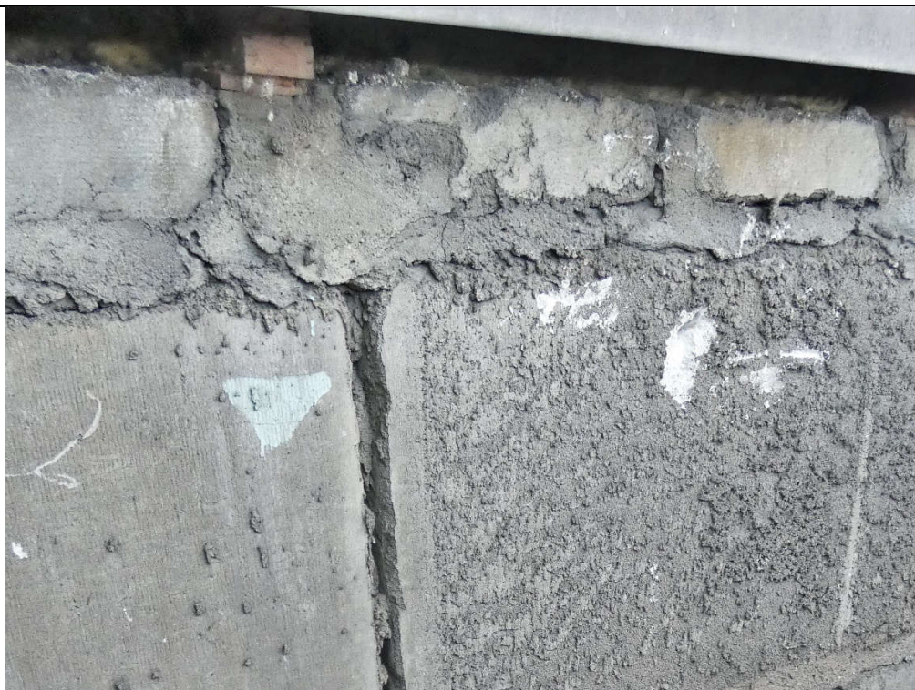
Fot. 10 Przykład zwińczenia ściany uszkodzonymi elementami z betonu komórkowego.
