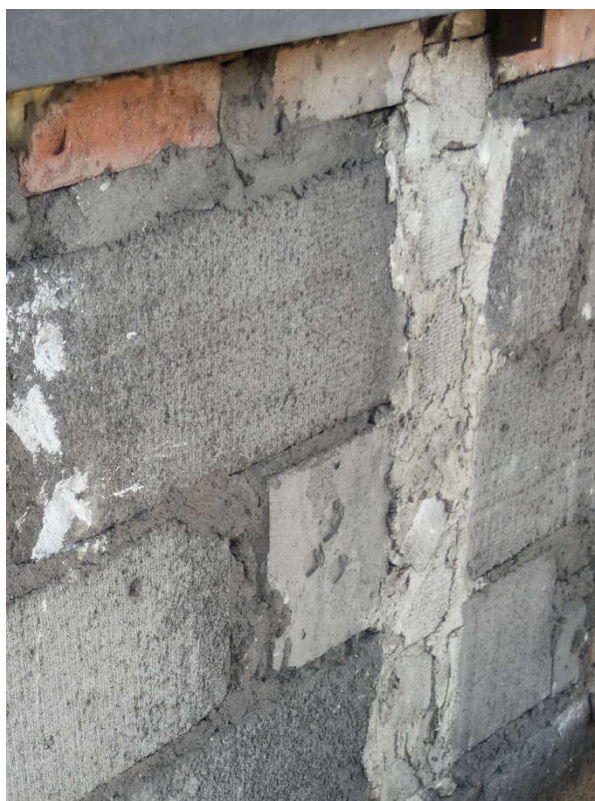
Fot. 13 Widok pionu instalacyjnego zamkniętego zaprawą i gruzem
