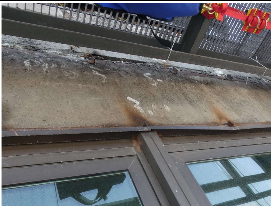
Fot. 86 Kondygnacja 7 (Poziom +28.50) Elewacja Północna – belka w osiach 10-11/I.
