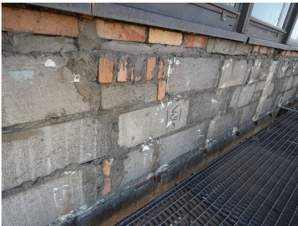
Fot. 5 Przykład ściany murowanej o bardzo niskiej jakości wykonania (ściana z uszkodzonych elementów o zróżnicowanych materiałach i kształtach, z wypełnieniem przerw między elementami zaprawą i gruzem)
