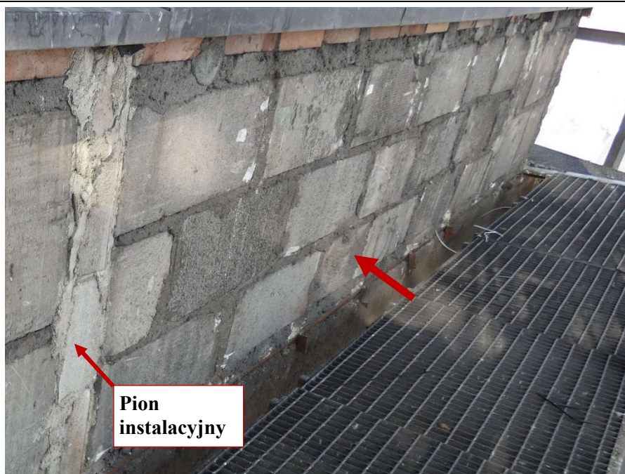
Fot. 19 Kondygnacja 7 (Poziom +28.50) Elewacja Wschodnia – widok ściany murowanej w osiach 14/H-I. Zbyt duże wymiary spoin. Ściana z uszkodzonych elementów murowych 24x60 cm Zwieńczenie ściany z ceramicznych elementów murowych gr. 6,5 cm. Wypełnienie ubytków między elementami zaprawą. Zamknięcie pionu instalacyjnego zaprawą i gruzem.
