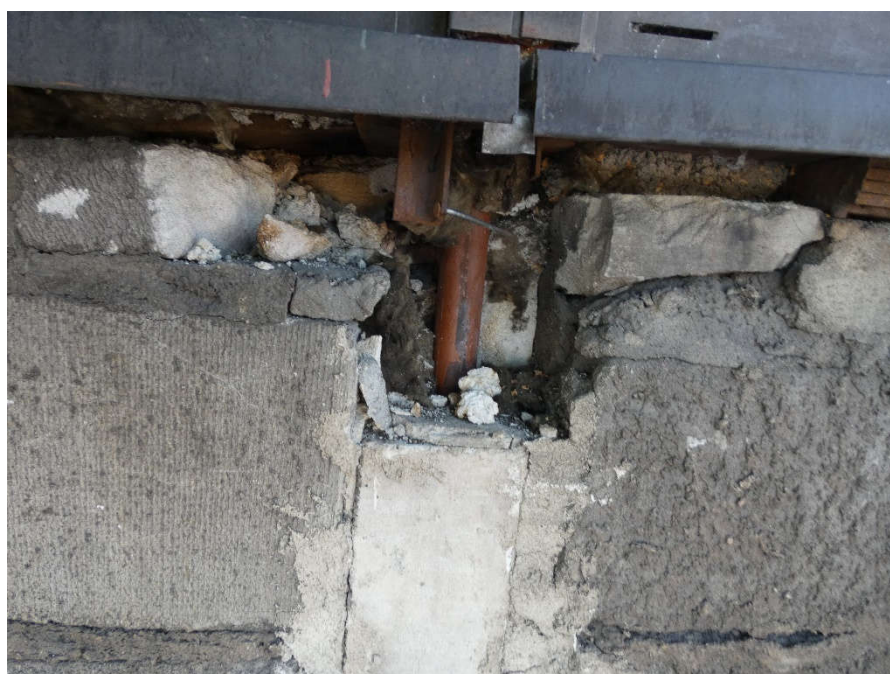
Fot. 34 Kondygnacja 7 (Poziom +28.50) Elewacja Północna – widok ściany murowanej w osiach 10-11/I. Otwarty pion instalacyjny, częściowe zamknięcie elementami murowymi.
