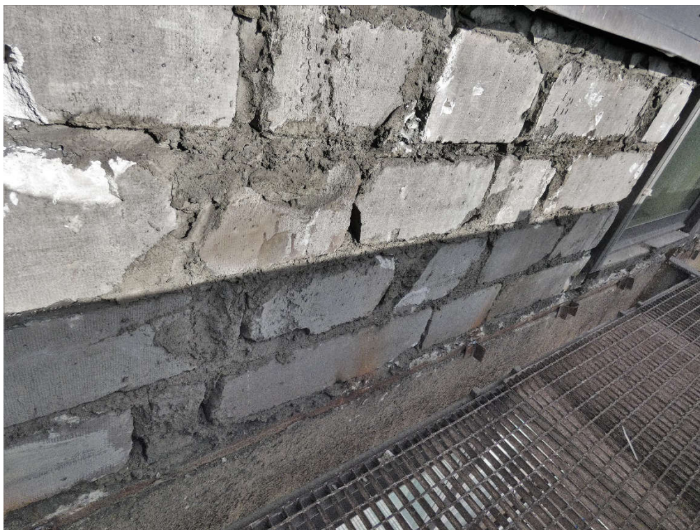
Fot. 4 Przykład ściany murowanej o bardzo niskiej jakości wykonania (ściana z uszkodzonych elementów z betonu komórkowego z wypełnieniem przerw między elementami zaprawą i gruzem)
