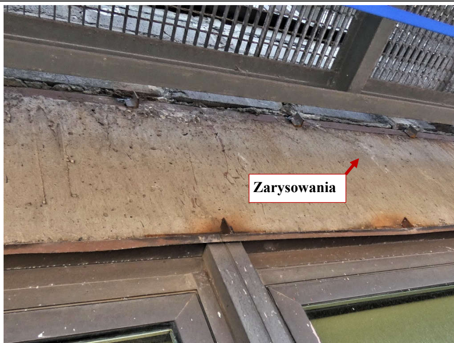
Fot. 97 Kondygnacja 7 (Poziom +28.50) Elewacja Zachodnia – belka w osiach 10/G-H. Zarysowanie belki w przęśle na wysokości miejsca oparcia.
