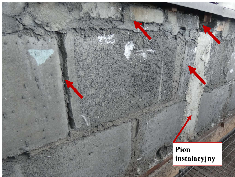
Fot. 40 Kondygnacja 7 (Poziom +28.50) Elewacja Zachodnia – widok ściany murowanej w osiach 10/G-H. Zbyt duże wymiary spoin. Ubytki spoin pionowych. Zwieńczenie ściany z uszkodzonych elementów murowych. Wypełnienie ubytków między elementami i uszkodzonych miejsc zaprawą i gruzem. Otwarty pion instalacyjny, częściowe zamknięcie elementami murowymi, zaprawą i gruzem.
