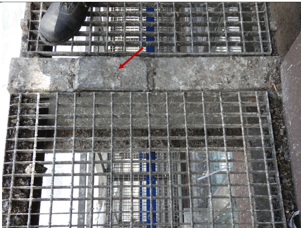
Fot. 127 Pozostałości po drabinie ewakuacyjnej w osi 14/F (widok z góry)
