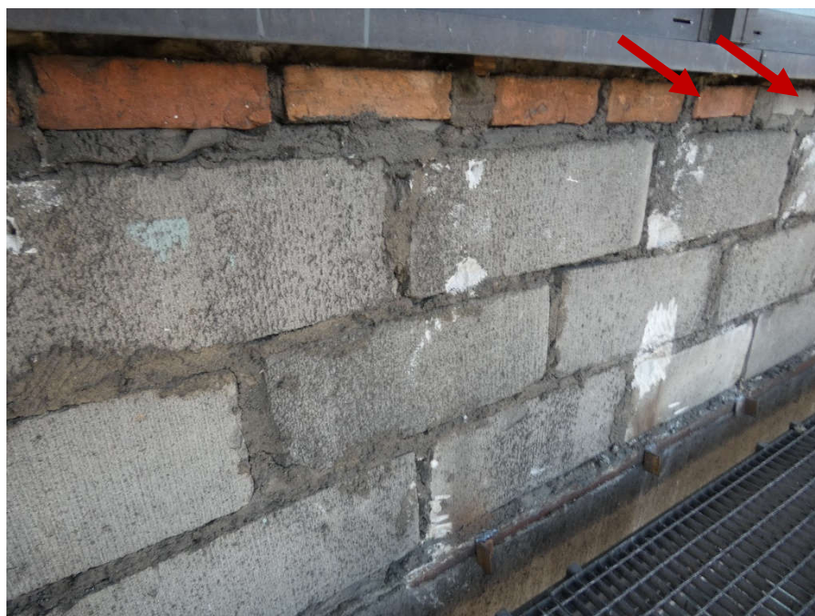
Fot. 30 Kondygnacja 7 (Poziom +28.50) Elewacja Północna – widok ściany murowanej w osiach 11-12/I. Zbyt duże wymiary spoin. zwieńczenie ściany z elementów murowych o zróżnicowanych materiałach i kształtach. Wypełnienie ubytków między elementami zaprawą.
