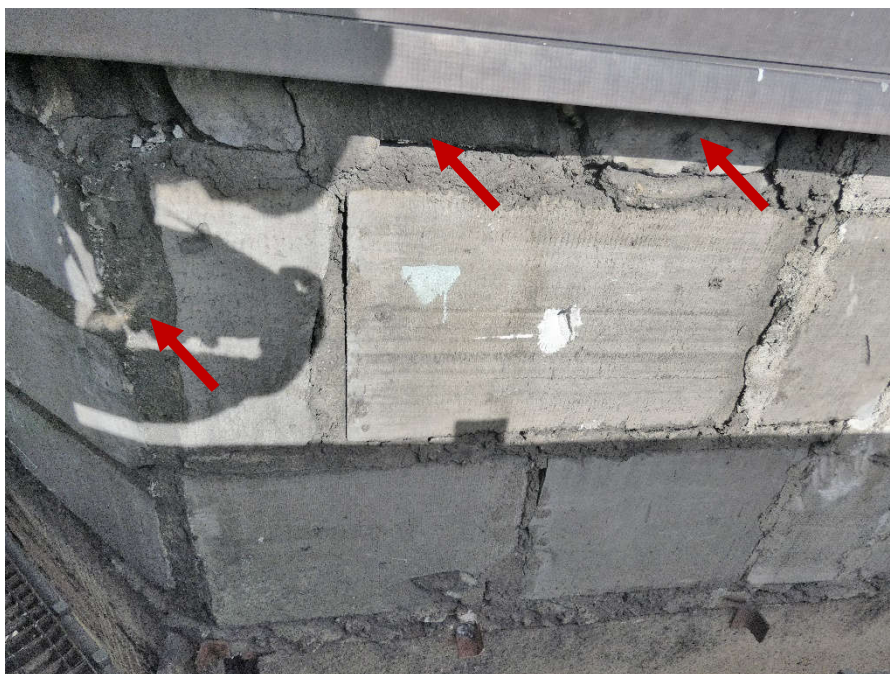
Fot. 50 Kondygnacja 7 (Poziom +28.50) Elewacja Południowa – widok ściany murowanej w osiach 10-11/E. Zbyt duże wymiary spoin. Niewłaściwe przewiązanie elementów w narożu. Zwieńczenie ściany z uszkodzonych elementów murowych. Wypełnienie ubytków między elementami i uszkodzonych miejsc zaprawą.
