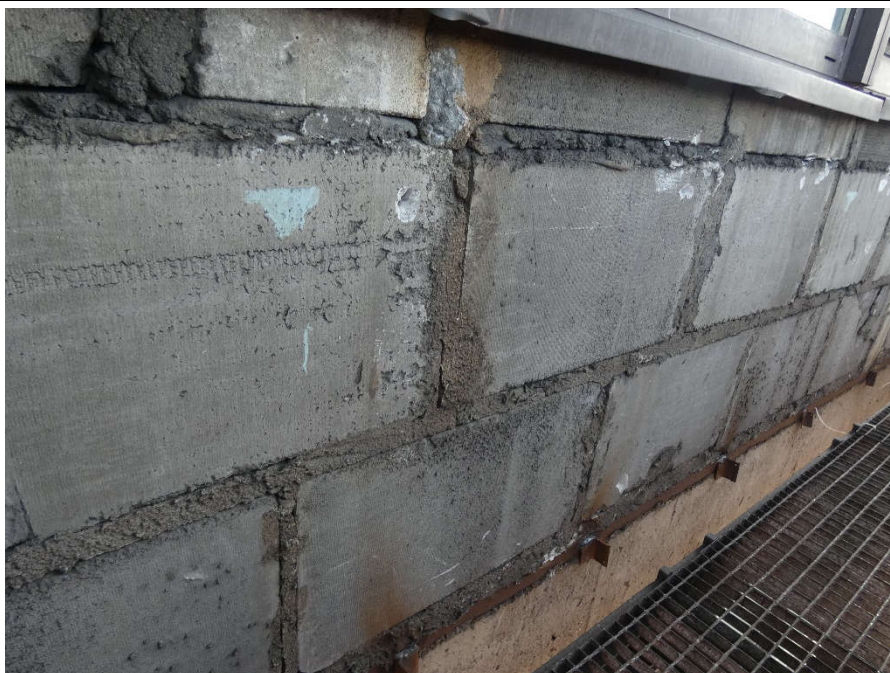
Fot. 47 Kondygnacja 7 (Poziom +28.50) Elewacja Zachodnia – widok ściany murowanej w osiach 10/E-F. Zbyt duże wymiary spoin. Wypełnienie ubytków między elementami zaprawą. Zamknięcie pionu instalacyjnego.
