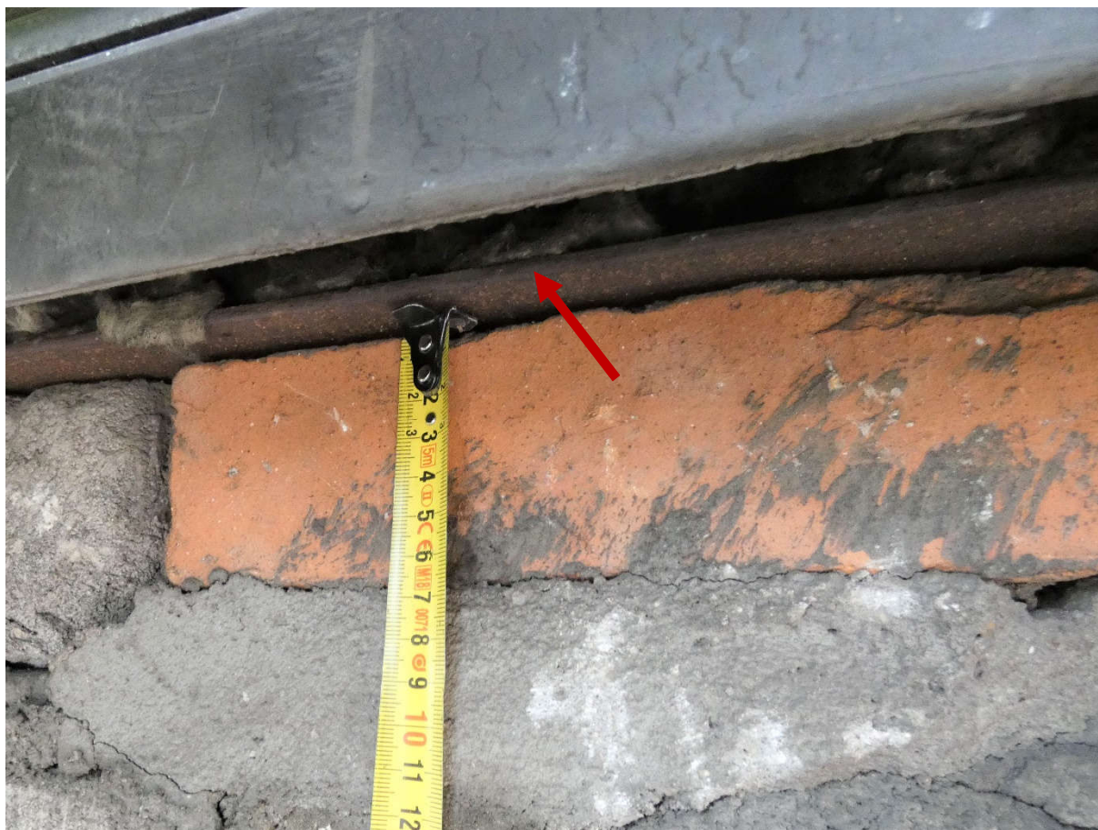
Fot. 7 Widok zwieńczenia ściany z elementów ceramicznych bezpośrednio pod profilem stalowym (brak podlewki)
