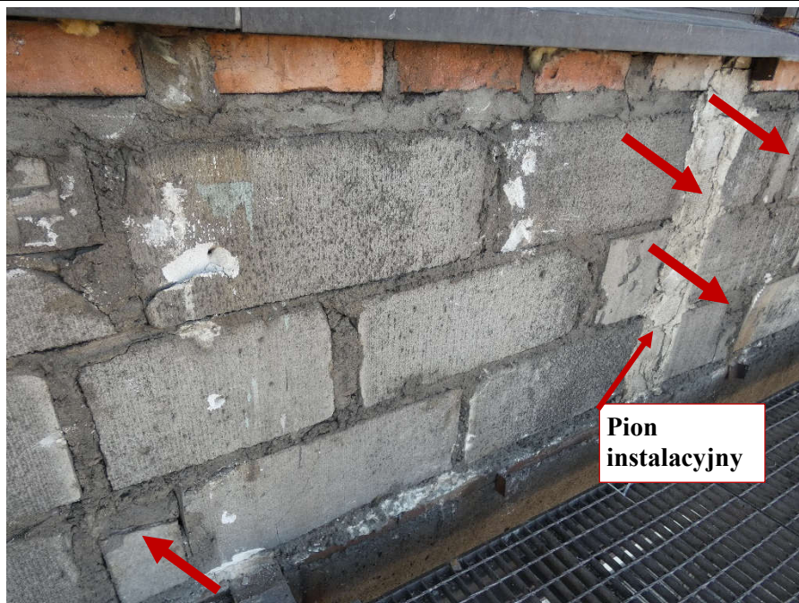
Fot. 29 Kondygnacja 7 (Poziom +28.50) Elewacja Północna – widok ściany murowanej w osiach 11-12/I. Zbyt duże wymiary spoin. Zwieńczenie ściany ceramicznymi elementami murowymi. Wypełnienie ubytków między elementami zaprawą i gruzem. Zamknięcie pionu instalacyjnego zaprawą i gruzem.
