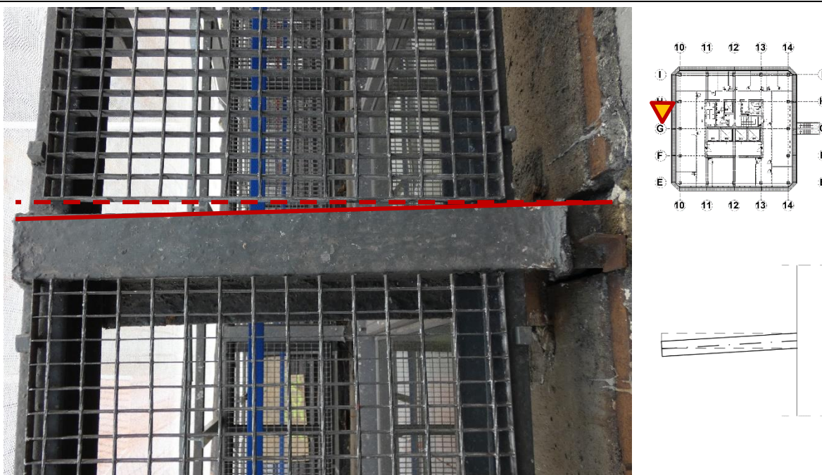
Fot. 150 Kondygnacja 9 (Poziom +35.10) Elewacja Zachodnia – wspornik w osiach 10/H (widok z góry) Przemieszczenie wspornika w kierunku osi G. Brak widocznych uszkodzeń wspornika.
