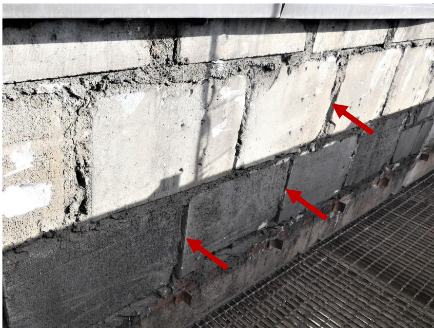
Fot. 55 Kondygnacja 9 (Poziom +35.10) Elewacja Południowa – widok ściany murowanej w osiach 11-12/E. Zbyt duże wymiary spoin. Ubytki spoin pionowych. Wypełnienie ubytków między elementami zaprawą.
