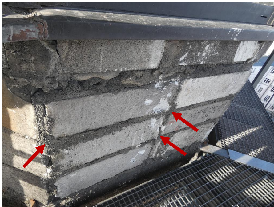
Fot. 20 Kondygnacja 9 (Poziom +35.10) Elewacja Wschodnia – widok ściany murowanej w osiach 14/I. Zbyt duże wymiary spoin. Niewłaściwe przewiązanie elementów. Wykonanie ściany z elementów murowych 18x60 cm. Wypełnienie ubytków między elementami zaprawą i gruzem.
