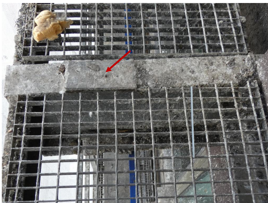
Fot. 124 Pozostałości po drabinie ewakuacyjnej w osi 14/F (widok z góry)
