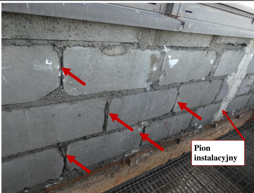
Fot. 41 Kondygnacja 9 (Poziom +35.10) Elewacja Zachodnia – widok ściany murowanej w osiach 10/G-H. Zbyt duże wymiary spoin. Ubytki spoin pionowych. Wypełnienie ubytków między elementami zaprawą. Zamknięcie pionu instalacyjnego.
