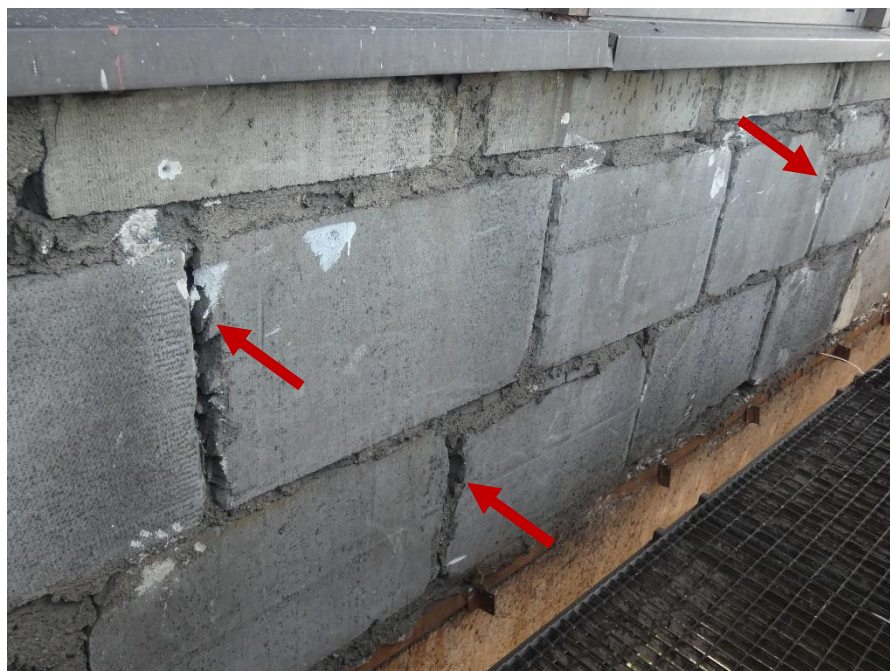
Fot. 47 Kondygnacja 9 (Poziom +35.10) Elewacja Zachodnia – widok ściany murowanej w osiach 10/E-F. Zbyt duże wymiary spoin. Ubytki spoin pionowych. Wykonanie ściany z elementów murowanych o zróżnicowanych kształtach. Wypełnienie ubytków między elementami zaprawą.
