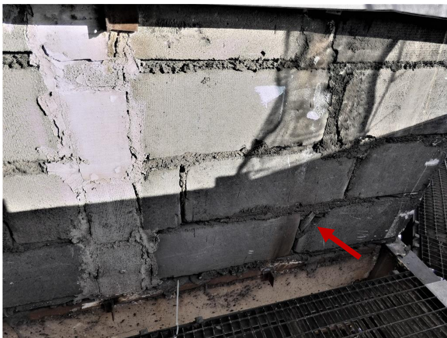
Fot. 63 Kondygnacja 9 (Poziom +35.10) Elewacja Południowa – widok ściany murowanej w osiach 13-14/E. Zbyt duże wymiary spoin. Wykonanie ściany z uszkodzonych elementów murowych. Wypełnienie ubytków między elementami i uszkodzonych miejsc zaprawą i gruzem. Zamknięcie pionu instalacyjnego.
