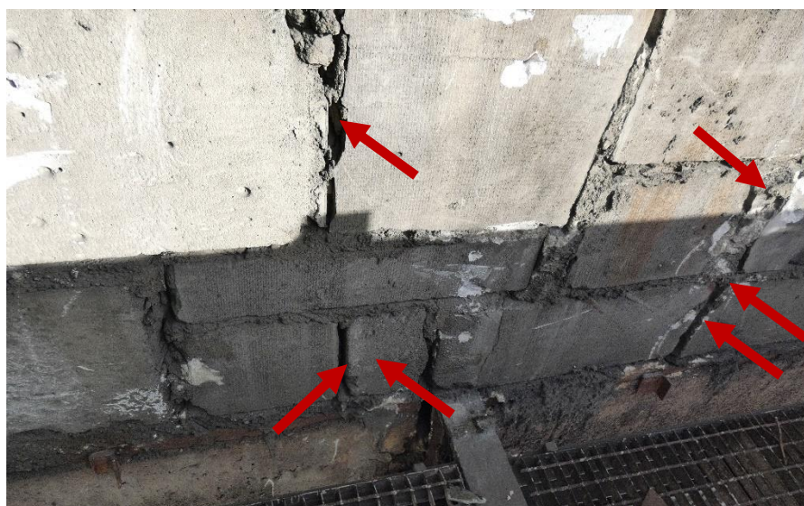
Fot. 57 Kondygnacja 9 (Poziom +35.10) Elewacja Południowa – widok ściany murowanej w osiach 12-13/E. Zbyt duże wymiary spoin. Ubytki spoin pionowych. Niewłaściwe przewiązanie elementów. Wykonanie ściany z elementów murowanych o zróżnicowanych kształtach. Wypełnienie ubytków między elementami zaprawą i gruzem.
