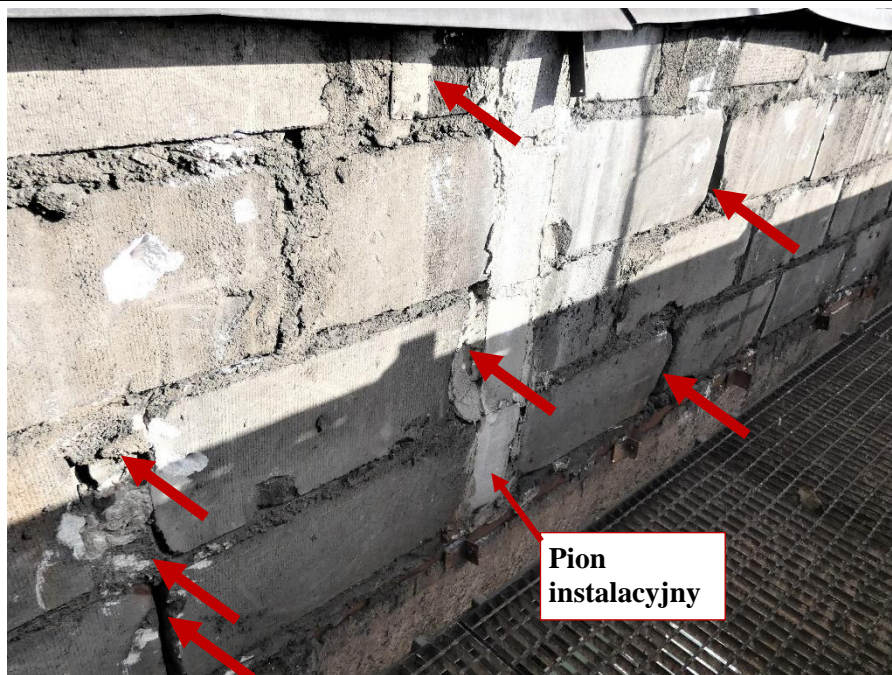
Fot. 58 Kondygnacja 9 (Poziom +35.10) Elewacja Południowa – widok ściany murowanej w osiach 12-13/E. Zbyt duże wymiary spoin. Wykonanie ściany z uszkodzonych elementów murowanych o zróżnicowanych kształtach. Wypełnienie ubytków między elementami i uszkodzonych miejsc zaprawą i gruzem. Zamknięcie pionu instalacyjnego.
