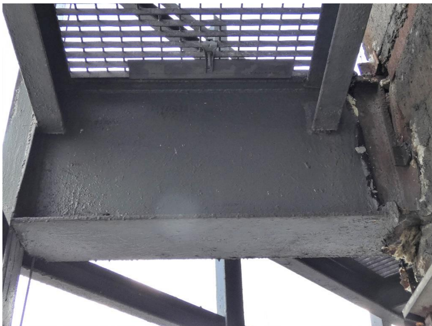
Fot. 125, 126 Kondygnacja 9 (Poziom +35.10) Elewacja Wschodnia – wspornik w osiach 14/E.
