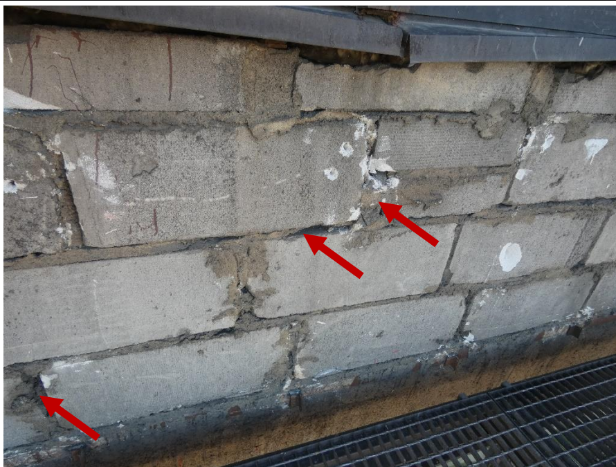
Fot. 25 Kondygnacja 9 (Poziom +35.10) Elewacja Północna – widok ściany murowanej w osiach 12-13/I. Zbyt duże wymiary spoin. Ubytki spoin. Ściana z elementów murowanych o zróżnicowanych kształtach. Wypełnienie ubytków między elementami zaprawą i gruzem.
