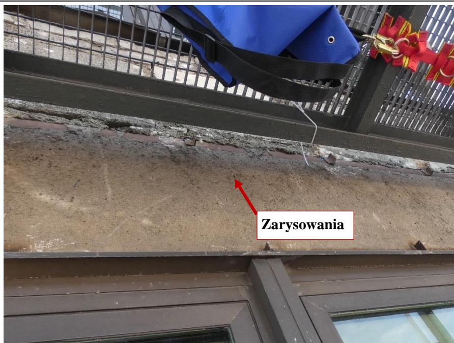
Fot. 86 Kondygnacja 9 (Poziom +35.10) Elewacja Północna – belka w osiach 10-11/I. Zarysowania belki w przęśle na wysokości miejsca oparcia.
