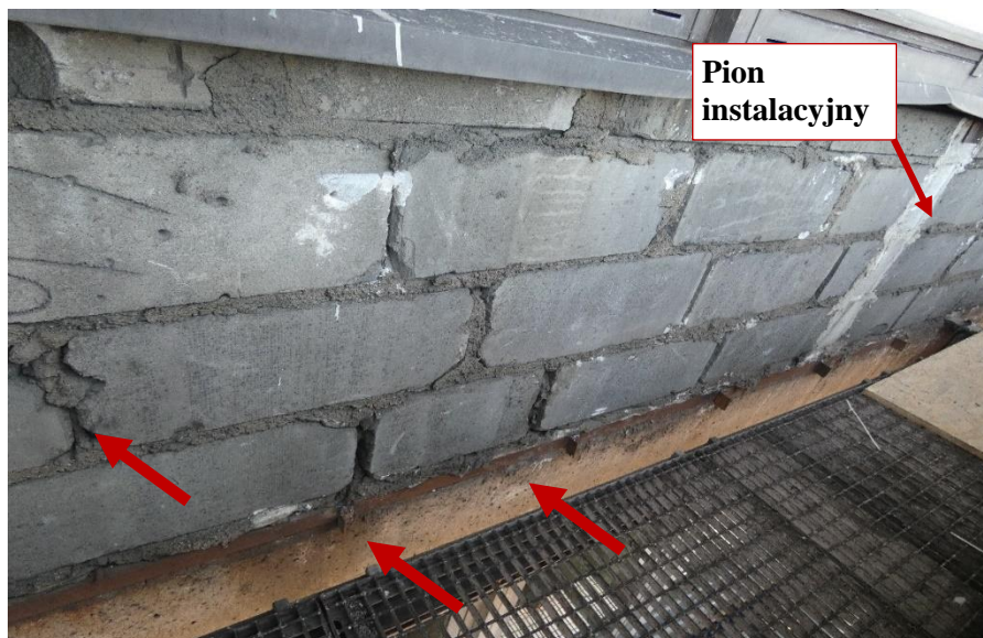
Fot. 44 Kondygnacja 9 (Poziom +35.10) Elewacja Zachodnia – widok ściany murowanej w osiach 10/F-G. Zbyt duże wymiary spoin. Ubytki spoin pionowych. Wypełnienie ubytków między elementami i uszkodzonych miejsc zaprawą. Zamknięcie pionu instalacyjnego.
