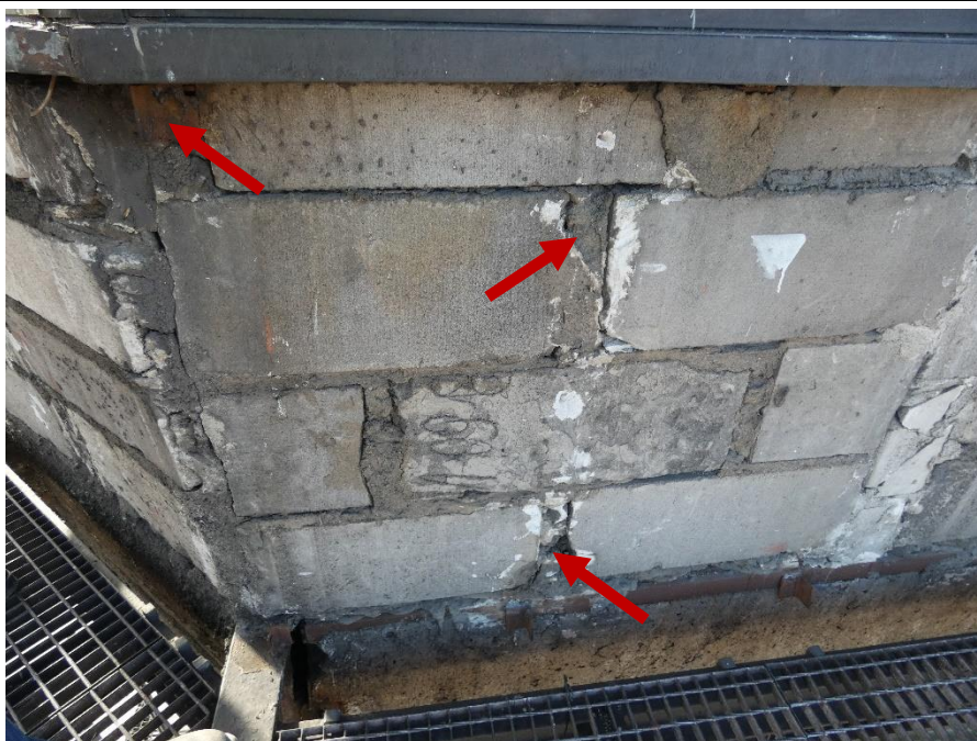
Fot. 21 Kondygnacja 9 (Poziom +35.10) Elewacja Północna – widok ściany murowanej w osiach 13-14/I. Zbyt duże wymiary spoin. Wykonanie ściany z uszkodzonych elementów murowych 24x60 cm. Zwieńczenie ściany elementami murowymi 12x60 cm. Wypełnienie ubytków między elementami zaprawą i gruzem. Zamknięcie pionu instalacyjnego.
