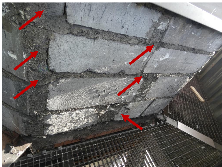
Fot. 49 Kondygnacja 9 (Poziom +35.10) Elewacja Zachodnia – widok ściany murowanej w osiach 10/E. Zbyt duże wymiary spoin. Niewłaściwe przewiązanie elementów. Wypełnienie ubytków między elementami zaprawą i gruzem.
