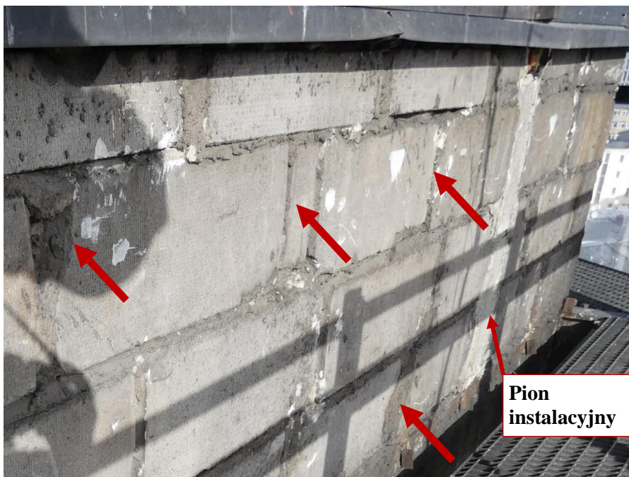
Fot. 18 Kondygnacja 9 (Poziom +35.10) Elewacja Wschodnia – widok ściany murowanej w osiach 14/H-I. Zbyt duże wymiary spoin. Ściana z uszkodzonych elementów murowych. Wypełnienie ubytków między elementami i uszkodzonych miejsc zaprawą i gruzem. Zamknięcie pionu instalacyjnego.
