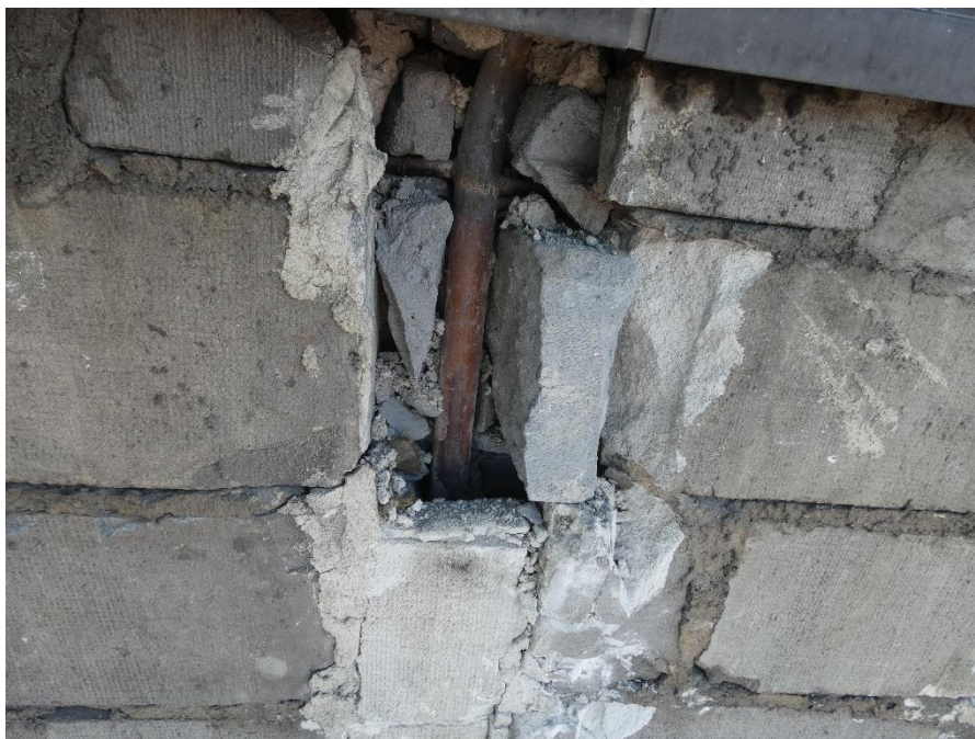
Fot. 30 Kondygnacja 9 (Poziom +35.10) Elewacja Północna – widok ściany murowanej w osiach 11-12/I. Otwarty pion instalacyjny. Częściowe wypełnienie przestrzeni gruzem.
