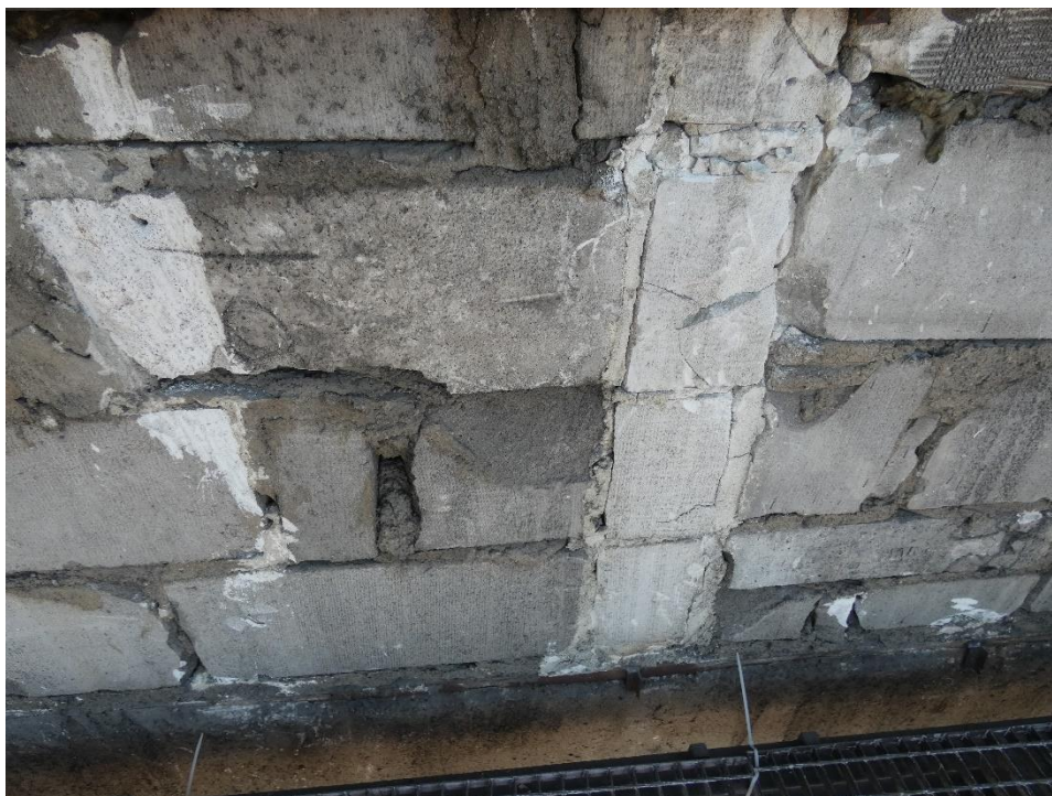
Fot. 3 Przykład ściany murowanej o bardzo niskiej jakości wykonania (ściana z uszkodzonych elementów o zróżnicowanych kształtach z wypełnieniem przerwy między elementami zaprawą i gruzem)
