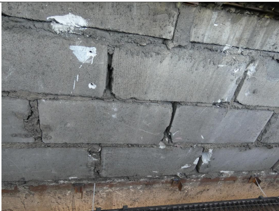
Fot. 2 Przykładowe ubytki zaprawy w spoinach pionowych
