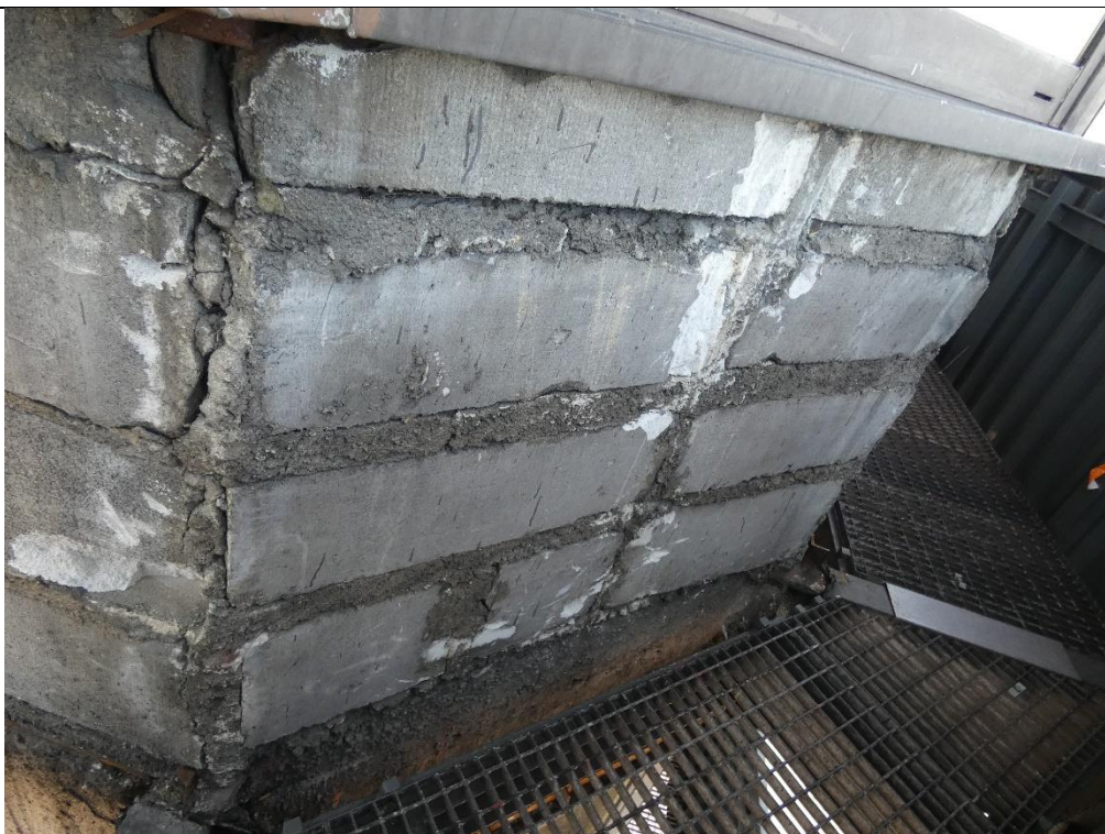
Fot. 6 Przykład ściany murowanej o bardzo niskiej jakości wykonania (niewłaściwe przewiązanie ściany murowanej między elementami i w narożu, wypełnienie ubytków między elementami zaprawą i gruzem)
