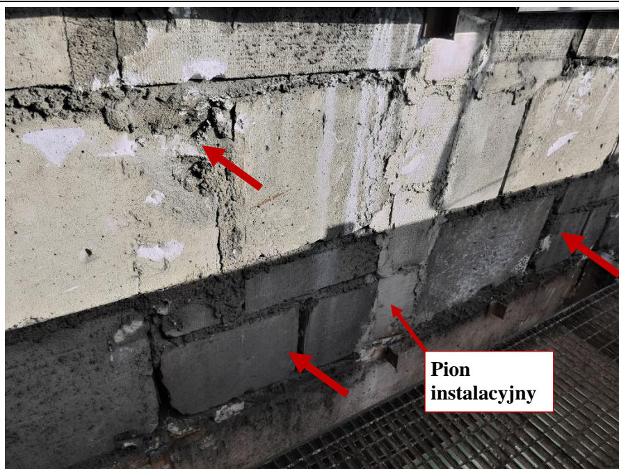
Fot. 56 Kondygnacja 9 (Poziom +35.10) Elewacja Południowa – widok ściany murowanej w osiach 12-13/E. Zbyt duże wymiary spoin. Wykonanie ściany z uszkodzonych elementów murowanych o zróżnicowanych kształtach. Wypełnienie ubytków między elementami i uszkodzonych miejsc zaprawą i gruzem. Zamknięcie pionu instalacyjnego.
