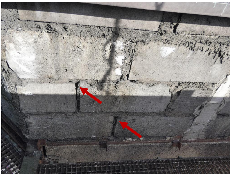
Fot. 50 Kondygnacja 9 (Poziom +35.10) Elewacja Południowa – widok ściany murowanej w osiach 10-11/E. Zbyt duże wymiary spoin. Ubytki spoin pionowych. Wypełnienie ubytków między elementami i uszkodzonych miejsc zaprawą. Zamknięcie pionu instalacyjnego.
