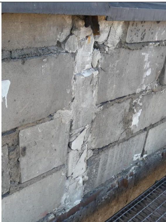
Fot. 11 Widok pionu instalacyjnego zamkniętego zaprawą i gruzem
