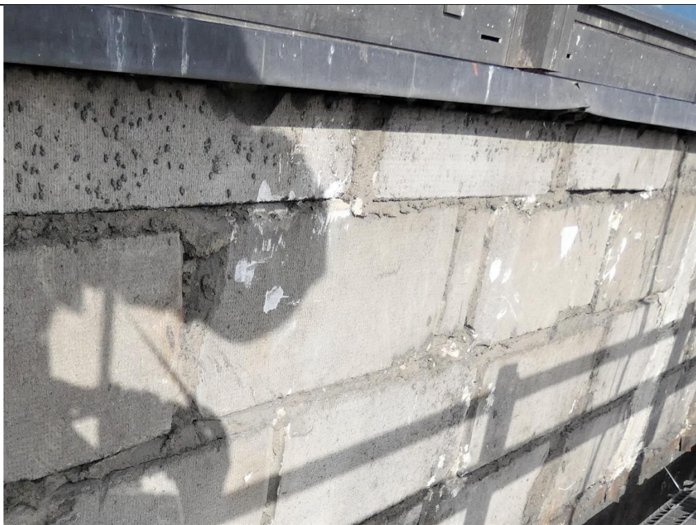
Fot. 8 Widok zwieńczenia ściany z elementów z betonu komórkowego bez podlewki pod profilem stalowym.
