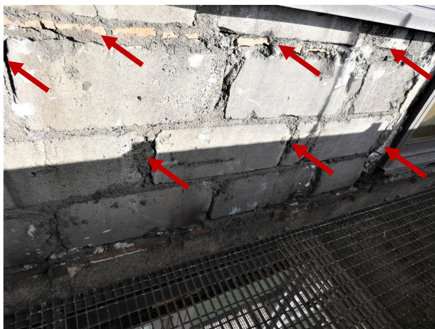
Fot. 59 Kondygnacja 9 (Poziom +35.10) Elewacja Południowa – widok ściany murowanej w osiach 12-13/E. Zbyt duże wymiary spoin. Ubytki spoin pionowych. Wypełnienie ubytków między elementami zaprawą i gruzem.
