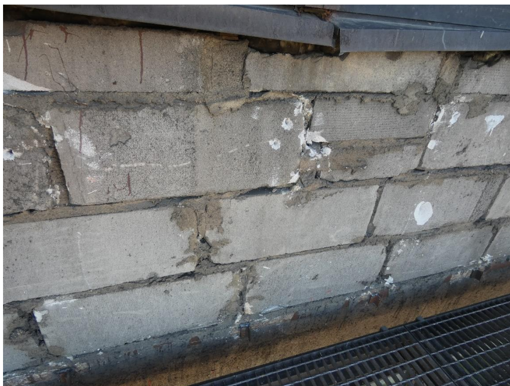
Fot. 5 Przykład ściany murowanej o bardzo niskiej jakości wykonania (ściana z elementów murowanych o zróżnicowanych kształtach, wypełnienie ubytków między elementami zaprawą i gruzem)
