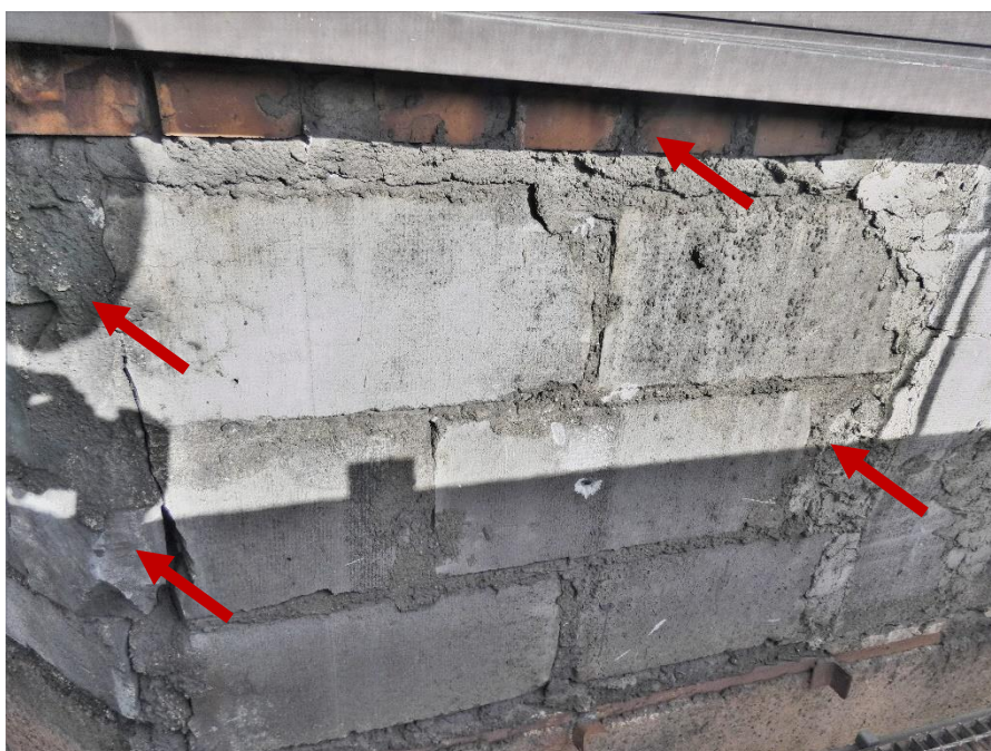
Fot. 47 Kondygnacja 8 (Poziom +31.80) Elewacja Południowa – widok ściany murowanej w osiach 10-11/E. Zbyt duże wymiary spoin. Niewłaściwe przewiązanie elementów. Zwieńczenie ściany z ceramicznych elementów murowych. Wypełnienie ubytków między elementami i uszkodzonych miejsc zaprawą i gruzem.
