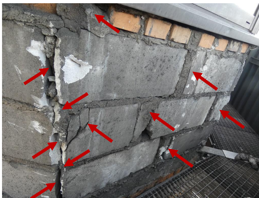
Fot. 35 Kondygnacja 8 (Poziom +31.80) Elewacja Północna – widok ściany murowanej w osiach 10/I. Zbyt duże wymiary spoin. Niewłaściwe przewiązanie elementów. Ubytki spoin pionowych. Ściana z uszkodzonych elementów murowych o zróżnicowanych kształtach. Zwieńczenie ściany z ceramicznych elementów murowych. Wypełnienie ubytków między elementami i uszkodzonych miejsc zaprawą i gruzem.
