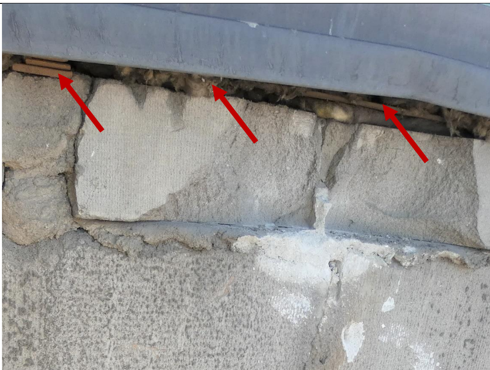
Fot. 7 Widok zwieńczenia ściany uszkodzonymi elementami z betonu komórkowego z podkładkami stalowymi i izolacją termiczną pod profilem stalowym (bez podlewki)
