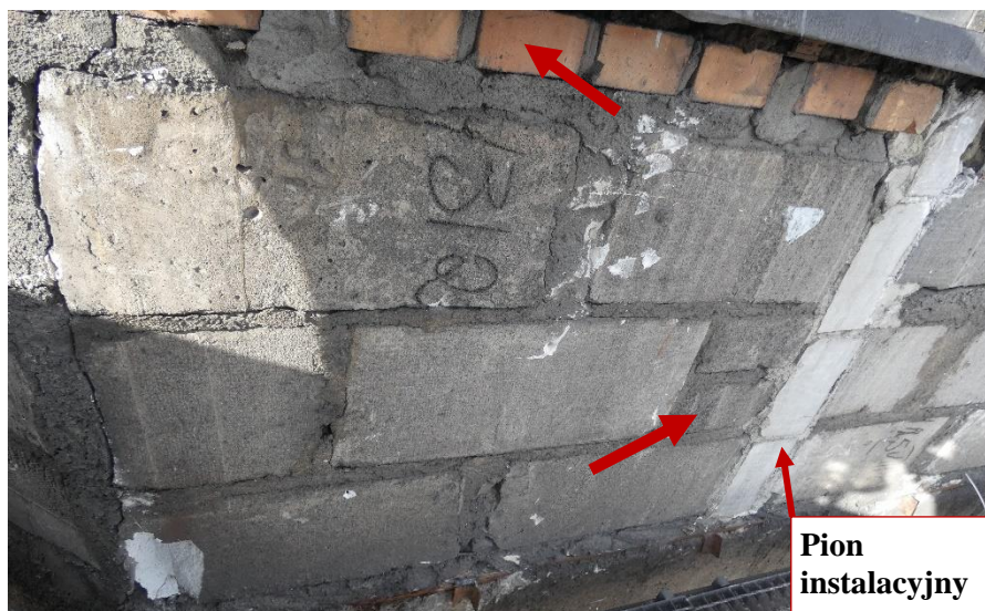
Fot. 14 Kondygnacja 8 (Poziom +31.80) Elewacja Wschodnia – widok ściany murowanej w osiach 14/E-F. Zbyt duże wymiary spoin. Ściana z elementów murowanych o zróżnicowanych kształtach. Zwieńczenie ściany ceramicznymi elementami murowymi. Wypełnienie ubytków między elementami zaprawą. Zamknięcie pionu instalacyjnego.
