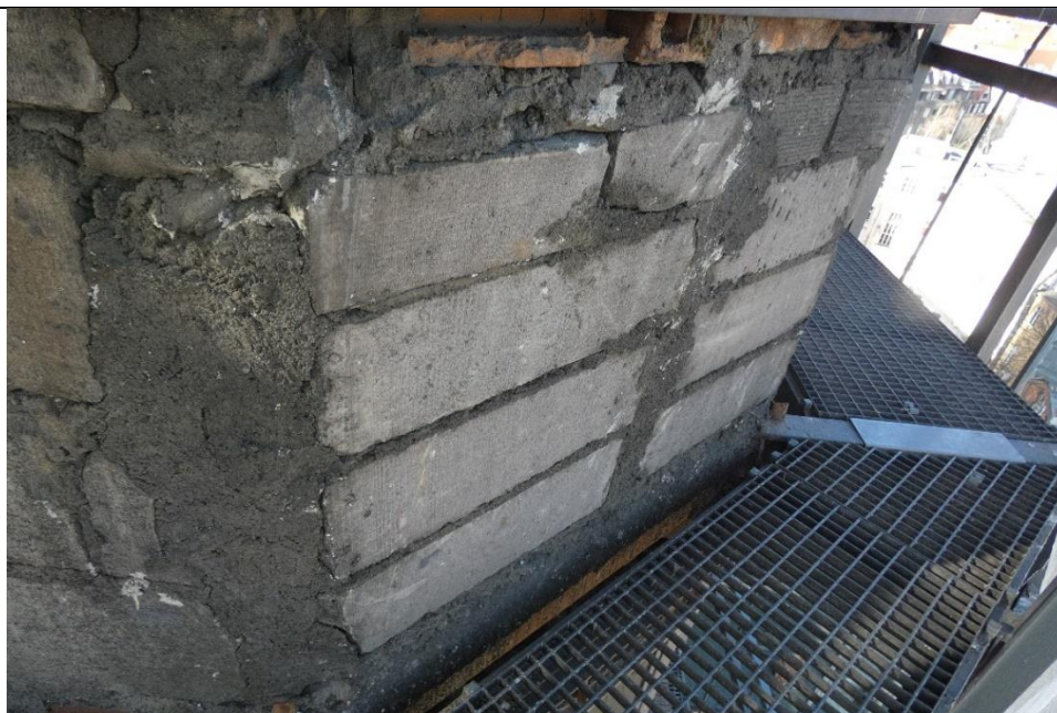
Fot. 6 Przykład ściany murowanej o bardzo niskiej jakości wykonania (niewłaściwe przewiązanie ściany murowanej między elementami i w narożu, wypełnienie ubytków oraz zwieńczenie ściany zaprawą i gruzem)
