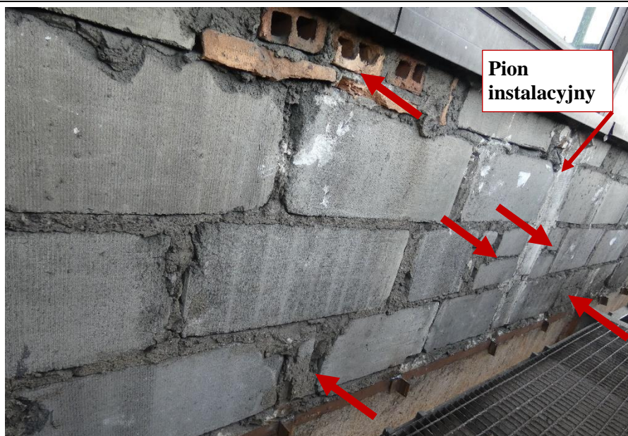
Fot. 42 Kondygnacja 8 (Poziom +31.80) Elewacja Zachodnia – widok ściany murowanej w osiach 10/F-G. Zbyt duże wymiary spoin. Ściana z elementów murowanych o zróżnicowanych kształtach. Zwieńczenie ściany elementami murowymi i gruzem. Wypełnienie ubytków między elementami i uszkodzonych miejsc zaprawą i gruzem. Zamknięcie pionu instalacyjnego.
