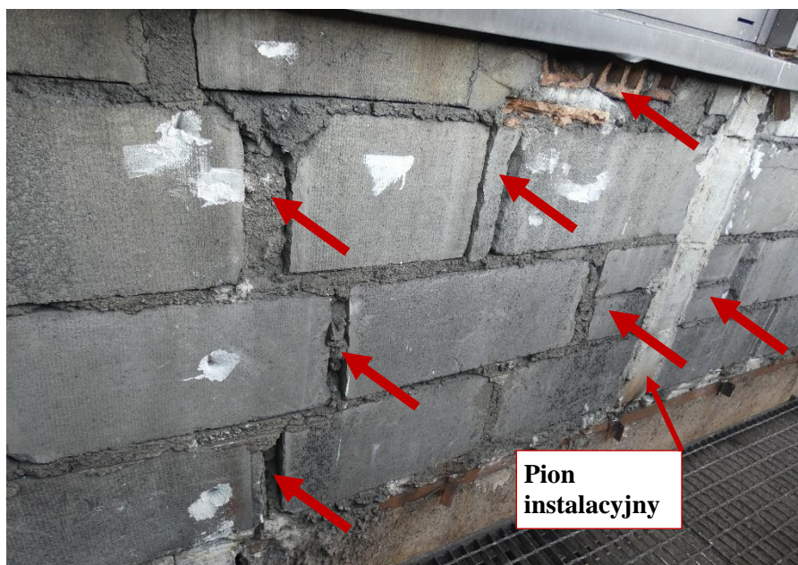
Fot. 41 Kondygnacja 8 (Poziom +31.80) Elewacja Zachodnia – widok ściany murowanej w osiach 10/F-G. Zbyt duże wymiary spoin. Ubytki spoin pionowych. Ściana z elementów murowych o zróżnicowanych kształtach. Zwieńczenie ściany elementami murowymi i gruzem. Wypełnienie ubytków między elementami i uszkodzonych miejsc zaprawą i gruzem. Zamknięcie pionu instalacyjnego.
