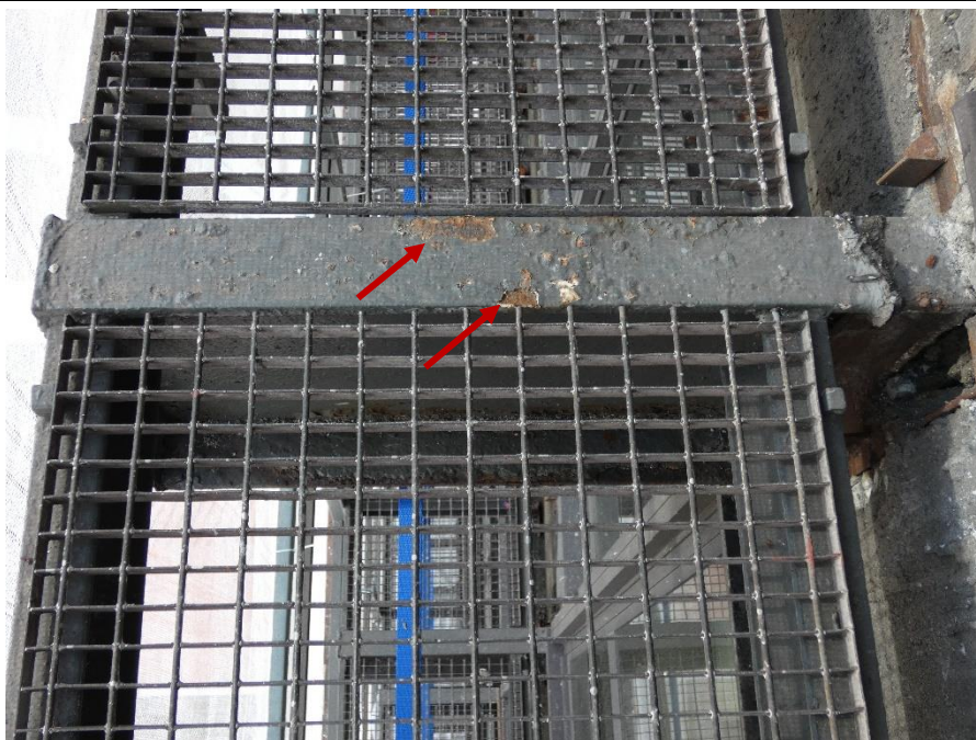
Fot. 154 Kondygnacja 8 (Poziom +31.80) Elewacja Południowa– wspornik w osiach 11/E (widok z góry) Ślady korozji pasa górnego. Brak widocznych uszkodzeń wspornika.
