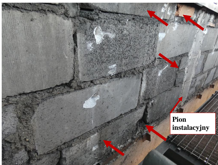
Fot. 43 Kondygnacja 8 (Poziom +31.80) Elewacja Zachodnia – widok ściany murowanej w osiach 10/F-G. Zbyt duże wymiary spoin. Spękania elementów murowanych. Ściana z uszkodzonych elementów murowanych o zróżnicowanych kształtach. Zwieńczenie ściany elementami o zróżnicowanych materiałach i kształtach. Wypełnienie ubytków między elementami zaprawą i gruzem. Zamknięcie pionu instalacyjnego.
