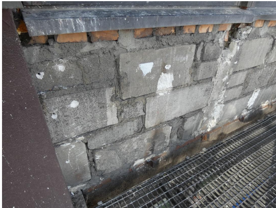
Fot. 3 Przykład ściany murowanej bardzo niskiej jakości wykonania (ściana z uszkodzonych elementów murowych o zróżnicowanych kształtach, wypełnienie ubytków między elementami zaprawą i gruzem. Zwieńczenie ściany ceramicznymi elementami murowymi. Otwarty pion instalacyjny)
