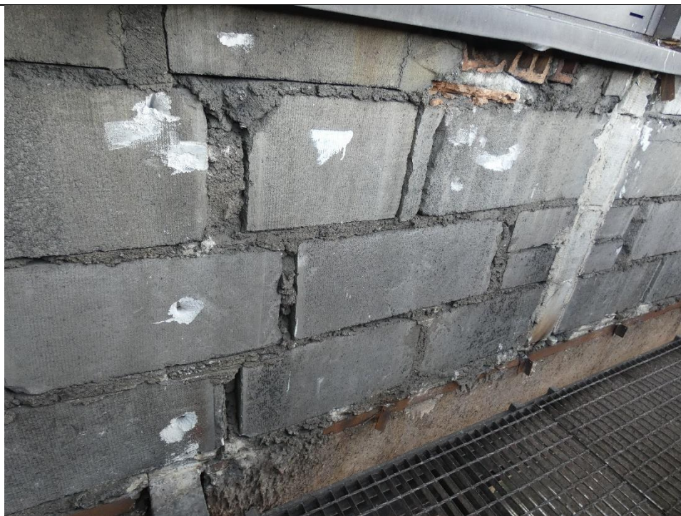
Fot. 2 Przykład ściany murowanej o bardzo niskiej jakości wykonania (ściana z uszkodzonych elementów murowych z betonu komórkowego z ubytkami w spoinach pionowych oraz wypełnieniem przerw między elementami zaprawą i gruzem)
