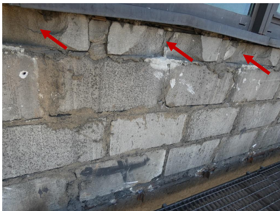
Fot. 27 Kondygnacja 8 (Poziom +31.80) Elewacja Północna – widok ściany murowanej w osiach 12-13/I. Zbyt duże wymiary spoin. Zwieńczenie ściany z uszkodzonych elementów murowanych. Wypełnienie ubytków między elementami i uszkodzonych miejsc zaprawą.
