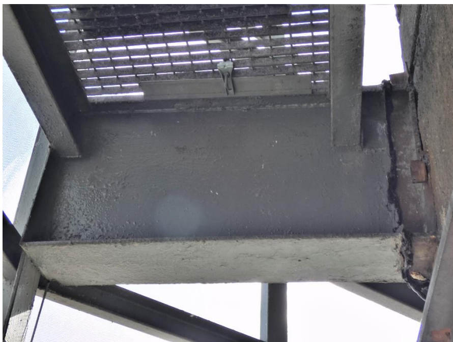
Fot. 118, 119 Kondygnacja 8 (Poziom +31.80) Elewacja Wschodnia – wspornik w osiach 14/E.
