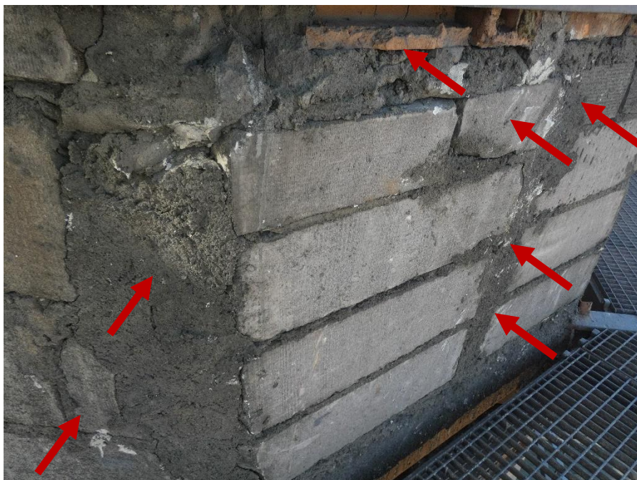
Fot. 22 Kondygnacja 8 (Poziom +31.80) Elewacja Wschodnia – widok ściany murowanej w osiach 14/I. Zbyt duże wymiary spoin. Niewłaściwe przewiązanie elementów. Wykonanie ściany z uszkodzonych elementów murowych 18x60 cm. Zwieńczenie ściany oraz wypełnienie ubytków między elementami zaprawą i gruzem.
