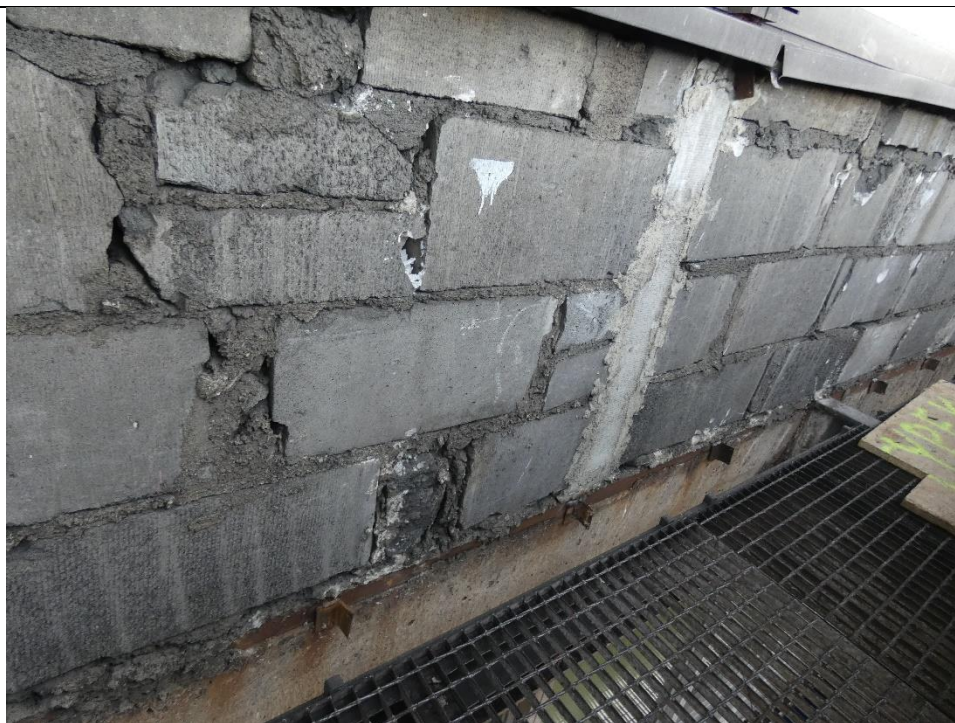
Fot. 4 Przykład ściany murowanej o bardzo niskiej jakości wykonania (ściana z uszkodzonych elementów murowych o zróżnicowanych kształtach, wypełnienie ubytków między elementami zaprawą i gruzem)
