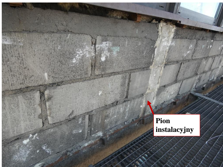
Fot. 22 Kondygnacja 6 (Poziom +25.20) Elewacja Północna – widok ściany murowanej w osiach 12-13/I. Zbyt duże wymiary spoin. Wypełnienie ubytków między elementami zaprawą. Zwieńczenie ściany podlewką. Zamknięcie pionu instalacyjnego.
