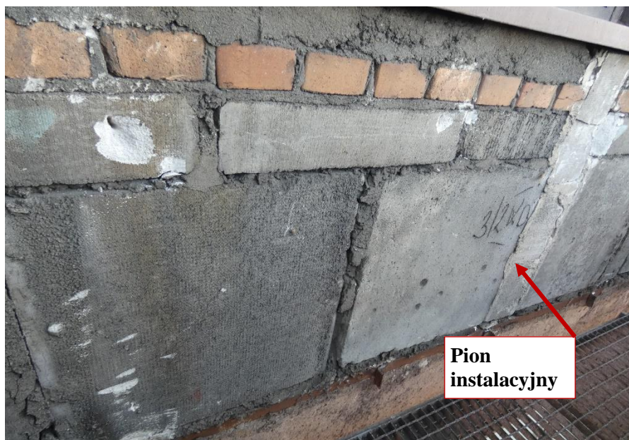
Fot. 38 Kondygnacja 6 (Poziom +25.20) Elewacja Zachodnia – widok ściany murowanej w osiach 10/F-G. Zbyt duże wymiary spoin. Ściana z elementów murowanych o zróżnicowanych materiałach i kształtach. Wypełnienie ubytków między elementami zaprawą. Zwieńczenie ściany podlewką. Zamknięcie pionu instalacyjnego.
