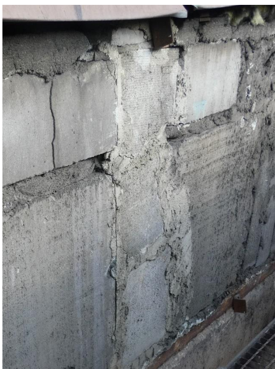
Fot. 10 Widok zamkniętego pionu instalacyjnego
