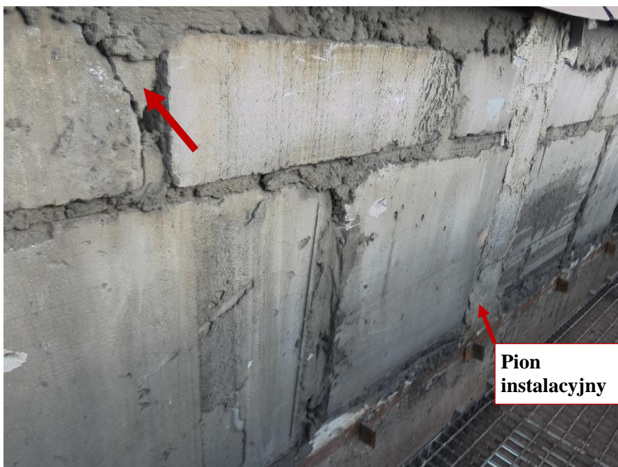
Fot. 52 Kondygnacja 6 (Poziom +25.20) Elewacja Południowa – widok ściany murowanej w osiach 12-13/E. Zbyt duże wymiary spoin. Wykonanie ściany z uszkodzonych elementów murowych o zróżnicowanych kształtach. Wypełnienie ubytków między elementami i uszkodzonych miejsc zaprawą i gruzem. Zwieńczenie ściany podławką. Zamknięcie pionu instalacyjnego.
