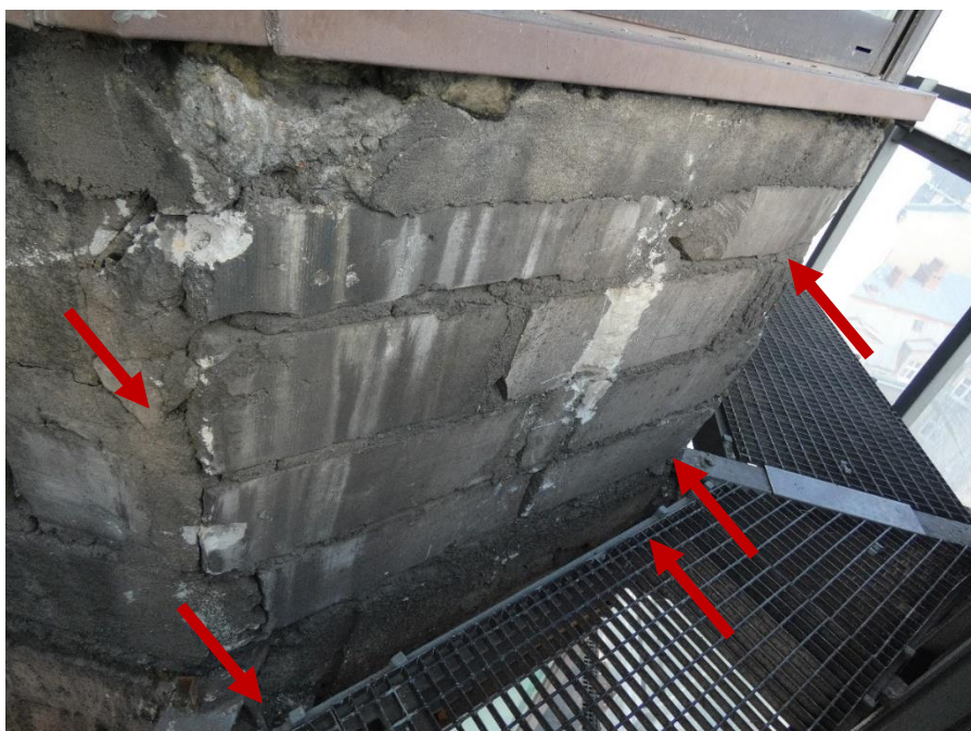
Fot. 58 Kondygnacja 6 (Poziom +25.20) Elewacja Południowa – widok ściany murowanej w osiach 14/E. Zbyt duże wymiary spoin. Niewłaściwe przewiązanie elementów. Wykonanie ściany z uszkodzonych elementów murowych. Wypełnienie ubytków między elementami zaprawą i gruzem. Zwieńczenie ściany podlewką.
