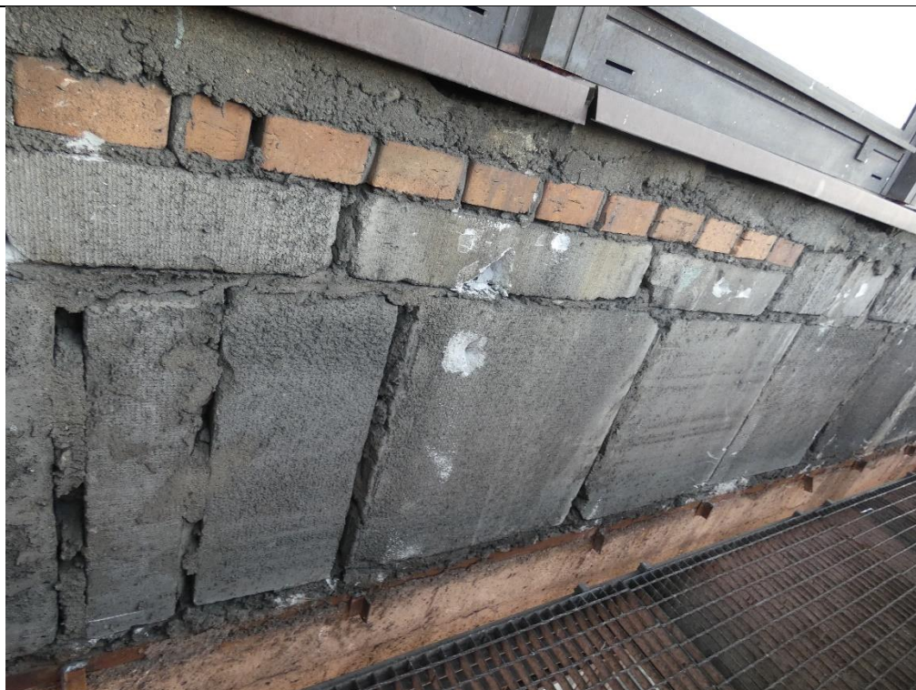
Fot. 2 Przykład ściany murowanej o bardzo niskiej jakości wykonania (ściana z elementów murowych o zróżnicowanych materiałach i kształtach, o złym kierunku układania elementów murowych oraz z ubytkami spoin pionowych.)
