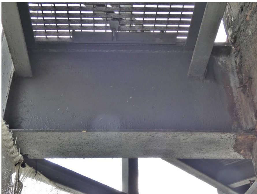
Fot. 122, 123 Kondygnacja 6 (Poziom +25.20) Elewacja Wschodnia – wspornik w osiach 14/E.
