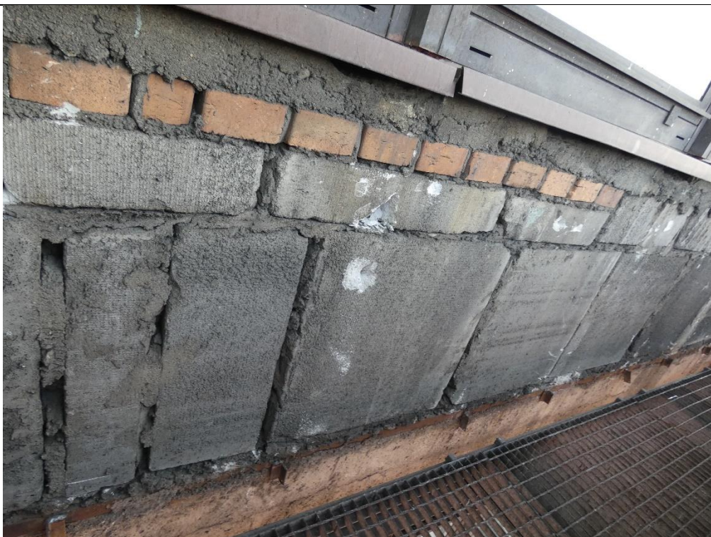
Fot. 2 Przykład ściany murowanej o bardzo niskiej jakości wykonania (ściana z elementów murowych o zróżnicowanych materiałach i kształtach, o złym kierunku układania elementów murowych oraz z ubytkami spoin pionowych.)
