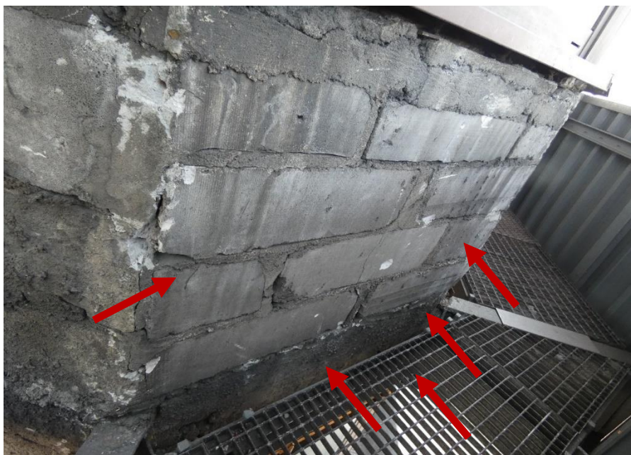
Fot. 30 Kondygnacja 6 (Poziom +25.20) Elewacja Północna – widok ściany murowanej w osiach 10/I. Zbyt duże wymiary spoin. Niewłaściwe przewiązanie elementów w narożu. Zarysowania elementów murowych. Ściana z elementów murowych 18x60 cm. Wypełnienie ubytków między elementami zaprawą i gruzem. Zwieńczenie ściany podlewką.
