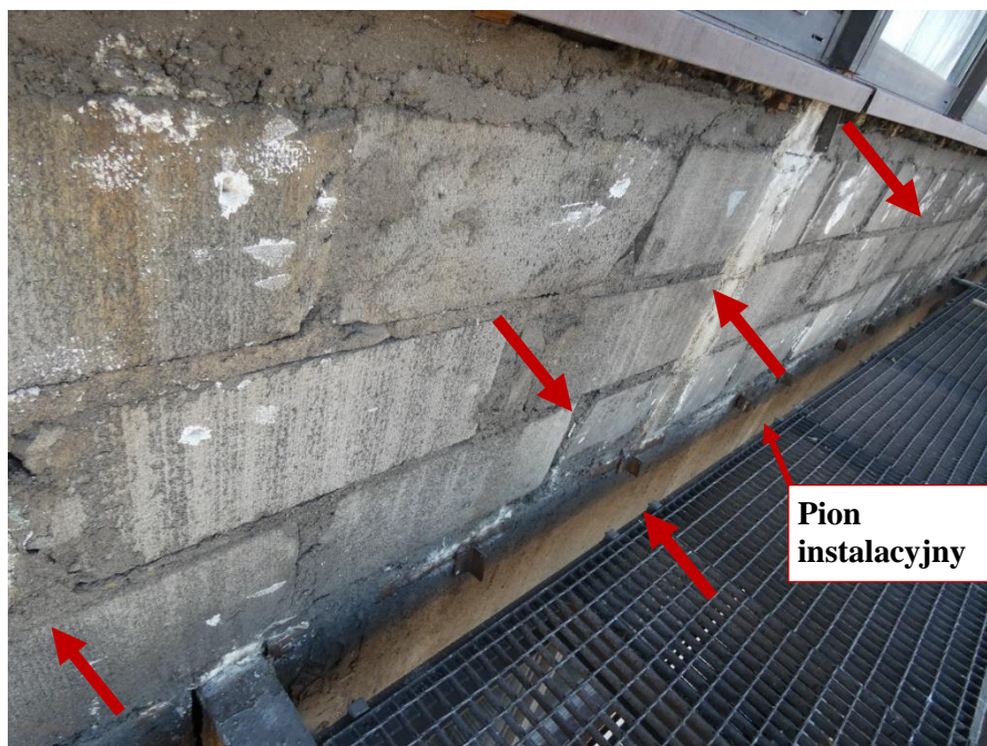
Fot. 21 Kondygnacja 6 (Poziom +25.20) Elewacja Północna – widok ściany murowanej w osiach 12-13/I. Zbyt duże wymiary spoin. Wypełnienie ubytków między elementami i uszkodzonych miejsc zaprawą i gruzem. Zwieńczenie ściany podlewką. Zamknięcie pionu instalacyjnego.
