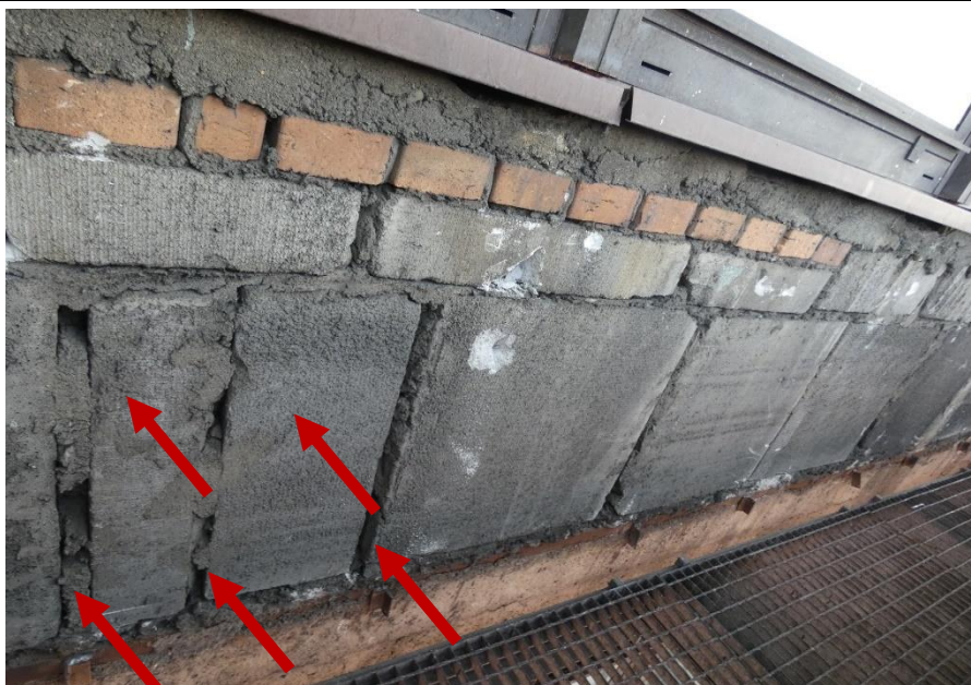
Fot. 39 Kondygnacja 6 (Poziom +25.20) Elewacja Zachodnia – widok ściany murowanej w osiach 10/F-G. Zbyt duże wymiary spoin. Ubytki spoin pionowych. Ściana z elementów murowanych o zróżnicowanych materiałach i kształtach. Niewłaściwy kierunek układania elementów. Wypełnienie ubytków między elementami zaprawą. Zwieńczenie ściany podlewką.
