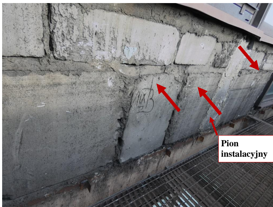
Fot. 48 Kondygnacja 6 (Poziom +25.20) Elewacja Południowa – widok ściany murowanej w osiach 10-11/E. Zbyt duże wymiary spoin. Niewłaściwe przewiązanie elementów. Wykonanie ściany z elementów murowych o zróżnicowanych kształtach. Niewłaściwy kierunek układania elementów. Wypełnienie ubytków między elementami zaprawą. Zwieńczenie ściany podławką. Zamknięcie pionu instalacyjnego.
