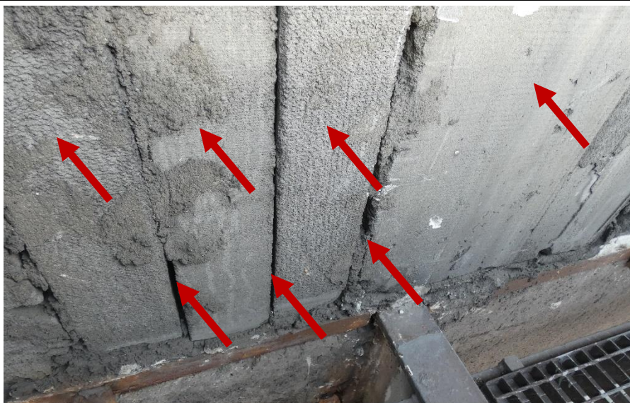
Fot. 51 Kondygnacja 6 (Poziom +25.20) Elewacja Południowa – widok ściany murowanej w osiach 12-13/E. Zbyt duże wymiary spoin. Ubytki spoin pionowych. Wykonanie ściany z elementów murowych o zróżnicowanych kształtach. Niewłaściwy kierunek układania elementów.
