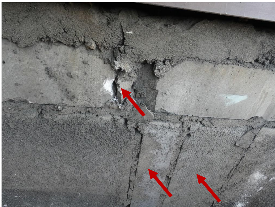
Fot. 40 Kondygnacja 6 (Poziom +25.20) Elewacja Zachodnia – widok ściany murowanej w osiach 10/F-G. Zbyt duże wymiary spoin. Ściana z uszkodzonych elementów murowanych o zróżnicowanych kształtach. Niewłaściwy kierunek układania elementów. Wypełnienie ubytków między elementami zaprawą i gruzem. Zwieńczenie ściany podlewką.
