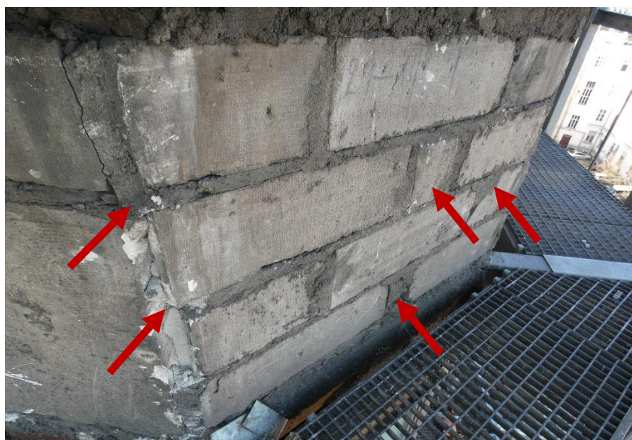
Fot. 18 Kondygnacja 6 (Poziom +25.20) Elewacja Wschodnia – widok ściany murowanej w osiach 14/I. Zbyt duże wymiary spoin. Niewłaściwe przewiązanie elementów w narożu. Wykonanie ściany z elementów murowych 18x60 cm. Wypełnienie ubytków między elementami zaprawą i gruzem. Zwieńczenie ściany podławką.
