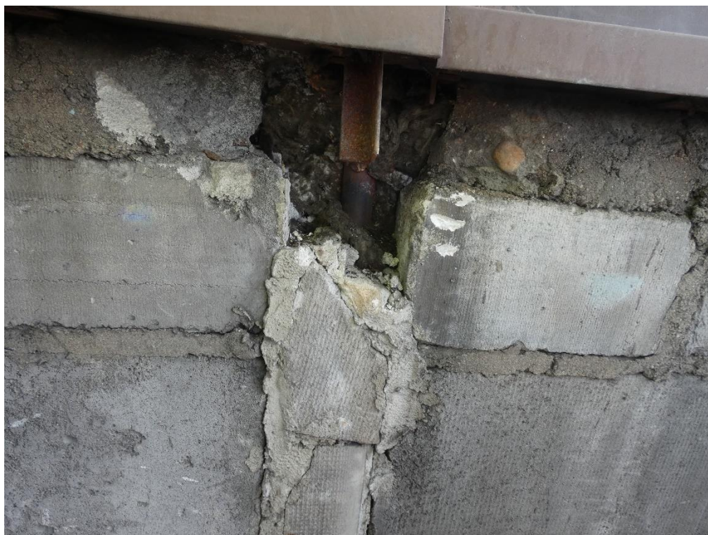
Fot. 8 Widok otwartego pionu instalacyjnego, częściowe zamknięcie zaprawą i gruzem
