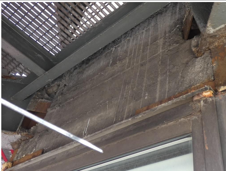
Fot. 98 Kondygnacja 6 (Poziom +25.20) Elewacja Zachodnia – belka w osiach 10/E.
