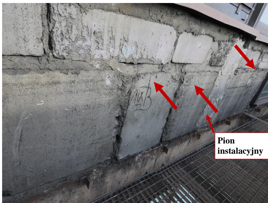
Fot. 48 Kondygnacja 6 (Poziom +25.20) Elewacja Południowa – widok ściany murowanej w osiach 10-11/E. Zbyt duże wymiary spoin. Niewłaściwe przewiązanie elementów. Wykonanie ściany z elementów murowych o zróżnicowanych kształtach. Niewłaściwy kierunek układania elementów. Wypełnienie ubytków między elementami zaprawą. Zwieńczenie ściany podławką. Zamknięcie pionu instalacyjnego.
