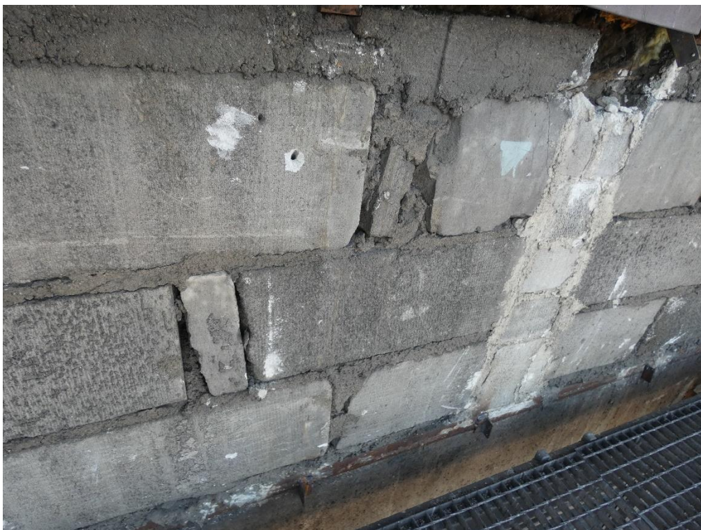
Fot. 3 Przykład ściany murowanej o bardzo niskiej jakości wykonania (ściana z uszkodzonych elementów murowych z wypełnieniem ubytków między elementami zaprawą i gruzem)
