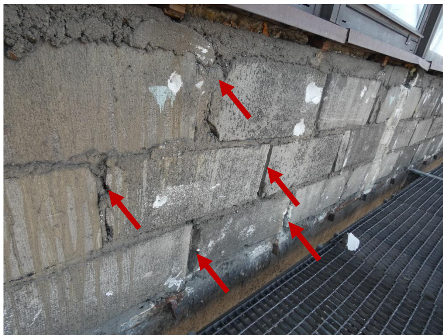
Fot. 24 Kondygnacja 6 (Poziom +25.20) Elewacja Północna – widok ściany murowanej w osiach 11-12/I. Zbyt duże wymiary spoin. Ubytki spoin pionowych. Ściana z uszkodzonymi elementami murowymi. Wypełnienie ubytków między elementami i uszkodzonych miejsc zaprawą i gruzem. Zwieńczenie ściany podlewką.
