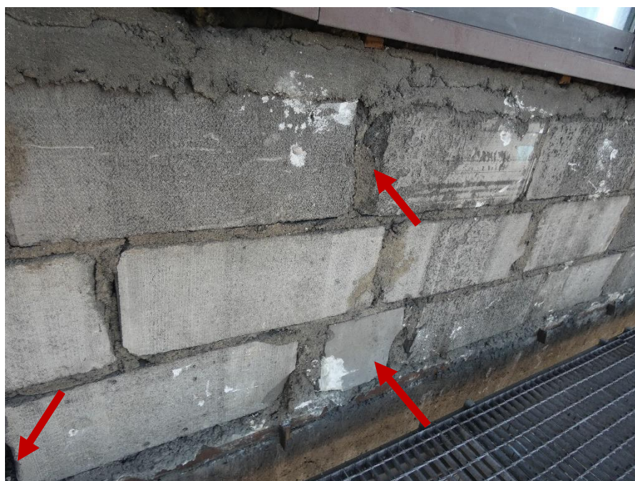
Fot. 28 Kondygnacja 6 (Poziom +25.20) Elewacja Północna – widok ściany murowanej w osiach 10-11/I. Zbyt duże wymiary spoin. Ubytki spoin pionowych. Wypełnienie ubytków między elementami i uszkodzonych miejsc zaprawą i gruzem. Zwieńczenie ściany podlewką.
