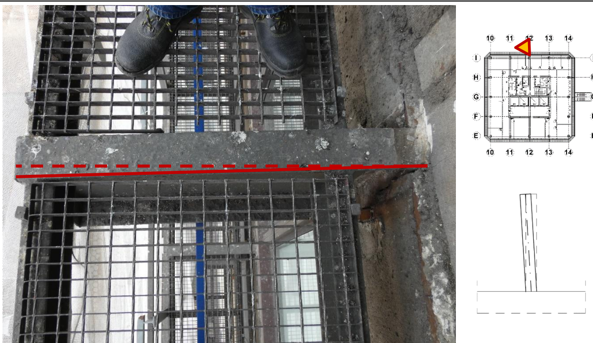
Fot. 139 Kondygnacja 6 (Poziom +25.20) Elewacja Północna – wspornik w osiach 12/I (widok z góry) Przemieszczenia wspornika w kierunku osi 11. Brak widocznych uszkodzeń wspornika.
