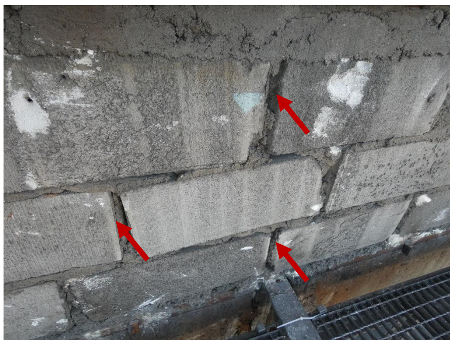
Fot. 26 Kondygnacja 6 (Poziom +25.20) Elewacja Północna – widok ściany murowanej w osiach 10-11/I. Zbyt duże wymiary spoin. Ubytki spoin pionowych. Zwieńczenie ściany podlewką.
