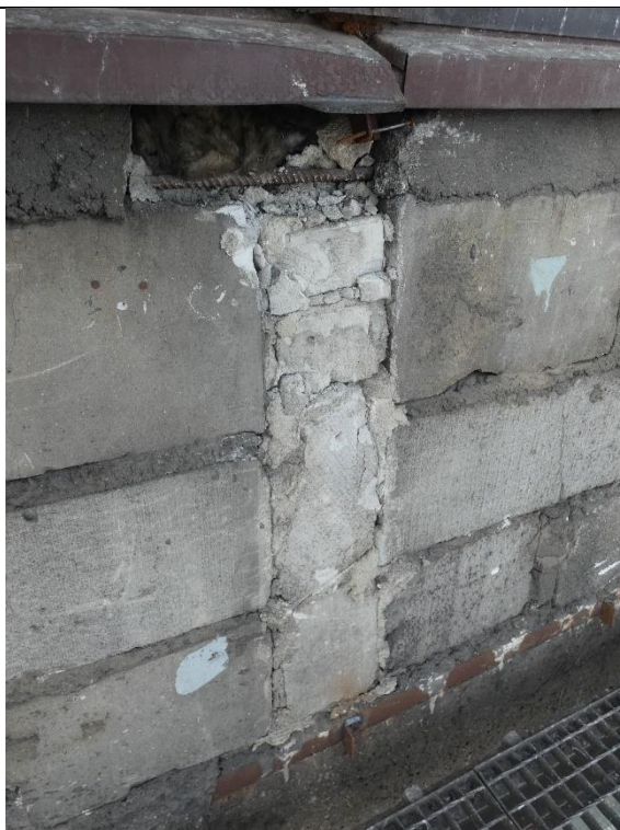
Fot. 9 Widok pionu instalacyjnego zamkniętego zaprawą i gruzem
