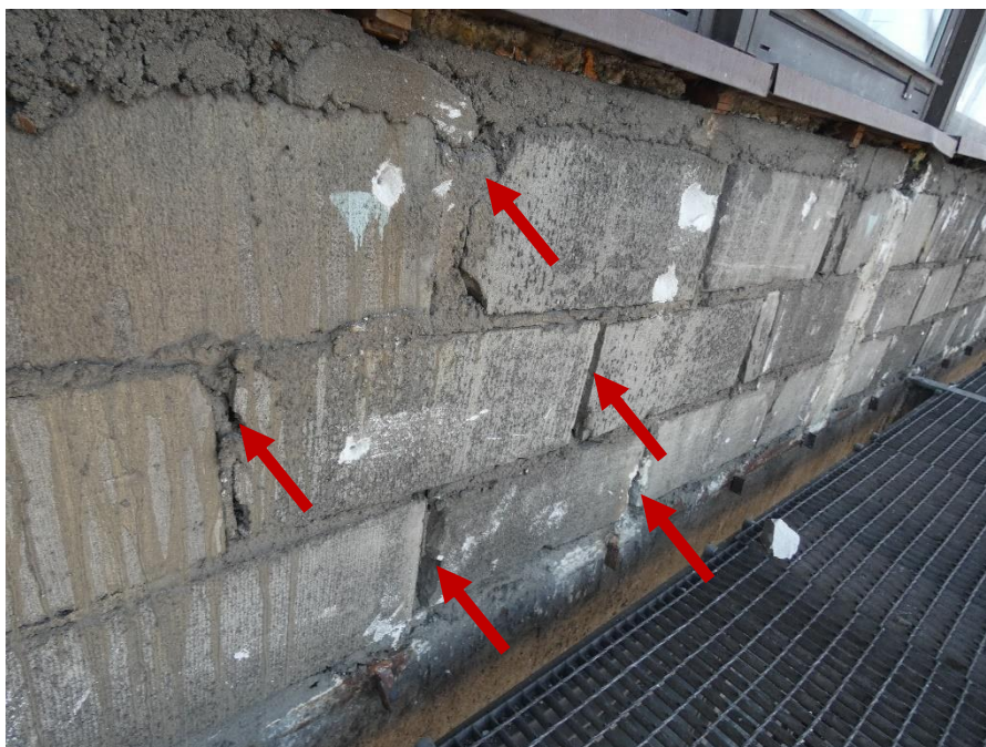
Fot. 24 Kondygnacja 6 (Poziom +25.20) Elewacja Północna – widok ściany murowanej w osiach 11-12/I. Zbyt duże wymiary spoin. Ubytki spoin pionowych. Ściana z uszkodzonymi elementami murowymi. Wypełnienie ubytków między elementami i uszkodzonych miejsc zaprawą i gruzem. Zwieńczenie ściany podlewką.
