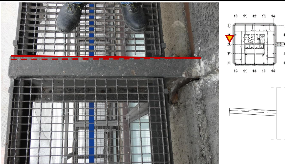
Fot. 149 Kondygnacja 6 (Poziom +25.20) Elewacja Zachodnia– wspornik w osiach 10/H (widok z góry) Przemieszczenie wspornika w kierunku osi I. Brak widocznych uszkodzeń wspornika.
