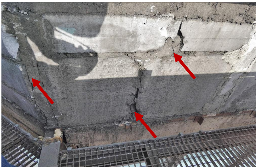
Fot. 46 Kondygnacja 6 (Poziom +25.20) Elewacja Południowa – widok ściany murowanej w osiach 10-11/E. Zbyt duże wymiary spoin. Niewłaściwe przewiązanie elementów w narożu. Ubytki spoin pionowych. Ściana z uszkodzonych elementów murowych o zróżnicowanych kształtach (24x60, 60x60 cm). Wypełnienie ubytków między elementami i uszkodzonych miejsc zaprawą i gruzem. Zwieńczenie ściany podlewką.
