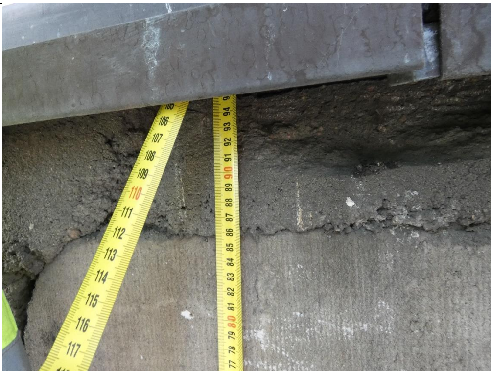
Fot. 4 Widok zwieńczenia ściany podławką wyrównującą gr. 9 cm pod profilem stalowym
