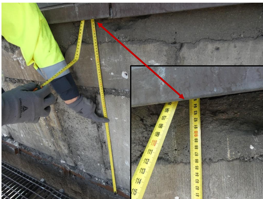
Fot. 16 Kondygnacja 6 (Poziom +25.20) Elewacja Wschodnia – widok ściany murowanej w osiach 14/H-I. Wysokość ściany murowanej ~95 cm. Grubość podlewki między belką żelbetową a ścianą ~5 cm. Grubość podlewki pod profilem stalowym ~9 cm.
