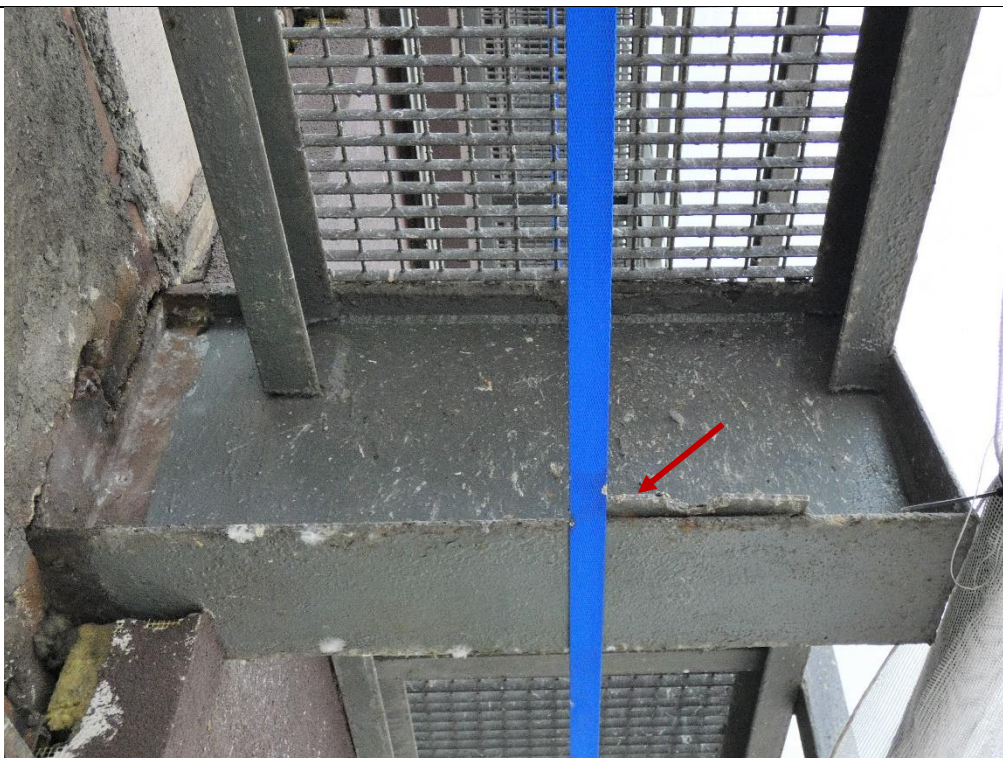
Fot. 120 Pozostałości po drabinie ewakuacyjnej w osi 14/F (widok z dołu)
