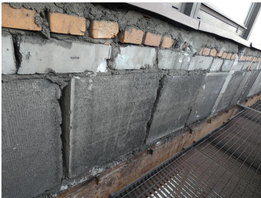
Fot. 1 Przykładowe ubytki zaprawy w spoinach pionowych
