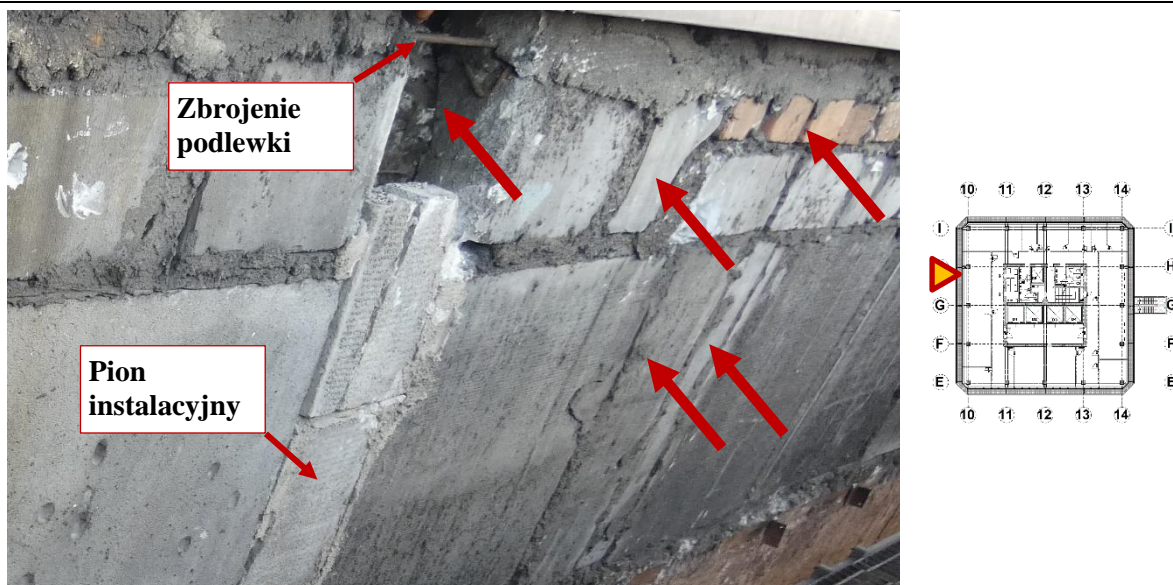
Fot. 35 Kondygnacja 6 (Poziom +25.20) Elewacja Zachodnia – widok ściany murowanej w osiach 10/G-H. Zbyt duże wymiary spoin. Ściana z uszkodzonych elementów murowanych o zróżnicowanych materiałach i kształtach. Niewłaściwy kierunek układania elementów. Wypełnienie ubytków między elementami i uszkodzonych miejsc zaprawą i gruzem. Zwieńczenie ściany podławką. Otwarty pion instalacyjny, częściowe zamknięcie elementami murowymi, zaprawą i gruzem.
