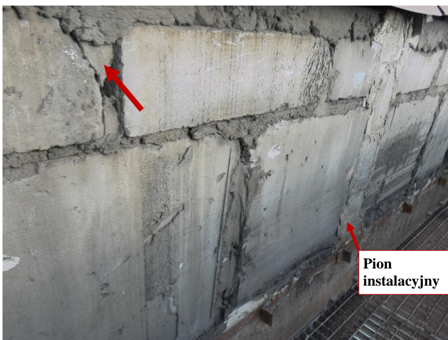
Fot. 52 Kondygnacja 6 (Poziom +25.20) Elewacja Południowa – widok ściany murowanej w osiach 12-13/E. Zbyt duże wymiary spoin. Wykonanie ściany z uszkodzonych elementów murowych o zróżnicowanych kształtach. Wypełnienie ubytków między elementami i uszkodzonych miejsc zaprawą i gruzem. Zwieńczenie ściany podławką. Zamknięcie pionu instalacyjnego.
