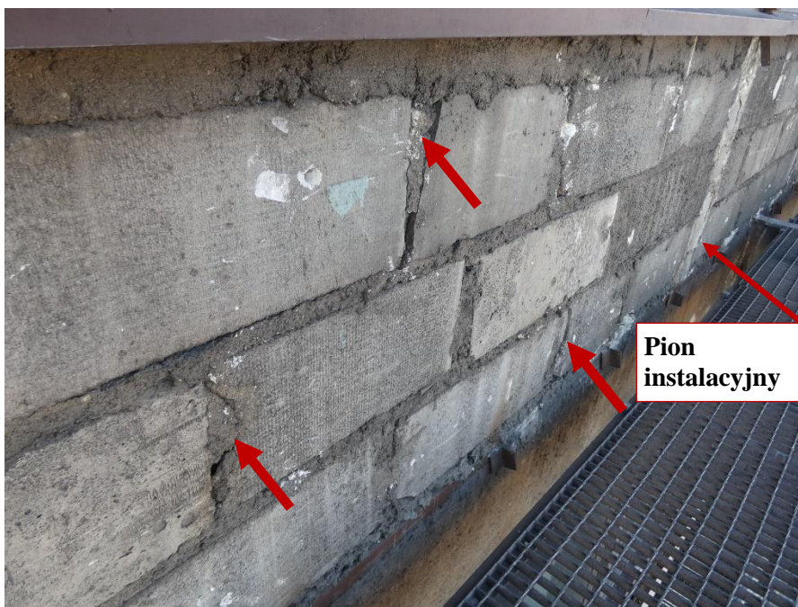
Fot. 20 Kondygnacja 6 (Poziom +25.20) Elewacja Północna – widok ściany murowanej w osiach 13-14/I. Zbyt duże wymiary spoin. Wypełnienie ubytków między elementami i uszkodzonych miejsc zaprawą i gruzem. Zwieńczenie ściany podlewką. Zamknięcie pionu instalacyjnego.
