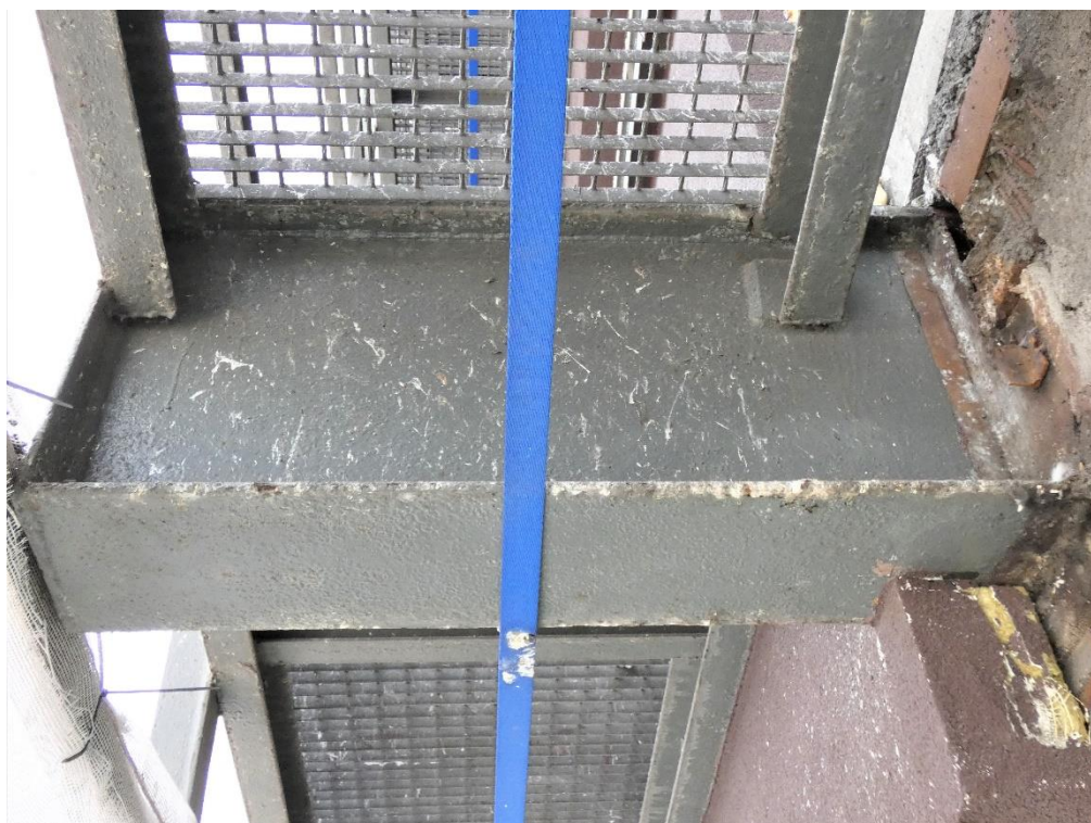
Fot. 119 Wspornik stalowy (widok z boku)
