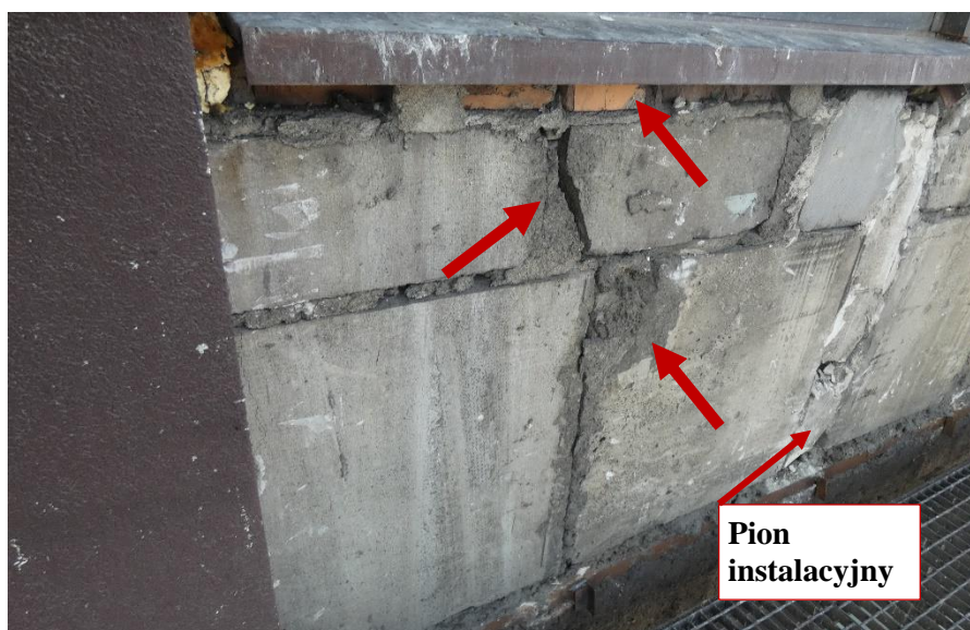
Fot. 14 Kondygnacja 6 (Poziom +25.20) Elewacja Wschodnia – widok ściany murowanej w osiach 14/H-I. Zbyt duże wymiary spoin. Ściana z uszkodzonych elementów murowych o zróżnicowanych kształtach (24x60, 60x60 cm). Zwieńczenie ściany uszkodzonymi ceramicznymi elementami murowymi gr. 6,5 cm. Wypełnienie ubytków między elementami i uszkodzonych miejsc zaprawą i gruzem. Zamknięcie pionu instalacyjnego zaprawą i gruzem.
