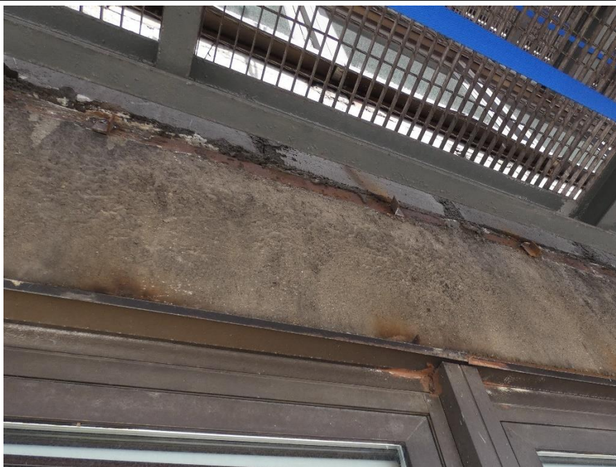
Fot. 105 Kondygnacja 6 (Poziom +25.20) Elewacja Południowa – belka w osiach 11-12/E.
