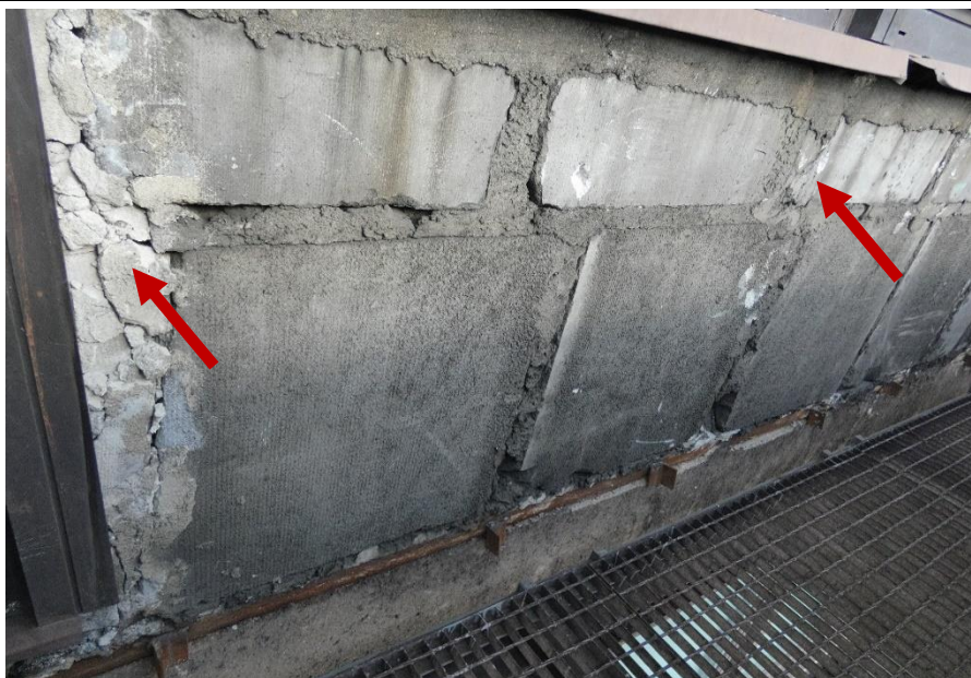
Fot. 49 Kondygnacja 6 (Poziom +25.20) Elewacja Południowa – widok ściany murowanej w osiach 11-12/E. Zbyt duże wymiary spoin. Wykonanie ściany z uszkodzonych elementów murowanych o zróżnicowanych kształtach. Wypełnienie ubytków między elementami zaprawą i gruzem. Zwieńczenie ściany podlewką.
