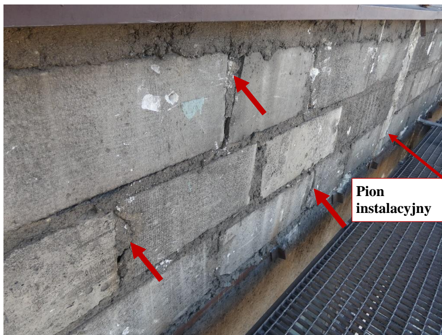
Fot. 20 Kondygnacja 6 (Poziom +25.20) Elewacja Północna – widok ściany murowanej w osiach 13-14/I. Zbyt duże wymiary spoin. Wypełnienie ubytków między elementami i uszkodzonych miejsc zaprawą i gruzem. Zwieńczenie ściany podlewką. Zamknięcie pionu instalacyjnego.
