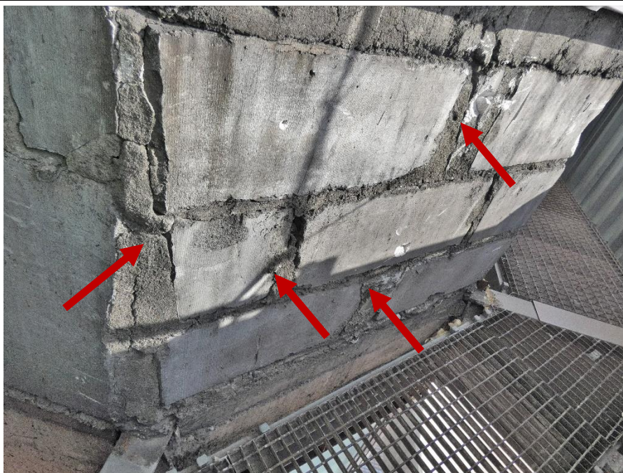
Fot. 45 Kondygnacja 6 (Poziom +25.20) Elewacja Zachodnia – widok ściany murowanej w osiach 10/E. Zbyt duże wymiary spoin. Niewłaściwe przewiązanie elementów w narożach. Wykonanie ściany z uszkodzonych elementów murowych. Zwieńczenie ściany podlewką. Wypełnienie ubytków między elementami zaprawą i gruzem.
