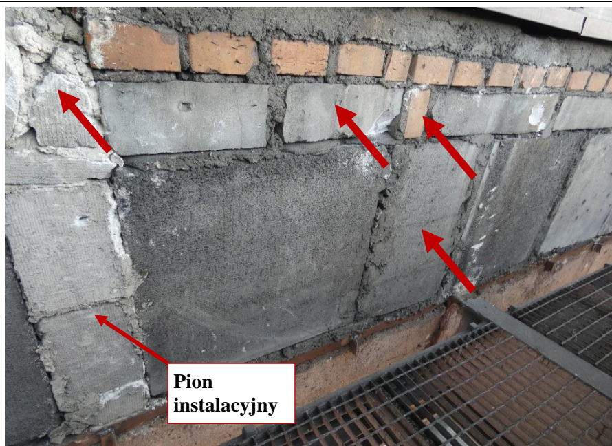
Fot. 37 Kondygnacja 6 (Poziom +25.20) Elewacja Zachodnia – widok ściany murowanej w osiach 10/G-H. Zbyt duże wymiary spoin. Ściana z elementów murowanych o zróżnicowanych materiałach i kształtach. Niewłaściwy kierunek układania elementów. Wypełnienie ubytków między elementami zaprawą. Zwieńczenie ściany podlewką. Zamknięcie pionu instalacyjnego elementami murowowymi, zaprawą i gruzem.
