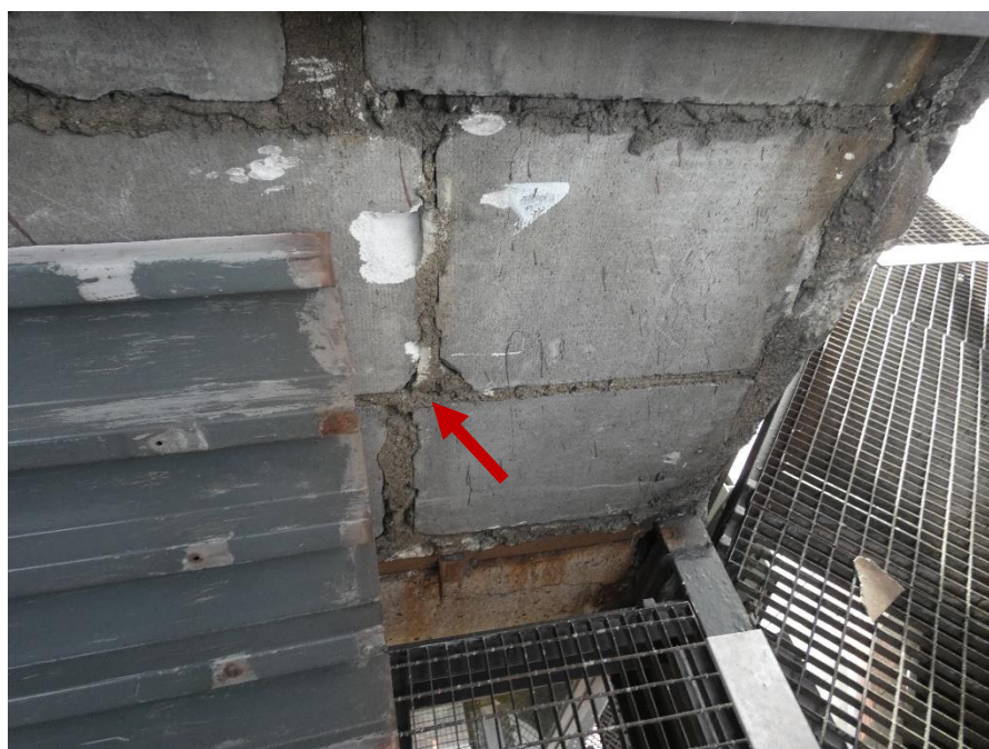
Fot. 46 Kondygnacja 11 (Poziom +41.70) Elewacja Zachodnia – widok ściany murowanej w osiach 10/E-F. Zbyt duże wymiary spoin. Niewłaściwe przewiązanie elementów.
