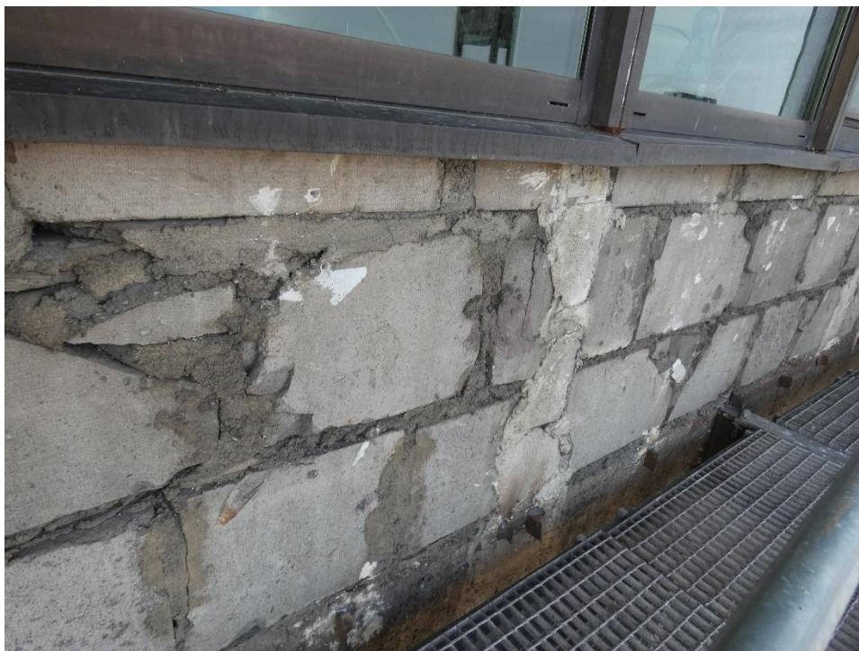
Fot. 3 Przykład ściany murowanej o bardzo niskiej jakości wykonania (wykonanie ściany z uszkodzonych elementów murowych z wypełnieniem przerw między elementami i uszkodzonych miejsc zaprawą i gruzem)
