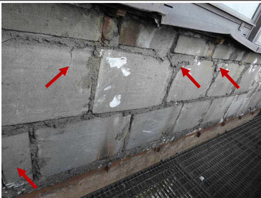
Fot. 41 Kondygnacja 11 (Poziom +41.70) Elewacja Zachodnia – widok ściany murowanej w osiach 10/G-H. Zbyt duże wymiary spoin. Zarysowania elementów murowych. Wykonanie ściany z uszkodzonych elementów murowych o zróżnicowanych kształtach. Wypełnienie ubytków między elementami i uszkodzonych miejsc zaprawą i gruzem. Zwieńczenie ściany elementami murowymi.
