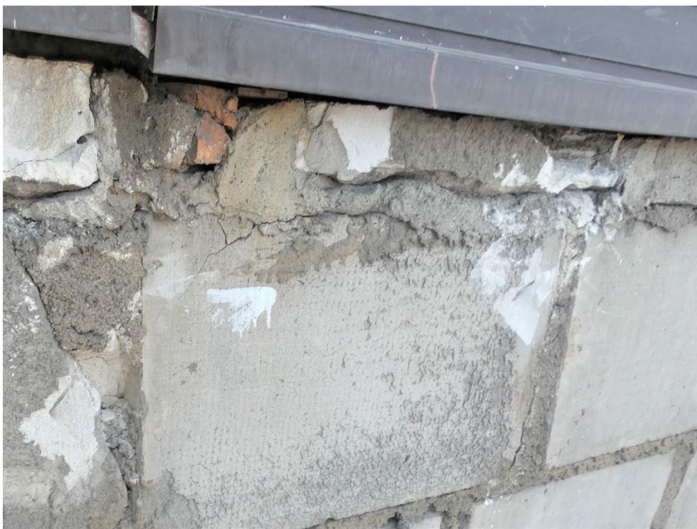
Fot. 8 Widok zwieńczenia ściany uszkodzonymi elementami murowymi i gruzem
