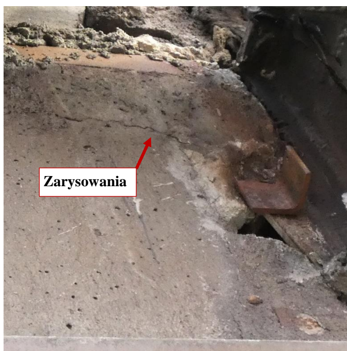
Fot. 101 Kondygnacja 11 (Poziom +41.70) Elewacja Południowa – belka w osiach 10-11/E. Zarysowania belki na wysokości miejsca oparcia. Spękania i zarysowania powierzchni zaprawy.
