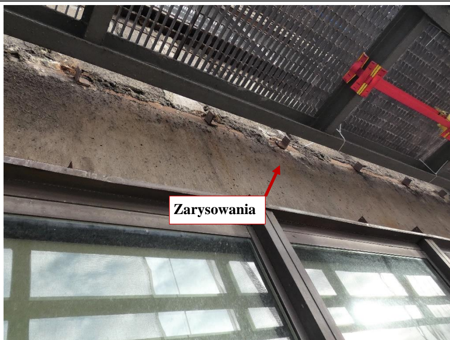
Fot. 100 Kondygnacja 11 (Poziom +41.70) Elewacja Południowa – belka w osiach 10-11/E. Zarysowania belki w przęśle na wysokości miejsca oparcia.
