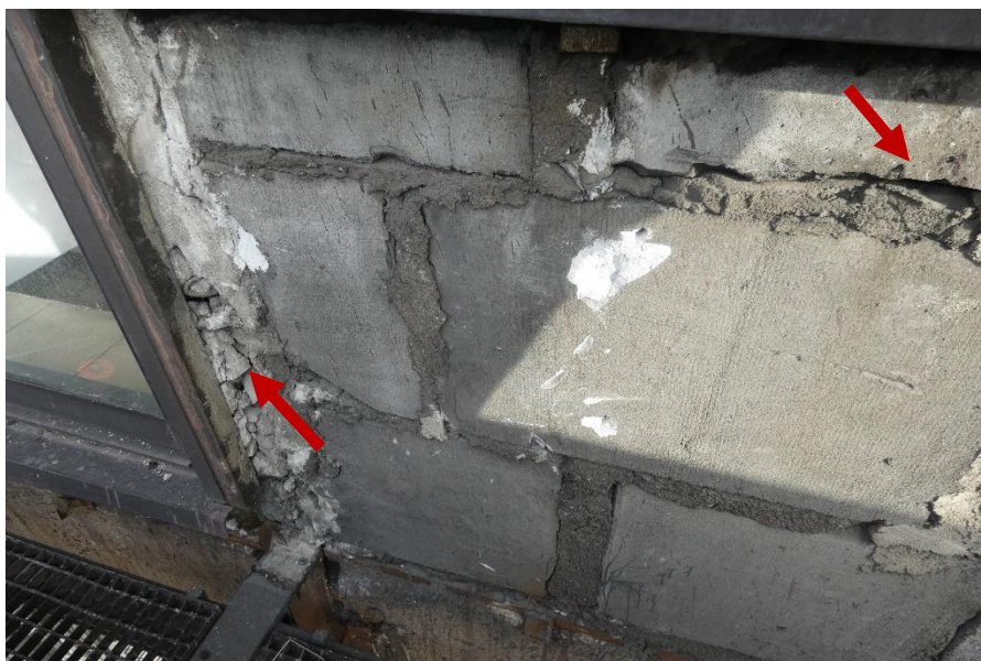
Fot. 54 Kondygnacja 11 (Poziom +41.70) Elewacja Południowa – widok ściany murowanej w osiach 12-13/E. Zbyt duże wymiary spoin. Wypełnienie ubytków między elementami zaprawą i gruzem. Zwieńczenie ściany uszkodzonymi elementami murowymi.
