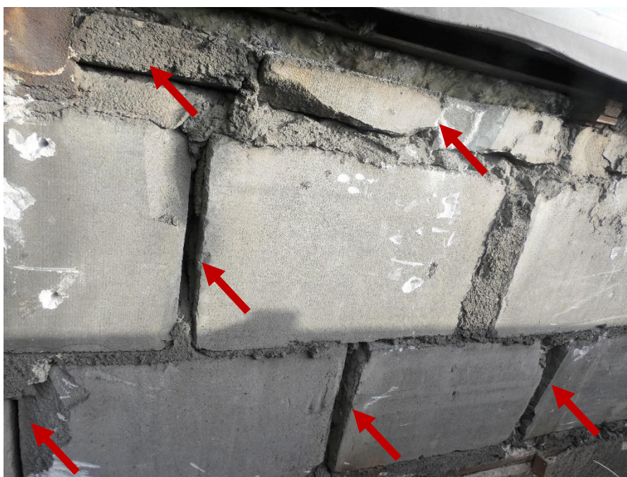
Fot. 56 Kondygnacja 11 (Poziom +41.70) Elewacja Południowa – widok ściany murowanej w osiach 13-14/E. Zbyt duże wymiary spoin. Ubytki spoin pionowych. Wykonanie ściany z uszkodzonych elementów murowych. Wypełnienie ubytków między elementami zaprawą. Zwieńczenie ściany uszkodzonymi elementami murowymi i gruzem.
