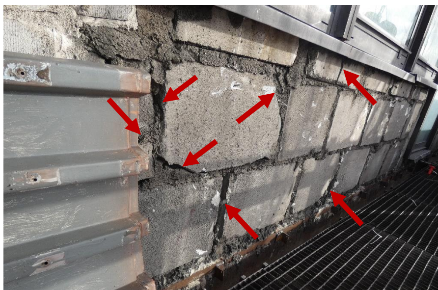
Fot. 52 Kondygnacja 11 (Poziom +41.70) Elewacja Południowa – widok ściany murowanej w osiach 12-13/E. Zbyt duże wymiary spoin. Ubytki spoin pionowych. Spękania elementów murowych. Wykonanie ściany z uszkodzonych elementów murowych. Wypełnienie ubytków między elementami i uszkodzonych miejsc zaprawą. Zwieńczenie ściany elementami murowymi.
