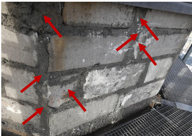
Fot. 20 Kondygnacja 11 (Poziom +41.70) Elewacja Wschodnia – widok ściany murowanej w osiach 14/I. Zbyt duże wymiary spoin. Niewłaściwe przewiązanie elementów. Wykonanie ściany z elementów murowanych 24x60 cm. Wypełnienie ubytków między elementami zaprawą i gruzem. Zwieńczenie ściany elementami murowymi 12x60 cm.
