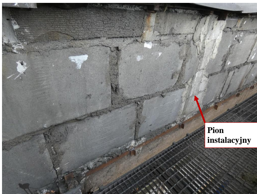
Fot. 40 Kondygnacja 11 (Poziom +41.70) Elewacja Zachodnia – widok ściany murowanej w osiach 10/G-H. Zbyt duże wymiary spoin. Wypełnienie ubytków między elementami zaprawą. Zwieńczenie ściany elementami murowymi. Zamknięcie pionu instalacyjnego.
