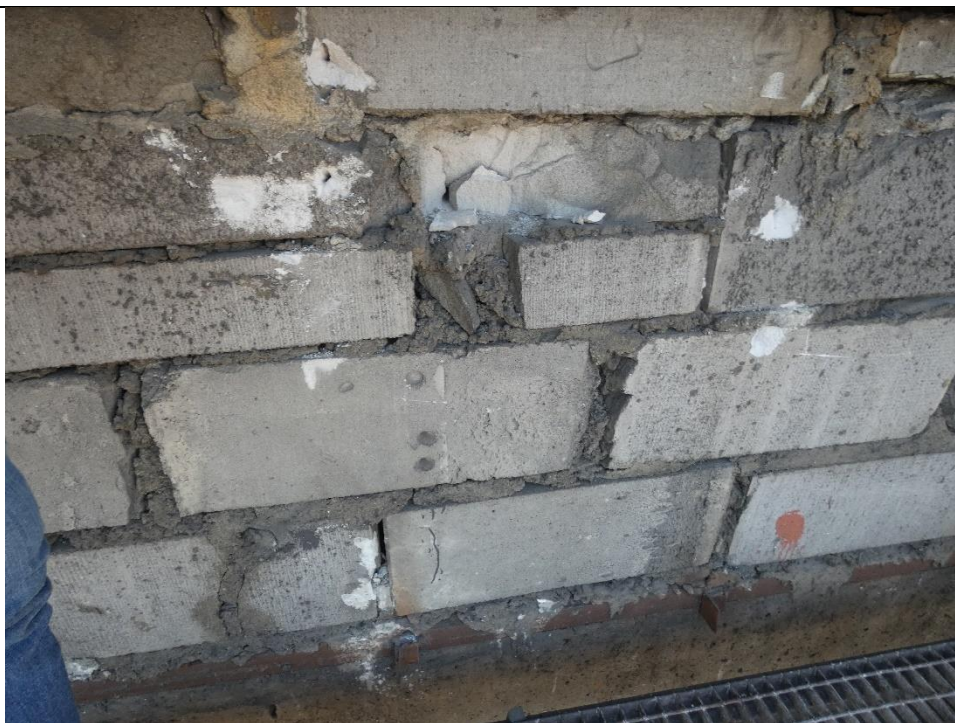
Fot. 2 Przykład ściany murowanej o bardzo niskiej jakości wykonania (ściana z uszkodzonych elementów murowych o zróżnicowanych wymiarach 12x60, 18x60, 24x60 z wypełnieniem przerw między elementami i uszkodzonych miejsc zaprawą i gruzem)
