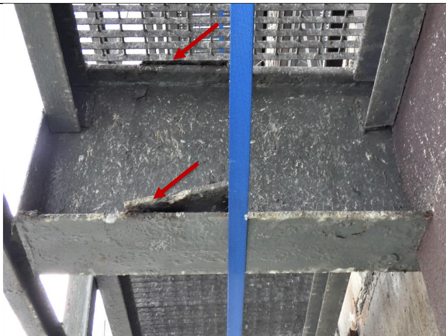
Fot. 116 Pozostałości po drabinie ewakuacyjnej w osi 14/F (widok z dołu)
