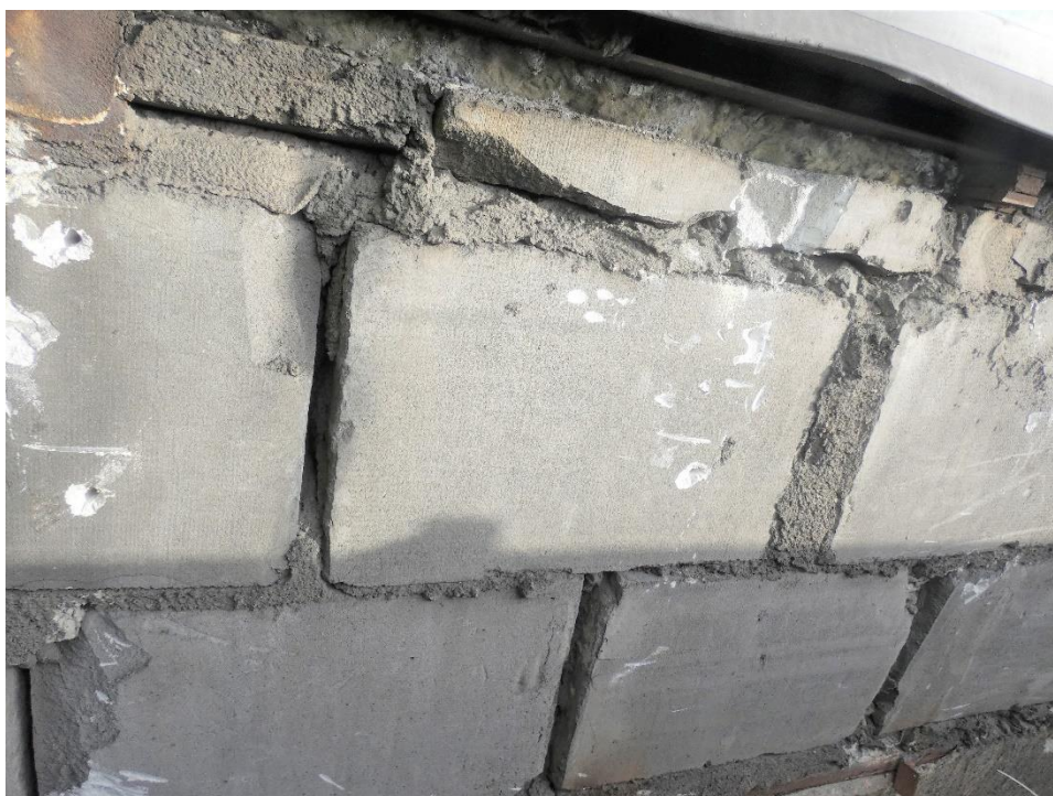
Fot. 5 Przykład ściany murowanej o bardzo niskiej jakości wykonania (ubytki spoin pionowych uzupełnienie uszkodzonych miejsc i części ubytków między elementami zaprawą)
