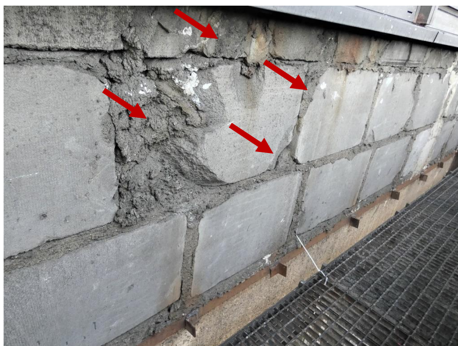
Fot. 38 Kondygnacja 11 (Poziom +41.70) Elewacja Zachodnia – widok ściany murowanej w osiach 10/H-I. Zbyt duże wymiary spoin. Wykonanie ściany z uszkodzonych elementów murowych. Wypełnienie ubytków między elementami i uszkodzonych miejsc zaprawą. Zwieńczenie ściany uszkodzonymi elementami murowymi.
