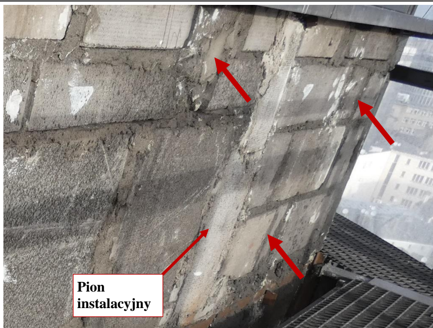
Fot. 19 Kondygnacja 11 (Poziom +41.70) Elewacja Wschodnia – widok ściany murowanej w osiach 14/H-I. Zbyt duże wymiary spoin. Ściana z uszkodzonych elementów murowanych o zróżnicowanych kształtach (12x60, 18x60, 24x60, 60x60 cm). Wypełnienie ubytków między elementami i uszkodzonych miejsc zaprawą i gruzem. Zwieńczenie ściany elementami murowymi 12x60 cm. Zamknięcie pionu instalacyjnego
