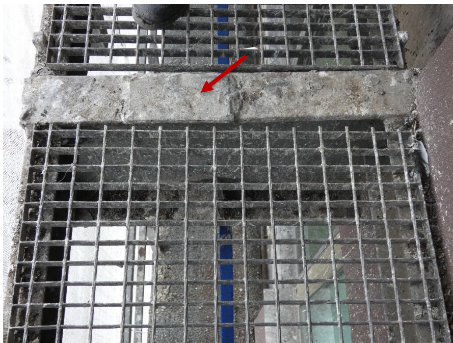
Fot. 117 Pozostałości po drabinie ewakuacyjnej w osi 14/F (widok z góry)
