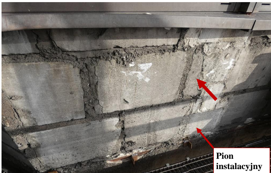
Fot. 48 Kondygnacja 11 (Poziom +41.70) Elewacja Południowa – widok ściany murowanej w osiach 10-11/E. Zbyt duże wymiary spoin. Wykonanie ściany z elementów murowych 36x60 cm. Wypełnienie ubytków między elementami i uszkodzonych miejsc zaprawą i gruzem. Zwieńczenie ściany uszkodzonymi elementami murowymi 12x60 cm. Zamknięcie pionu instalacyjnego.
