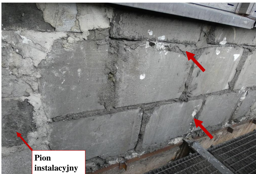
Fot. 42 Kondygnacja 11 (Poziom +41.70) Elewacja Zachodnia – widok ściany murowanej w osiach 10/G-H. Zbyt duże wymiary spoin. Wykonanie ściany z uszkodzonych elementów murowych. Wypełnienie ubytków między elementami i uszkodzonych miejsc zaprawą i gruzem. Zwieńczenie pionu instalacyjnego elementami murowymi i gruzem.
