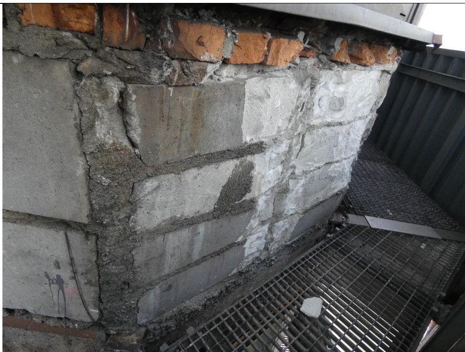
Fot. 4 Przykład ściany murowanej o bardzo niskiej jakości wykonania (brak przewiązania ściany murowanej, zwieńczenie ściany ceramicznymi elementami murowymi)
