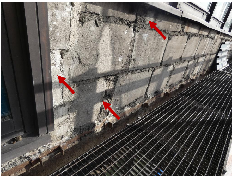
Fot. 50 Kondygnacja 11 (Poziom +41.70) Elewacja Południowa – widok ściany murowanej w osiach 10-11/E. Zbyt duże wymiary spoin. Wykonanie ściany z uszkodzonych elementów murowych. Wypełnienie ubytków między elementami i uszkodzonych miejsc zaprawą i gruzem. Zwieńczenie ściany elementami murowymi i gruzem.
