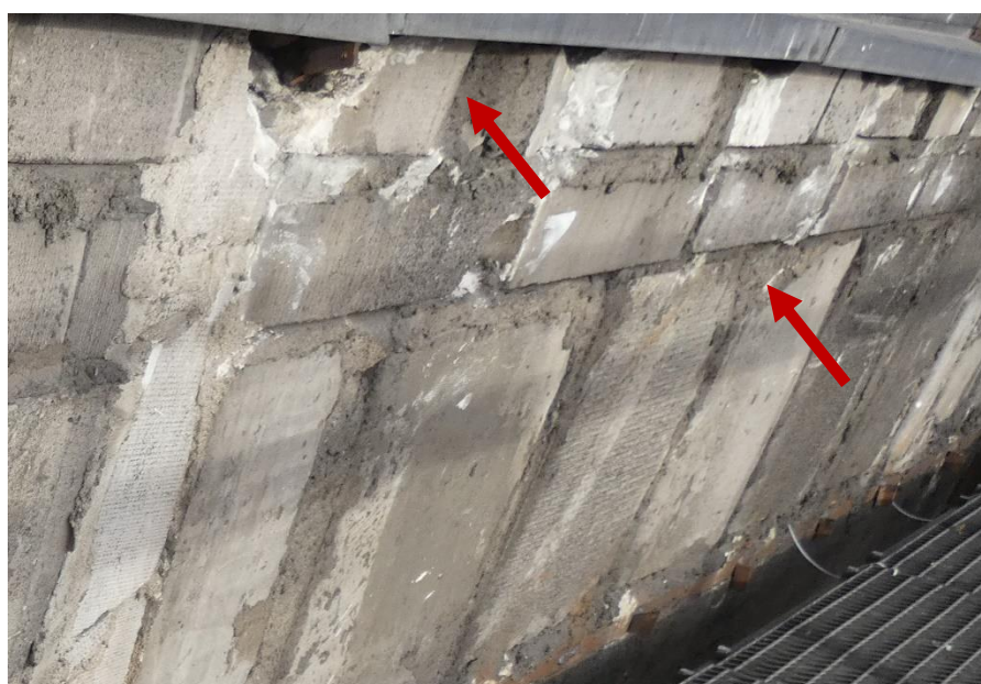
Fot. 16 Kondygnacja 11 (Poziom +41.70) Elewacja Wschodnia – widok ściany murowanej w osiach 14/H-I. Zbyt duże wymiary spoin. Ściana z uszkodzonymi elementami murowymi o zróżnicowanych kształtach. Wypełnienie ubytków między elementami i uszkodzonych miejsc zaprawą. Zwieńczenie ściany uszkodzonymi elementami murowymi.
