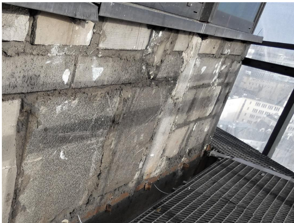
Fot. 1 Przykład ściany murowanej o bardzo niskiej jakości wykonania (ściana z elementów o zróżnicowanych wymiarach 12x60, 18x60, 24x60, 60x60 cm)
