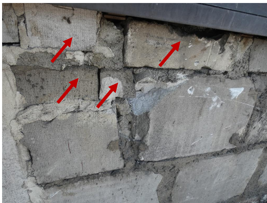
Fot. 30 Kondygnacja 11 (Poziom +41.70) Elewacja Północna – widok ściany murowanej w osiach 11-12/I. Zbyt duże wymiary spoin. Wykonanie ściany z uszkodzonych elementów murowych o zróżnicowanych kształtach. Wypełnienie ubytków między elementami i uszkodzonych miejsc zaprawą i gruzem. Zwieńczenie ściany uszkodzonymi elementami murowymi.
