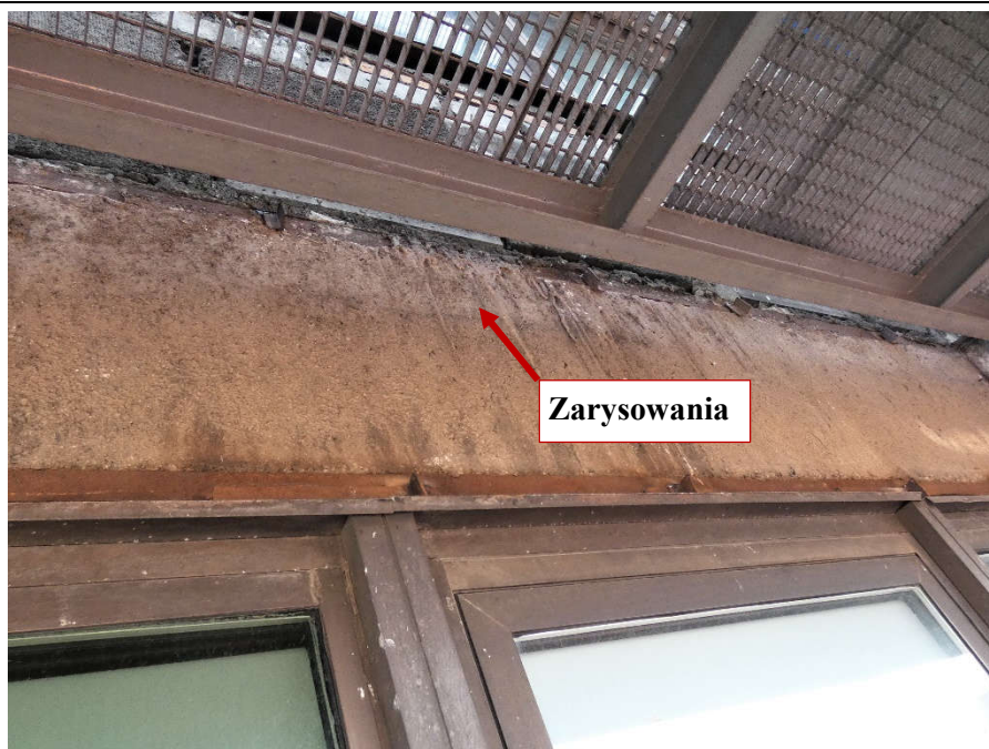
Fot. 98 Nad kondygnacją 5 (Poziom +21.90) Elewacja Zachodnia – belka w osiach 10/G-H. Zarysowanie belki w przęśle na wysokości miejsca oparcia.
