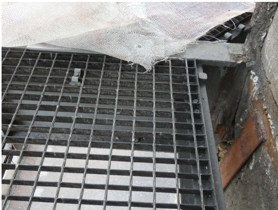
Fot. 207 Pod kondygnacją 5 (Poziom +21.90) Elewacja Wschodnia – wspornik w osiach 14/E.
