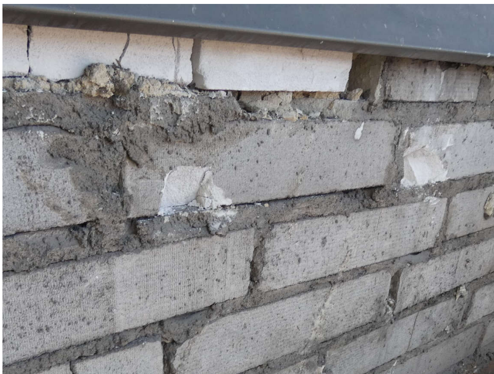
Fot. 10 Widok zwieńczenia ściany elementami z betonu komórkowego bez podlewki pod profilem stalowym.
