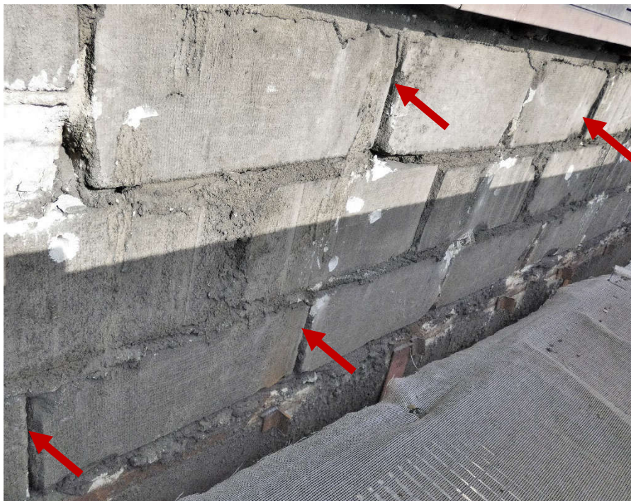
Fot. 61 Kondygnacja 5 (Poziom +21.90) Elewacja Południowa – widok ściany murowanej w osiach 13-14/E. Zbyt duże wymiary spoin. Ubytki spoin pionowych. Wypełnienie ubytków między elementami zaprawą. Zwieńczenie ściany podlewką.
