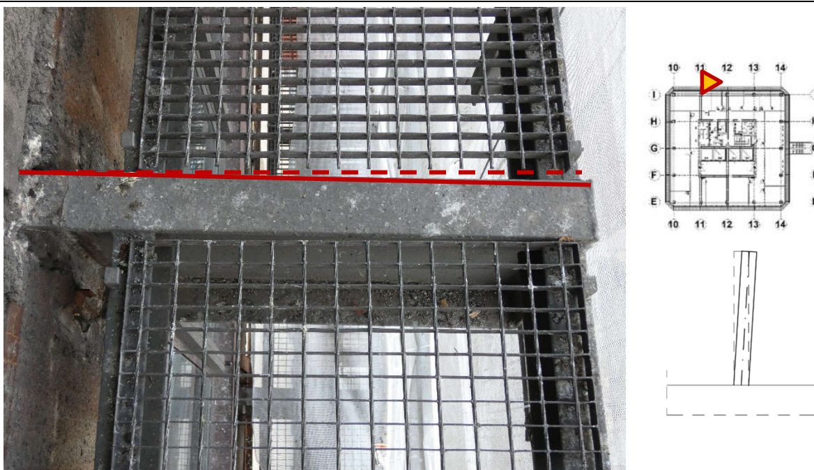
Fot. 183 Nad kondygnacją 5 (Poziom +21.90) Elewacja Północna – wspornik w osiach 11/I (widok z góry) Przesunięcie wspornika w kierunku osi 12. Brak widocznych uszkodzeń wspornika.
