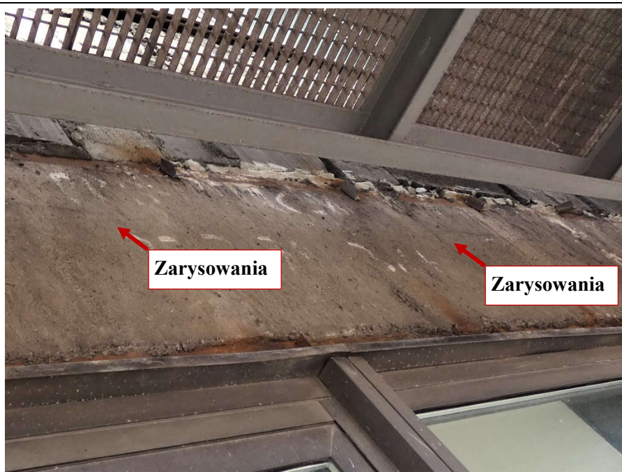
Fot. 123 Nad kondygnacją 5 (Poziom +21.90) Elewacja Południowa – belka w osiach 13-14/E. Zarysowanie belki w przęśle na wysokości miejsca oparcia.
