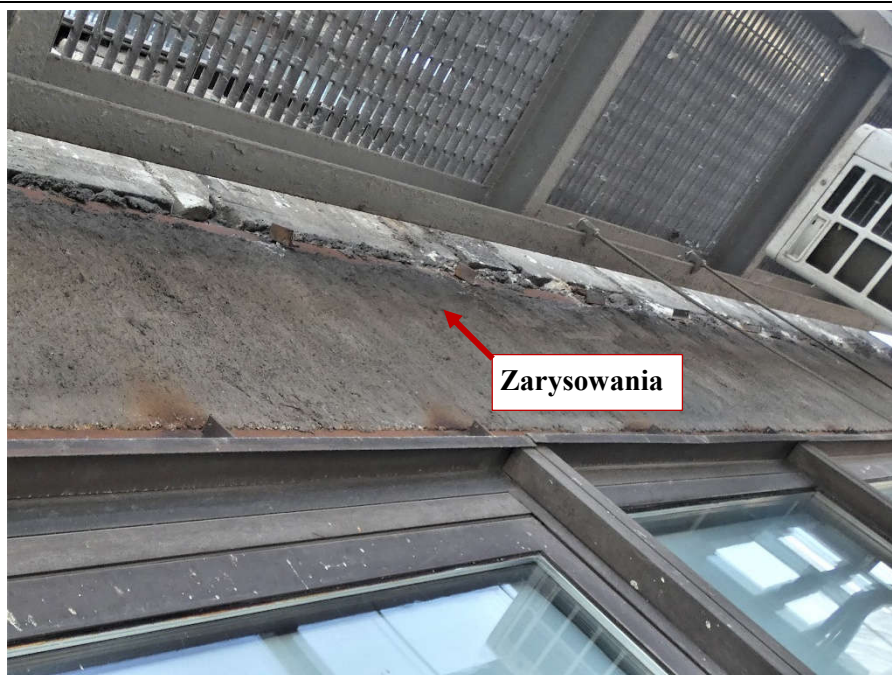
Fot. 69 Nad kondygnacją 5 (Poziom +21.90) Elewacja Wschodnia – belka w osiach 14/H-I. Zarysowanie belki w przęśle na wysokości miejsca oparcia.
