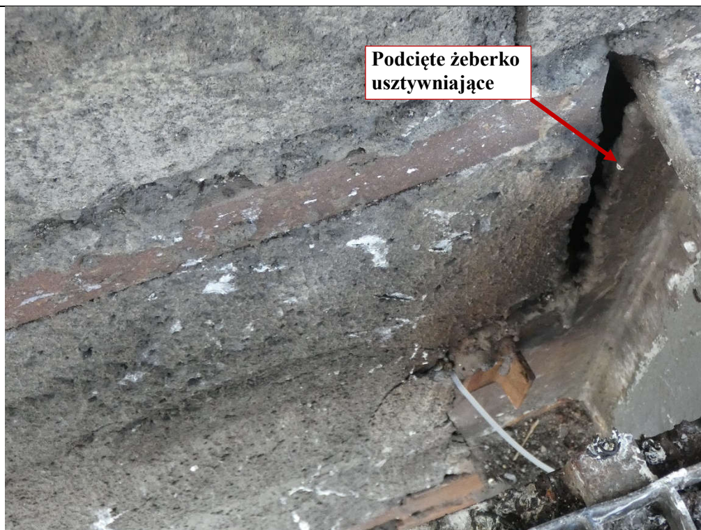
Fot. 157 Wspornik stalowy w miejscu oparcia belek żelbetowych nad kondygnacją 5 (widok z góry)
