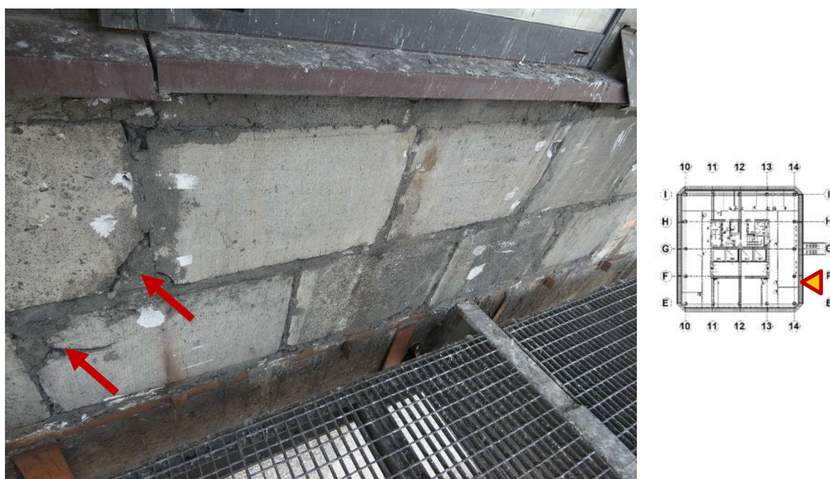
Fot. 17 Kondygnacja 5 (Poziom +21.90) Elewacja Wschodnia – widok ściany murowanej w osiach 14/E-F. Zbyt duże wymiary spoin. Wykonanie ściany z uszkodzonych elementów murowych 36x60 cm. Wypełnienie ubytków między elementami i uszkodzonych miejsc zaprawą. Zwieńczenie ściany podlewką.
