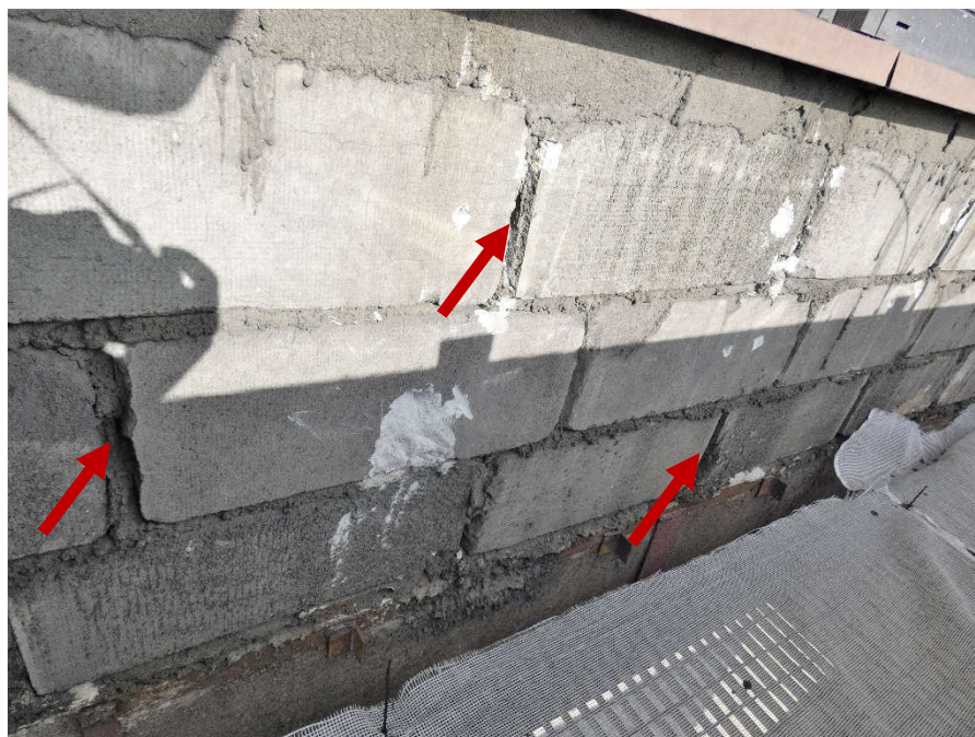
Fot. 53 Kondygnacja 5 (Poziom +21.90) Elewacja Południowa – widok ściany murowanej w osiach 10-11/E. Zbyt duże wymiary spoin. Ubytki spoin pionowych. Wypełnienie ubytków między elementami zaprawą. Zwieńczenie ściany podlewką.
