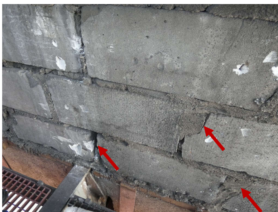
Fot. 47 Kondygnacja 5 (Poziom +21.90) Elewacja Zachodnia – widok ściany murowanej w osiach 10/E-F. Zbyt duże wymiary spoin. Ubytki spoin pionowych. Ściana z uszkodzonych elementów murowych. Wypełnienie ubytków między elementami i uszkodzonych miejsc zaprawą i gruzem.
