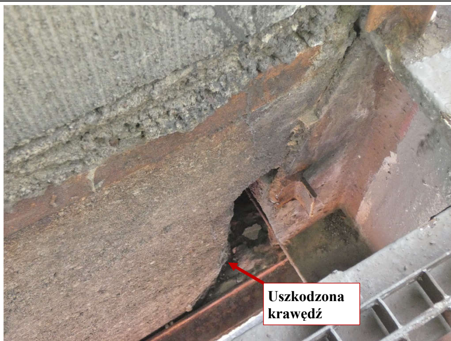
Fot. 148 Pod kondygnacją 5 (Poziom +21.90) Elewacja Zachodnia – belka w osiach 10/E-F. Uszkodzona krawędź elementu. Zalegający gruz w przestrzeni między elementami.
