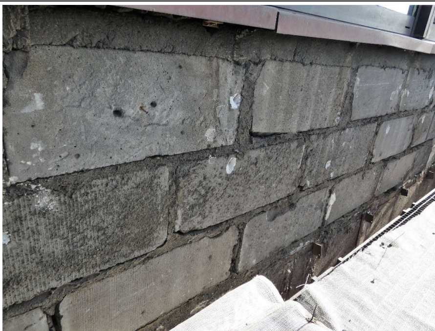
Fot. 48 Kondygnacja 5 (Poziom +21.90) Elewacja Zachodnia – widok ściany murowanej w osiach 10/E-F. Zbyt duże wymiary spoin. Ściana z elementów murowanych 24x60 cm. Wypełnienie ubytków między elementami zaprawą. Zwieńczenie ściany podlewką.
