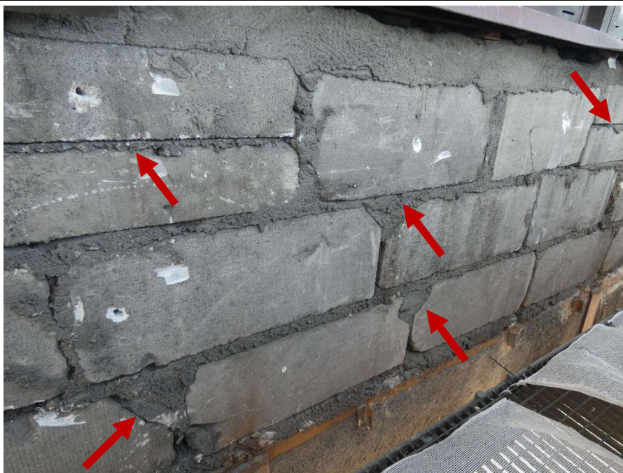
Fot. 22 Kondygnacja 5 (Poziom +21.90) Elewacja Wschodnia – widok ściany murowanej w osiach 14/H-I. Zbyt duże wymiary spoin. Ściana z uszkodzonych elementów murowych o zróżnicowanych kształtach. Wypełnienie ubytków między elementami i uszkodzonych miejsc zaprawą. Zwieńczenie ściany podlewką.
