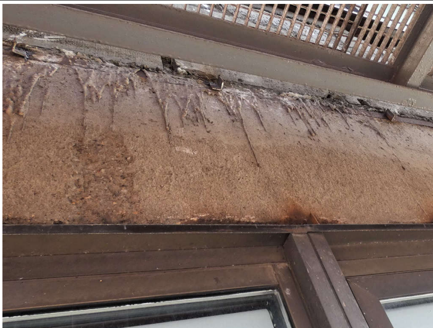
Fot. 104 Nad kondygnacją 5 (Poziom +21.90) Elewacja Zachodnia – belka w osiach 10/E-F. Brak widocznych uszkodzeń belki w przęśle
