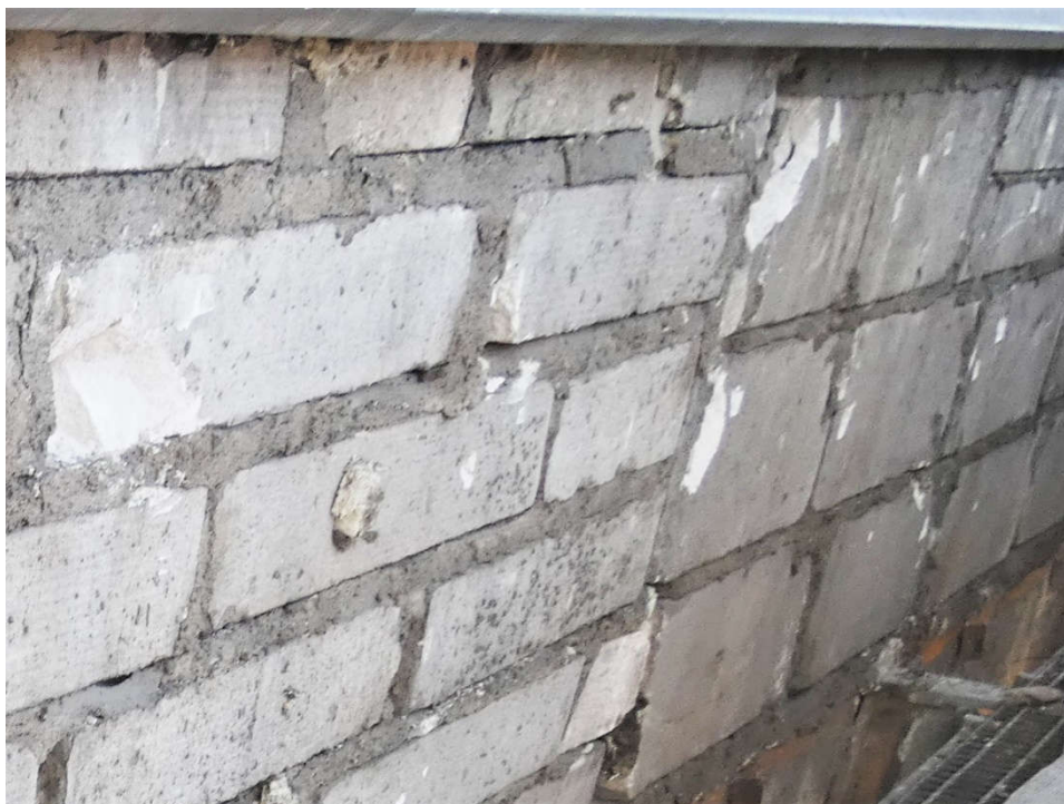
Fot. 6 Przykład ściany murowanej o bardzo niskiej jakości wykonania (ściana z uszkodzonymi elementami murowymi o zróżnicowanych kształtach, niewłaściwym przewiązaniu)
