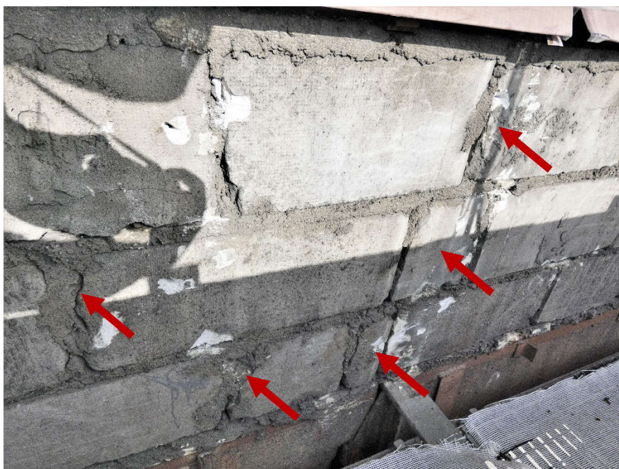
Fot. 57 Kondygnacja 5 (Poziom +21.90) Elewacja Południowa – widok ściany murowanej w osiach 11-12/E. Zbyt duże wymiary spoin. Wykonanie ściany z uszkodzonych elementów murowych. Wypełnienie ubytków między elementami i uszkodzonych miejsc zaprawą i gruzem. Zwieńczenie ściany podlewką.
