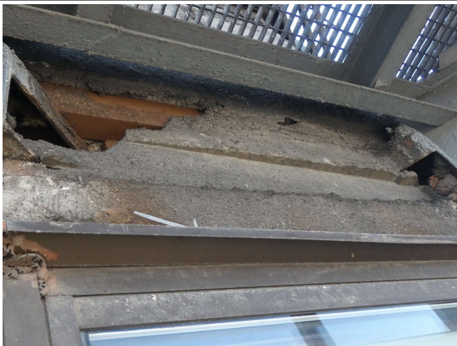
Fot. 72 Nad kondygnacją 5 (Poziom +21.90) Elewacja Wschodnia – belka w osiach 14/I. Uszkodzona zaprawa przykrywająca ceowniki oparte na wspornikach stalowych.
