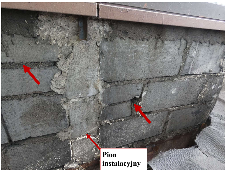
Fot. 49 Kondygnacja 5 (Poziom +21.90) Elewacja Zachodnia – widok ściany murowanej w osiach 10/E-F. Zbyt duże wymiary spoin. Ściana z elementów murowanych o zróżnicowanych kształtach. Wypełnienie ubytków między elementami zaprawą. Zwieńczenie ściany podlewką. Zamknięcie pionu instalacyjnego.
