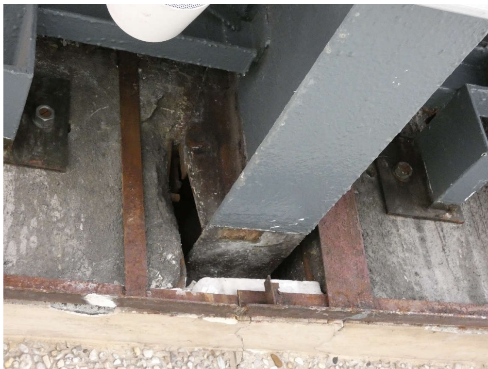
Fot. 160 Wspornik stalowy w miejscu oparcia belek żelbetowych pod kondygnacją 5 (widok z dołu)
