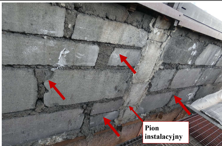
Fot. 46 Kondygnacja 5 (Poziom +21.90) Elewacja Zachodnia – widok ściany murowanej w osiach 10/F-G. Zbyt duże wymiary spoin. Ściana z uszkodzonych elementów murowych o zróżnicowanych kształtach. Wypełnienie ubytków między elementami i uszkodzonych miejsc zaprawą i gruzem. Zwieńczenie ściany podlewką. Zamknięcie pionu instalacyjnego.
