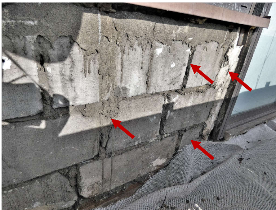
Fot. 54 Kondygnacja 5 (Poziom +21.90) Elewacja Południowa – widok ściany murowanej w osiach 10-11/E. Zbyt duże wymiary spoin. Ubytki spoin pionowych. Ściana z uszkodzonych elementów murowych. Wypełnienie ubytków między elementami zaprawą i gruzem. Zwieńczenie ściany podlewką.
