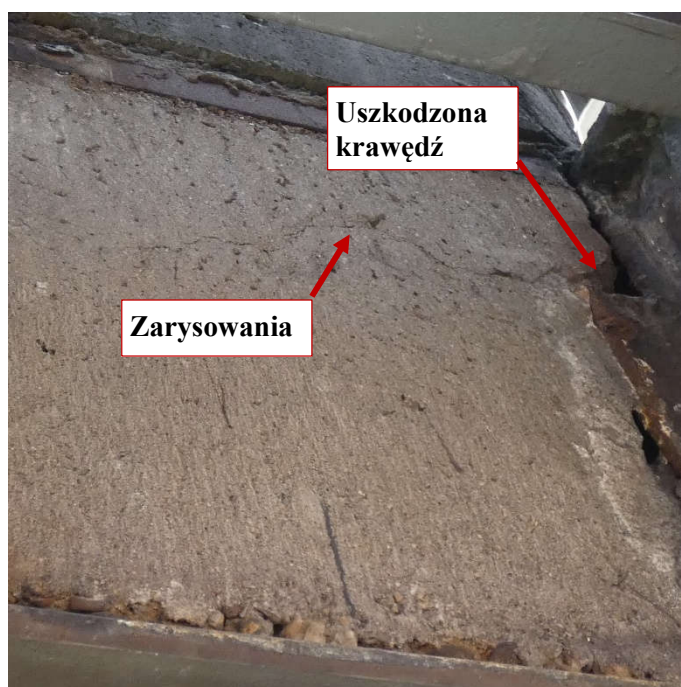
Fot. 105 Nad kondygnacją 5 (Poziom +21.90) Elewacja Zachodnia – belka w osiach 10/E-F. Uszkodzona krawędź elementu. Zarysowania belki na wysokości miejsca oparcia. Spękania i zarysowania powierzchni zaprawy.
