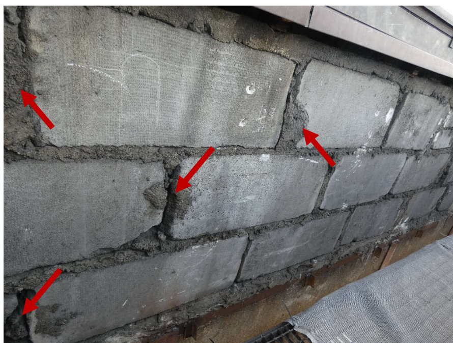
Fot. 39 Kondygnacja 5 (Poziom +21.90) Elewacja Zachodnia – widok ściany murowanej w osiach 10/H-I. Zbyt duże wymiary spoin. Ubytki spoin pionowych. Ściana z uszkodzonych elementów murowych 24x60 cm. Wypełnienie ubytków między elementami i uszkodzonych miejsc zaprawą i gruzem. Zwieńczenie ściany podlewką.
