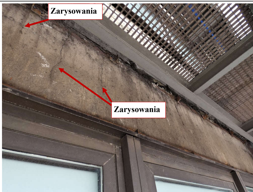
Fot. 108 Nad kondygnacją 5 (Poziom +21.90) Elewacja Południowa – belka w osiach 10-11/E. Zarysowania pionowe oraz poziome na wysokości miejsca oparcia.
