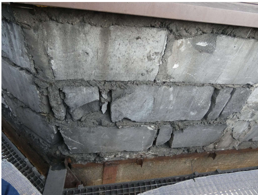
Fot. 4 Przykład ściany murowanej o bardzo niskiej jakości wykonania (ściana o niewłaściwym przewiązaniu elementów w narożu oraz z wypełnieniem uszkodzonych miejsc i ubytków między elementami zaprawą i gruzem)
