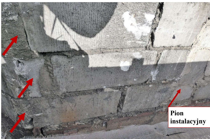
Fot. 51 Kondygnacja 5 (Poziom +21.90) Elewacja Południowa – widok ściany murowanej w osiach 10-11/E. Zbyt duże wymiary spoin. Niewłaściwe przewiązanie elementów w narożu. Wypełnienie ubytków między elementami zaprawą i gruzem. Zamknięcie pionu instalacyjnego.
