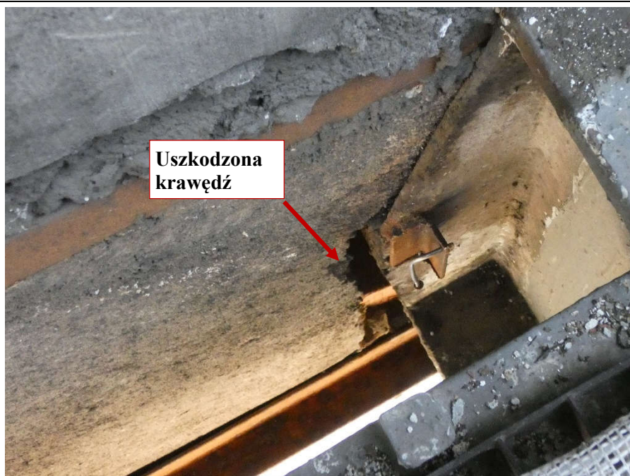
Fot. 138 Pod kondygnacją 5 (Poziom +21.90) Elewacja Północna – belka w osiach 11-12/I. Uszkodzona krawędź elementu. Przestrzeń między elementami wypełniona gruzem
