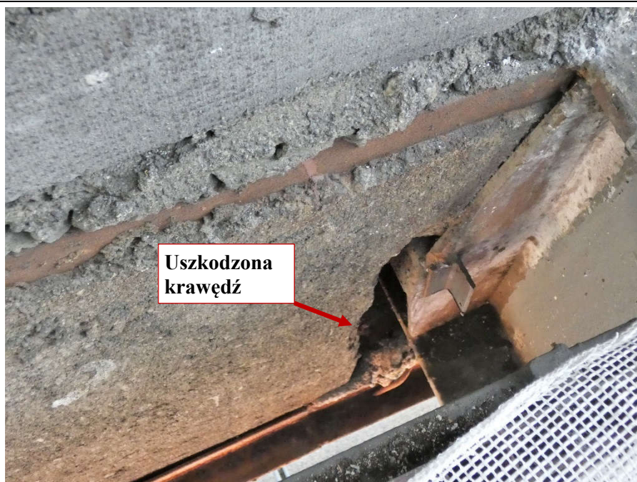
Fot. 144 Pod kondygnacją 5 (Poziom +21.90) Elewacja Zachodnia – belka w osiach 10/G-H. Uszkodzona krawędź elementu. Zalegający gruz w przestrzeni między elementami.
