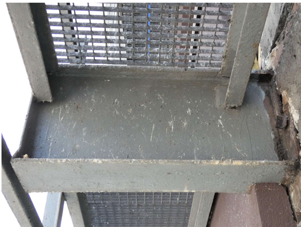
Fot. 161 Wspornik stalowy (widok z boku)
