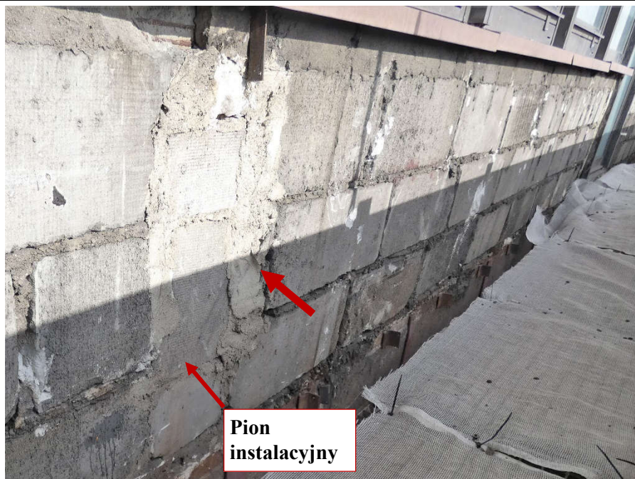
Fot. 52 Kondygnacja 5 (Poziom +21.90) Elewacja Południowa – widok ściany murowanej w osiach 10-11/E. Zbyt duże wymiary spoin. Ściana z elementów murowanych 24x60 cm. Wypełnienie ubytków między elementami zaprawą i gruzem. Zwieńczenie ściany podlewką. Zamknięcie pionu instalacyjnego.
