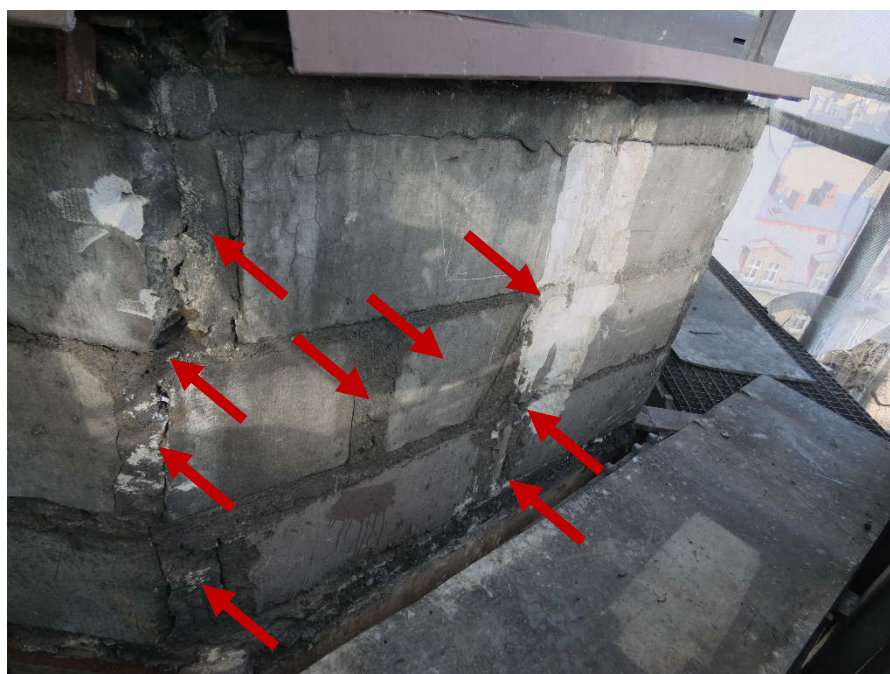
Fot. 63 Kondygnacja 5 (Poziom +21.90) Elewacja Południowa – widok ściany murowanej w osiach 14/E. Zbyt duże wymiary spoin. Niewłaściwe przewiązanie elementów. Wykonanie ściany z uszkodzonych elementów murowych. Wypełnienie ubytków między elementami zaprawą i gruzem. Zwieńczenie ściany podlewką.
