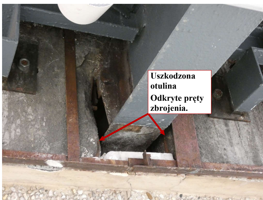
Fot. 129 Pod kondygnacją 5 (Poziom +21.90) Elewacja Wschodnia – belki w osiach 14/F-H (widok z dołu) Uszkodzona otulina. Odkryte pręty zbrojenia.
