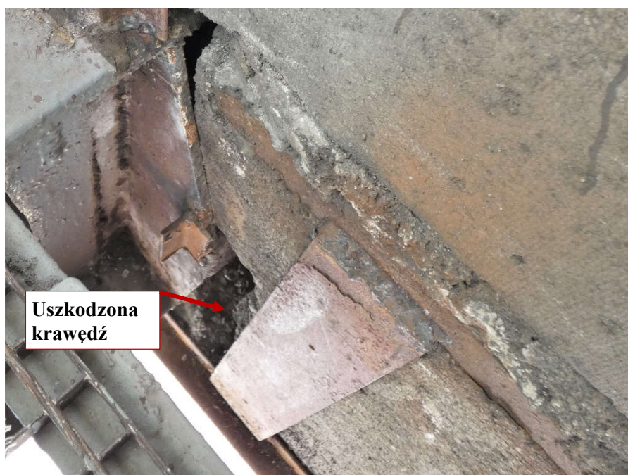
Fot. 149 Pod kondygnacją 5 (Poziom +21.90) Elewacja Południowa – belka w osiach 10-11/E. Uszkodzona krawędź elementu. Zalegający gruz w przestrzeni między elementami.
