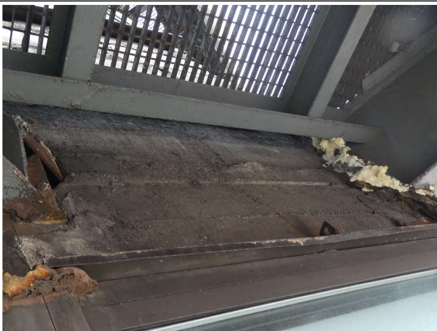
Fot. 106 Nad kondygnacją 5 (Poziom +21.90) Elewacja Zachodnia – belka w osiach 10/E.
