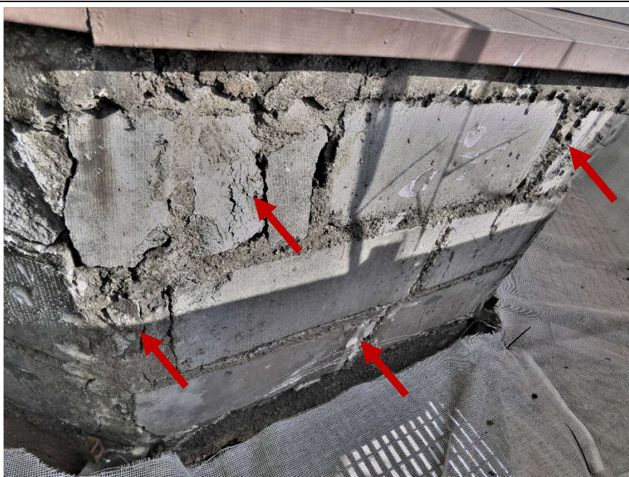
Fot. 50 Kondygnacja 5 (Poziom +21.90) Elewacja Zachodnia – widok ściany murowanej w osiach 10/E. Zbyt duże wymiary spoin. Niewłaściwe przewiązanie elementów. Wykonanie ściany z uszkodzonych elementów murowych. Wypełnienie ubytków między elementami zaprawą, gruzem. Zwieńczenie ściany podlewką.
