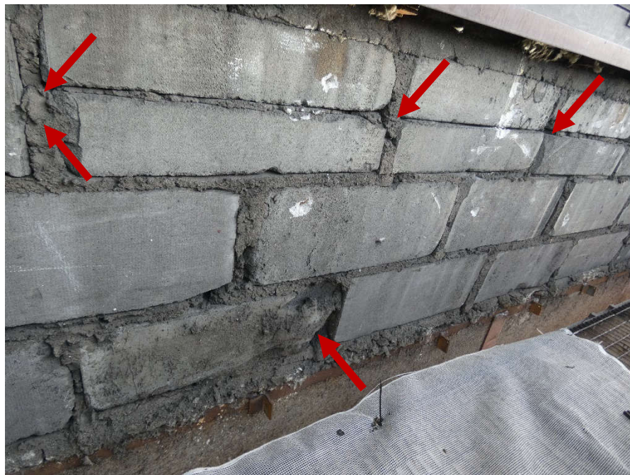
Fot. 45 Kondygnacja 5 (Poziom +21.90) Elewacja Zachodnia – widok ściany murowanej w osiach 10/F-G. Zbyt duże wymiary spoin. Niewłaściwe przewiązanie elementów. Ściana z uszkodzonymi elementami murowymi o zróżnicowanych kształtach (12x60, 24x60 cm). Wypełnienie ubytków między elementami i uszkodzonych miejsc zaprawą i gruzem. Zwieńczenie ściany podlewką.
