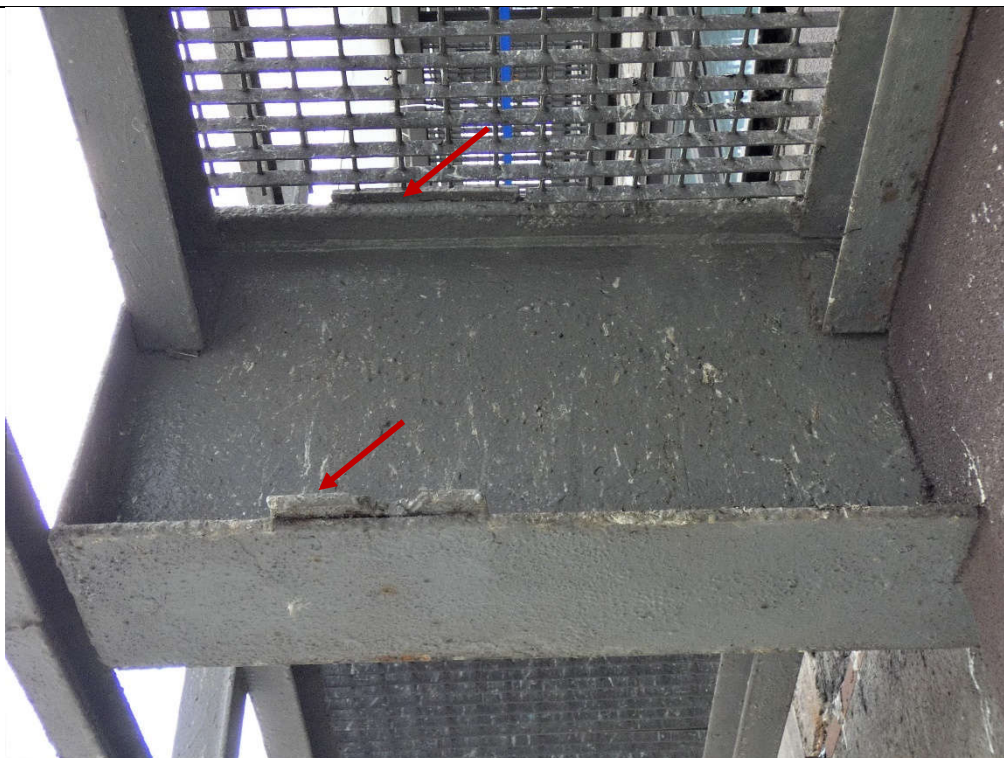
Fot. 162 Pozostałości po drabinie ewakuacyjnej w osi 14/F (widok z dołu)
