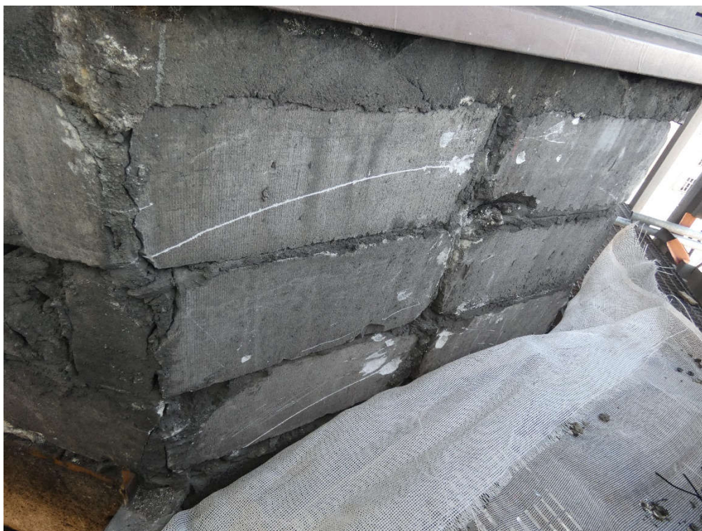
Fot. 3 Przykład ściany murowanej o bardzo niskiej jakości wykonania (brak przewiązania elementów ściany murowanej)
