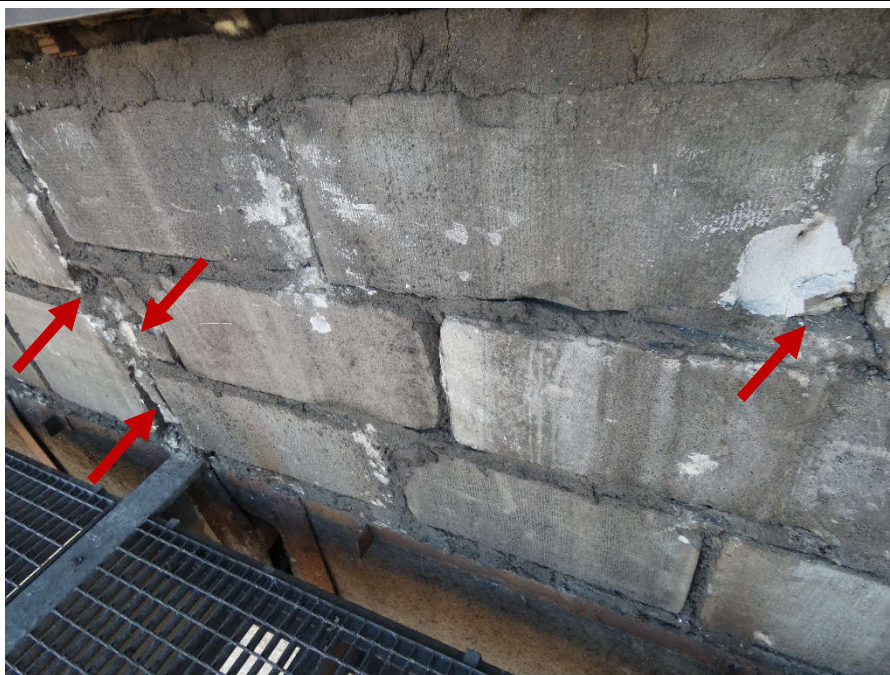
Fot. 28 Kondygnacja 5 (Poziom +21.90) Elewacja Północna – widok ściany murowanej w osiach 12-13/I. Zbyt duże wymiary spoin. Niewłaściwe przewiązanie elementów. Ściana z uszkodzonych elementów murowanych o zróżnicowanych kształtach (24x60, 36x60 cm). Wypełnienie ubytków między elementami i uszkodzonych miejsc zaprawą i gruzem. Zwieńczenie ściany podławką.
