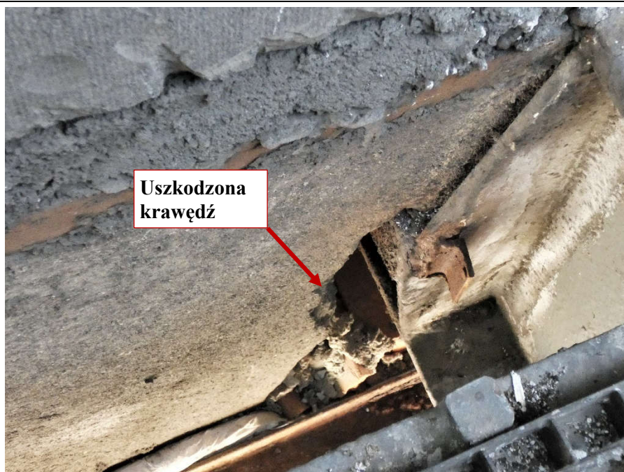
Fot. 136 Pod kondygnacją 5 (Poziom +21.90) Elewacja Północna – belka w osiach 12-13/I. Uszkodzona krawędź elementu. Zalegający gruz i odpady w przestrzeni między elementami.
