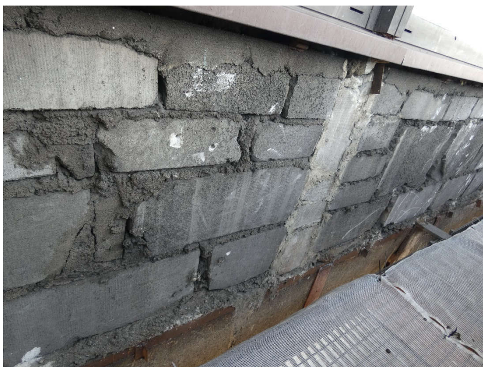
Fot. 5 Przykład ściany murowanej o bardzo niskiej jakości wykonania (ściana z uszkodzonymi elementami murowymi o różnicowanych kształtach, niewłaściwym przewiązaniu elementów oraz wypełnieniem uszkodzonych miejsc i ubytków zaprawą i gruzem)
