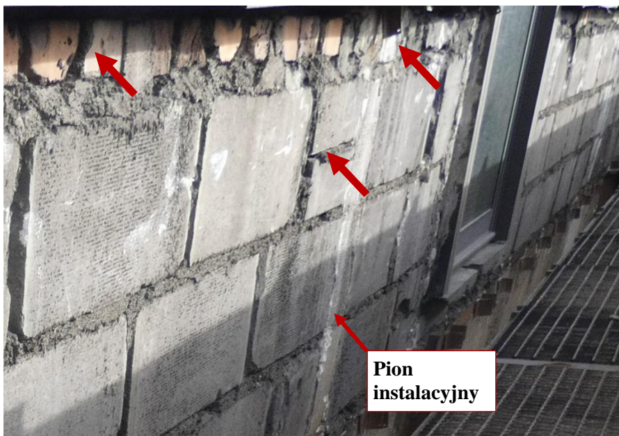
Fot. 53 Kondygnacja 10 (Poziom +38.40) Elewacja Południowa – widok ściany murowanej w osiach 10-11/E. Zbyt duże wymiary spoin. Wykonanie ściany z elementów murowych o zróżnicowanych kształtach (12x60, 24x60 cm). Zwieńczenie ściany z uszkodzonych elementów murowych o zróżnicowanych materiałach. Wypełnienie ubytków między elementami zaprawą.
