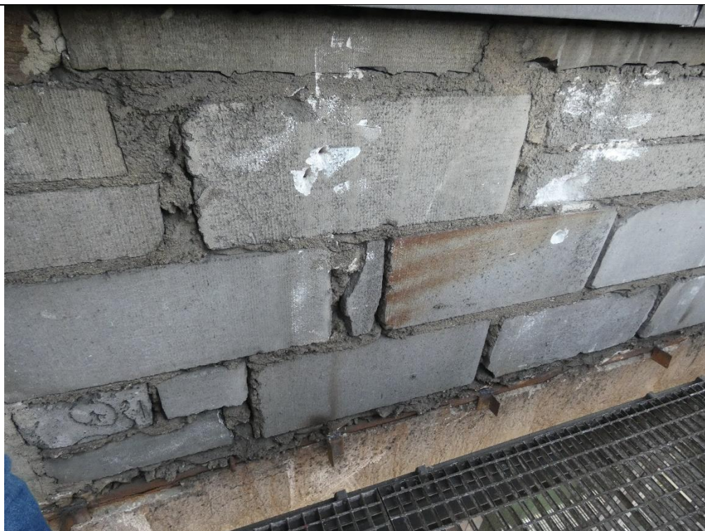
Fot. 4 Przykład ściany murowanej o bardzo niskiej jakości wykonania (ściana z uszkodzonych elementów z betonu komórkowego o zróżnicowanych kształtach. Uszkodzenia i przerwy między elementami wypełnione zaprawą i gruzem)
