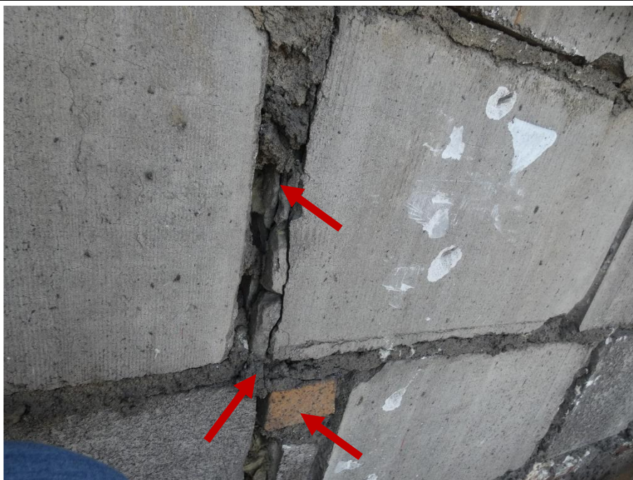
Fot. 24 Kondygnacja 10 (Poziom +38.40) Elewacja Północna – widok ściany murowanej w osiach 12-13/I. Zbyt duże wymiary spoin. Niewłaściwe przewiązanie elementów. Zwieńczenie ściany elementami murowym. Wypełnienie ubytków między elementami zaprawą i gruzem.
