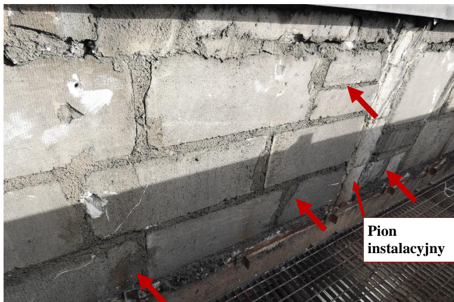
Fot. 59 Kondygnacja 10 (Poziom +38.40) Elewacja Południowa – widok ściany murowanej w osiach 12-13/E. Zbyt duże wymiary spoin. Wykonanie ściany z uszkodzonych elementów murowych o zróżnicowanych kształtach. Zwieńczenie ściany z uszkodzonych elementów murowych. Wypełnienie ubytków między elementami i uszkodzonych miejsc zaprawą. Zamknięcie pionu instalacyjnego.
