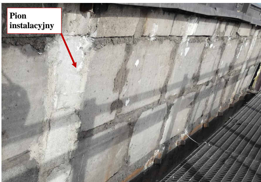
Fot. 13 Kondygnacja 10 (Poziom +38.40) Elewacja Wschodnia – widok ściany murowanej w osiach 14/E-F. Zbyt duże wymiary spoin. Wykonanie ściany z elementów murowych 36x60 cm. Zwieńczenie ściany elementami murowymi 12x60 cm. Wypełnienie ubytków między elementami zaprawą. Zamknięcie pionu instalacyjnego.
