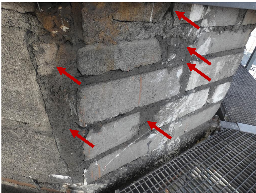
Fot. 20 Kondygnacja 10 (Poziom +38.40) Elewacja Wschodnia – widok ściany murowanej w osiach 14/I. Zbyt duże wymiary spoin. Niewłaściwe przewiązanie elementów. Wykonanie ściany z uszkodzonych elementów murowych 18x60 cm. Zwieńczenie ściany uszkodzonymi elementami murowymi 12x60 cm. Wypełnienie ubytków między elementami zaprawą i gruzem
