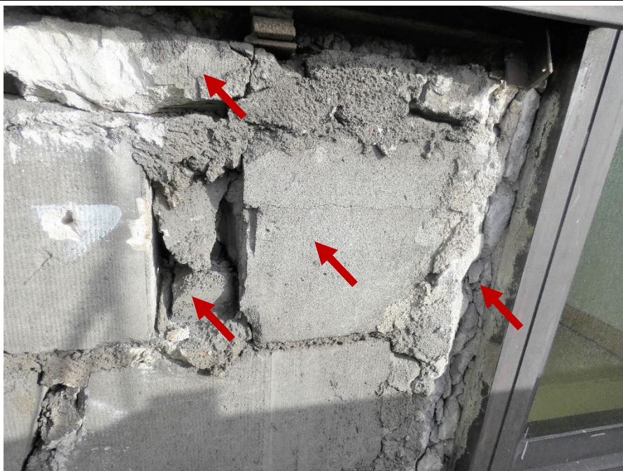
Fot. 54 Kondygnacja 10 (Poziom +38.40) Elewacja Południowa – widok ściany murowanej w osiach 10-11/E. Zbyt duże wymiary spoin. Zwieńczenie ściany uszkodzonymi elementami murowymi i gruzem. Wypełnienie ubytków między elementami zaprawą i gruzem
