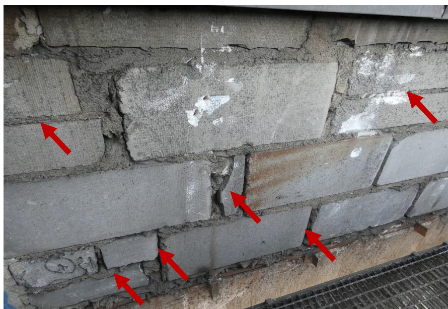
Fot. 47 Kondygnacja 10 (Poziom +38.40) Elewacja Zachodnia – widok ściany murowanej w osiach 10/E-F. Zbyt duże wymiary spoin. Ubytki spoin pionowych. Wykonanie i zwieńczenie ściany z uszkodzonych elementów murowanych o zróżnicowanych kształtach. Wypełnienie ubytków między elementami i uszkodzonych miejsc zaprawą i gruzem. \
