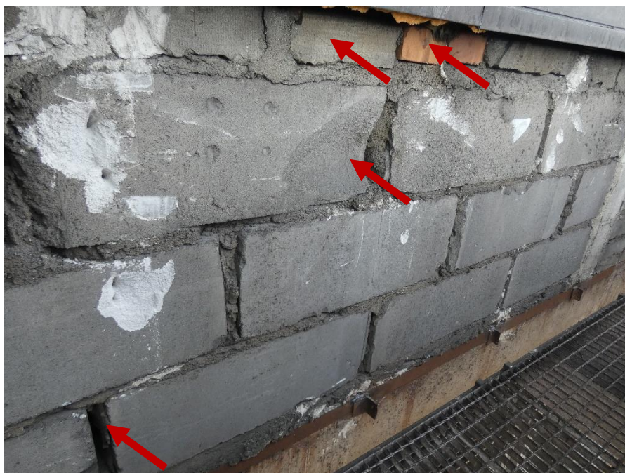
Fot. 41 Kondygnacja 10 (Poziom +38.40) Elewacja Zachodnia – widok ściany murowanej w osiach 10/G-H. Zbyt duże wymiary spoin. Ubytki spoin pionowych. Wykonanie ściany z uszkodzonych elementów murowych 24x60 cm. Zwieńczenie ściany z uszkodzonych elementów murowych o zróżnicowanych materiałach. Wypełnienie ubytków między elementami zaprawą.
