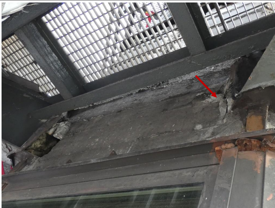
Fot. 105 Kondygnacja 10 (Poziom +38.40) Elewacja Zachodnia – belka w osiach 10/E.
