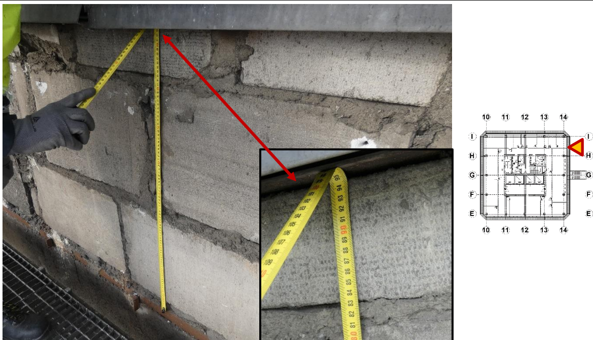
Fot. 18 Kondygnacja 10 (Poziom +38.40) Elewacja Wschodnia – widok ściany murowanej w osiach 14/H-I. Wysokość ściany murowanej ~95 cm. Grubość podlewki między belką żelbetową a ścianą ~6 cm. Element murowy bezpośrednio pod profilem stalowym (brak podlewki).
