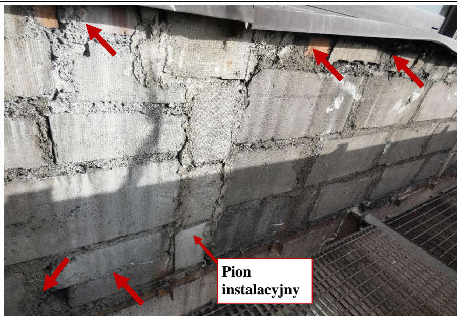
Fot. 58 Kondygnacja 10 (Poziom +38.40) Elewacja Południowa – widok ściany murowanej w osiach 12-13/E. Zbyt duże wymiary spoin. Wykonanie ściany z uszkodzonych elementów murowych o zróżnicowanych kształtach. Zwieńczenie ściany z uszkodzonych elementów murowych o zróżnicowanych materiałach. Wypełnienie ubytków między elementami i uszkodzonych miejsc zaprawą i gruzem Zamknięcie pionu instalacyjnego.
