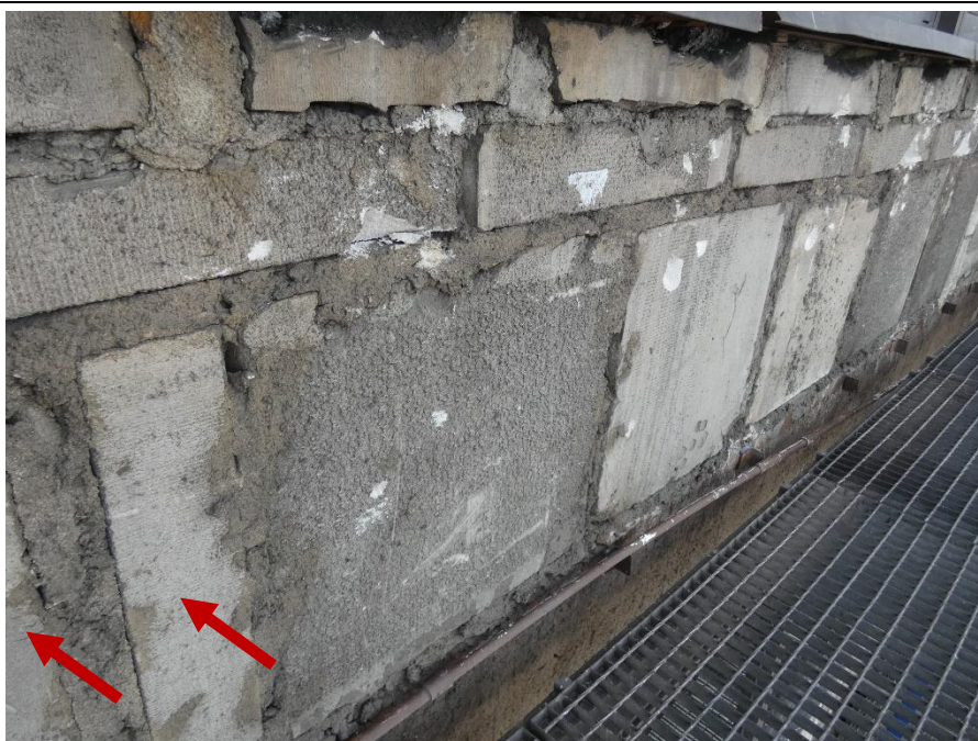
Fot. 30 Kondygnacja 10 (Poziom +38.40) Elewacja Północna – widok ściany murowanej w osiach 11-12/I. Zbyt duże wymiary spoin. Wykonanie ściany z uszkodzonych elementów murowych o zróżnicowanych kształtach (12x60, 60x60 cm) i złym kierunku ułożenia. Zwieńczenie ściany uszkodzonymi elementami murowymi. Wypełnienie ubytków między elementami i uszkodzonych miejsc zaprawą.
