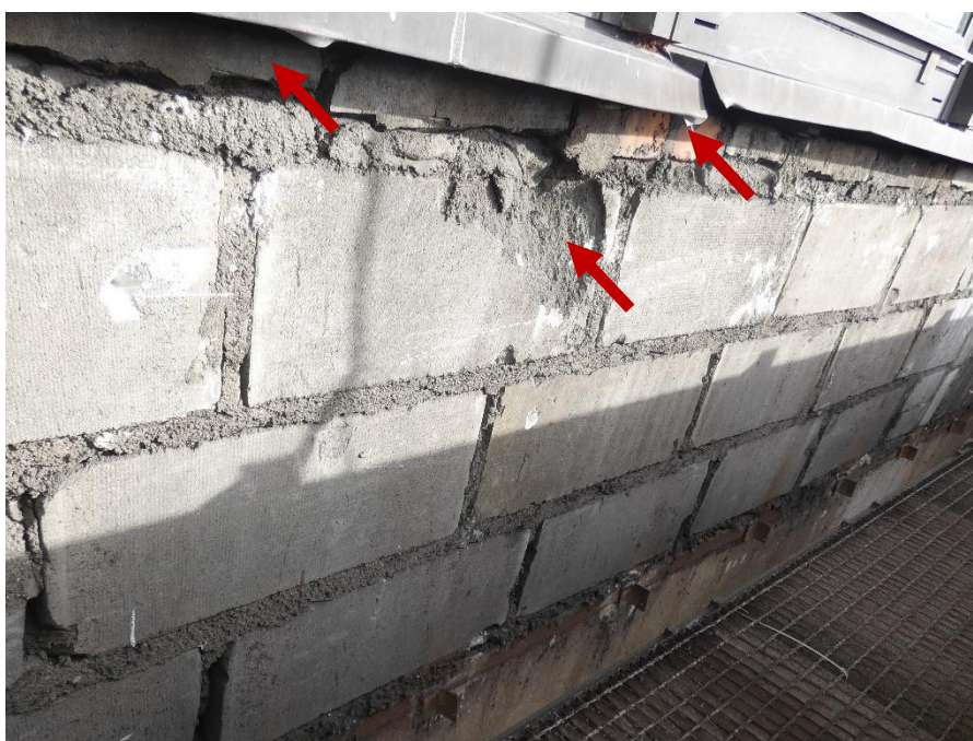
Fot. 57 Kondygnacja 10 (Poziom +38.40) Elewacja Południowa – widok ściany murowanej w osiach 11-12/E. Zbyt duże wymiary spoin. Wykonanie ściany z uszkodzonych elementów murowych 24x60 cm. Zwieńczenie ściany z uszkodzonych elementów murowych o zróżnicowanych materiałach. Wypełnienie ubytków między elementami zaprawą.
