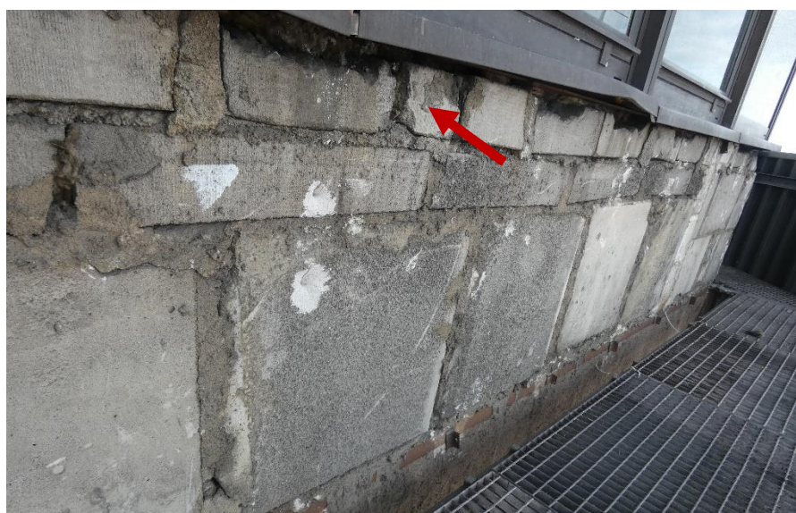
Fot. 33 Kondygnacja 10 (Poziom +38.40) Elewacja Północna – widok ściany murowanej w osiach 10-11/I. Zbyt duże wymiary spoin. Wykonanie ściany z elementów murowych o zróżnicowanych kształtach. Zwieńczenie ściany uszkodzonymi elementami murowymi. Wypełnienie ubytków między elementami i uszkodzonych miejsc zaprawą.
