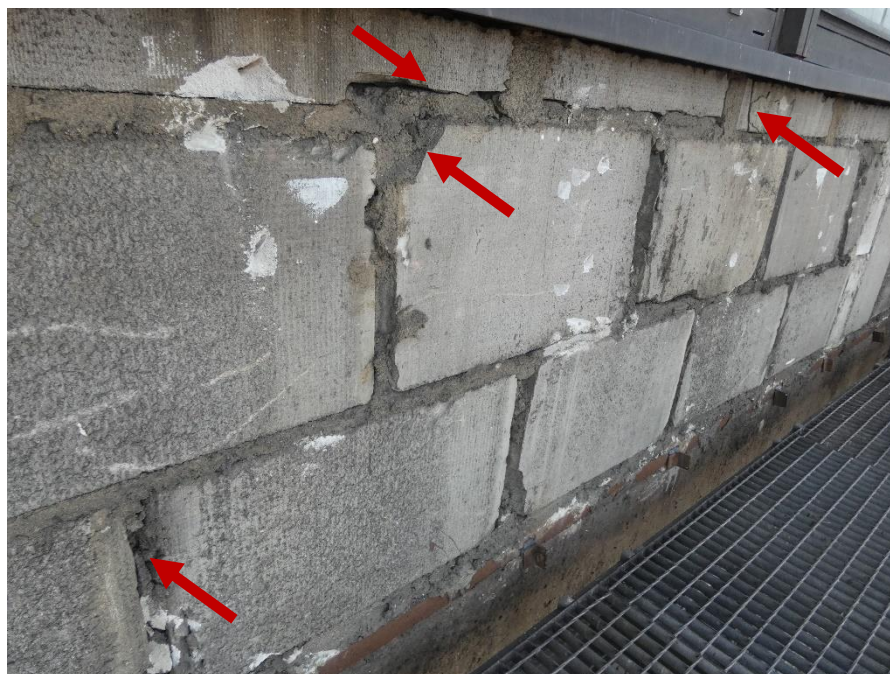
Fot. 27 Kondygnacja 10 (Poziom +38.40) Elewacja Północna – widok ściany murowanej w osiach 12-13/I. Zbyt duże wymiary spoin. Ubytki spoin pionowych. Spękania elementów murowych. Wykonanie i zwieńczenie ściany z uszkodzonych elementów murowych. Wypełnienie ubytków między elementami zaprawą.
