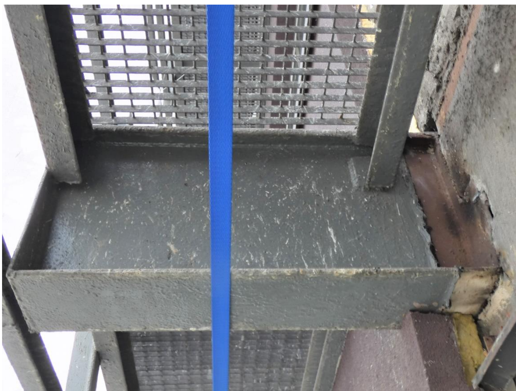
Fot. 125 Wspornik stalowy (widok z boku)
