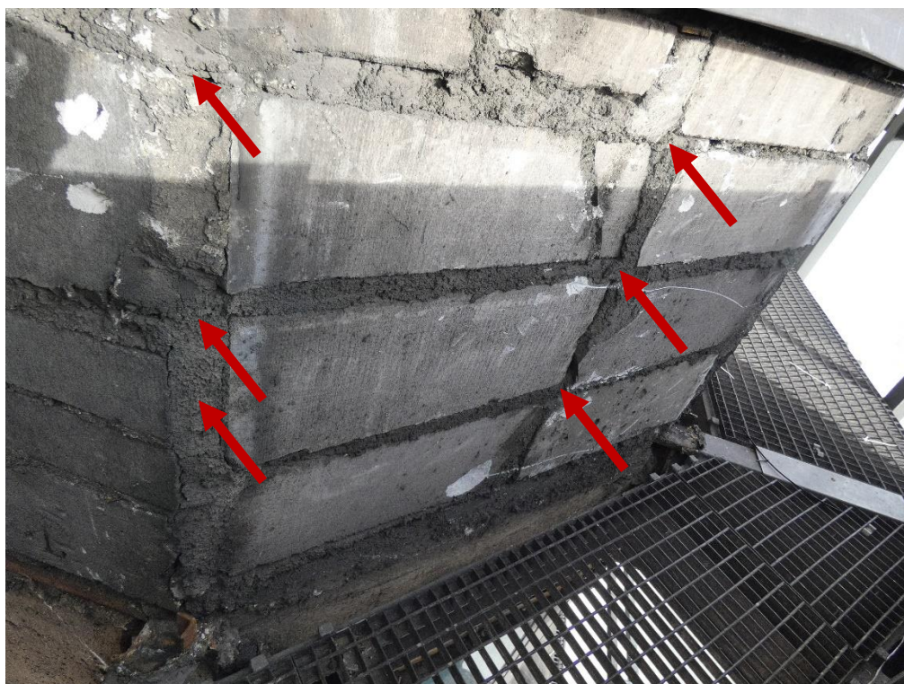
Fot. 5 Przykład ściany murowanej o bardzo niskiej jakości wykonania (wykonanie ściany z uszkodzonych i niewłaściwie przewiązanych elementów murowych)
