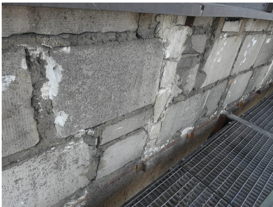
Fot. 3 Przykład ściany murowanej o bardzo niskiej jakości wykonania (ściana z uszkodzonych elementów z betonu komórkowego o zróżnicowanych kształtach. Uszkodzenia i przerwy między elementami wypełnione zaprawą i gruzem)
