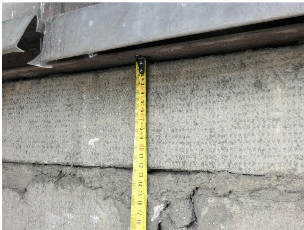
Fot. 7 Widok zwieńczenia ściany z elementów z betonu komórkowego bez podlewki pod profilem stalowym.
