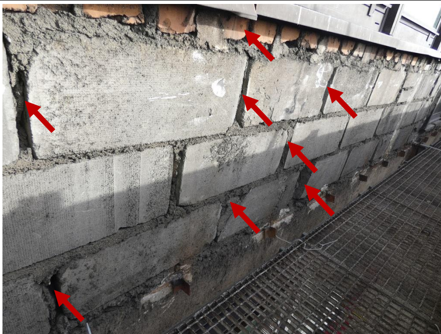
Fot. 52 Kondygnacja 10 (Poziom +38.40) Elewacja Południowa – widok ściany murowanej w osiach 10-11/E. Zbyt duże wymiary spoin. Ubytki spoin pionowych. Wykonanie ściany z uszkodzonych elementów murowych. Zwieńczenie ściany z uszkodzonych ceramicznych elementów murowych. Wypełnienie ubytków między elementami zaprawą i gruzem.
