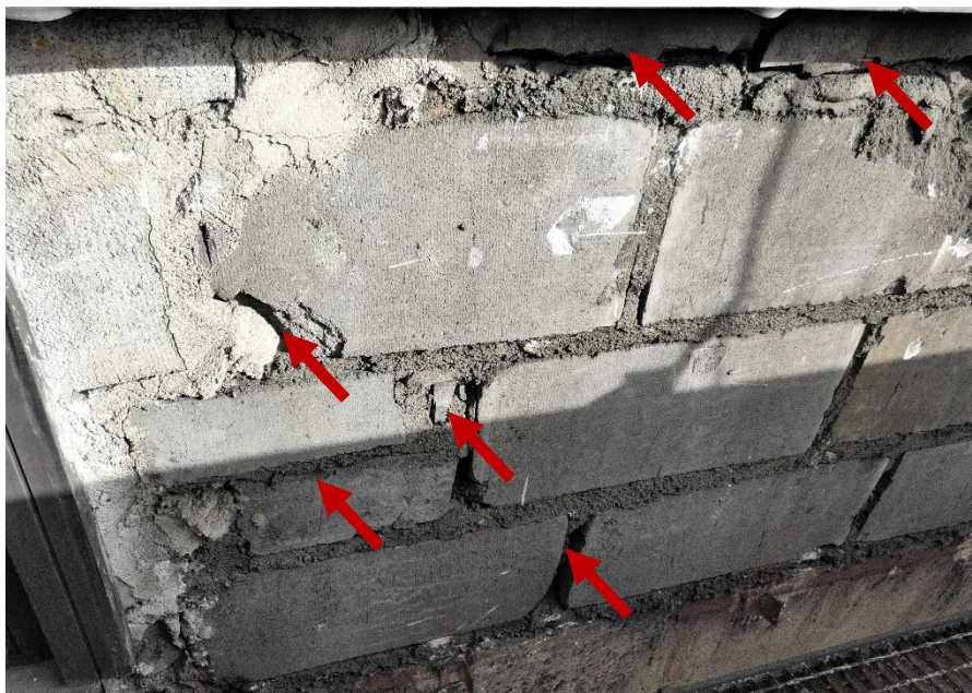
Fot. 56 Kondygnacja 10 (Poziom +38.40) Elewacja Południowa – widok ściany murowanej w osiach 11-12/E. Zbyt duże wymiary spoin. Ubytki spoin pionowych. Wykonanie i zwieńczenie ściany z uszkodzonych elementów murowych. Wypełnienie ubytków między elementami zaprawą i gruzem.
