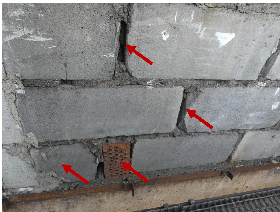
Fot. 40 Kondygnacja 10 (Poziom +38.40) Elewacja Zachodnia – widok ściany murowanej w osiach 10/G-H. Zbyt duże wymiary spoin. Ubytki spoin pionowych. Wykonanie ściany z uszkodzonych elementów murowych o zróżnicowanych kształtach i materiałach.
