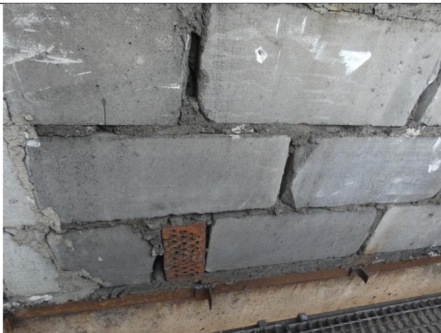
Fot. 2 Przykład ściany murowanej o bardzo niskiej jakości wykonania (ściana z elementów o zróżnicowanych kształtach i materiałach z licznymi ubytkami spoin pionowych)
