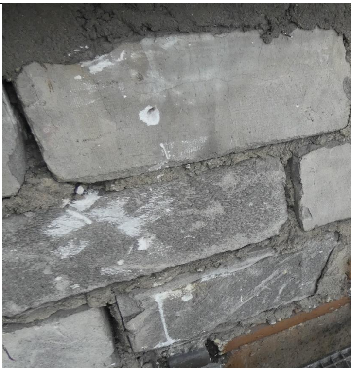
Fot. 2 Przykładowe ubytki zaprawy w spinach pionowych
