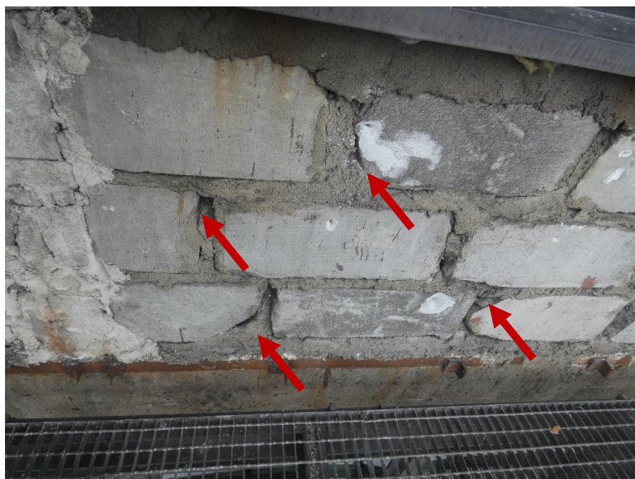
Fot. 26 Kondygnacja 14 (Poziom +51.60) Elewacja Północna – widok ściany murowanej w osiach 11-12/I. Zbyt duże wymiary spoin. Ubytki spoin pionowych. Wykonanie ściany z uszkodzonych elementów murowych. Wypełnienie ubytków między elementami i uszkodzonych miejsc zaprawą.
