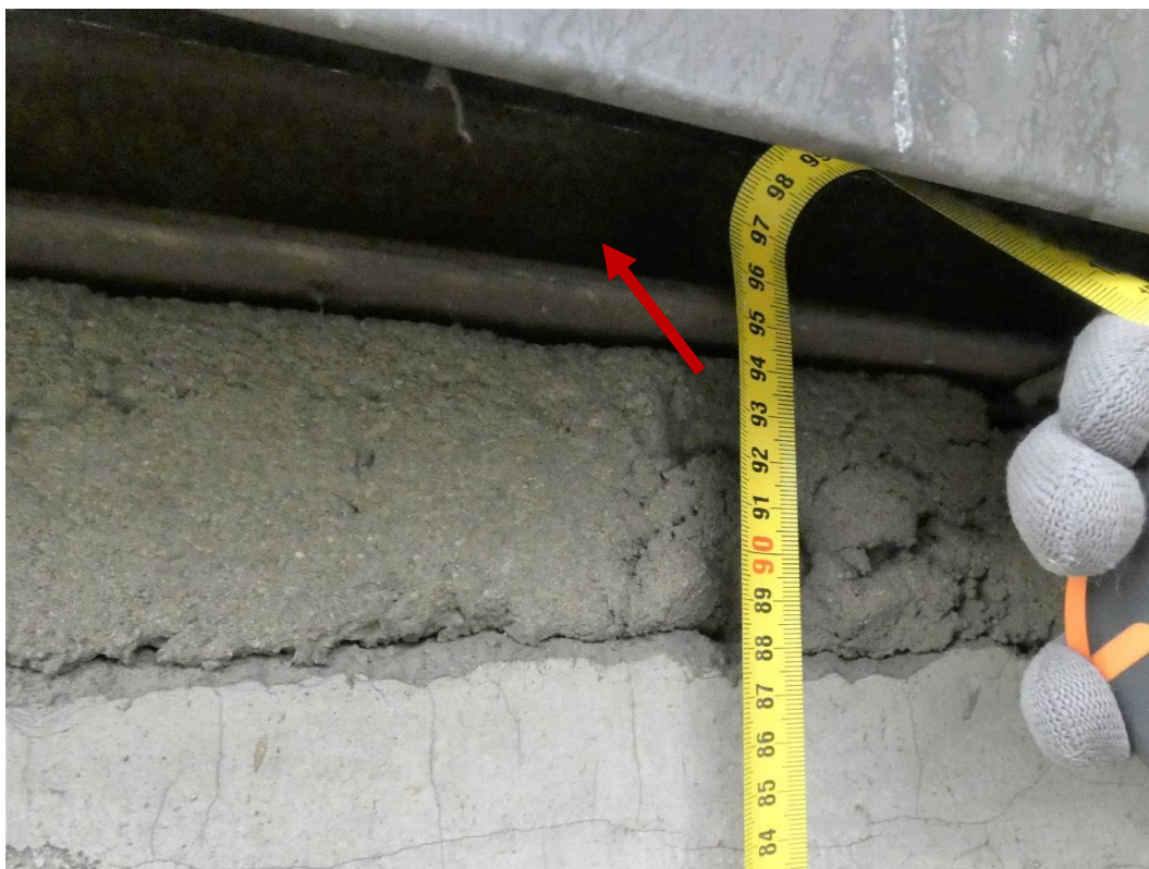
Fot. 7 Widok zwieńczenia ściany z elementów z betonu komórkowego z podlewką wyrównującą gr. 6 cm pod profilem stalowym
