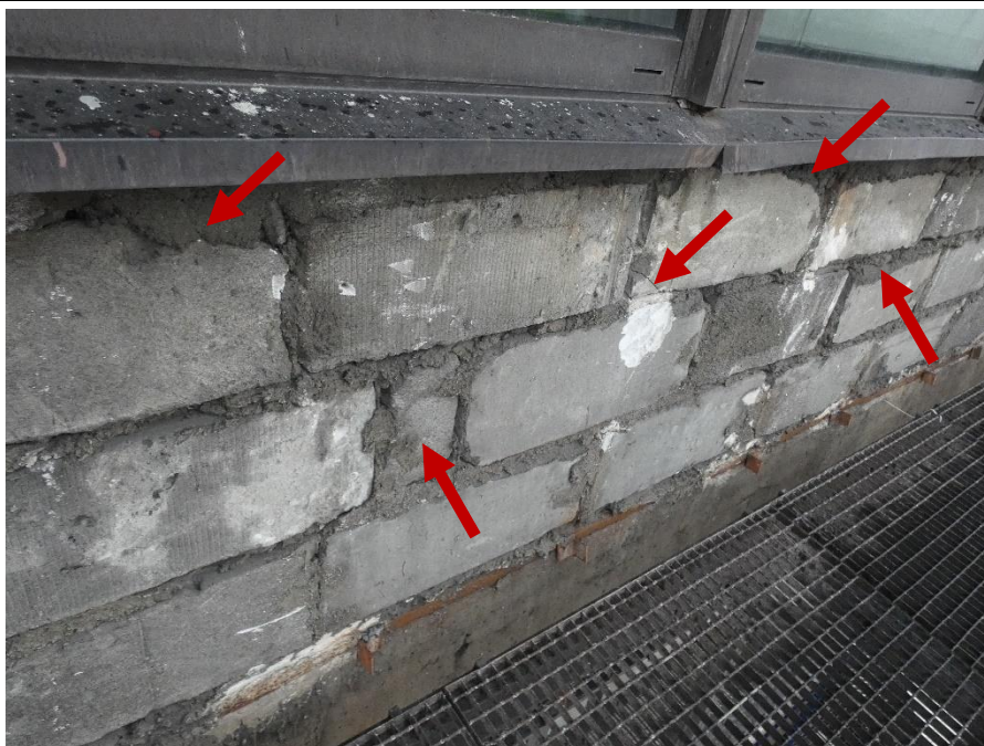
Fot. 55 Kondygnacja 14 (Poziom +51.60) Elewacja Południowa – widok ściany murowanej w osiach 13-14/E. Zbyt duże wymiary spoin. Wykonanie ściany z uszkodzonych elementów murowych. Spękania elementów murowych Wypełnienie ubytków między elementami i uszkodzonych miejsc zaprawą i niewymiarnymi elementami murowymi. Zamknięcie pionu instalacyjnego.
