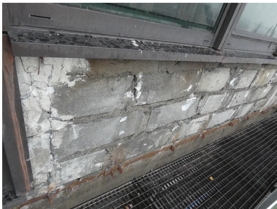
Fot. 48 Kondygnacja 14 (Poziom +51.60) Elewacja Południowa – widok ściany murowanej w osiach 11-12/E. Zbyt duże wymiary spoin.
