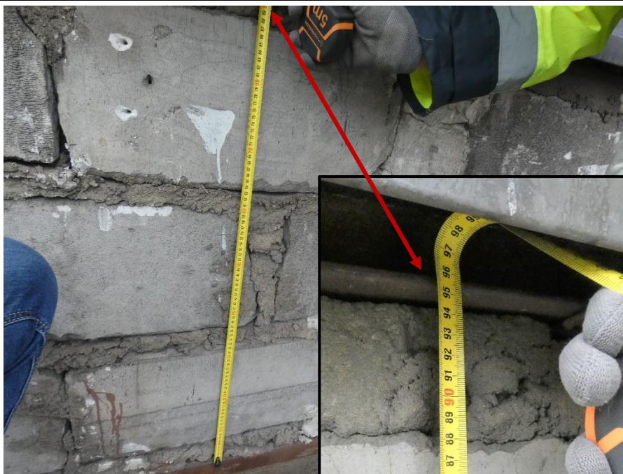
Fot. 19 Kondygnacja 14 (Poziom +51.60) Elewacja Północna – widok ściany murowanej w osiach 13-14/I. Wysokość ściany murowanej ~97 cm. Grubość podlewki między belką żelbetową a ścianą ~7,0 cm. Grubość podlewki między ścianą a profilem okiennym ~6,0 cm
