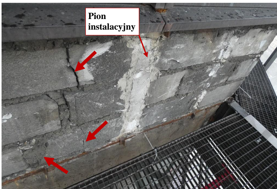
Fot. 56 Kondygnacja 14 (Poziom +51.60) Elewacja Południowa – widok ściany murowanej w osiach 13-14/E. Zbyt duże wymiary spoin. Wykonanie ściany z uszkodzonych elementów murowych. Spękania i zarysowania elementów murowych. Wypełnienie ubytków między elementami i uszkodzonych miejsc zaprawą. Zamknięcie pionu instalacyjnego.
