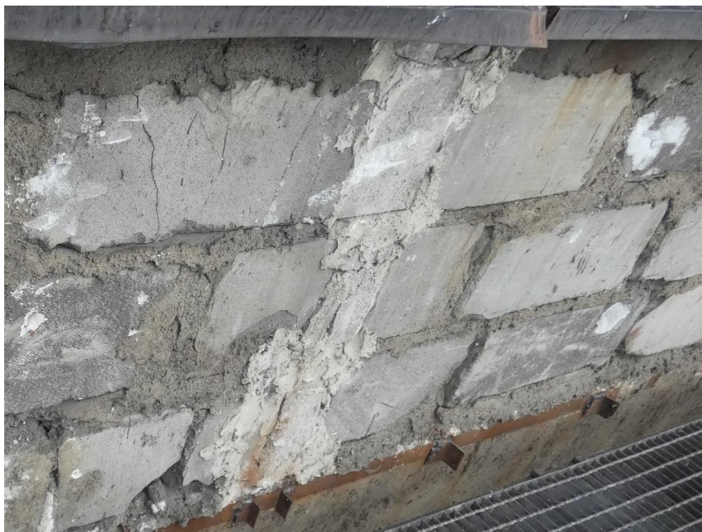
Fot. 10 Widok pionu instalacyjnego zamkniętego elementami murowymi, zaprawą i gruzem
