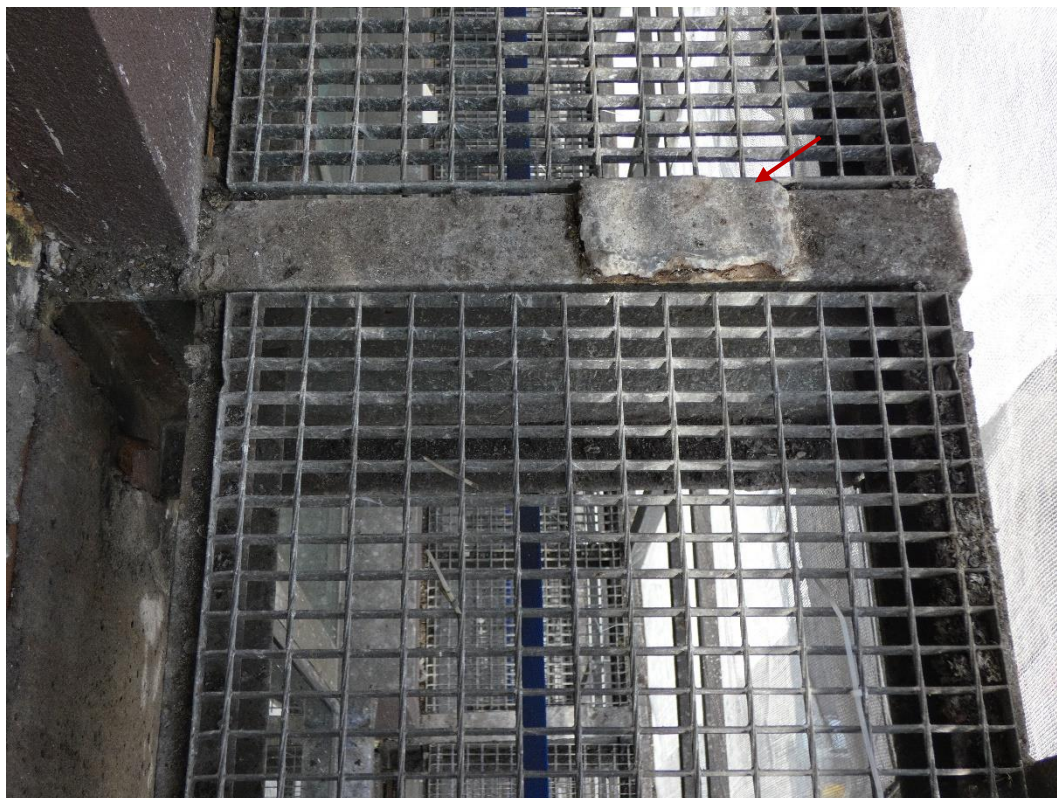
Fot. 111 Pozostałości po drabinie ewakuacyjnej w osi 14/F (widok z góry)
