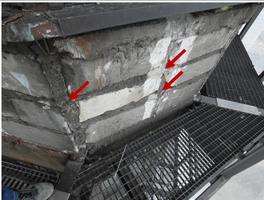
Fot. 57 Kondygnacja 14 (Poziom +51.60) Elewacja Południowa – widok ściany murowanej w osiach 14/E. Zbyt duże wymiary spoin. Niewłaściwe przewiązania elementów. Wypełnienie ubytków między elementami zaprawą.
