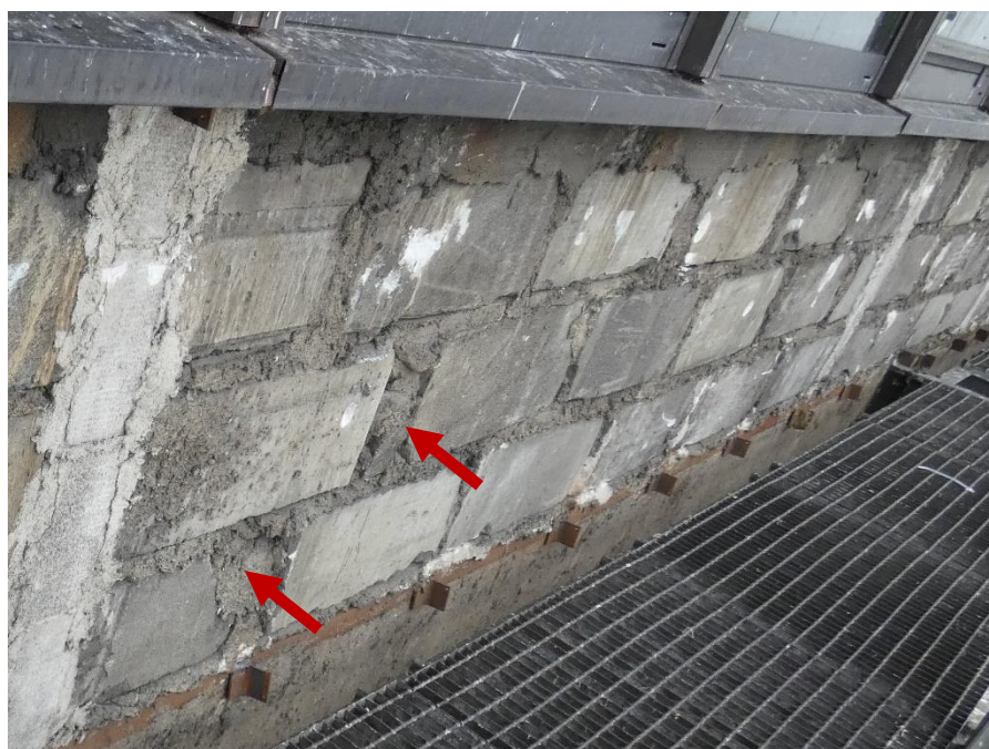
Fot. 40 Kondygnacja 14 (Poziom +51.60) Elewacja Zachodnia – widok ściany murowanej w osiach 10/F-G. Zbyt duże wymiary spoin. Wykonanie ściany z uszkodzonych elementów murowych. Wypełnienie ubytków między elementami i uszkodzonych miejsc zaprawą i gruzem.
