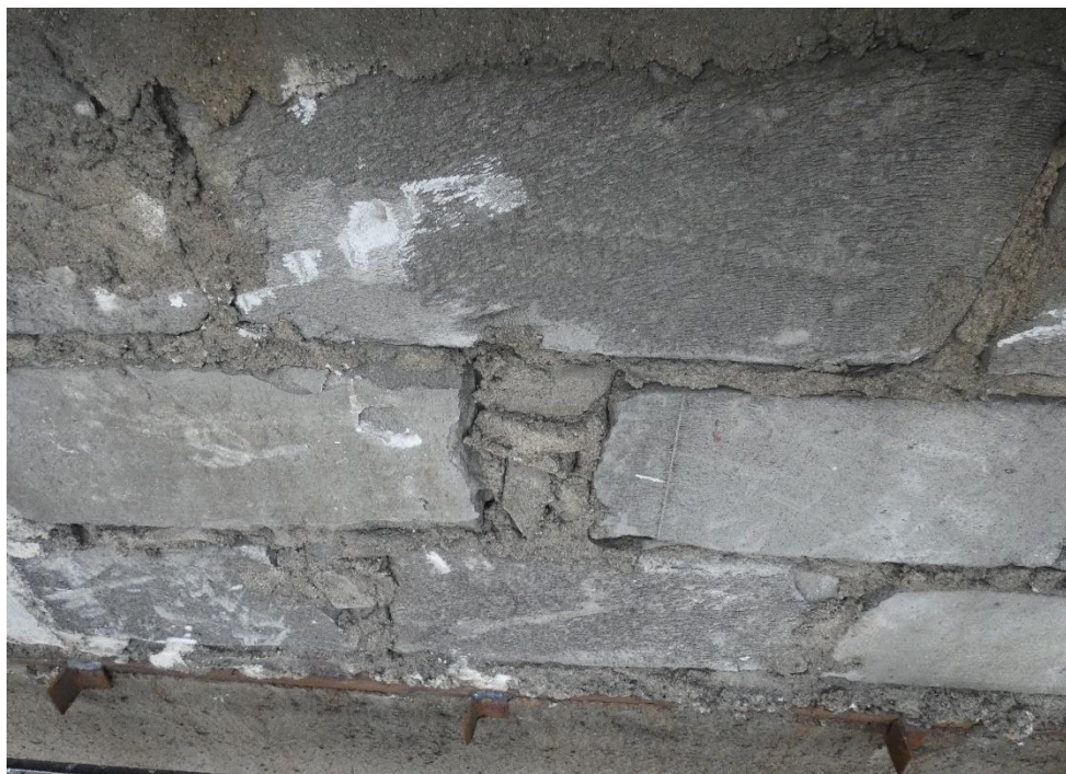
Fot. 3 Przykład ściany murowanej o bardzo niskiej jakości wykonania (wypełnienie przerwy między elementami gruzem zmieszanim z zaprawą)
