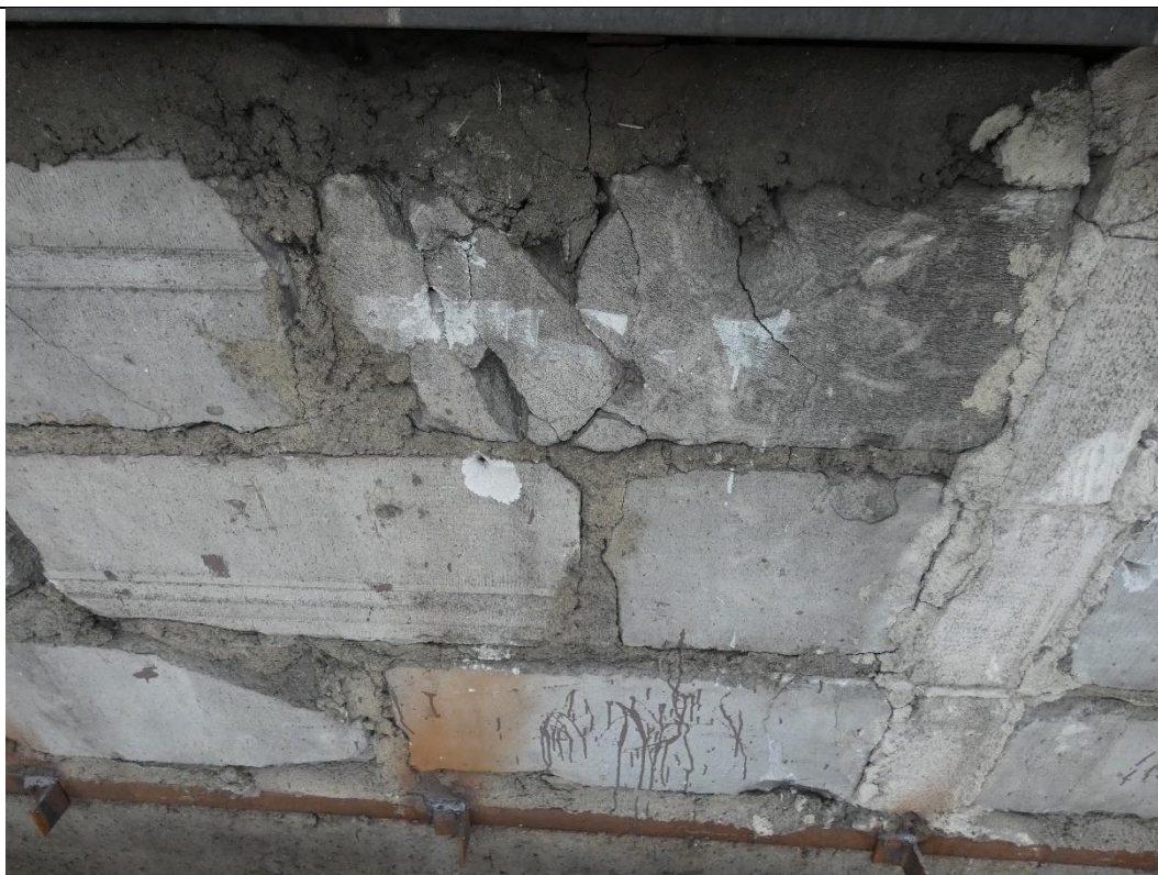
Fot. 4 Przykład ściany murowanej o bardzo niskiej jakości wykonania (użycie uszkodzonych elementów z wypełnieniem ubytków zaprawą)
