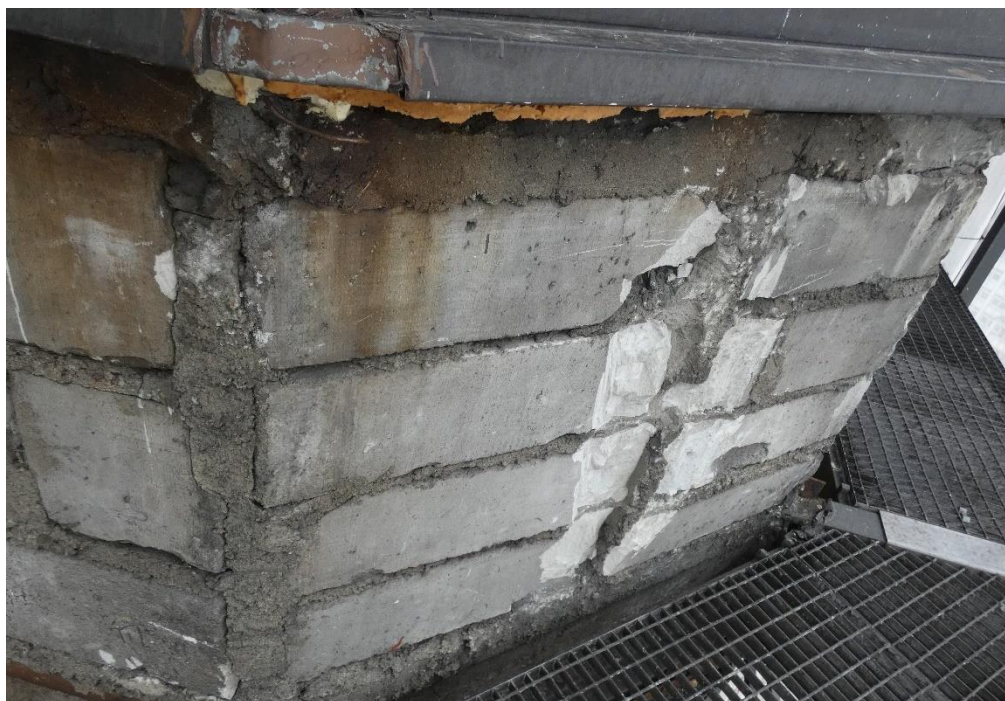
Fot. 5 Przykład ściany murowanej o bardzo niskiej jakości wykonania (użycie uszkodzonych elementów o zróżnicowanych kształtach oraz braku przewiązania ściany murowanej)
