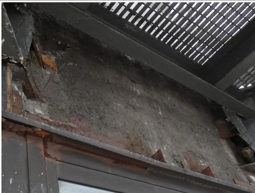
Fot. 79 Kondygnacja 14 (Poziom +51.60) Elewacja Północna – belka w osiach 10/I.
