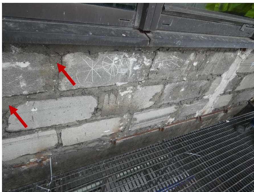
Fot. 12 Kondygnacja 14 (Poziom +51.60) Elewacja Wschodnia – widok ściany murowanej w osiach 14/E-F. Zbyt duże wymiary spoin. Wykonanie ściany z uszkodzonych elementów murowych. Ściana z elementów betonowych 24x60 cm Wypełnienie ubytków między elementami i uszkodzonych miejsc zaprawą.
