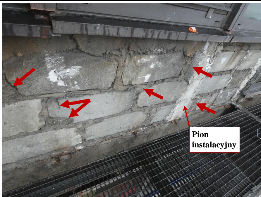
Fot. 47 Kondygnacja 14 (Poziom +51.60) Elewacja Południowa – widok ściany murowanej w osiach 10-11/E. Zbyt duże wymiary spoin. Wykonanie ściany z uszkodzonych elementów murowych. Wypełnienie ubytków między elementami i uszkodzonych miejsc zaprawą i niewymiarowymi elementami murowymi. Zamknięcie pionu instalacyjnego.
