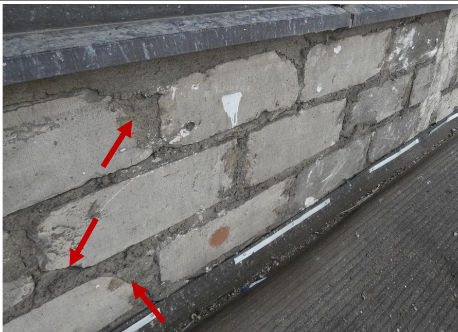
Fot. 15 Kondygnacja 14 (Poziom +51,60) Elewacja Wschodnia – widok ściany murowanej w osiach 14/H-I. Zbyt duże wymiary spoin. Wykonanie ściany z uszkodzonych elementów murowych. Wypełnienie ubytków między elementami i uszkodzonych miejsc zaprawą.
