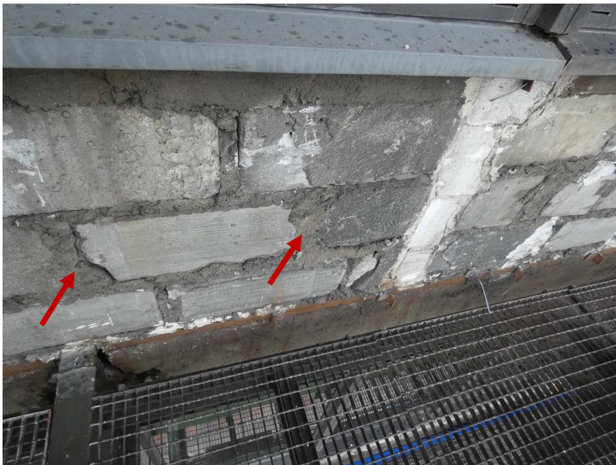
Fot. 6 Przykład ściany murowanej o bardzo niskiej jakości wykonania (wypełnienie ubytków między elementami zwiększoną ilością zaprawy, zbyt grube spoiny pionowe)
