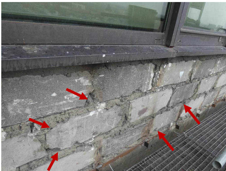
Fot. 20 Kondygnacja 14 (Poziom +51.60) Elewacja Północna – widok ściany murowanej w osiach 13-14/I. Zbyt duże wymiary spoin. Wykonanie ściany z uszkodzonych elementów murowych. Wypełnienie ubytków między elementami i uszkodzonych miejsc zaprawą.
