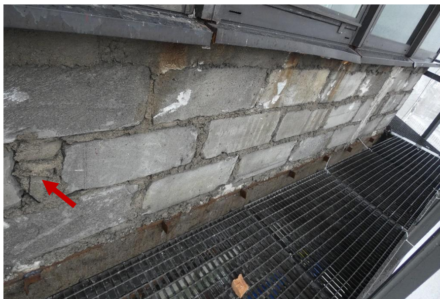
Fot. 42 Kondygnacja 14 (Poziom +51.60) Elewacja Zachodnia – widok ściany murowanej w osiach 10/E-F. Zbyt duże wymiary spoin. Wypełnienie ubytków między elementami zaprawą i gruzem.
