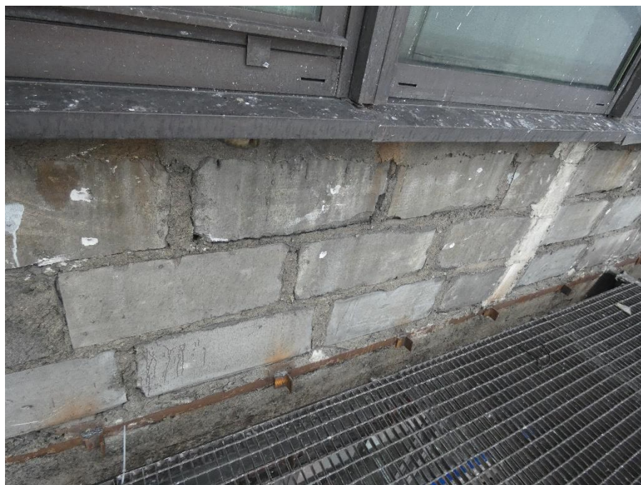
Fot. 34 Kondygnacja 14 (Poziom +51.60) Elewacja Zachodnia – widok ściany murowanej w osiach 10/H-I. Zbyt duże wymiary spoin.
