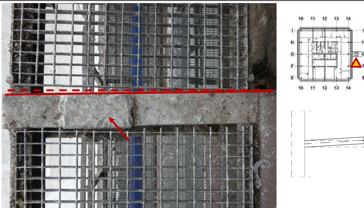
Fot. 120 Kondygnacja 13 (Poziom +48.30) Elewacja Wschodnia – wspornik w osiach 14/F (widok z góry) Pozostałości po usuniętej drabinie ewakuacyjnej. Przemieszczenie wspornika w kierunku osi G. Brak widocznych uszkodzeń wspornika.
