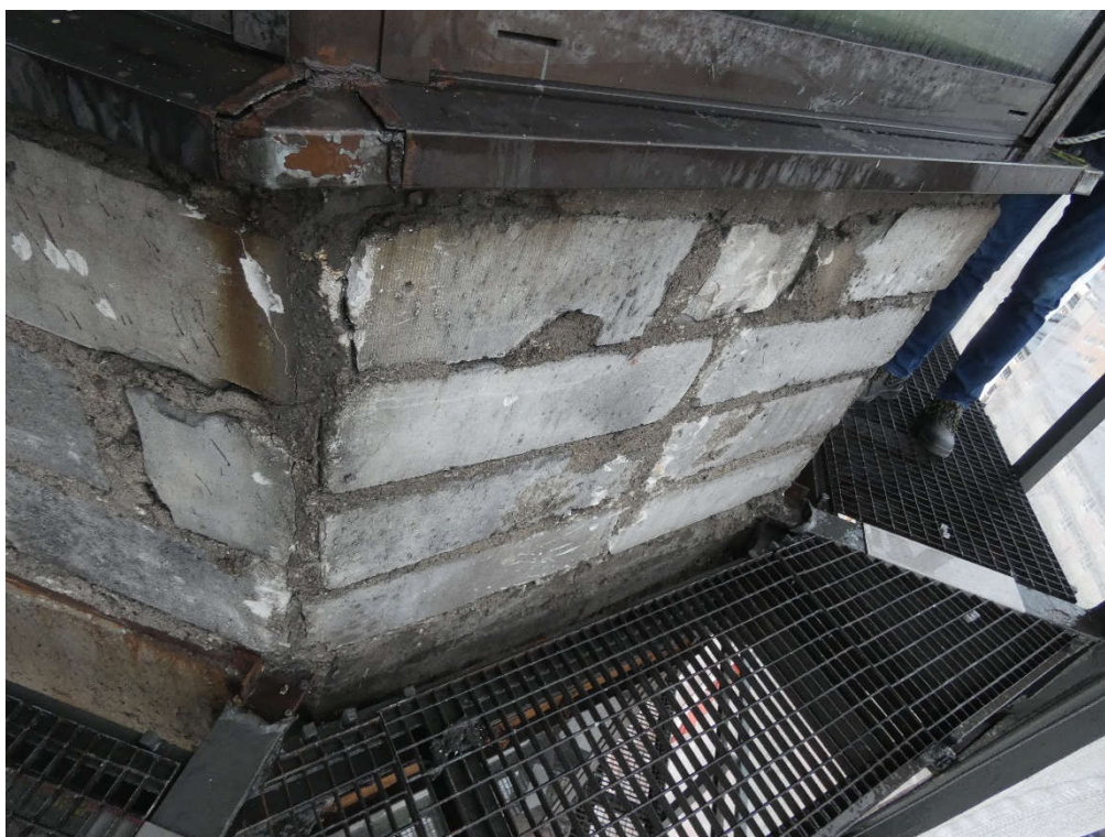
Fot. 5 Przykład ściany murowanej o bardzo niskiej jakości wykonania (użycie uszkodzonych elementów o zróżnicowanych kształtach oraz braku przewiązania ściany murowanej)
