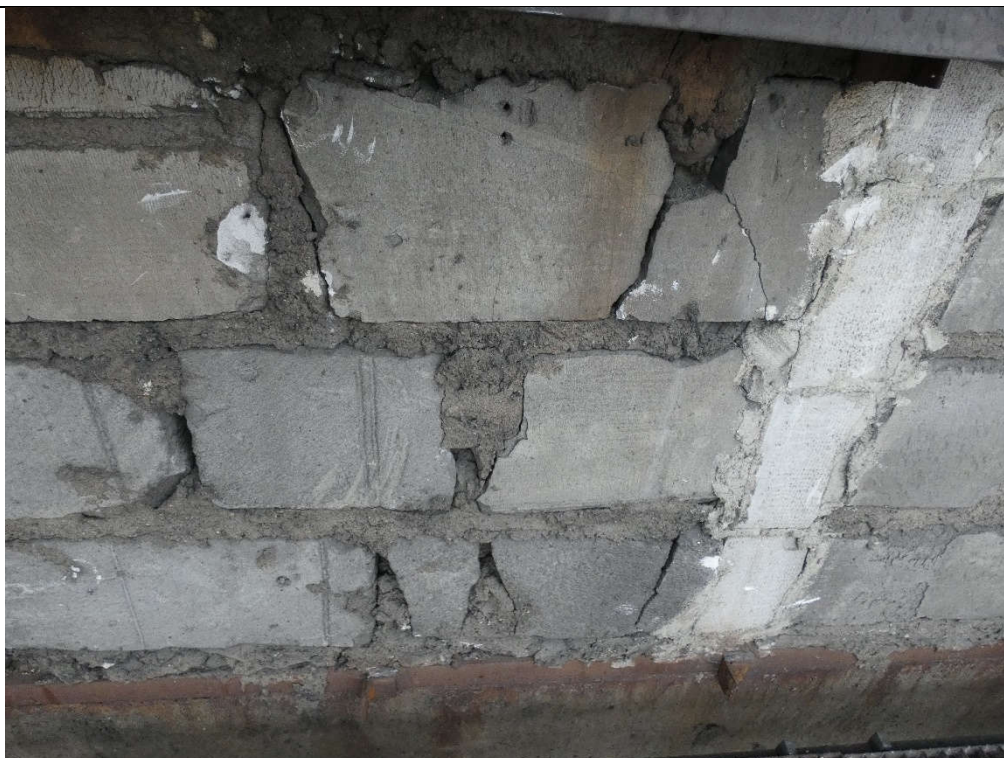
Fot. 4 Przykład ściany murowanej o bardzo niskiej jakości wykonania (użycie uszkodzonych elementów z wypełnieniem ubytków zaprawą i gruzem)
