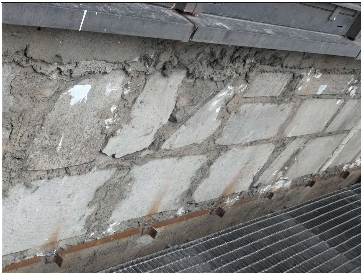
Fot. 7 Przykład ściany murowanej bardzo niskiej jakości niespełniającej żadnych kryteriów konstrukcji murowej (połączenie elementów z betonu komórkowego o wysokości 18,24 i 36cm, część elementów uszkodzonych, uszkodzenia wypełnione zaprawą i gruzem)
