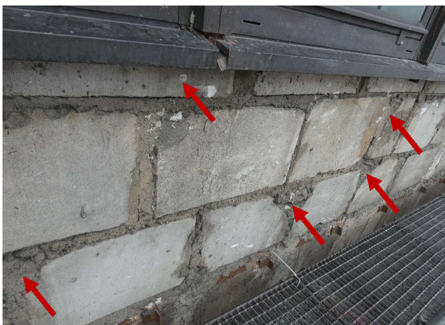
Fot. 24 Kondygnacja 13 (Poziom +48.30) Elewacja Północna – widok ściany murowanej w osiach 13-14/I. Zbyt duże wymiary spoin. Niewłaściwe przewiązanie elementów. Wykonanie ściany z uszkodzonych elementów murowanych o zróżnicowanych kształtach. Zwieńczenie ściany elementami murowymi 12x60 cm. Wypełnienie ubytków między elementami zaprawą i gruzem.
