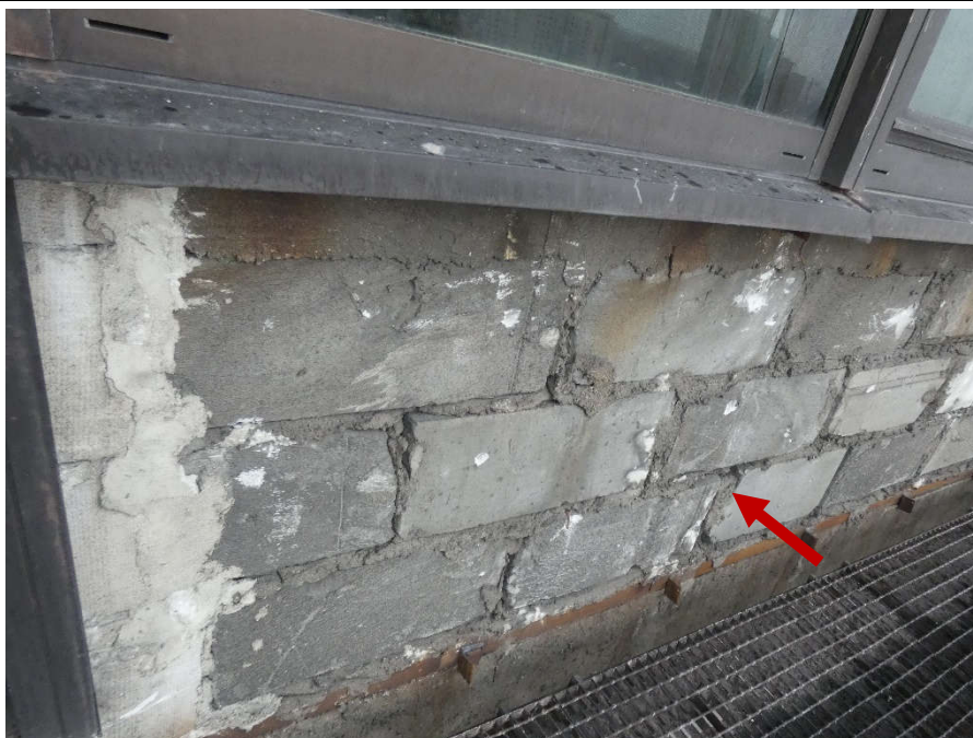
Fot. 53 Kondygnacja 13 (Poziom +48.30) Elewacja Południowa – widok ściany murowanej w osiach 11-12/E. Zbyt duże wymiary spoin. Wykonanie ściany z uszkodzonych elementów murowych 24x60 cm. Wypełnienie ubytków między elementami i uszkodzonych miejsc zaprawą. Zwieńczenie ściany podlewką.
