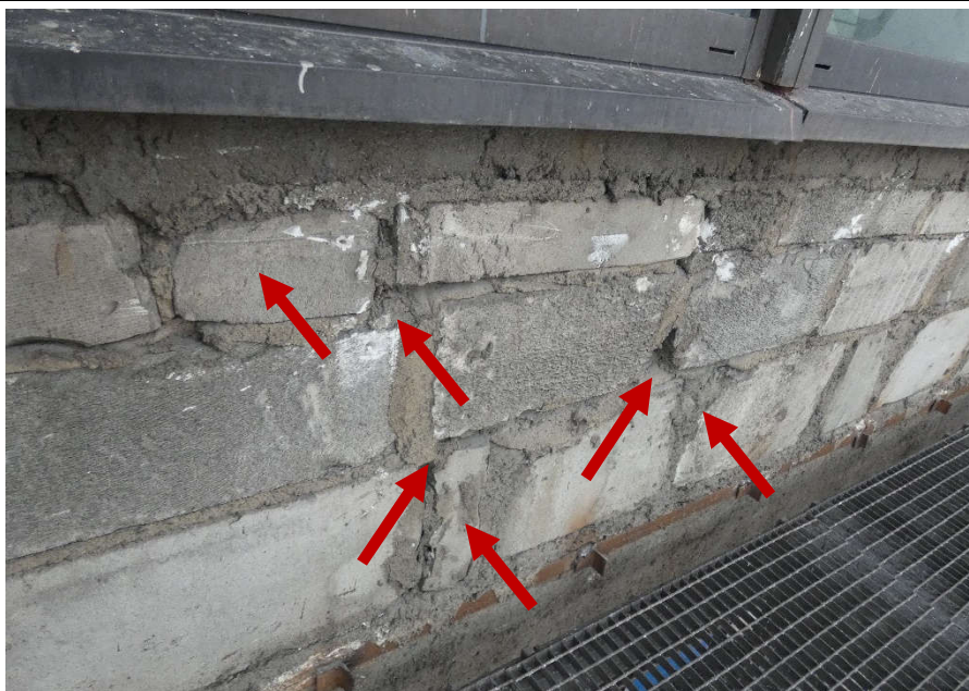
Fot. 31 Kondygnacja 13 (Poziom +48.30) Elewacja Północna – widok ściany murowanej w osiach 11-12/I. Zbyt duże wymiary spoin. Niewłaściwe przewiązanie elementów. Wykonanie ściany z uszkodzonych elementów murowych o zróżnicowanych kształtach. Wypełnienie ubytków między elementami i uszkodzonych miejsc zaprawą i gruzem. Zwieńczenie ściany podlewką.
