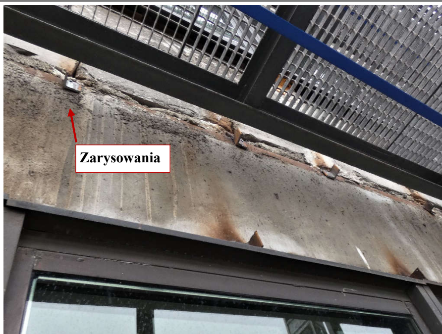
Fot. 70 Kondygnacja 1`3 (Poziom +48.30) Elewacja Północna – belka w osiach 13-14/I. Zarysowanie belki w przęśle na wysokości miejsca oparcia.
