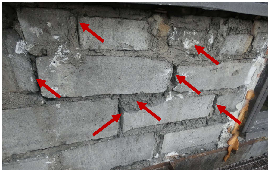
Fot. 57 Kondygnacja 13 (Poziom +48.30) Elewacja Południowa – widok ściany murowanej w osiach 12-13/E. Zbyt duże wymiary oraz ubytki spoin pionowych. Wykonanie ściany z uszkodzonych elementów murowych. Wypełnienie ubytków między elementami i uszkodzonych miejsc zaprawą i gruzem. Zwieńczenie ściany elementami murowymi oraz nieregularną podlewką.
