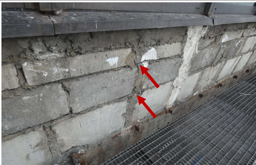
Fot. 33 Kondygnacja 13 (Poziom +48.30) Elewacja Północna – widok ściany murowanej w osiach 10-11/I. Zbyt duże wymiary spoin. Niewłaściwe przewiązanie elementów. Wykonanie ściany z uszkodzonych elementów murowych o zróżnicowanych kształtach. Wypełnienie ubytków między elementami i uszkodzonych miejsc zaprawą i gruzem. Zwieńczenie ściany podlewką.
