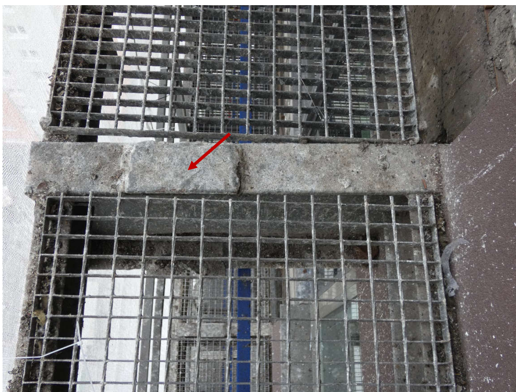
Fot. 115 Pozostałości po drabinie ewakuacyjnej w osi 14/F (widok z góry)
