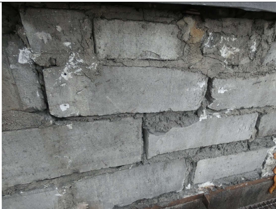
Fot. 2 Przykładowe ubytki zaprawy w spinach pionowych
