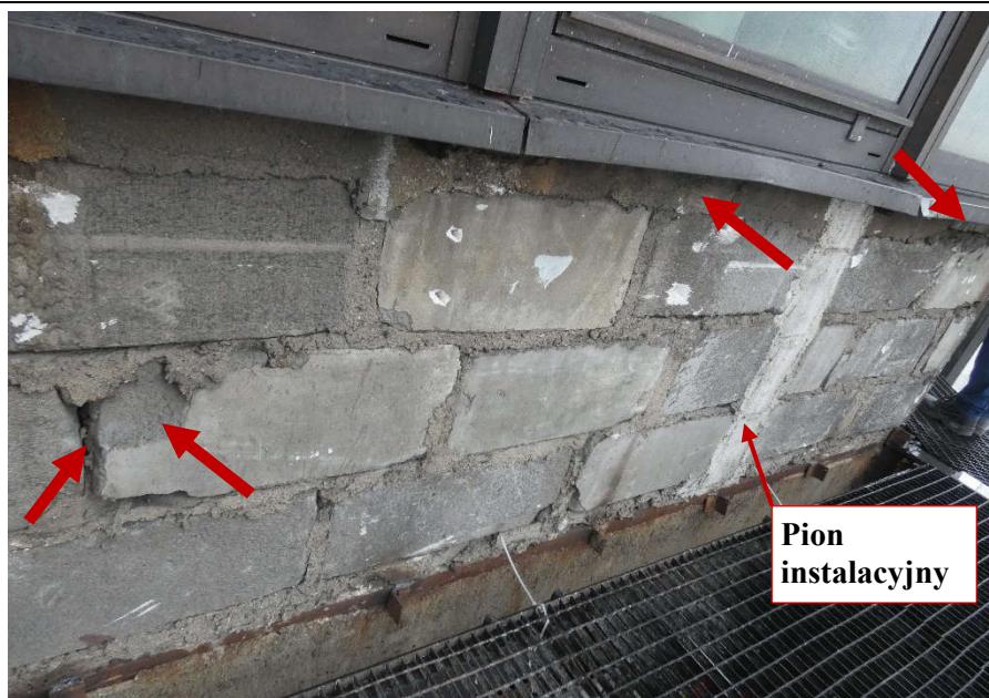
Fot. 47 Kondygnacja 13 (Poziom +48.30) Elewacja Zachodnia – widok ściany murowanej w osiach 10/E-F. Zbyt duże wymiary spoin. Ubytki spoin pionowych. Wykonanie ściany z uszkodzonych elementów murowych. Wypełnienie ubytków między elementami i uszkodzonych miejsc zaprawą. Zwieńczenie ściany podlewką i elementami murowymi. Zamknięcie pionu instalacyjnego.
