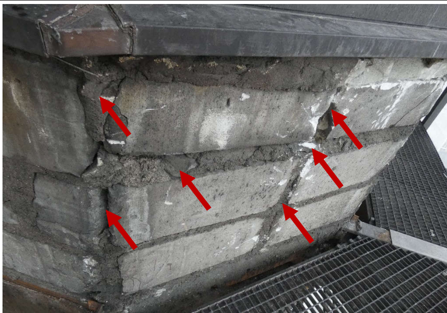
Fot. 61 Kondygnacja 13 (Poziom +48.30) Elewacja Południowa – widok ściany murowanej w osiach 14/E. Zbyt duże wymiary spoin. Ubytki spoin pionowych. Niewłaściwe przewiązanie elementów. Wykonanie ściany z uszkodzonych elementów murowych. Wypełnienie ubytków między elementami zaprawą i gruzem. Zwieńczenie ściany podlewką.
