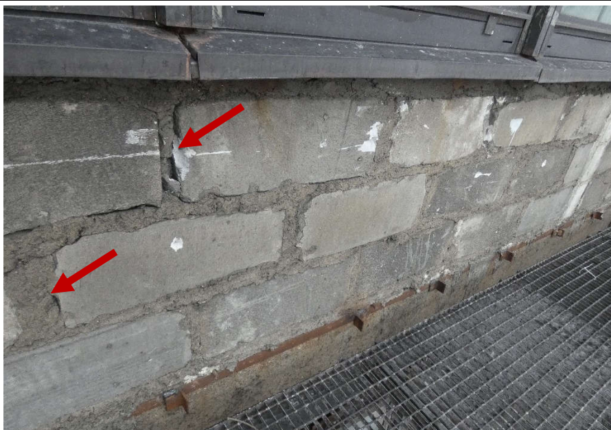
Fot. 41 Kondygnacja 13 (Poziom +48.30) Elewacja Zachodnia – widok ściany murowanej w osiach 10/G-H. Zbyt duże wymiary spoin. Ubytki spoin pionowych. Wypełnienie ubytków między elementami zaprawą. Zwieńczenie ściany podlewką.
