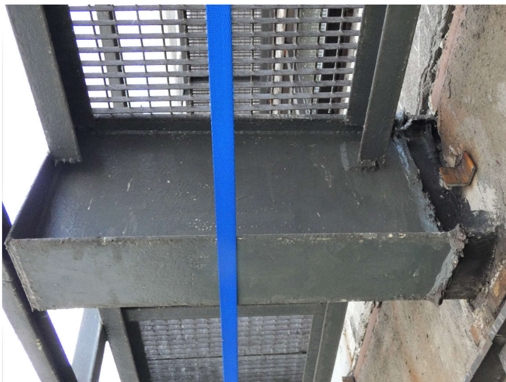
Fot. 113 Wspornik stalowy (widok z boku)
