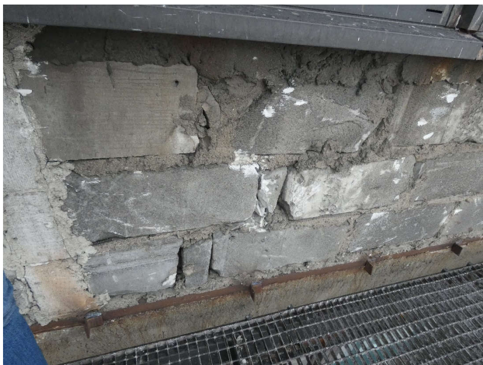
Fot. 3 Przykład ściany murowanej o bardzo niskiej jakości wykonania (wypełnienie przerwy między elementami zaprawą i gruzem)
