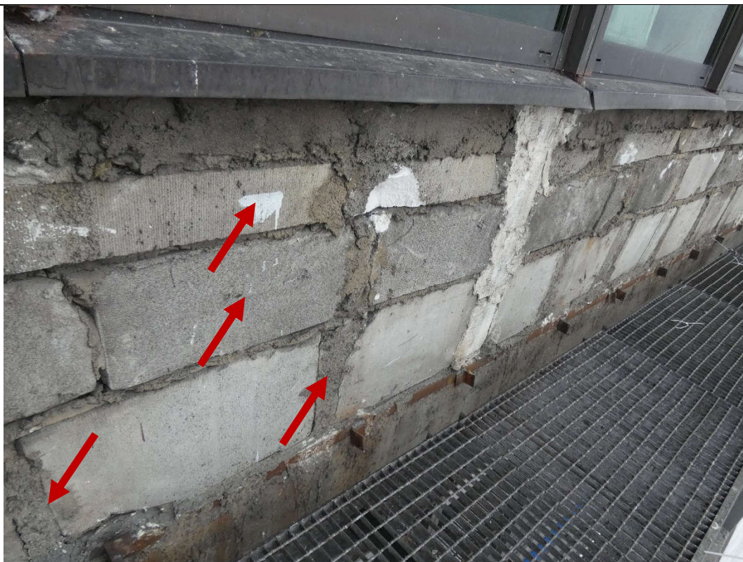
Fot. 6 Przykład ściany murowanej o bardzo niskiej jakości wykonania (zastosowanie elementów murowanych o zróżnicowanych kształtach, wypełnienie ubytków między elementami zwiększoną ilością zaprawy, zbyt grube spoiny pionowe, brak przewiązania ściany)
