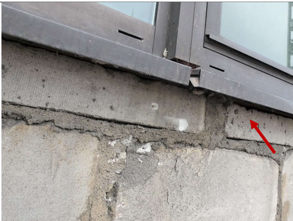
Fot. 9 Widok zwieńczenia ściany z elementów z betonu komórkowego bez podlewki pod profilem stalowym.
