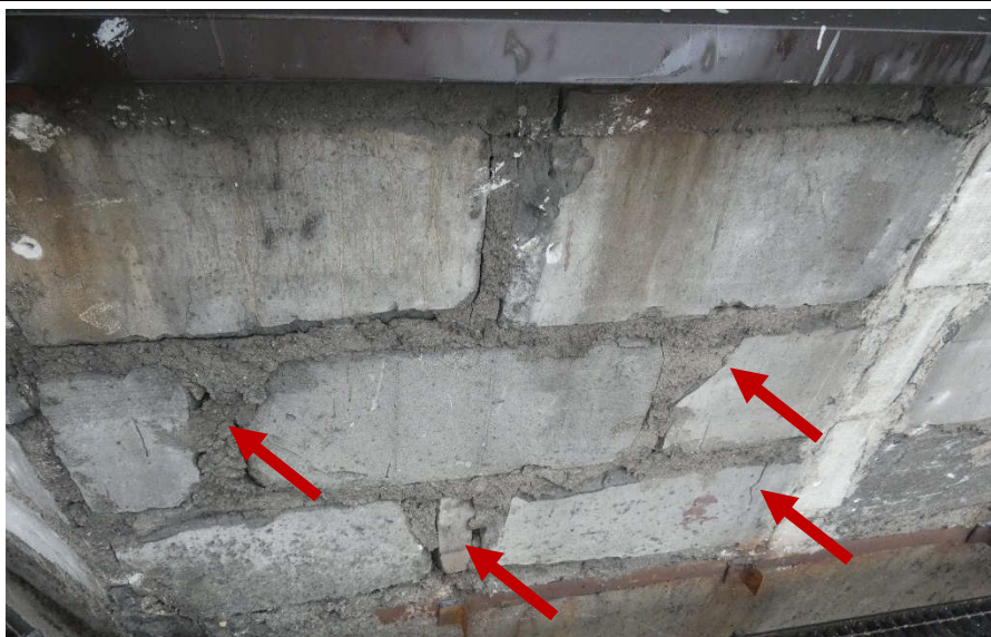
Fot. 49 Kondygnacja 13 (Poziom +48.30) Elewacja Południowa – widok ściany murowanej w osiach 10-11/E. Zbyt duże wymiary spoin. Spękania i zarysowania elementów murowych. Wykonanie ściany z uszkodzonych elementów murowych. Wypełnienie ubytków między elementami i uszkodzonych miejsc zaprawą i gruzem. Zwieńczenie ściany podlewką.
