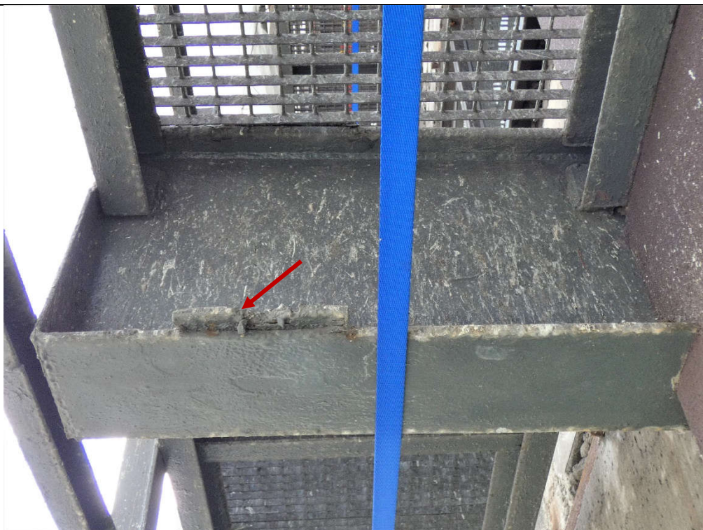
Fot. 114 Pozostałości po drabinie ewakuacyjnej w osi 14/F (widok z dołu)
