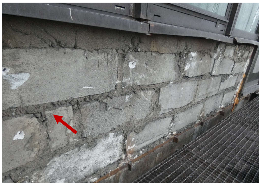
Fot. 56 Kondygnacja 13 (Poziom +48.30) Elewacja Południowa – widok ściany murowanej w osiach 12-13/E. Zbyt duże wymiary spoin. Wypełnienie ubytków między elementami zaprawą. Zwieńczenie ściany podlewką.
