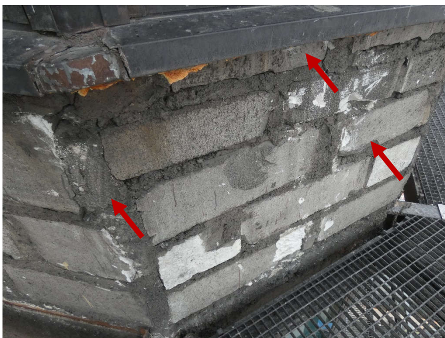
Fot. 22 Kondygnacja 13 (Poziom +48.30) Elewacja Wschodnia – widok ściany murowanej w osiach 14/ I. Zbyt duże wymiary spoin. Wykonanie ściany z uszkodzonych elementów murowych o zróżnicowanych kształtach (12x60 cm 18x60 cm). Zwieńczenie ściany elementami murowymi 12x60 cm. Wypełnienie ubytków między elementami zaprawą.
