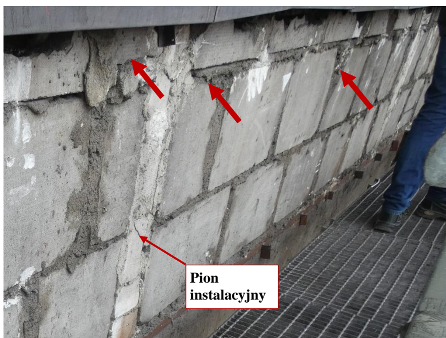
Fot. 20 Kondygnacja 12 (Poziom +45.00) Elewacja Północna – widok ściany murowanej w osiach 12-13/I. Zbyt duże wymiary spoin. Wykonanie ściany z uszkodzonych elementów murowych. Wypełnienie ubytków między elementami i uszkodzonych miejsc zaprawą. Zwieńczenie ściany elementami murowymi, zaprawą i gruzem. Zamknięcie pionu instalacyjnego.
