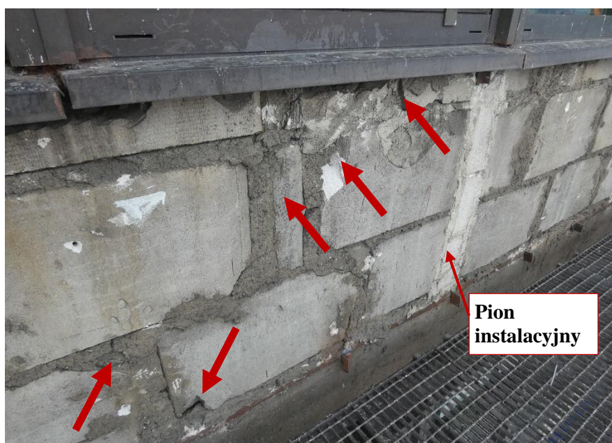
Fot. 22 Kondygnacja 12 (Poziom +45.00) Elewacja Północna – widok ściany murowanej w osiach 11-12/I. Zbyt duże wymiary spoin. Wykonanie ściany z uszkodzonych elementów murowych. Wypełnienie ubytków między elementami i uszkodzonych miejsc zaprawą i gruzem. Zwieńczenie ściany elementami murowymi oraz zaprawą i gruzem. Zamknięcie pionu instalacyjnego.
