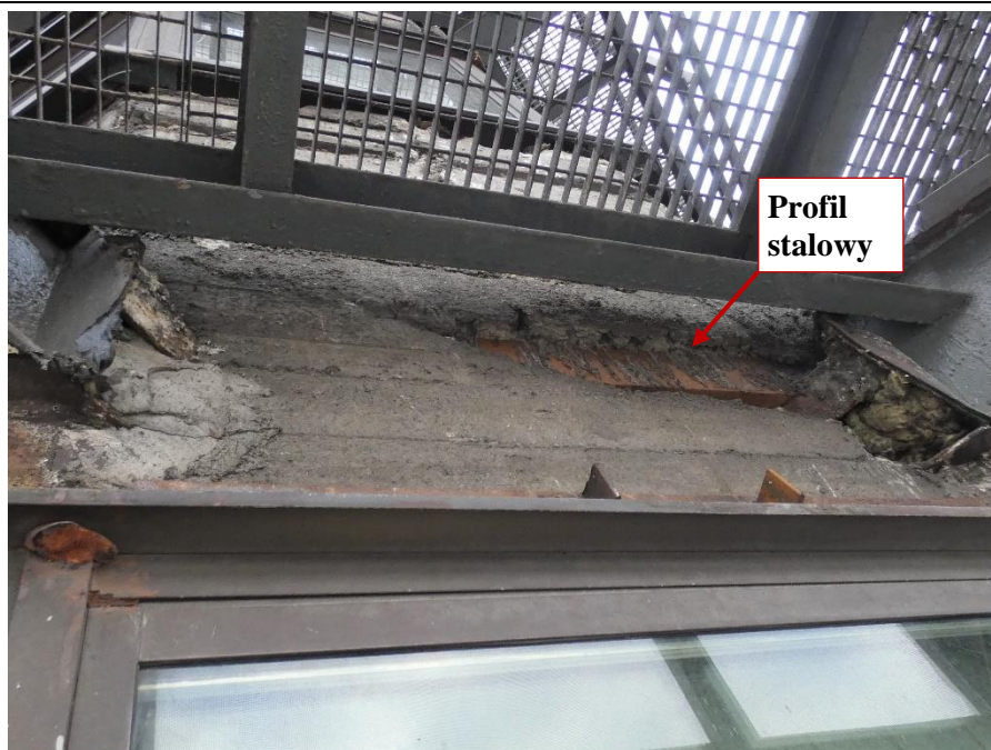
Fot. 103 Kondygnacja 12 (Poziom +45.00) Elewacja Południowa – belka w osiach 14/E. Uszkodzona zaprawa przykrywająca ceowniki oparte na wspornikach stalowych.
