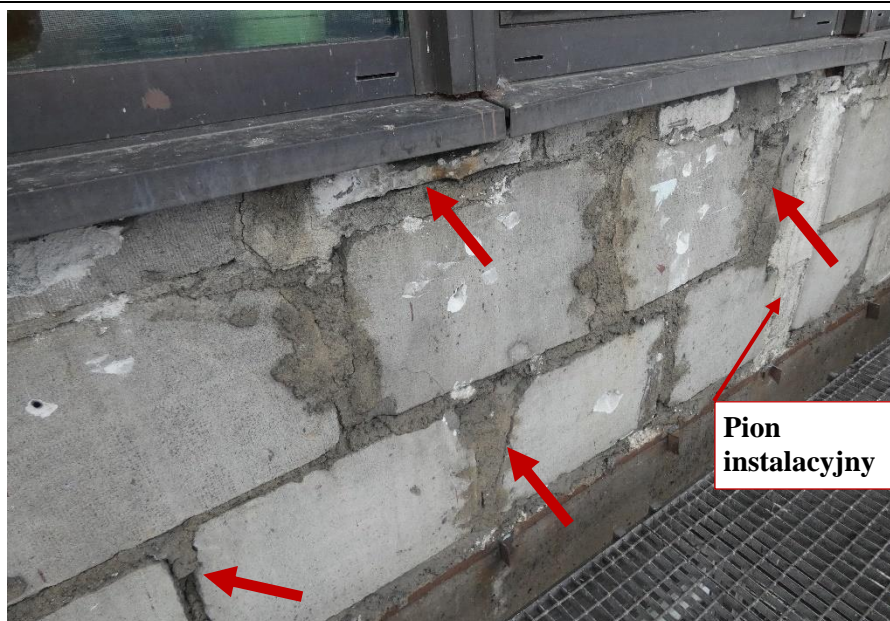
Fot. 23 Kondygnacja 12 (Poziom +45.00) Elewacja Północna – widok ściany murowanej w osiach 11-12/I. Zbyt duże wymiary spoin. Ubytki spoin pionowych. Wykonanie ściany z uszkodzonych elementów murowych. Wypełnienie ubytków między elementami i uszkodzonych miejsc zaprawą i gruzem. Zwieńczenie ściany elementami murowymi, zaprawą i gruzem. Zamknięcie pionu instalacyjnego.
