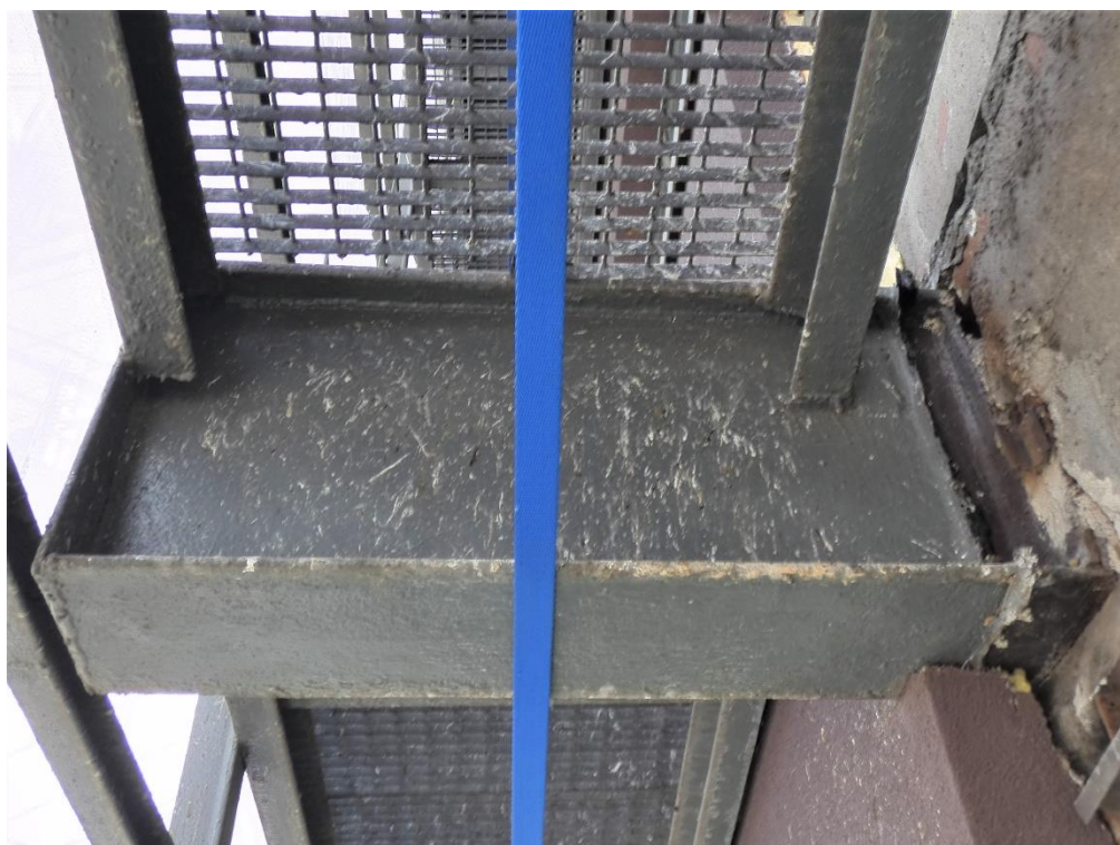
Fot. 106 Wspornik stalowy (widok z boku)
