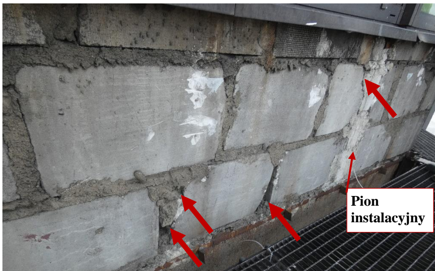
Fot. 37 Kondygnacja 12 (Poziom +45.00) Elewacja Zachodnia – widok ściany murowanej w osiach 10/E-F. Zbyt duże wymiary spoin. Ubytki spoin pionowych. Wykonanie ściany z uszkodzonych elementów murowych. Wypełnienie ubytków między elementami i uszkodzonych miejsc zaprawą. Zwieńczenie ściany elementami murowymi. Zamknięcie pionu instalacyjnego.
