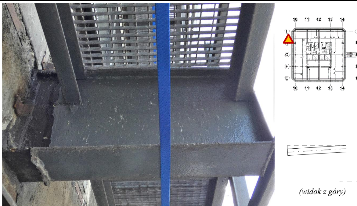
Fot. 133 Kondygnacja 12 (Poziom +45.00) Elewacja Zachodnia– wspornik w osiach 10/H Przemieszczenie wspornika w kierunku osi G. Brak widocznych uszkodzeń wspornika.
