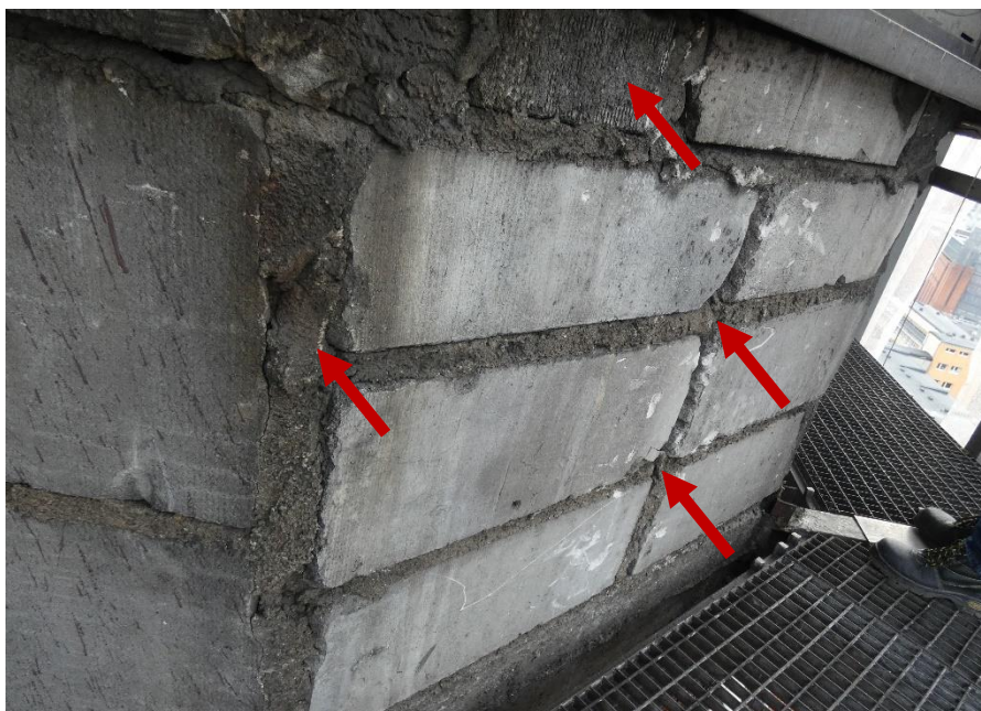
Fot. 38 Kondygnacja 12 (Poziom +45.00) Elewacja Zachodnia – widok ściany murowanej w osiach 10/E. Zbyt duże wymiary spoin. Niewłaściwe przewiązanie elementów. Wykonanie ściany z elementów murowych 24x60 cm. Zwieńczenie ściany elementami murowymi 12x60 cm i gruzem. Wypełnienie ubytków między elementami zaprawą.
