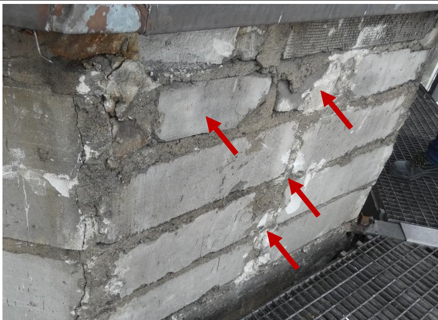
Fot. 27 Kondygnacja 12 (Poziom +45.00) Elewacja Północna – widok ściany murowanej w osiach 10/I. Zbyt duże wymiary spoin. Niewłaściwe przewiązanie elementów. Wykonanie ściany z uszkodzonych elementów murowych 18x60 cm. Zwieńczenie ściany elementami murowymi 12x60 cm. Wypełnienie ubytków między elementami i uszkodzonych miejsc zaprawą i gruzem.
