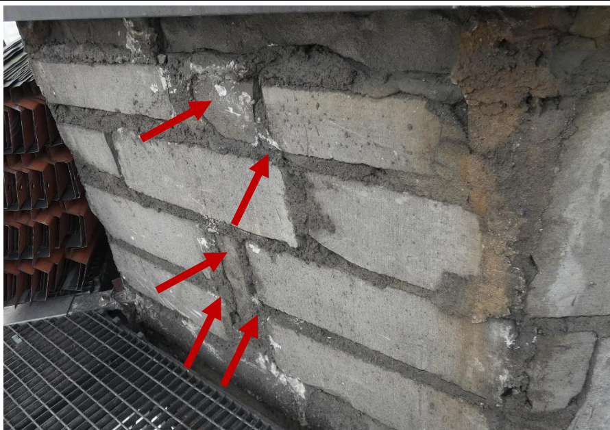
Fot. 17 Kondygnacja 12 (Poziom +45.00) Elewacja Wschodnia – widok ściany murowanej w osiach 14/I. Zbyt duże wymiary spoin. Niewłaściwe przewiązanie elementów. Wykonanie ściany z uszkodzonych elementów murowych o zróżnicowanych kształtach (12x60 cm, 18x60 cm). Wypełnienie ubytków między elementami zaprawą i gruzem. Zwieńczenie ściany podlewką.
