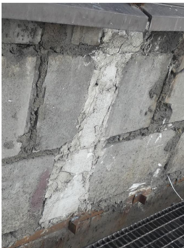
Fot. 10 Przykład zamknięcia pionu instalacyjnego elementami murowymi, zaprawą i gruzem.
