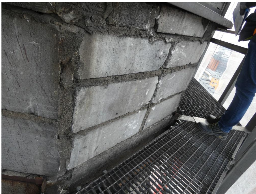
Fot. 4 Przykład ściany murowanej o bardzo niskiej jakości wykonania (brak przewiązania ściany murowanej)
