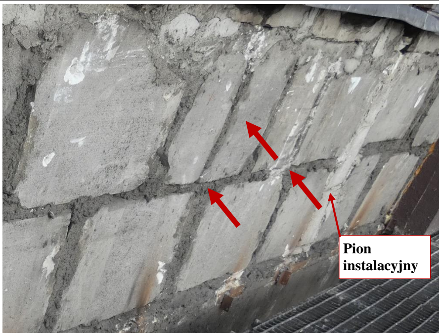
Fot. 13 Kondygnacja 12 (Poziom +45.00) Elewacja Wschodnia – widok ściany murowanej w osiach 14/E-F. Zbyt duże wymiary spoin. Niewłaściwe przewiązanie elementów. Ściana z uszkodzonych elementów murowych o zróżnicowanych kształtach. Wypełnienie ubytków między elementami i uszkodzonych miejsc zaprawą i gruzem. Zwieńczenie ściany elementami murowymi, zaprawą i gruzem. Zamknięcie pionu instalacyjnego.
