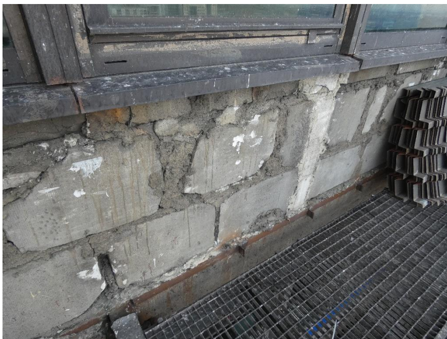
Fot. 3 Przykład ściany murowanej o bardzo niskiej jakości wykonania (wykonanie ściany z uszkodzonych elementów murowych z wypełnieniem przerw między elementami i uszkodzonych miejsc zaprawą i gruzem)
