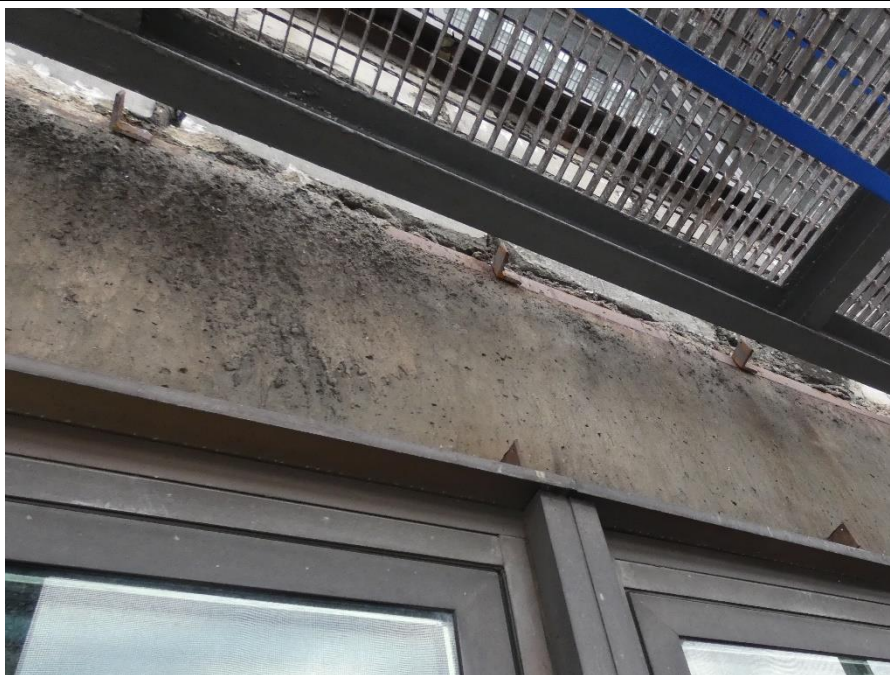
Fot. 92 Kondygnacja 12 (Poziom +45.00) Elewacja Południowa – belka w osiach 10-11/E. Brak widocznych uszkodzeń w pozostałej części przęsła belki
