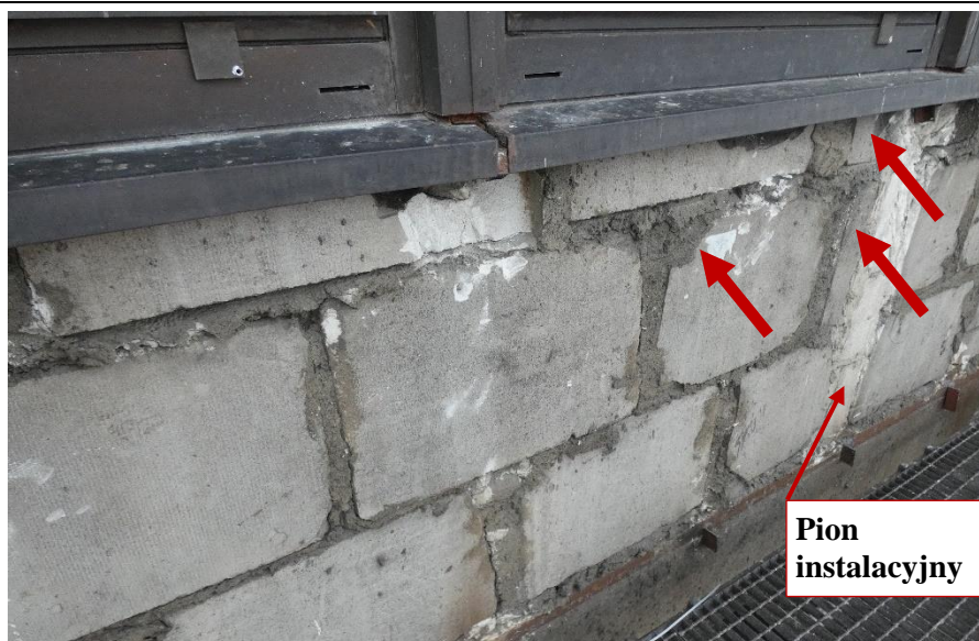
Fot. 21 Kondygnacja 12 (Poziom +45.00) Elewacja Północna – widok ściany murowanej w osiach 12-13/I. Zbyt duże wymiary spoin. Wykonanie ściany z uszkodzonych elementów murowych. Wypełnienie ubytków między elementami i uszkodzonych miejsc zaprawą. Zwieńczenie ściany elementami murowymi. Zamknięcie pionu instalacyjnego.
