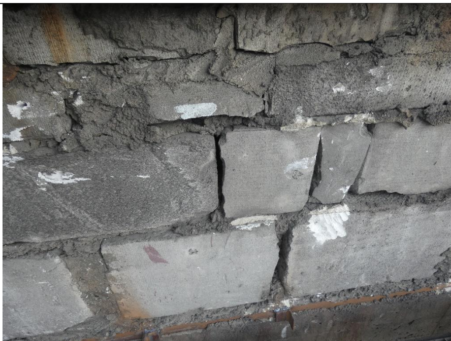
Fot. 2 Przykład ściany murowanej o bardzo niskiej jakości wykonania (wypełnienie przerw między elementami uszkodzonymi elementami murowymi o niewymiarowych kształtach oraz zaprawą i gruzem, ubytki w spoinach pionowych, zbyt grube spoiny poziome)
