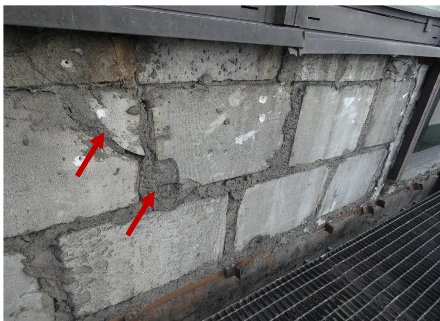
Fot. 44 Kondygnacja 12 (Poziom +45.00) Elewacja Południowa – widok ściany murowanej w osiach 12-13/E. Zbyt duże wymiary spoin. Wykonanie ściany z uszkodzonych elementów murowych. Wypełnienie ubytków między elementami i uszkodzonych miejsc zaprawą. Zwieńczenie ściany elementami murowymi.
