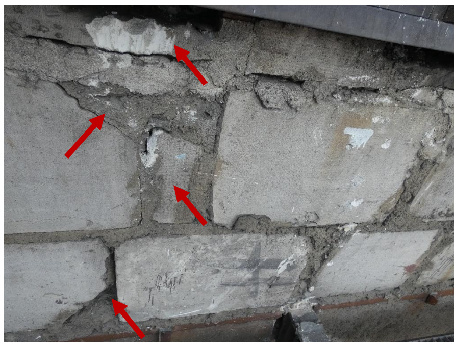
Fot. 24 Kondygnacja 12 (Poziom +45.00) Elewacja Północna – widok ściany murowanej w osiach 11-12/I. Zbyt duże wymiary spoin. Ubytki spoin pionowych. Wykonanie ściany z uszkodzonych elementów murowych. Wypełnienie ubytków między elementami i uszkodzonych miejsc zaprawą i gruzem. Zwieńczenie ściany elementami murowymi, zaprawą i gruzem.
