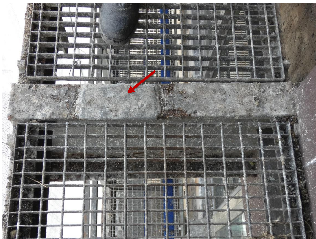
Fot. 108 Pozostałości po drabinie ewakuacyjnej w osi 14/F (widok z góry)
