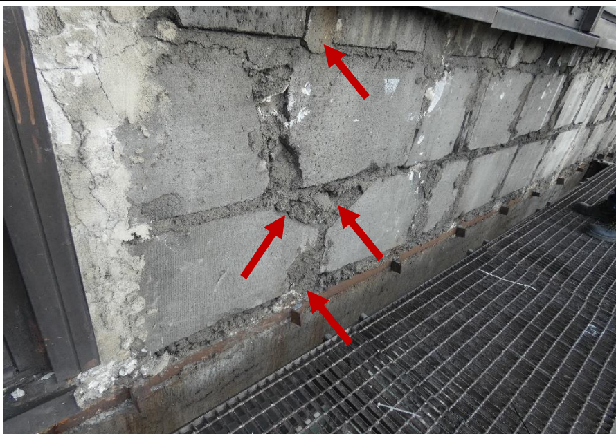
Fot. 41 Kondygnacja 12 (Poziom +45.00) Elewacja Południowa – widok ściany murowanej w osiach 11-12/E. Zbyt duże wymiary spoin. Wykonanie ściany z uszkodzonych elementów murowych. Wypełnienie ubytków między elementami i uszkodzonych miejsc zaprawą. Zwieńczenie ściany elementami murowymi i gruzem.
