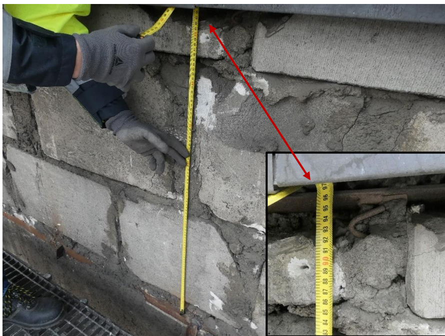
Fot. 15 Kondygnacja 12 (Poziom +45.00) Elewacja Północna – widok ściany murowanej w osiach 14/H-I. Wysokość ściany murowanej ~96 cm. Grubość podlewki między belką żelbetową a ścianą ~7 cm. Grubość podlewki między ścianą a profilem okiennym 0-2 cm. Element murowany bezpośrednio pod profilem stalowym.
