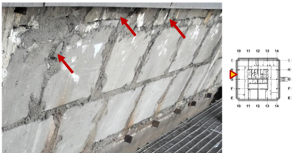
Fot. 32 Kondygnacja 12 (Poziom +45.00) Elewacja Zachodnia – widok ściany murowanej w osiach 10/G-H. Zbyt duże wymiary spoin. Wykonanie ściany z uszkodzonych elementów murowych. Wypełnienie ubytków między elementami i uszkodzonych miejsc zaprawą i gruzem. Zwieńczenie ściany uszkodzonymi elementami murowymi.
