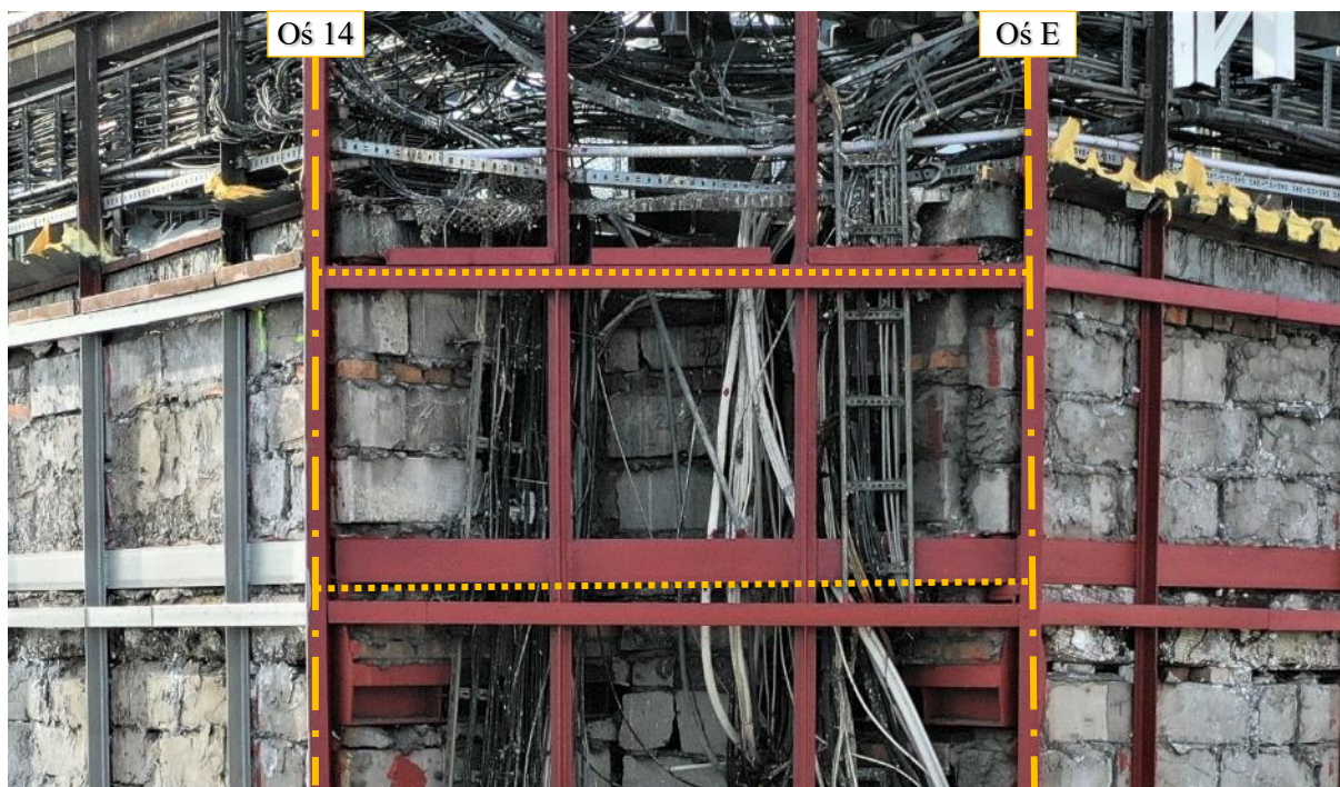
Fot. 250 Ściana nad 20 piętrzem (Poziom +76.00) Elewacja Południowa – widok naroża ściany w osi 14 / E Stan ścian można uznać za zadowalający. Na etapie prac zweryfikować trwałość połączeń elementów murowych, wypełnić ewentualne ubytki spoin.
