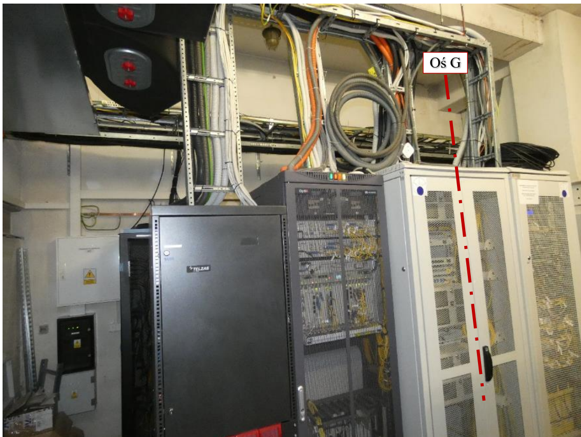
Fot. 219 Piętro 20 (Poziom +71.40) Elewacja Zachodnia – widok ściany w osi 10 / F-G – wewnątrz
