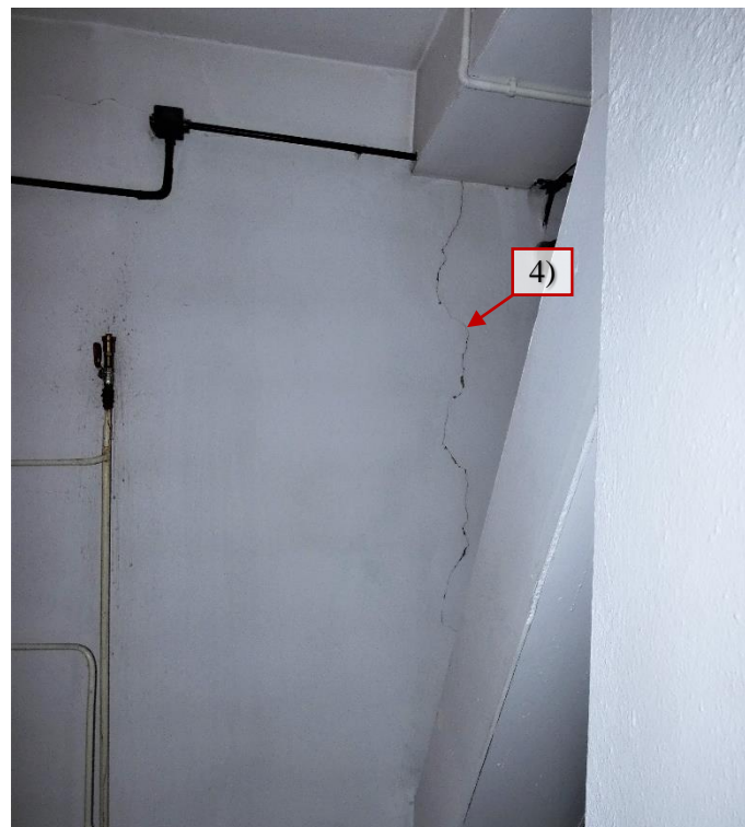
Fot. 76 Piętro 19 (Poziom +68.10) Elewacja Południowa – widok ściany w osiach 12-13 / E - uszkodzenia od strony wewnętrznej
