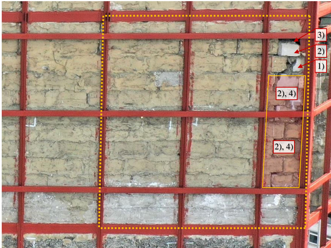
Fot. 22 Piętro 19 (Poziom +68.10) Elewacja Północna – widok ściany w osiach 10-11 / I – Część 1/2
