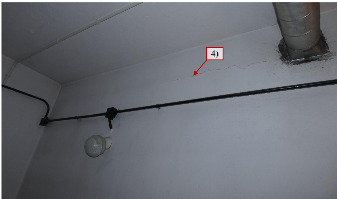
Fot. 74 Piętro 19 (Poziom +68.10) Elewacja Południowa – widok ściany w osiach 12-13 / E - uszkodzenia od strony wewnętrznej
