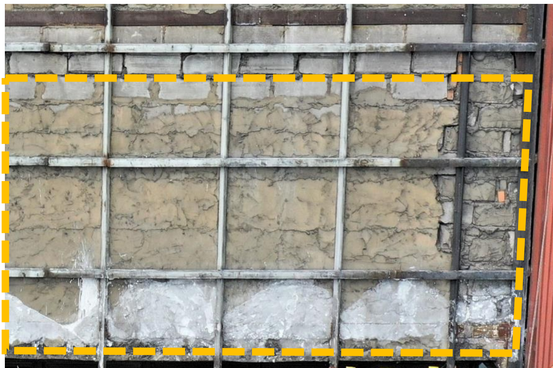
Fot. 10 Przykład elementów wymagających oczyszczenia
