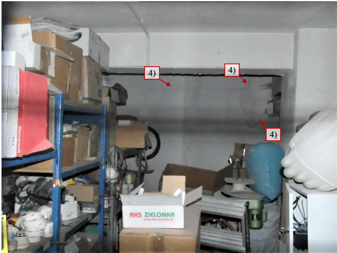
Fot. 48 Piętro 19 (Poziom +68.10) Elewacja Wschodnia – widok ściany w osiach 14 / H-I – uszkodzenia od strony wewnętrznej
