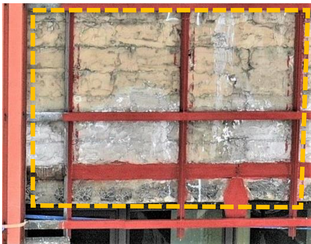
Fot. 11 Przykład elementów wymagających oczyszczenia
