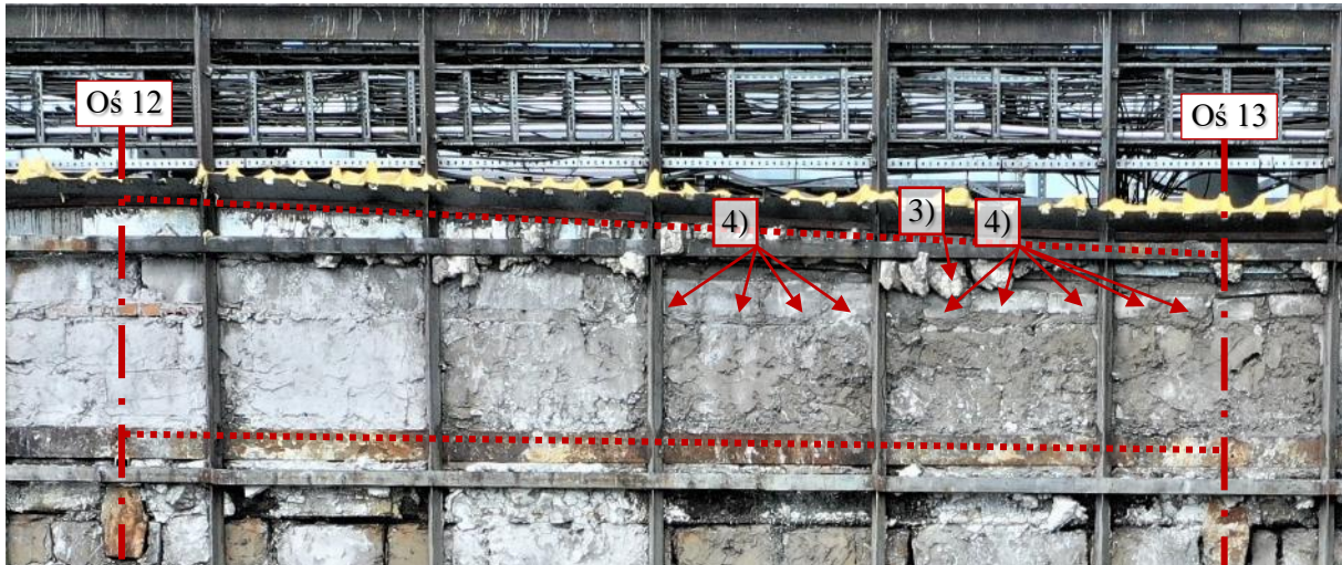
Fot. 252 Ściana nad 20 piętrem (Poziom +76.00) Elewacja Południowa – widok ściany w osiach 12-13 / E
