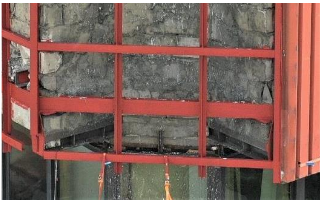
Fot. 7 Przykład elementów wymagających oczyszczenia
