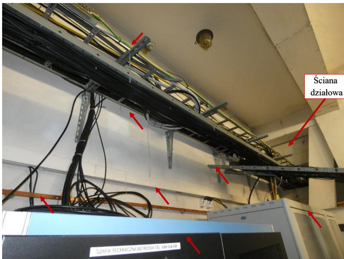
Fot. 220 Piętro 20 (Poziom +71.40) Elewacja Zachodnia – widok ściany w osi 10 / F-G – wewnątrz
