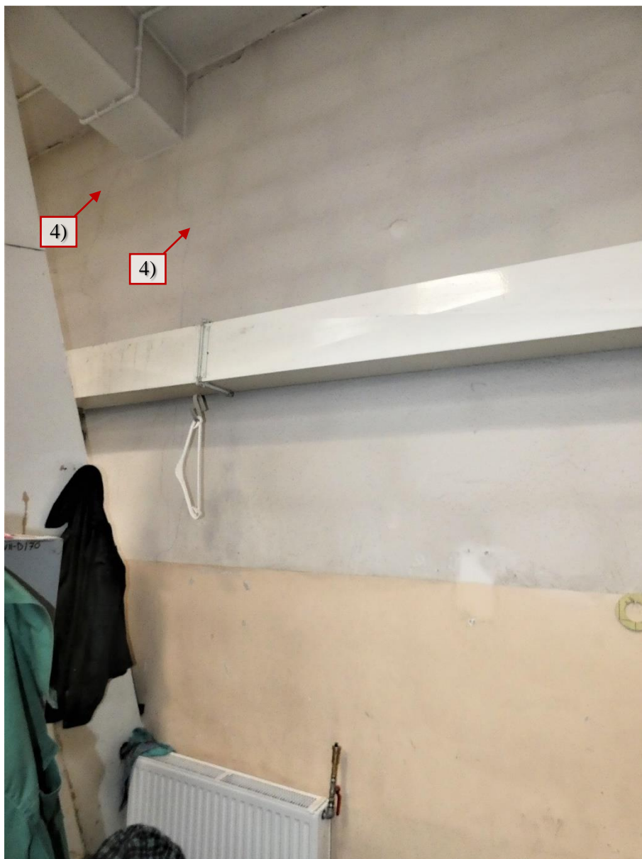
Fot. 150 Piętro 20 (Poziom +71.40) Elewacja Wschodnia – widok ściany w osiach 14 / G-H - uszkodzenia od strony wewnętrznej
