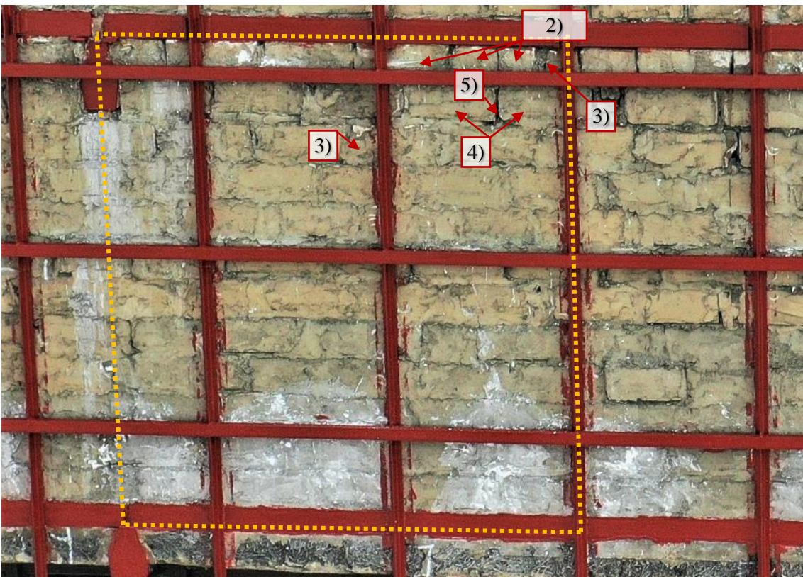
Fot. 33 Piętro 19 (Poziom +68.10) Elewacja Północna – widok ściany w osiach 12-13 / I – Część 2/2
