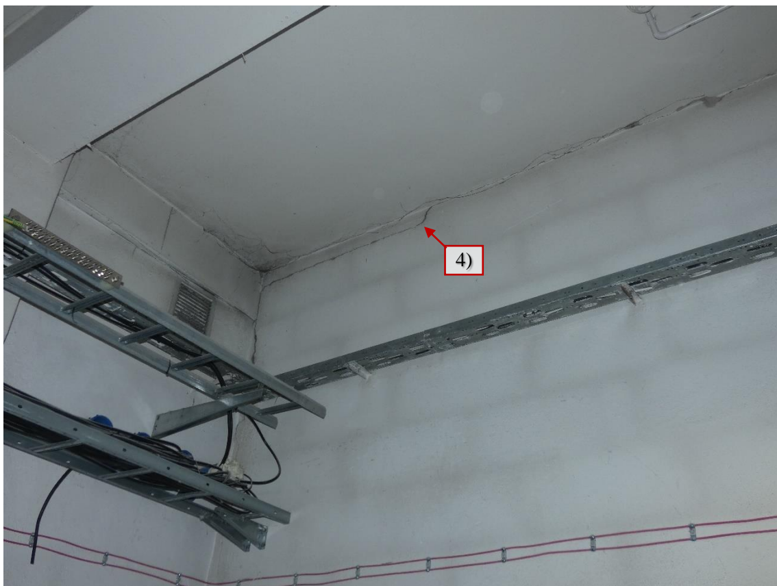
Fot. 119 Piętro 20 (Poziom +71.40) Elewacja Północna – widok ściany w osiach 10-11 / I - uszkodzenia od strony wewnętrznej
