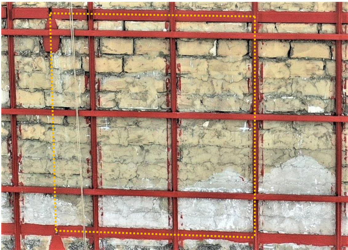
Fot. 27 Piętro 19 (Poziom +68.10) Elewacja Północna – widok ściany w osiach 11-12 / I – Część 2/2
