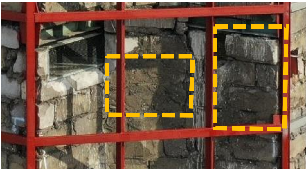
Fot. 5 Przykład elementów wymagających oczyszczenia
