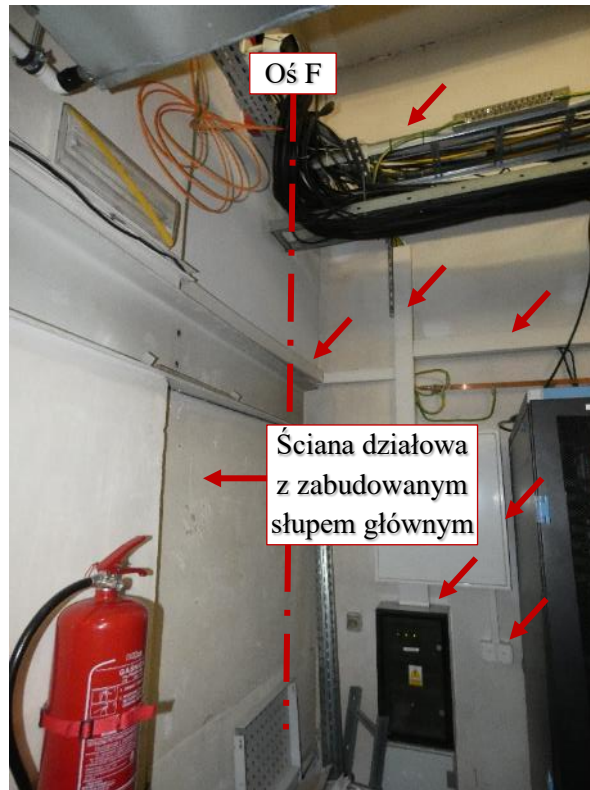
Fot. 218 Piętro 20 (Poziom +71.40) Elewacja Zachodnia – widok ściany w osi 10 / F-G – wewnątrz
