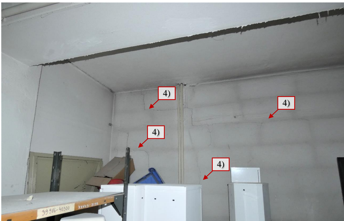
Fot. 36 Piętro 19 (Poziom +68.10) Elewacja Północna – widok ściany w osiach 13-14 / I - uszkodzenia od strony wewnętrznej
