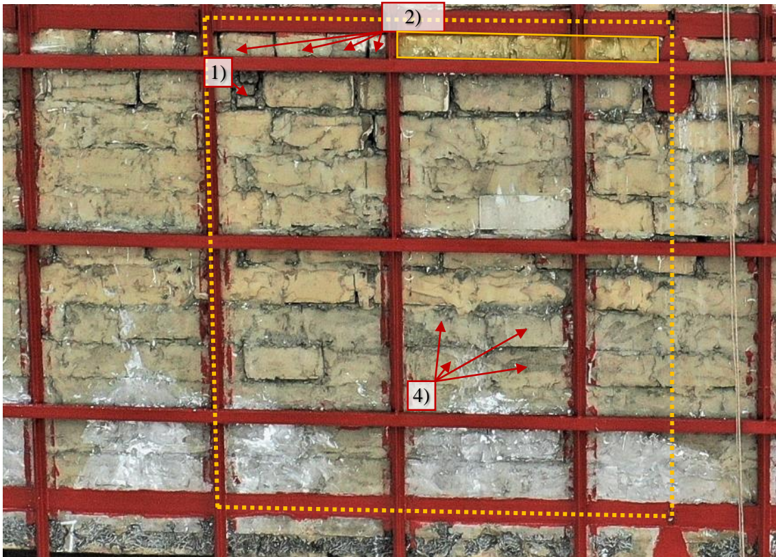
Fot. 32 Piętro 19 (Poziom +68.10) Elewacja Północna – widok ściany w osiach 12-13 / I – Część 1/2
