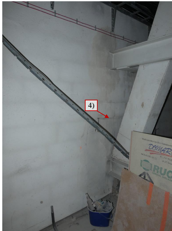
Fot. 227 Piętro 20 (Poziom +71.40) Elewacja Zachodnia – widok ściany w osiach 10 / G-H - uszkodzenia od strony wewnętrznej
