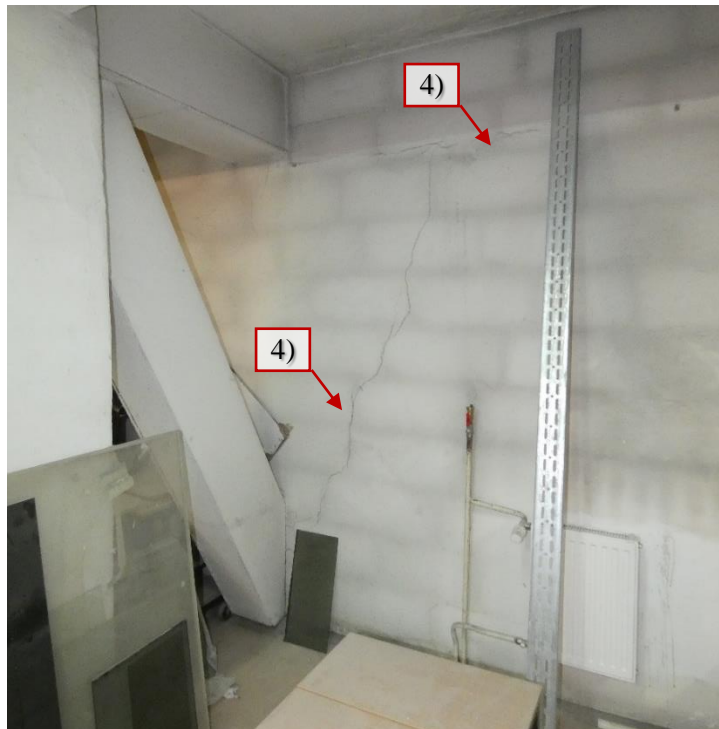
Fot. 30 Piętro 19 (Poziom +68.10) Elewacja Północna – widok ściany w osiach 12-13 / I - uszkodzenia od strony wewnętrznej
