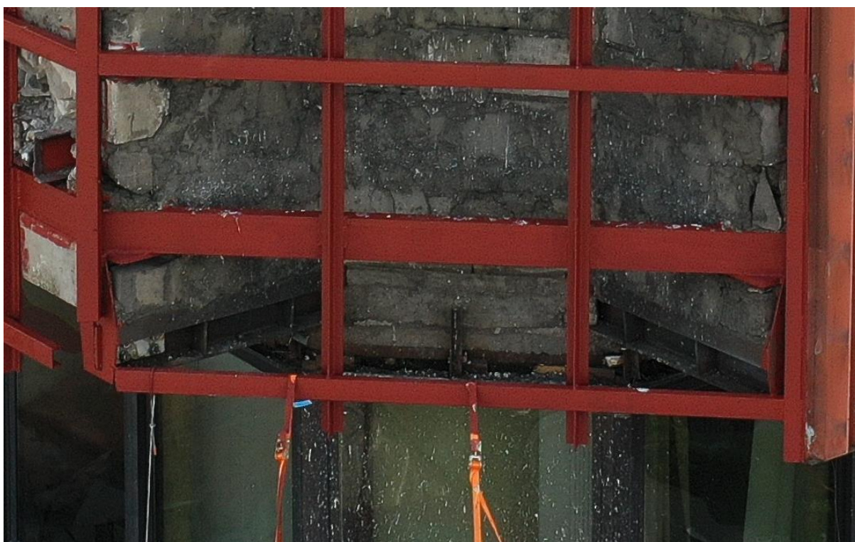
Fot. 4 Brak siatki zabezpieczającej w narożu osi 14/I
