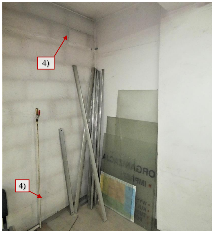
Fot. 31 Piętro 19 (Poziom +68.10) Elewacja Północna – widok ściany w osiach 12-13 / I - uszkodzenia od strony wewnętrznej
