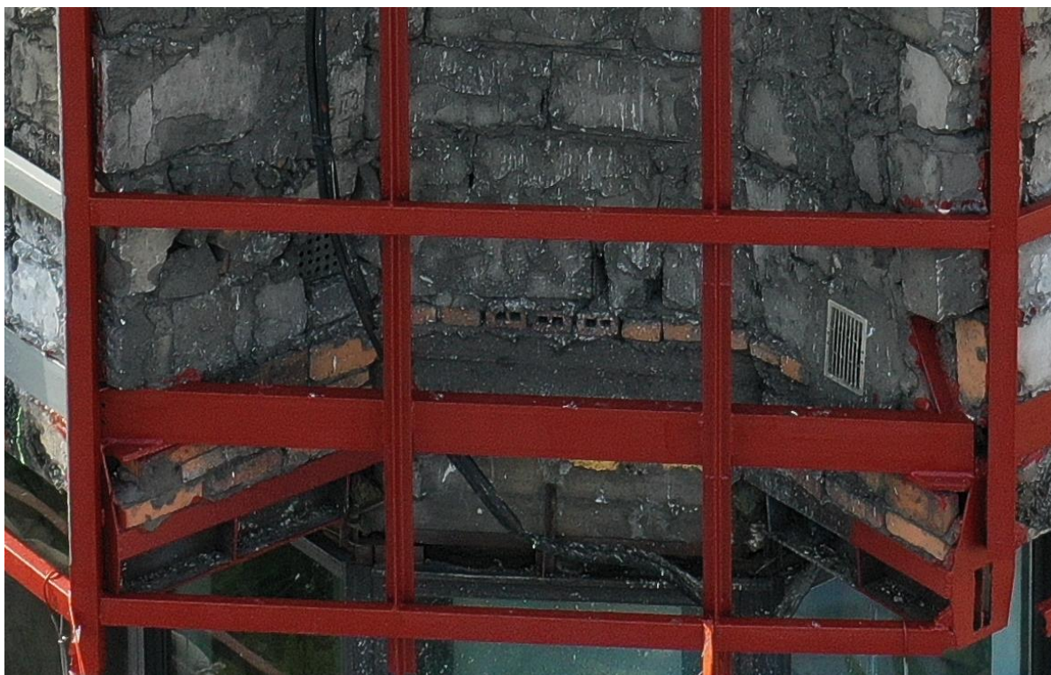
Fot. 2 Brak siatki zabezpieczającej w narożu osi 14/E
