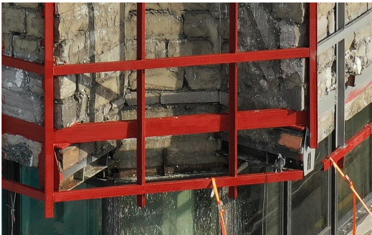
Fot. 3 Brak siatki zabezpieczającej w narożu osi 10/I
