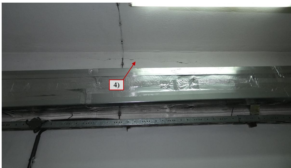
Fot. 59 Piętro 19 (Poziom +68.10) Elewacja Wschodnia – widok ściany w osiach 14 / E-F – uszkodzenia od strony wewnętrznej
