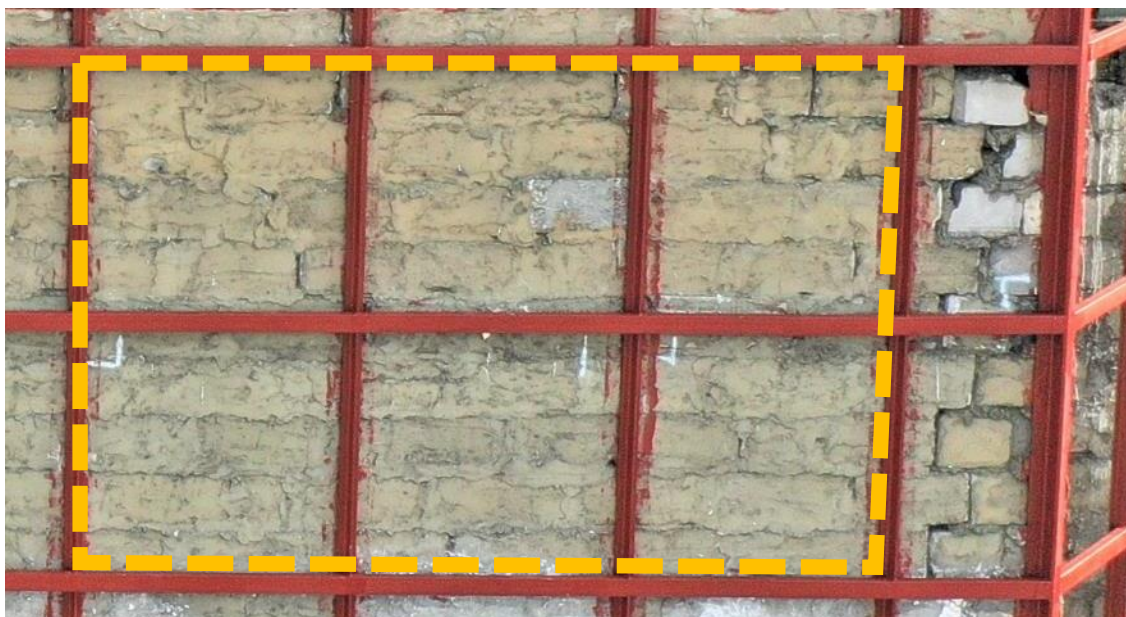
Fot. 8 Przykład elementów wymagających oczyszczenia
