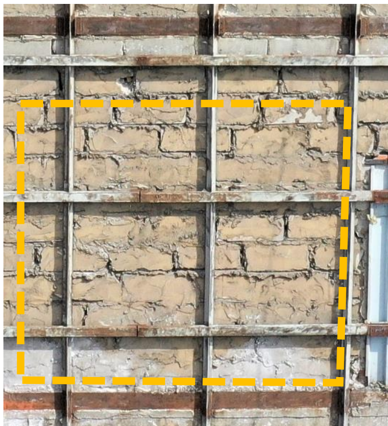
Fot. 15 Przykład elementów wymagających oczyszczenia
