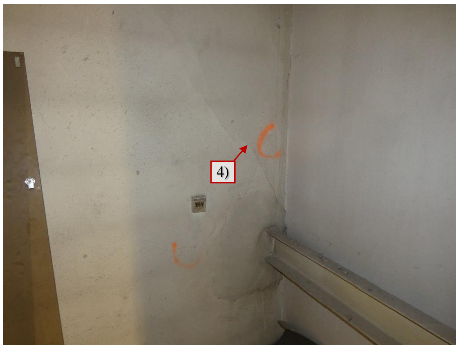
Fot. 235 Piętro 20 (Poziom +71.40) Elewacja Zachodnia – widok ściany w osiach 10 / H-I - uszkodzenia od strony wewnętrznej
