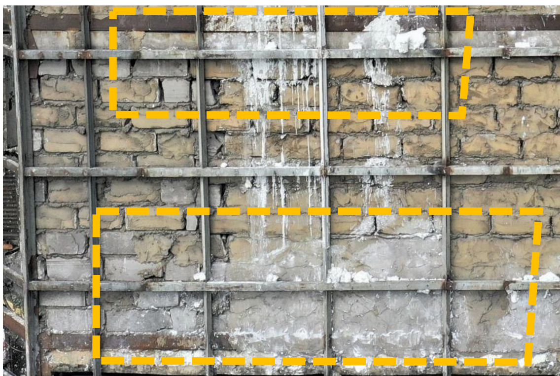
Fot. 13 Przykład elementów wymagających oczyszczenia
