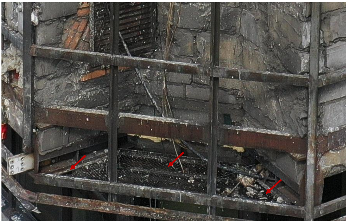
Fot. 1 Uszkodzona siatka zabezpieczająca w narożu osi 10/E
