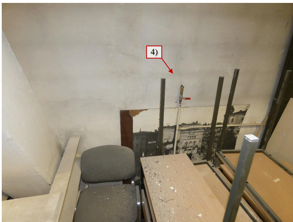
Fot. 111 Piętro 19 (Poziom +68.10) Elewacja Zachodnia – widok ściany w osiach 10 / H-I – uszkodzenia od strony wewnętrznej
