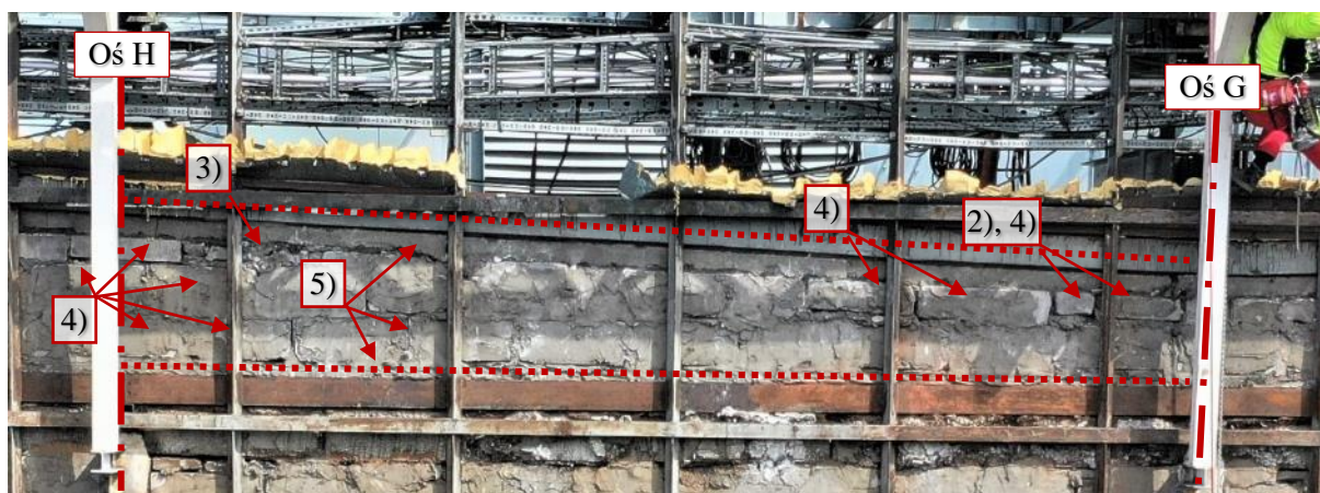
Fot. 258 Ściana nad 20 piętrem (Poziom +76.00) Elewacja Zachodnia – widok ściany w osi 10 / G-H
