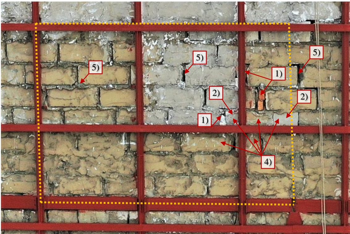
Fot. 132 Piętro 20 (Poziom +71.40) Elewacja Północna – widok ściany w osiach 12-13 / I – Część 1/4
