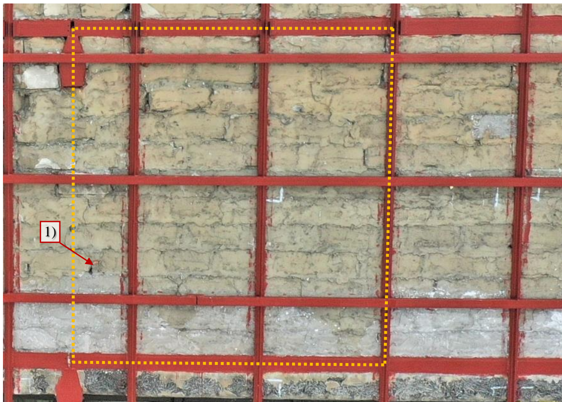
Fot. 23 Piętro 19 (Poziom +68.10) Elewacja Północna – widok ściany w osiach 10-11 / I – Część 2/2
