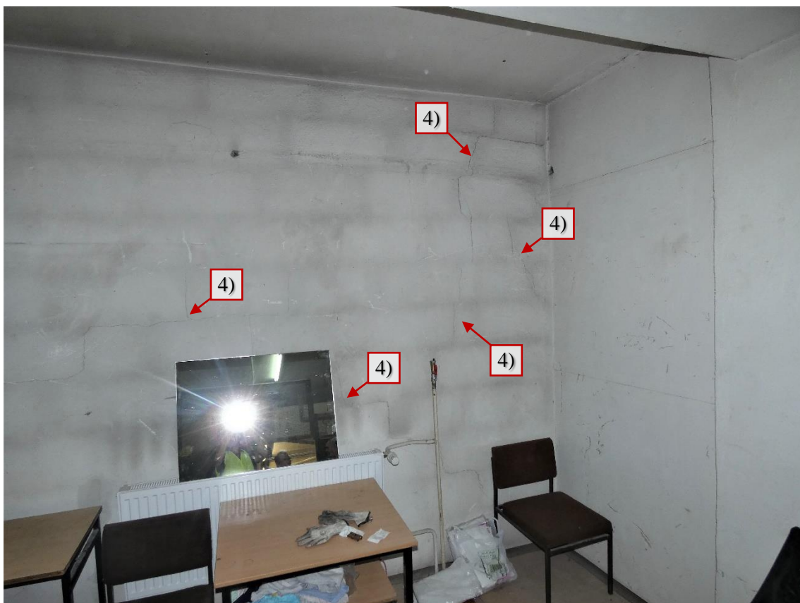
Fot. 21 Piętro 19 (Poziom +68.10) Elewacja Północna – widok ściany w osiach 10-11 / I - uszkodzenia od strony wewnętrznej
