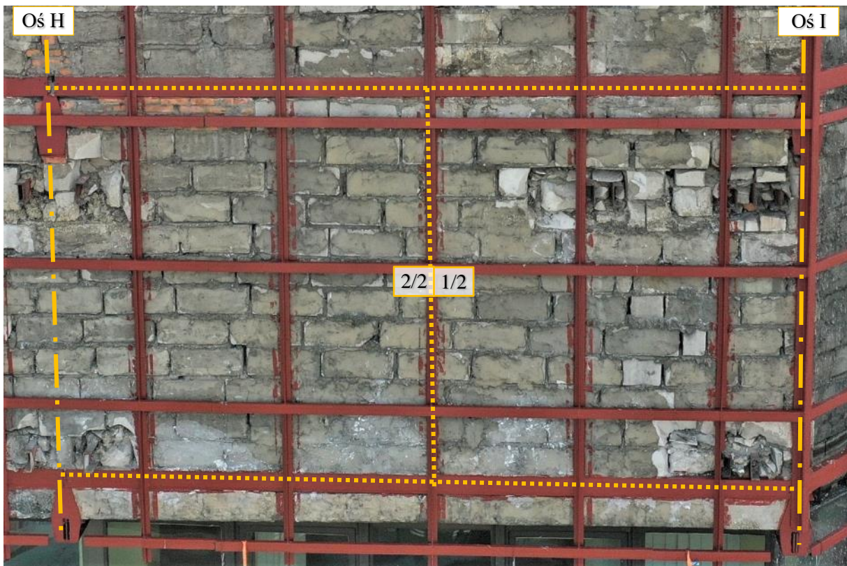
Fot. 40 Piętro 19 (Poziom +68.10) Elewacja Wschodnia – widok ściany w osiach 14 / H-I – zewnątrz
