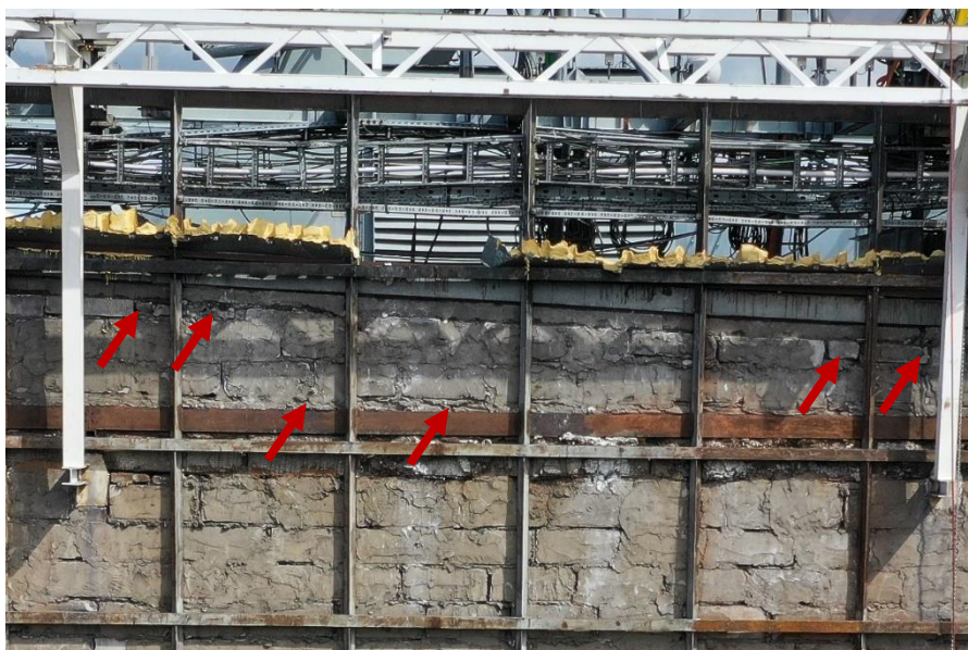
Fot. 28 Stropodach (Poziom +76.09) Elewacja Zachodnia – widok ściany murowanej w osiach 10/G-H. Zbyt duże wymiary spoin. Ściana z elementów murowanych o zróżnicowanych wymiarach. Lokalne ubytki spoin i uszkodzenia elementów murowych. Ubytki między elementami wypełnione zaprawą lub zaprawą i gruzem.
