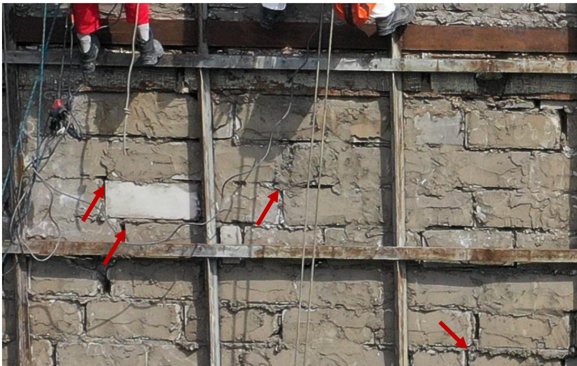
Rys. 6 Przykład niewłaściwego przewiązania ściany o nieuszkodzonych elementach, z możliwością zastosowania systemów naprawczych np. „Helfix-HeliBar”
