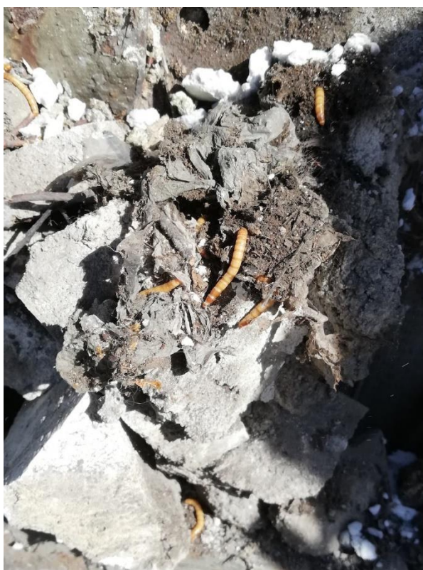
Fot. 8, Gruz i materiał biologiczny w miejscu ubytków w murze oraz przestrzeni między murem, a elewacją z blachy trapezowej.
