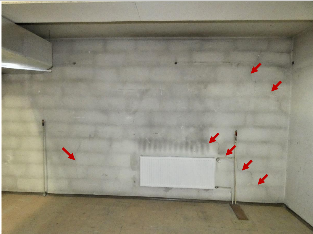
Fot. 11 Przykład zarysowania ściany. Rysy pionowe i ukośne.
