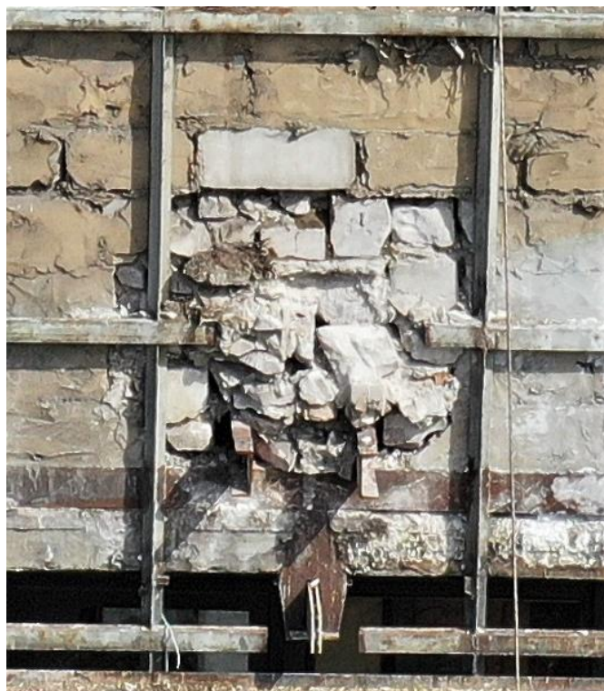
Fot. 1 Widok ściany murowanej o bardzo niskiej jakości wykonania niespełniającej żadnych kryteriów konstrukcji murowej (otwory w ścianie wypełnione zaprawą i gruzem)
