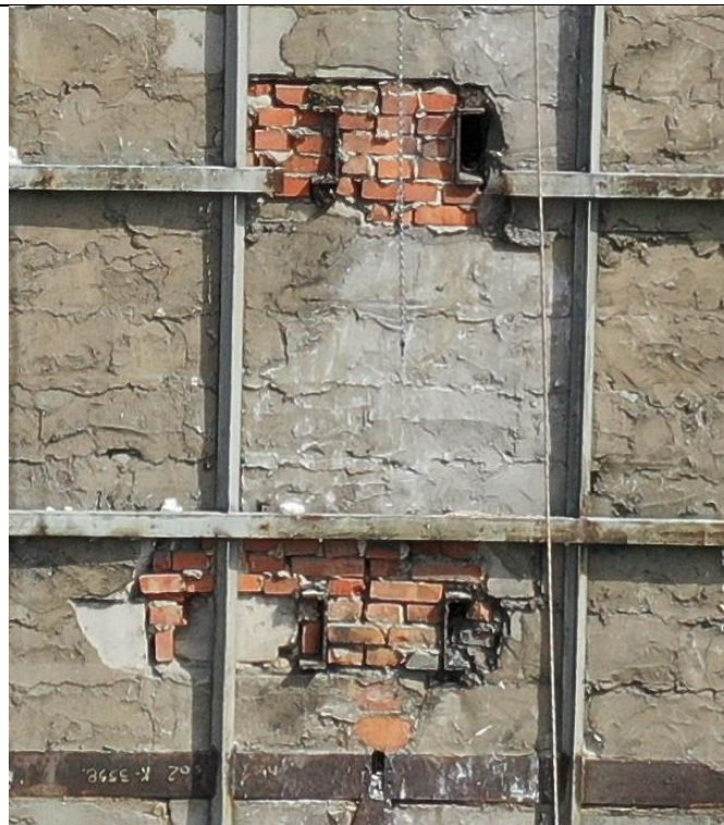
Fot. 2 Widok ściany murowanej o bardzo niskiej jakości wykonania niespełniającej żadnych kryteriów konstrukcji murowej (otwory w ścianie wypełnione nieprzewiązanymi elementami ceramicznymi z ubytkami spoin pionowych i poziomych)
