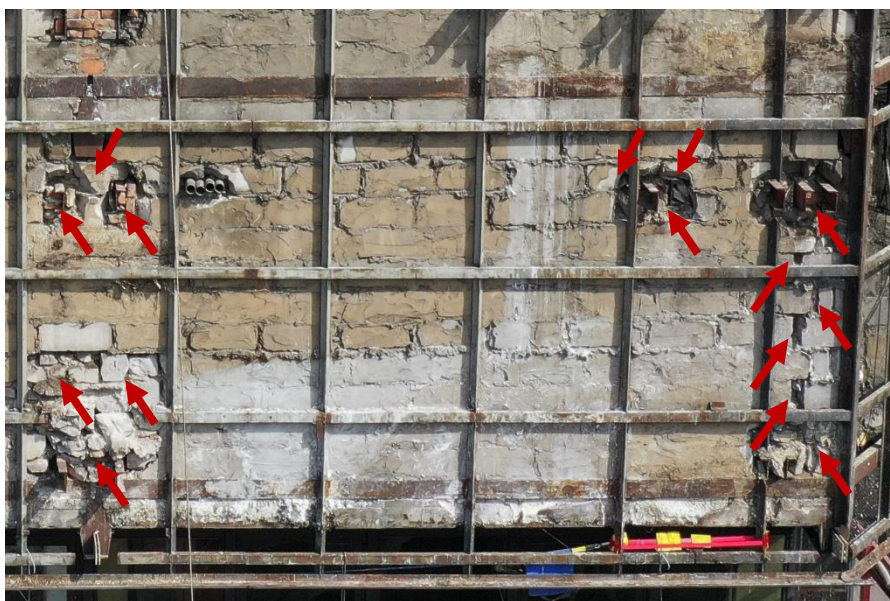
Fot. 20 Piętro 19 (Poziom +68.10) Elewacja Zachodnia – widok ściany murowanej w osiach 10/E-F. Zbyt duże wymiary spoin. Część elementów murowych uszkodzona. Otwory i ubytki w murze wypełnione zaprawą i gruzem lub samym gruzem.
