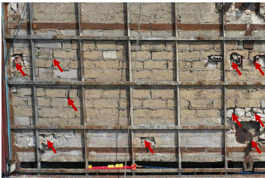
Fot. 17 Piętro 19 (Poziom +68.10) Elewacja Zachodnia – widok ściany murowanej w osiach 10/H-I. Zbyt duże wymiary spoin. Część elementów murowanych uszkodzona. Lokalnie braki przewiązania elementów i ubytki spoin. Otwory w murze wypełnione zaprawą i gruzem lub samym gruzem. Otwory od wnętrza budynku zabezpieczone blachami.
