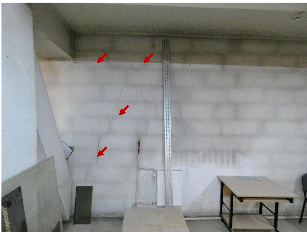
Fot. 12 Przykład zarysowania ściany. Rysy ukośne i poziome.
