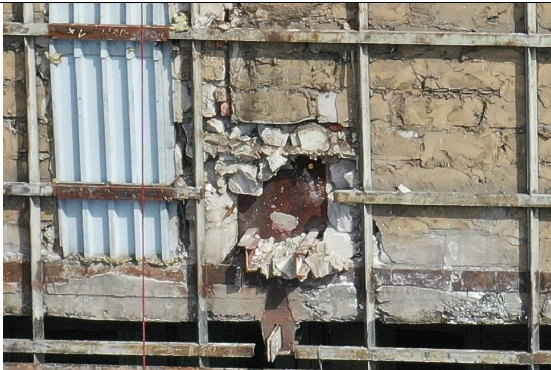
Fot. 4 Widok ściany murowanej o bardzo niskiej jakości wykonania niespełniającej żadnych kryteriów konstrukcji murowej (otwór w ścianie - pozostałość po osunięciu luźnego wypełnia gruzem. Zabezpieczenie otworu od wnętrza budynku blachami)
