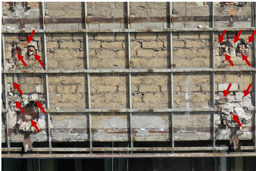
Fot. 19 Piętro 19 (Poziom +68.10) Elewacja Zachodnia – widok ściany murowanej w osiach 10/F-G. Zbyt duże wymiary spoin. Część elementów murowych uszkodzona. Otwory w murze wypełnione zaprawą i gruzem lub samym gruzem. Otwory od wnętrza budynku zabezpieczone blachami.
