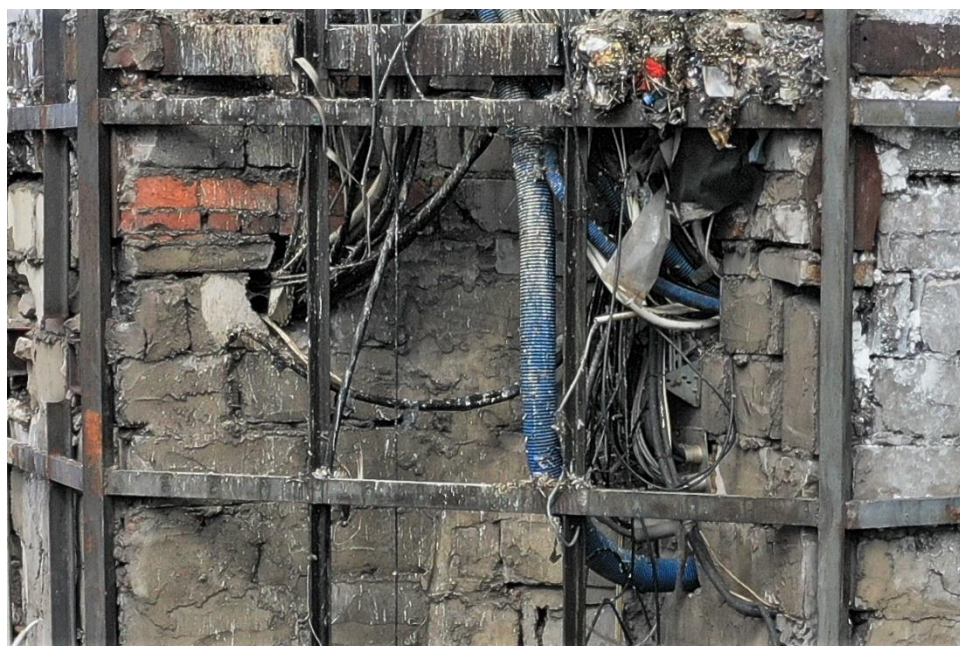
Fot. 5 Widok naroża budynku - niewłaściwe przeprowadzenie instalacji przez ściany budynku. Ściana z uszkodzonymi elementami murowymi z różnicowanymi materiałami i kształtami, z ubytkami spoin pionowych i poziomych.
