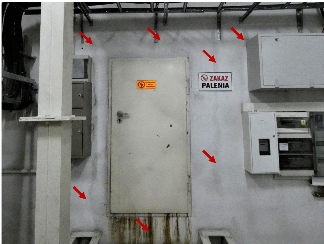
Fot. 10 Zarysowania i zacieki na ścianie (stan ściany z zewnątrz Fot. 3)
