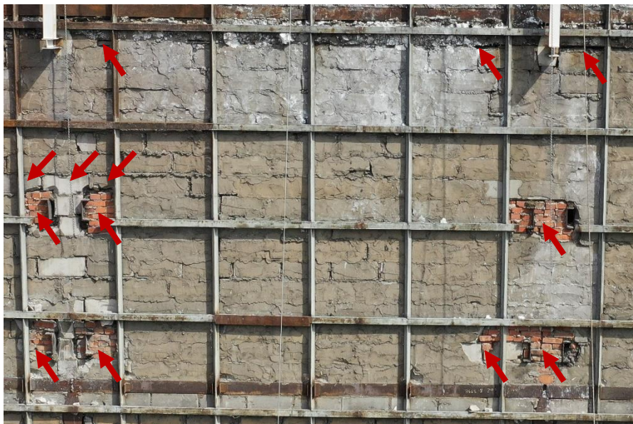
Fot. 24 Piętro 20 (Poziom +71.40) Elewacja Zachodnia – widok ściany murowanej w osiach 10/F-G. Zbyt duże wymiary spoin. Część elementów murowych uszkodzona. Otwory i ubytki między elementami wypełnione niepołączonymi ze ścianą elementami ceramicznymi oraz zaprawą i gruzem. Przestrzeń między ścianą a stropodachem niewypelniona lub wypełniona zaprawą i gruzem.
