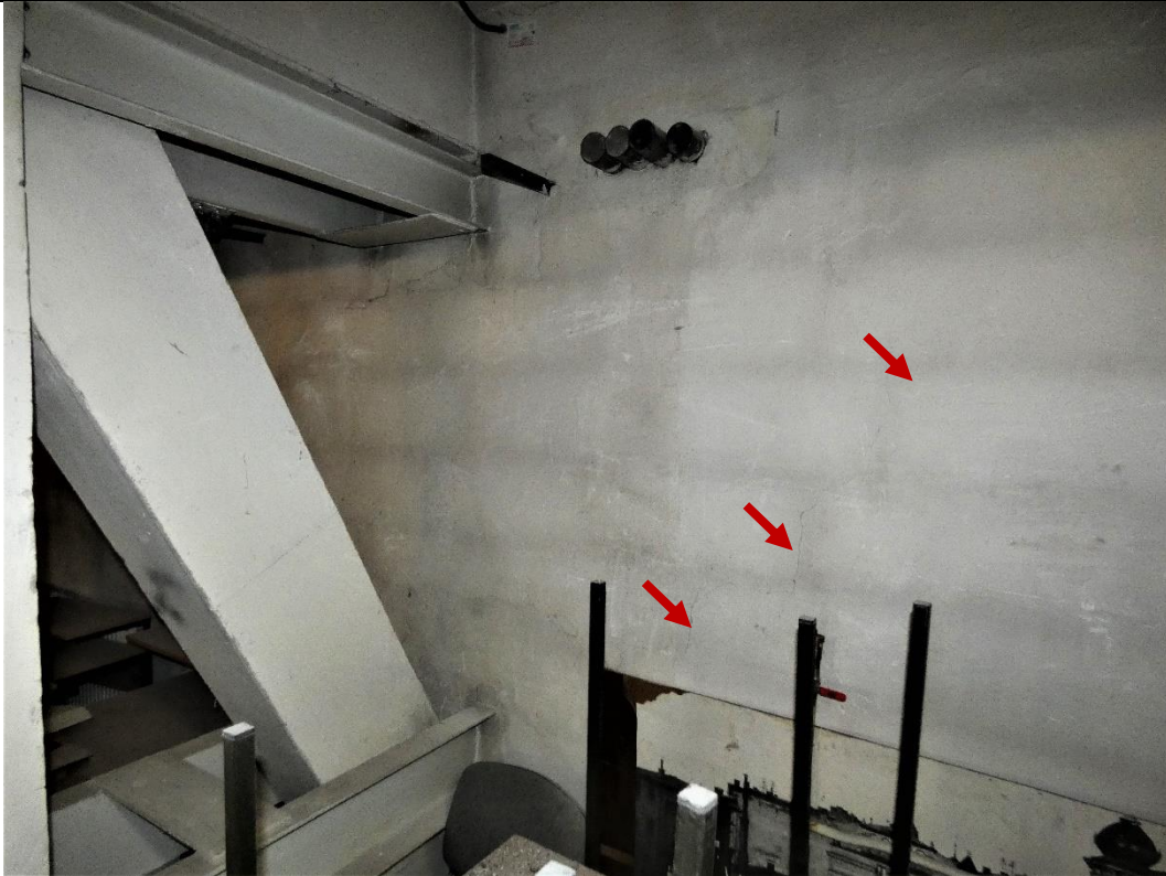
Fot. 9 Przykład zarysowania ukośnego (rysy ukośne - schodkowe) ściany
