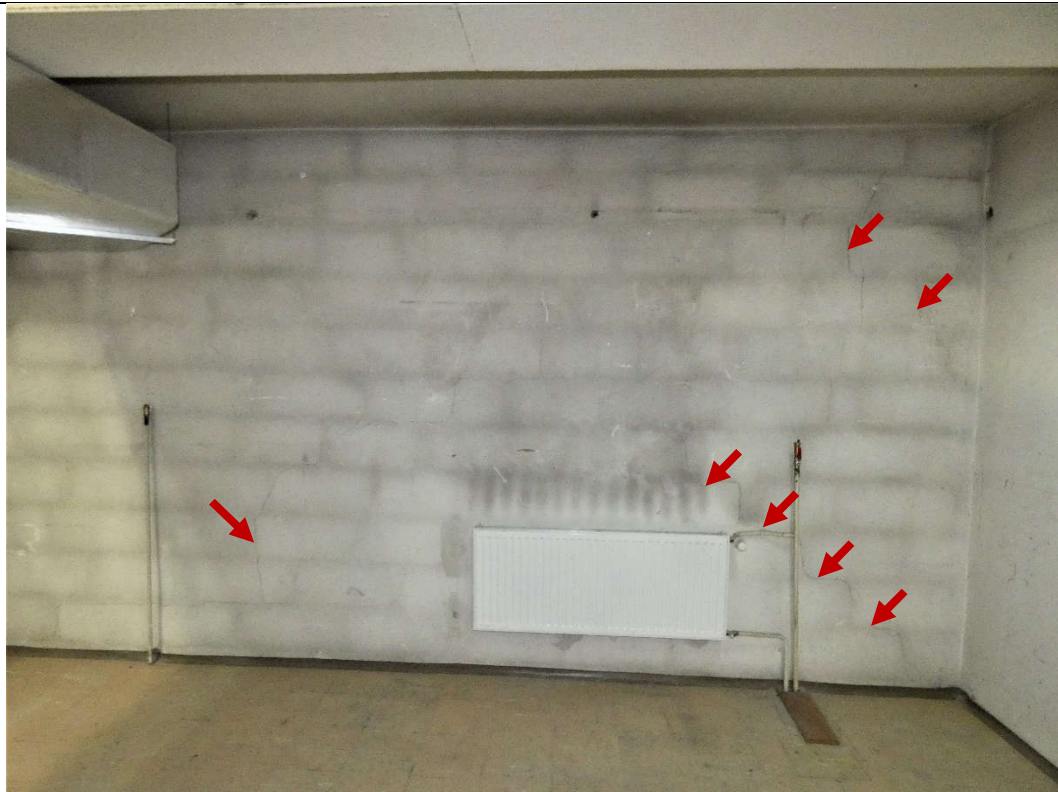
Fot. 8 Przykład zarysowania ściany. Rysy pionowe i ukośne.
