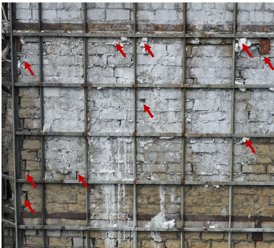
Fot. 22 Piętro 20 (Poziom +71.40) Elewacja Południowa – widok ściany murowanej w osiach 10-11/E. Zbyt duże wymiary spoin, lokalne ubytki spoin pionowych. Ubytki między elementami wypełnione zaprawą i gruzem.
