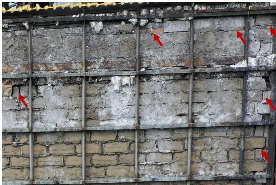
Fot. 3 Widok ściany murowanej – uszkodzone i niewłaściwie przewiązane elementy murowe. Część ubytków między elementami oraz przestrzeni między ścianami a stropami wypełniona zaprawą i gruzem
