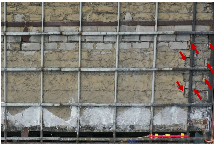
Fot. 21 Piętro 19 (Poziom +68.10) Elewacja Południowa – widok ściany murowanej w osiach 13-14/E. Zbyt duże wymiary spoin. Ubytki spoin pionowych i niewłaściwe przewiązania elementów. Ubytki między elementami wypełnione ceramicznymi elementami murowymi, zaprawą i gruzem.
