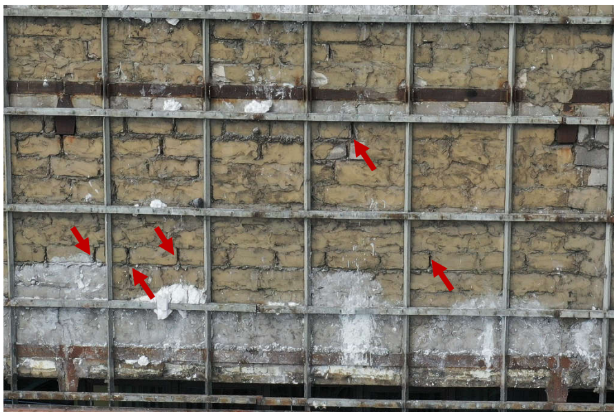
Fot. 15 Piętro 19 (Poziom +68.10) Elewacja Południowa – widok ściany murowanej w osiach 11-12/E. Zbyt duże wymiary spoin. Lokalne ubytki spoin pionowych i niewłaściwe przewiązania elementów.
