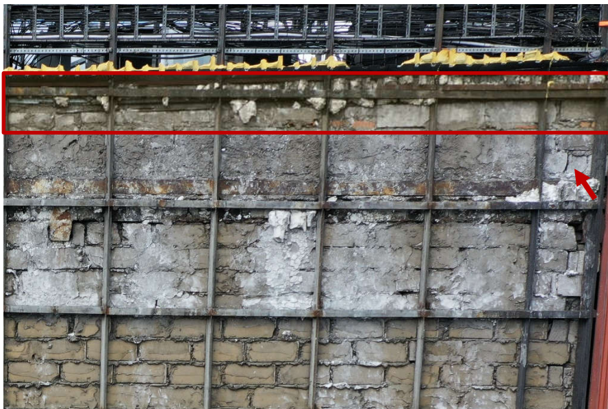
Fot. 29 Stropodach (Poziom +76.09) Elewacja Południowa – widok ściany murowanej w osiach 13-14/E. Zbyt duże wymiary spoin. Ściana z uszkodzonych elementów murowych o zróżnicowanych materiałach i kształtach. Ubytki między elementami oraz pomiędzy ścianą a stropem wypełnione zaprawą i gruzem.
