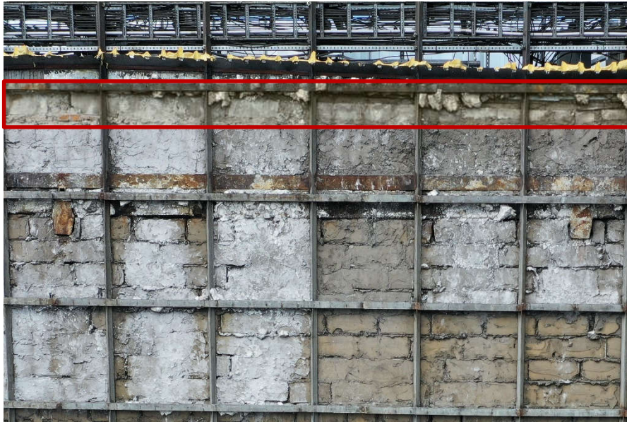
Fot. 28 Stropodach (Poziom +76.09) Elewacja Południowa – widok ściany murowanej w osiach 12-13/E. Zbyt duże wymiary spoin. Ściana z uszkodzonych elementów murowych o zróżnicowanych materiałach i kształtach. Ubytki między elementami oraz pomiędzy ścianą a stropem wypełnione zaprawą i gruzem.
