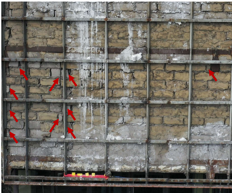
Fot. 18 Piętro 19 (Poziom +68.10) Elewacja Południowa – widok ściany murowanej w osiach 10-11/E. Zbyt duże wymiary spoin, lokalne ubytki spoin pionowych. Niewłaściwe przewiązania elementów, ubytki między elementami wypełnione zaprawą i gruzem.
