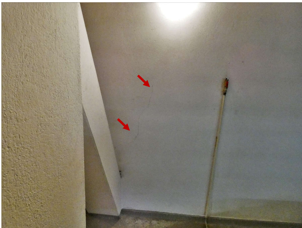
Fot. 9 Przykład zarysowania ściany. Rysy ukośne.
