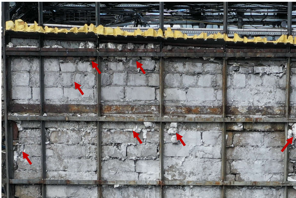
Fot. 1 Widok ściany murowanej – uszkodzone i niewłaściwie przewiązane elementy murowe. Część ubytków między elementami oraz przestrzeni między ścianami a stropami wypełniona zaprawą i gruzem
