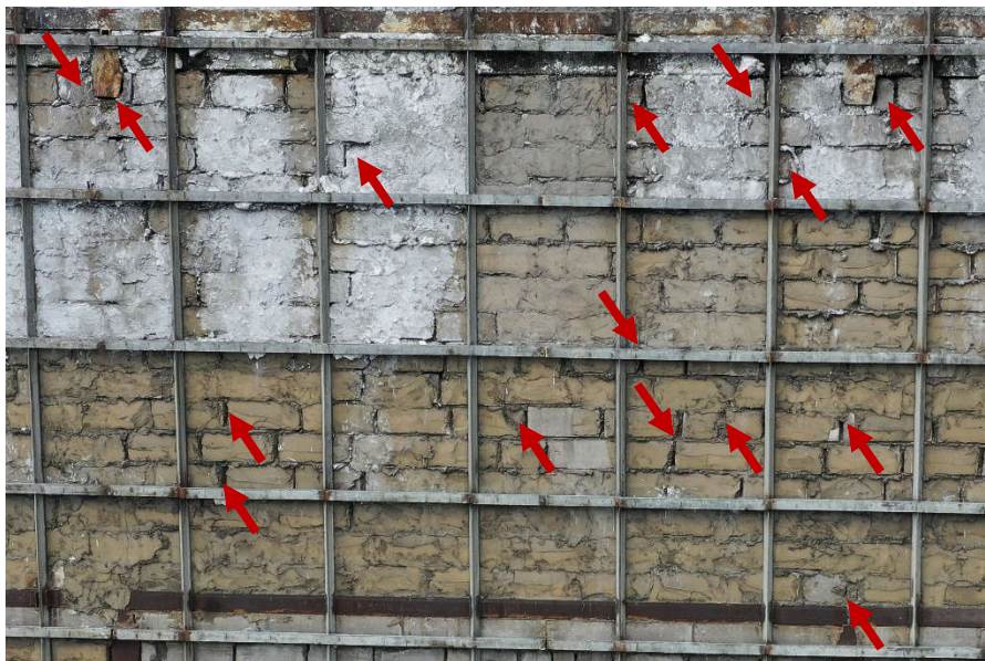
Fot. 24 Piętro 20 (Poziom +71.40) Elewacja Południowa – widok ściany murowanej w osiach 12-13/E. Zbyt duże wymiary spoin. Ubytki spoin pionowych i niewłaściwe przewiązania elementów. Ubytki między elementami wypełnione zaprawą i gruzem.
