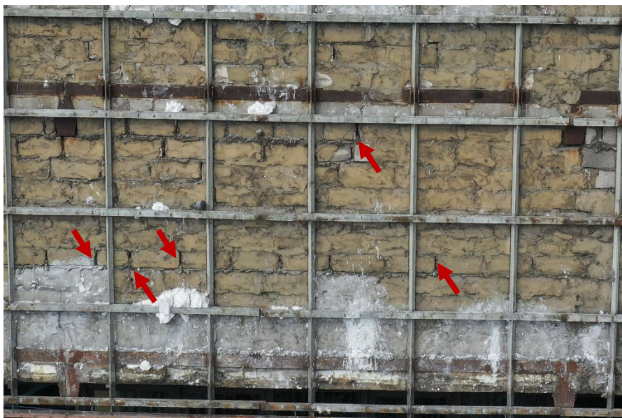
Fot. 19 Piętro 19 (Poziom +68.10) Elewacja Południowa – widok ściany murowanej w osiach 11-12/E. Zbyt duże wymiary spoin. Lokalne ubytki spoin pionowych i niewłaściwe przewiązania elementów.
