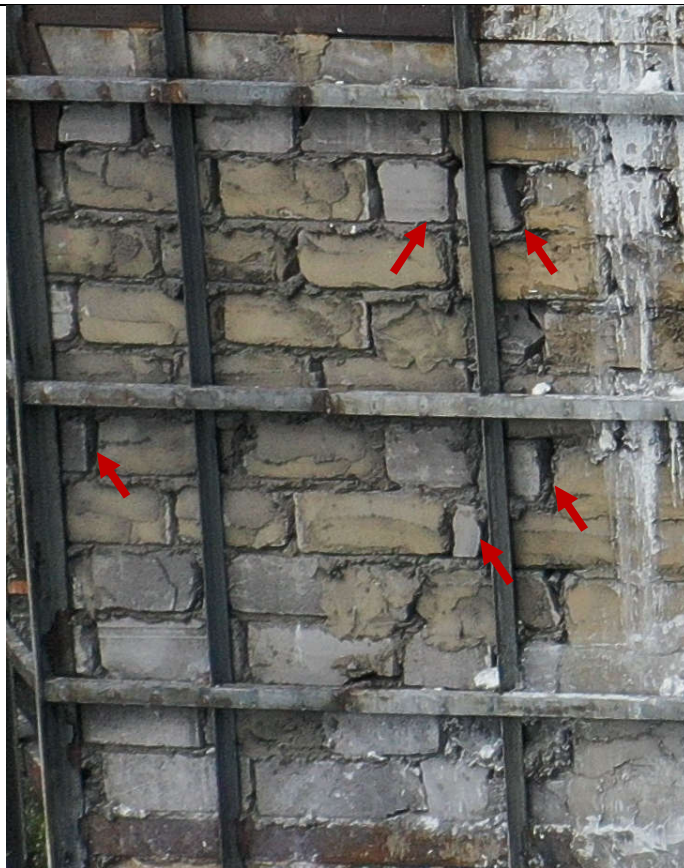
Fot. 2 Widok ściany murowanej – uszkodzone i niewłaściwie przewiązane elementy murowe. Część ubytków między elementami oraz przestrzeni między ścianami a stropami wypełniona zaprawą i gruzem
