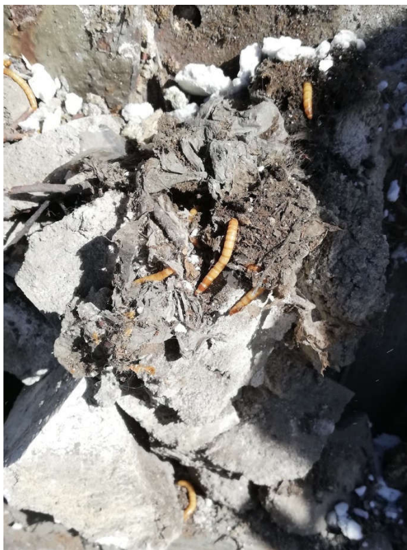
Fot. 7, Gruz i materiał biologiczny w miejscu ubytków w murze oraz przestrzeni między murem, a elewacją z blachy trapezowej.
