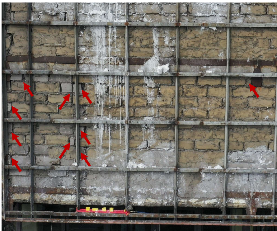
Fot. 14 Piętro 19 (Poziom +68.10) Elewacja Południowa – widok ściany murowanej w osiach 10-11/E. Zbyt duże wymiary spoin, lokalne ubytki spoin pionowych. Niewłaściwe przewiązania elementów, ubytki między elementami wypełnione zaprawą i gruzem.
