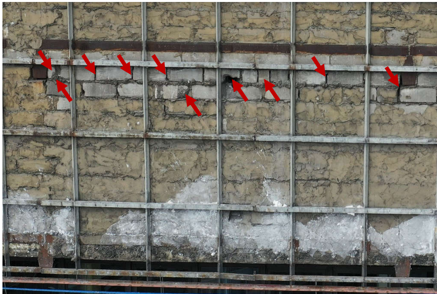
Fot. 20 Piętro 19 (Poziom +68.10) Elewacja Południowa – widok ściany murowanej w osiach 12-13/E. Zbyt duże wymiary spoin. Ubytki spoin pionowych i niewłaściwe przewiązania elementów. Część ściany wykonana z uszkodzonych elementów murowych. Ubytki między elementami wypełnione zaprawą i gruzem.
