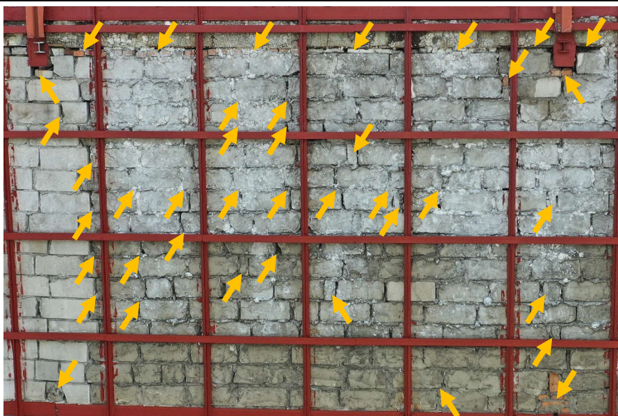
Fot. 23 Piętro 20 (Poziom +71.40) Elewacja Wschodnia – widok ściany murowanej w osiach 14/G-H. Zbyt duże wymiary spoin. Ściana z uszkodzonych, nieprawidłowo przewiązanych elementów murowych z ubytkami spoin pionowych. Uszkodzenia i ubytki między elementami wypełnione elementami ceramicznymi, zaprawą i gruzem. Przestrzeń między ścianą a stropem piętra 20 wypełniona elementami ceramicznymi, zaprawą i gruzem lub pozostawiona bez wypełnienia.
