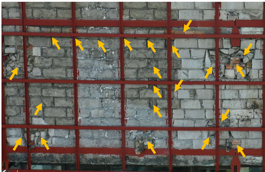
Fot. 15 Piętro 19 (Poziom +68.10) Elewacja Wschodnia – widok ściany murowanej w osiach 14/E-F. Zbyt duże wymiary spoin. Ściana z niewłaściwie przewiązanych, uszkodzonych elementów murowych o zróżnicowanych materiałach i kształtach. Uszkodzenia i ubytki między elementami wypełnione zaprawą i gruzem.
