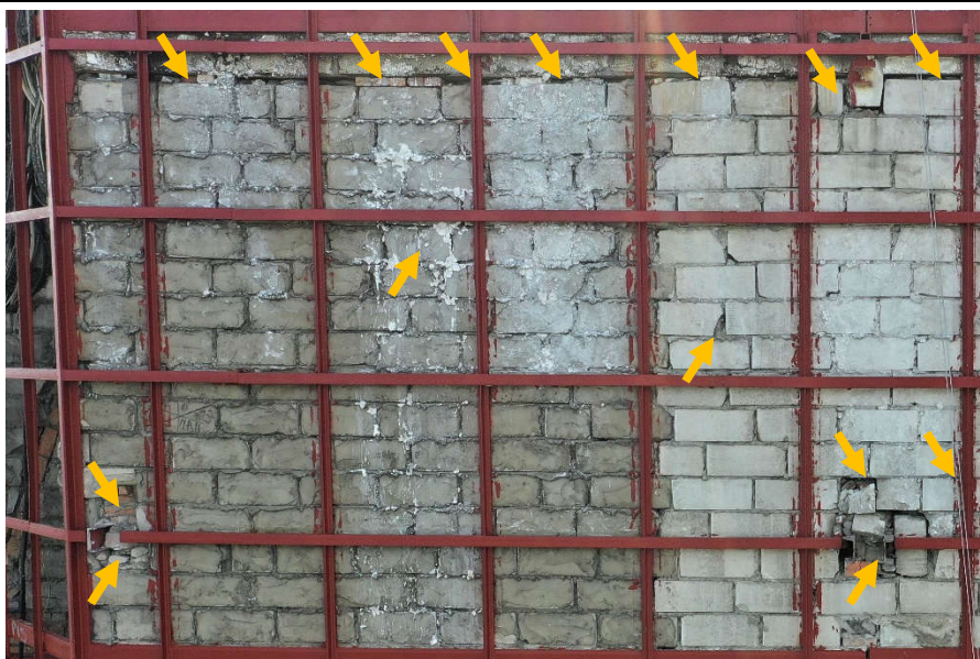
Fot. 21 Piętro 20 (Poziom +71.40) Elewacja Wschodnia – widok ściany murowanej w osiach 14/E-F. Zbyt duże wymiary spoin. Ściana z uszkodzonych elementów murowych. Uszkodzenia i ubytki między elementami wypełnione zaprawą i gruzem. Przestrzeń między ścianą a stropem piętra 20 wypełniona elementami ceramicznymi, zaprawą i gruzem lub pozostawiona bez wypełnienia.
