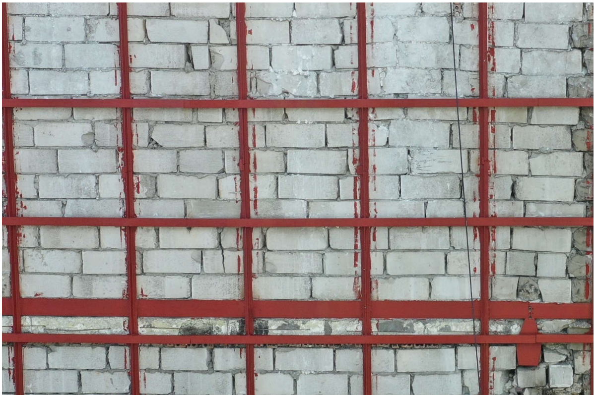
Fot. 3 Widok ściany murowanej o bardzo niskiej jakości wykonania (ściana z uszkodzonych i niewłaściwie przewiązanych elementów murowych z licznymi ubytkami spoin. Przestrzeń między stropem a ścianą piętra 19 wypełniona cegłą dziurawką)
