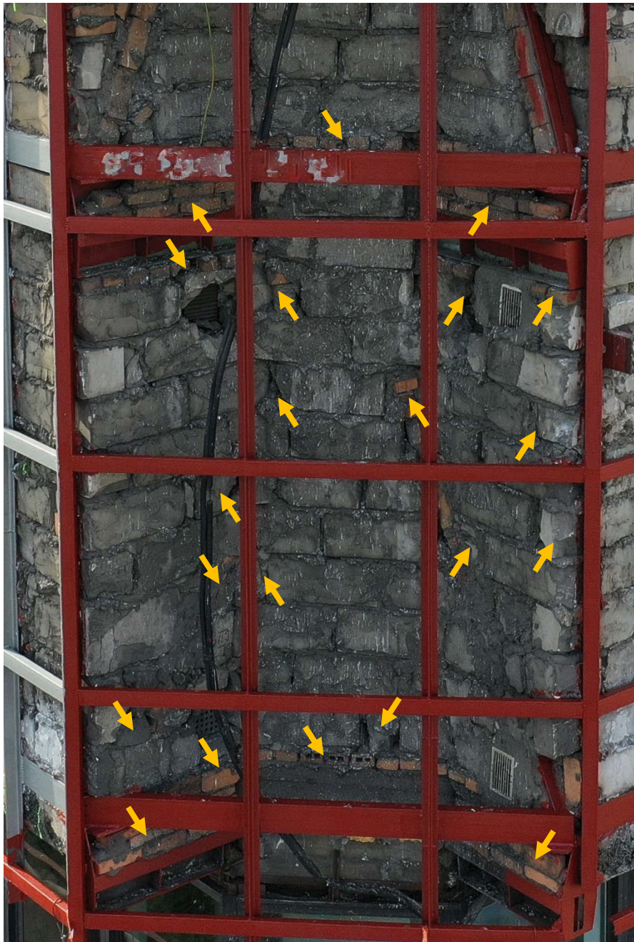
Fot. 14 Piętro 19 (Poziom +68.10) Elewacja Wschodnia Naroże – widok ściany murowanej w osiach 14/E. Zbyt duże wymiary spoin. Ściana z uszkodzonych elementów murowanych o zróżnicowanych materiałach i kształtach. Uszkodzenia i ubytki między elementami wypełnione zaprawą i gruzem
