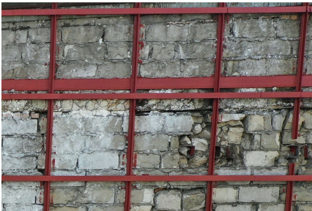
Fot. 5 Widok ściany murowanej o bardzo niskiej jakości wykonania (pozostawione niewypełnione przestrzenie między ścianą a stropem, lokalnie ubytki między elementami wypełnione zaprawą i gruzem lub elementami o zróżnicowanych materiałach i kształtach)
