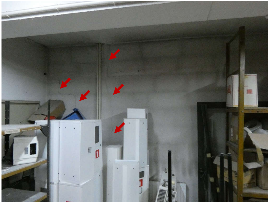
Fot. 7 Przykład zarysowania ściany. Rysy ukośne (schodkowe) i pionowe.
