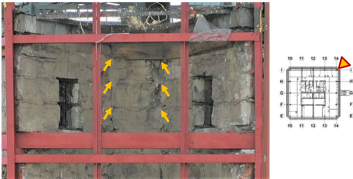
Fot. 30 Stropodach (Poziom +76.09) Elewacja Wschodnia Naroże – widok ściany murowanej w osiach 14/I.
