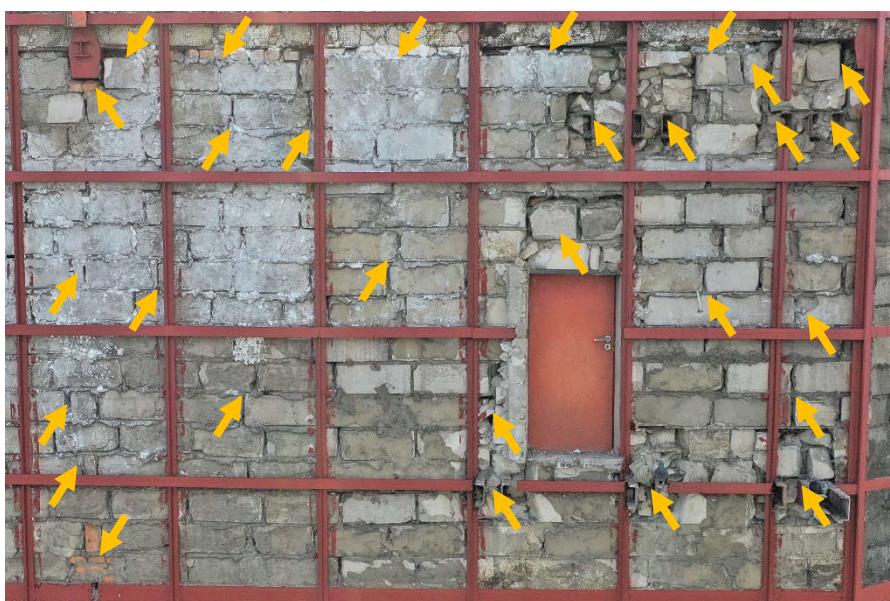
Fot. 24 Piętro 20 (Poziom +71.40) Elewacja Wschodnia – widok ściany murowanej w osiach 14/H-I. Zbyt duże wymiary spoin. Ściana z uszkodzonych, nieprawidłowo przewiązanych elementów murowych z ubytkami spoin pionowych. Uszkodzenia i ubytki między elementami wypełnione zaprawą i gruzem. Przestrzeń między ścianą a stropem piętra 20 wypełniona elementami ceramicznymi, zaprawą i gruzem lub pozostawiona bez wypełnienia.
