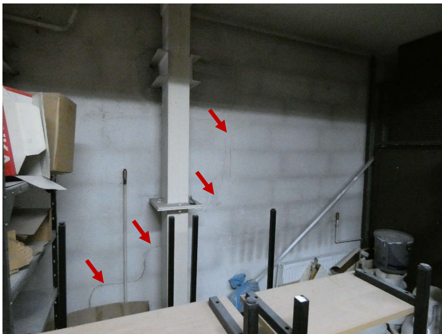
Fot. 8 Przykład zarysowania ściany. Rysy ukośne i pionowe.
