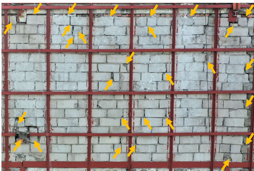
Fot. 22 Piętro 20 (Poziom +71.40) Elewacja Wschodnia – widok ściany murowanej w osiach 14/F-G. Zbyt duże wymiary spoin. Ściana z uszkodzonych, nieprawidłowo przewiązanych elementów murowych. Uszkodzenia i ubytki między elementami wypełnione zaprawą i gruzem. Przestrzeń między ścianą a stropem piętra 20 wypełniona cegłą dziurawką, zaprawą i gruzem lub pozostawiona bez wypełnienia.
