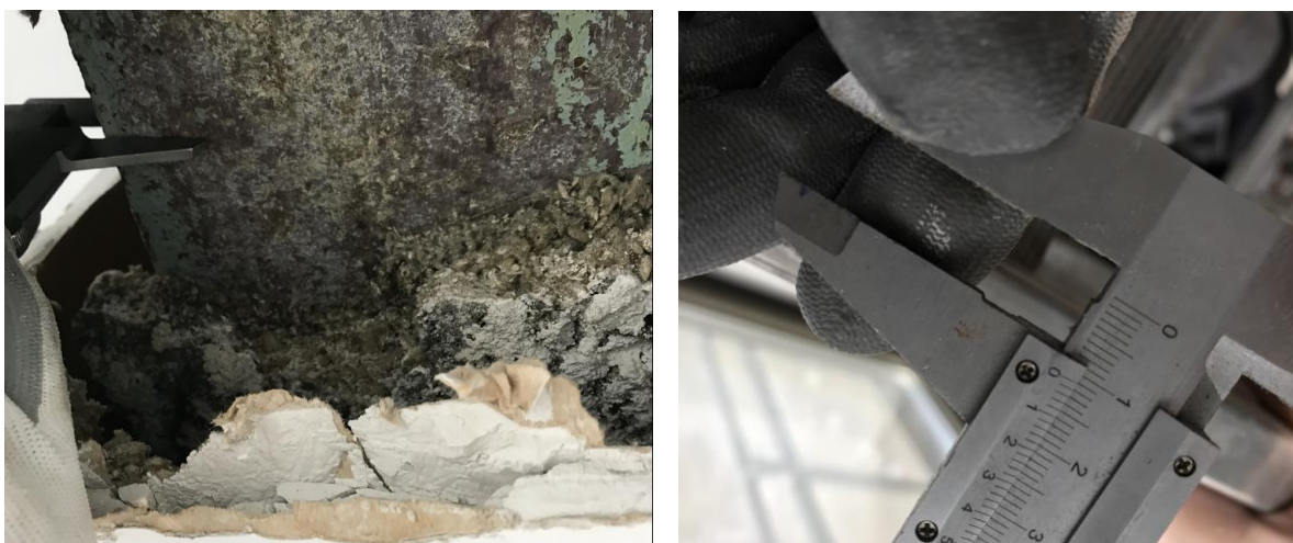
Fot. 2 Odkrywka 1 - Belka stalowa Poz. 5.3 – Pomiar grubości pasa dolnego
