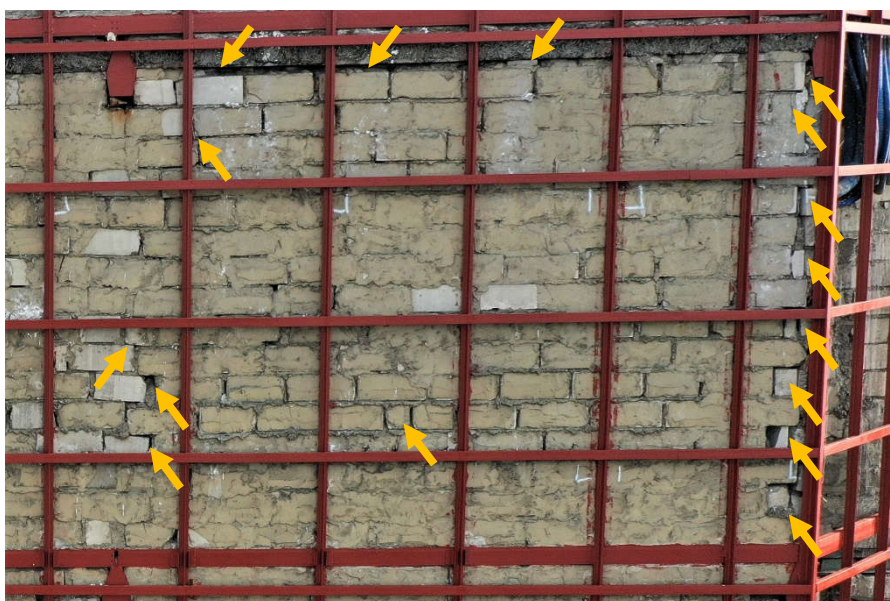
Fot. 17 Piętro 20 (Poziom +71.40) Elewacja Północna – widok ściany murowanej w osiach 10-11/I. Zbyt duże wymiary spoin. Ściana z niewłaściwie przewiązanych elementów murowych z ubytkami spoin pionowych. Ubytki między elementami wypełnione zaprawą i gruzem. Przestrzeń między ścianą a stropem 20 piętra wypełniona zaprawą i gruzem lub pozostawiona bez wypełnienia.
