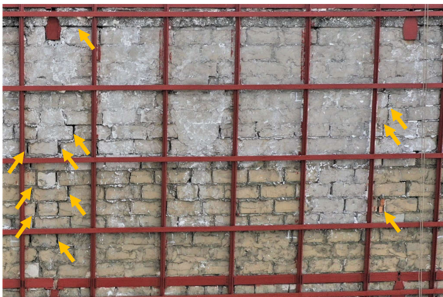
Fot. 15 Piętro 20 (Poziom +71.40) Elewacja Północna – widok ściany murowanej w osiach 12-13/I. Zbyt duże wymiary spoin. Ściana z niewłaściwie przewiązanych elementów murowych z ubytkami spoin pionowych. Ubytki między elementami wypełnione zaprawą i gruzem. Lokalnie brak wypełnienia przestrzeni między ścianą a stropem nad 20 pięciem.
