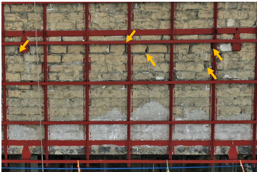
Fot. 11 Piętro 19 (Poziom +68.10) Elewacja Północna – widok ściany murowanej w osiach 11-12/I. Zbyt duże wymiary spoin. Ściana z niewłaściwie przewiązanych elementów murowych z ubytkami spoin pionowych. Wypełnienie ubytków między elementami zaprawą i gruzem.
