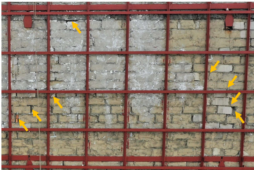
Fot. 16 Piętro 20 (Poziom +71.40) Elewacja Północna – widok ściany murowanej w osiach 11-12/I. Zbyt duże wymiary spoin. Ściana z uszkodzonych i niewłaściwie przewiązania elementów murowych z ubytkami w spoinach pionowych. Ubytki między elementami wypełnione zaprawą i gruzem. Lokalnie brak wypełnienia przestrzeni między ścianą a stropem nad 20 piętrem.
