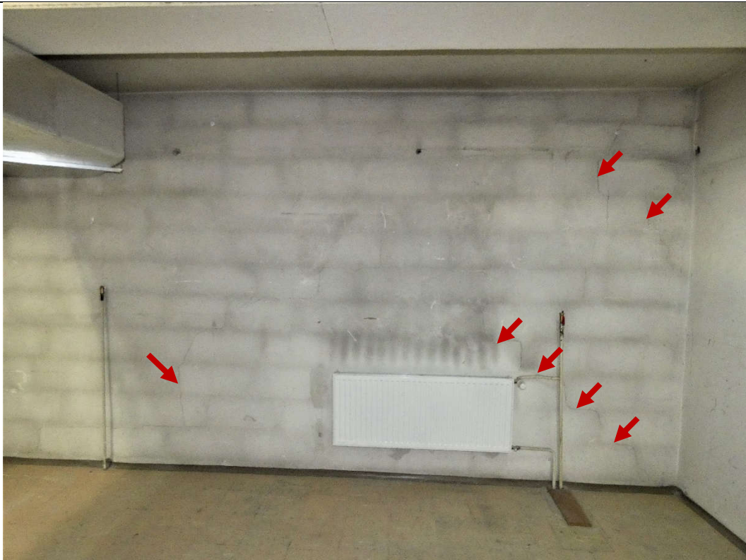
Fot. 4 Przykład zarysowania ściany. Rysy pionowe i ukośne.
