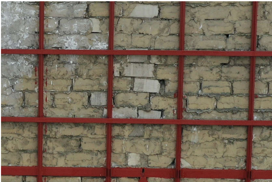
Fot. 1 Widok ściany murowanej – uszkodzone i niewłaściwie przewiązane elementy murowe z ubytkami spoin pionowych. Wypełnienie ubytków między elementami zaprawą i gruzem.
