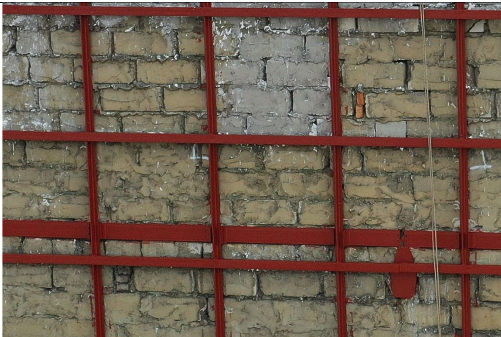
Fot. 2 Widok ściany murowanej – uszkodzone i niewłaściwie przewiązane elementy murowe z ubytkami w spoinach pionowych. Wypełnienie ubytków między elementami zaprawą i gruzem
