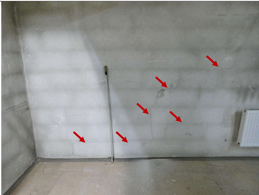
Fot. 6 Przykład zarysowania ściany. Rysy ukośne i poziome.
