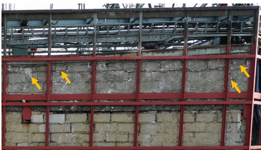
Fot. 22 Stropodach (Poziom +76.09) Elewacja Północna – widok ściany murowanej w osiach 10-11/I. Zbyt duże wymiary spoin. Ściana z elementów murowanych o zróżnicowanych wymiarach. Ubytki między elementami wypełnione zaprawą i gruzem.
