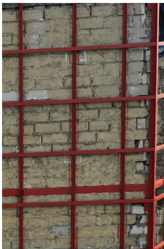
Fot. 3 Widok ściany murowanej – uszkodzone i niewłaściwie przewiązane elementy murowe z ubytkami w spoinach. Wypełnienie części ubytków między elementami zaprawą i gruzem
